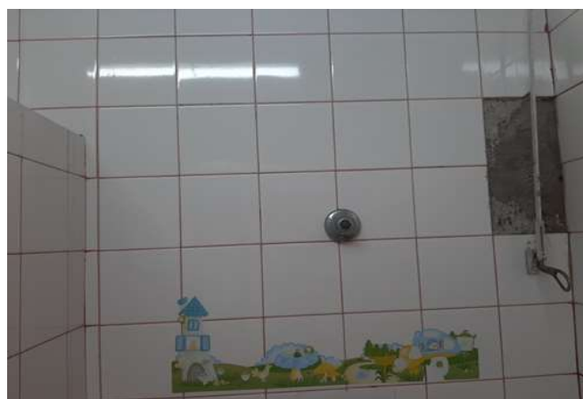
FOTO 44 Registro de gaveta sem acabamento
