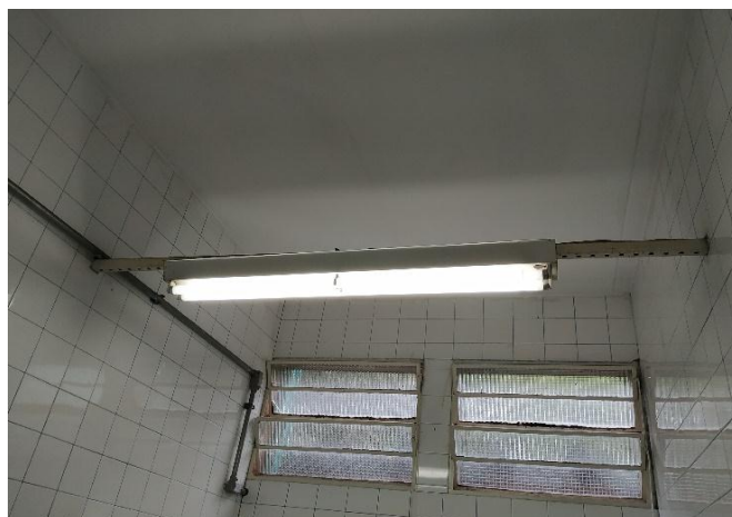
FOTO 22 Luminárias sobrepor com lâmpadas tubular de LED, banheiro dos funcionários.
