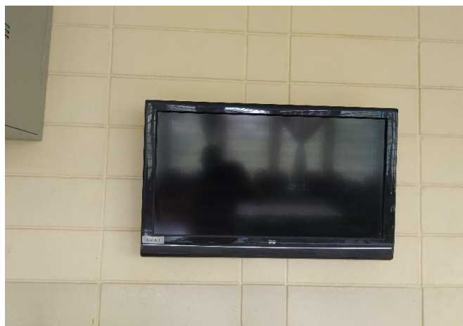
FOTO 96 Televisor instalado na sala de aula 3.
