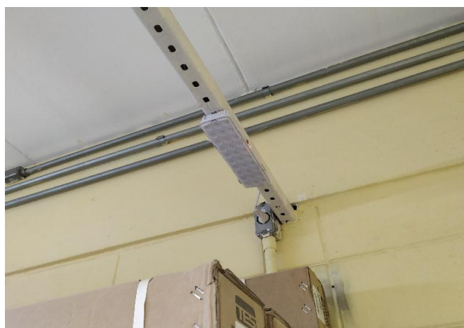
FOTO 16 Iluminação de emergência.
