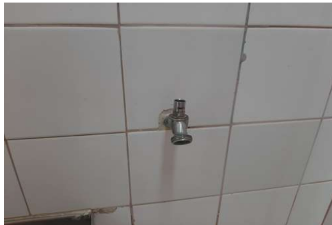
FOTO 50 Torneira de acionamento restrito
