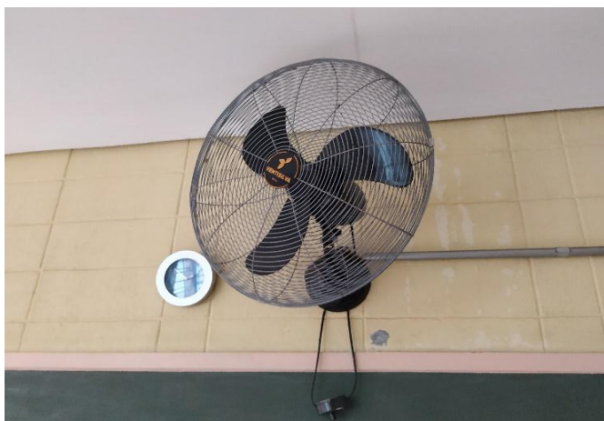
FOTO 87 Ventilador de parede, sala de aula 1.
