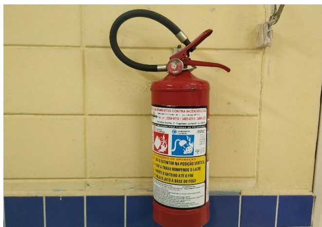
FOTO 14 Extintor pó químico, 4 (quatro) unidades.
