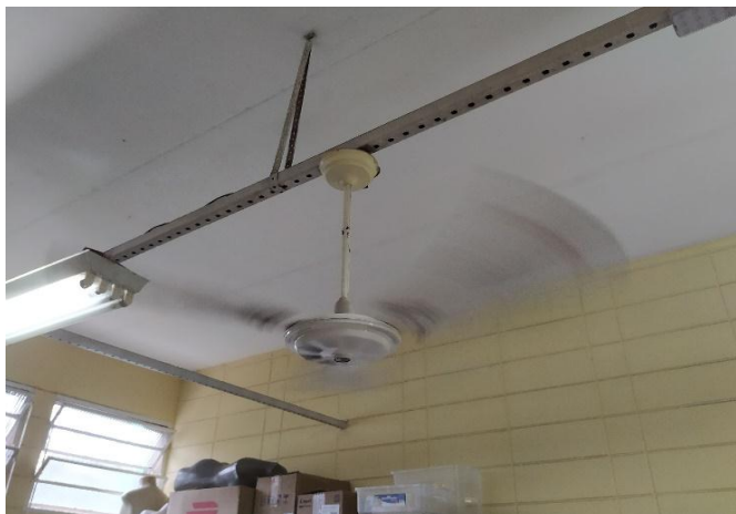
FOTO 85 Ventilador de teto, sala dos professores.
