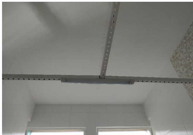
FOTO 20 Luminária sobrepor de LED. Banheiro dos funcionários.
