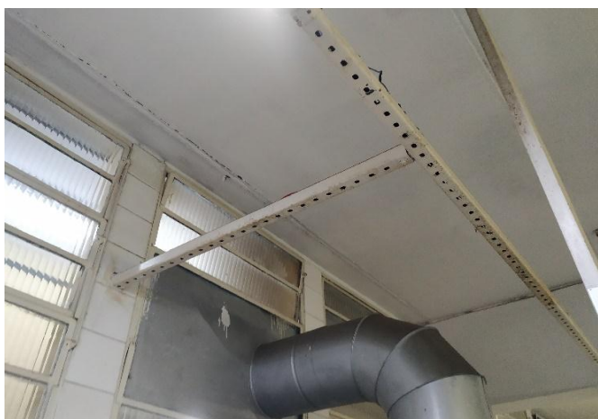
FOTO 93 Duto de saída do exaustor.
