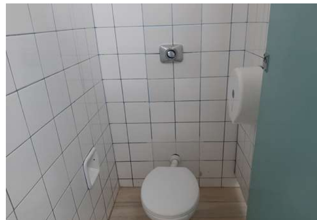
FOTO 58 Válvula de descarga com botão preso
