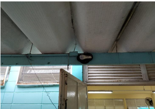
FOTO 57 Luminária tipo tartaruga com lâmpada de LED, área externa, fundos.
