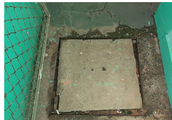
FOTO 42 Caixa de passagem
