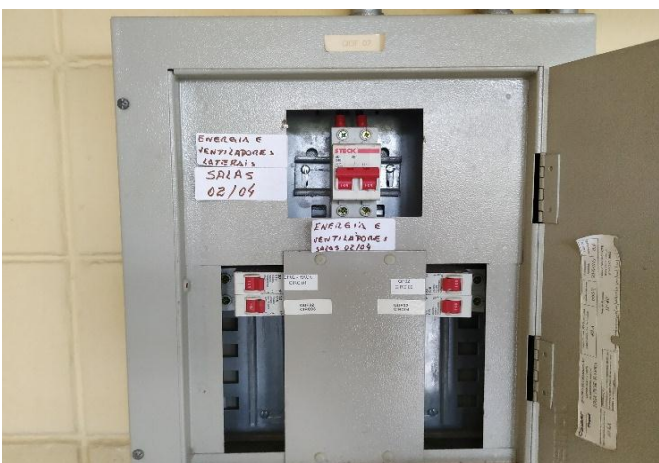
FOTO 17 Quadro de distribuição, instalado no piso superior.
