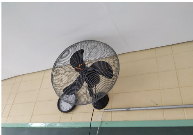
FOTO 89 Ventilador de parede, sala de aula 2.
