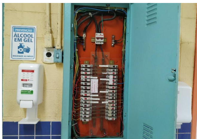
FOTO 6 Quadro de distribuição, piso térreo. Adaptação na distribuição de barramento/cabo.
