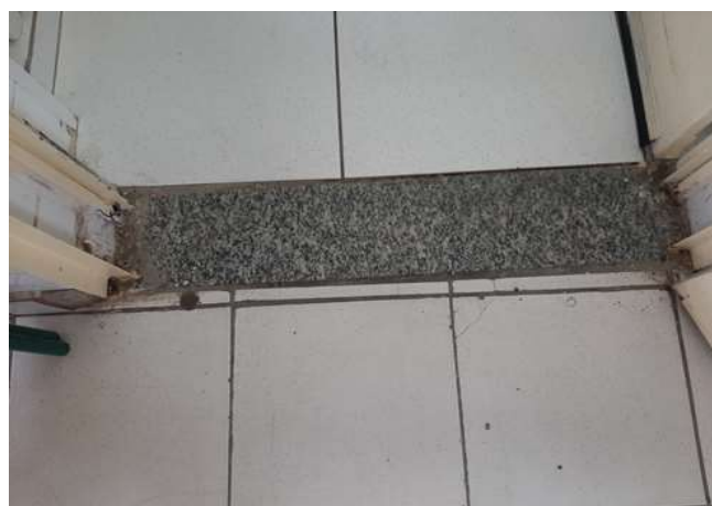
FOTO 28 Soleira porta de cozinha
