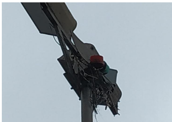
FOTO 64 Refletores com lâmpadas de vapor de sódio e relé fotoelétrico, inoperantes. Quadra poliesportiva.
