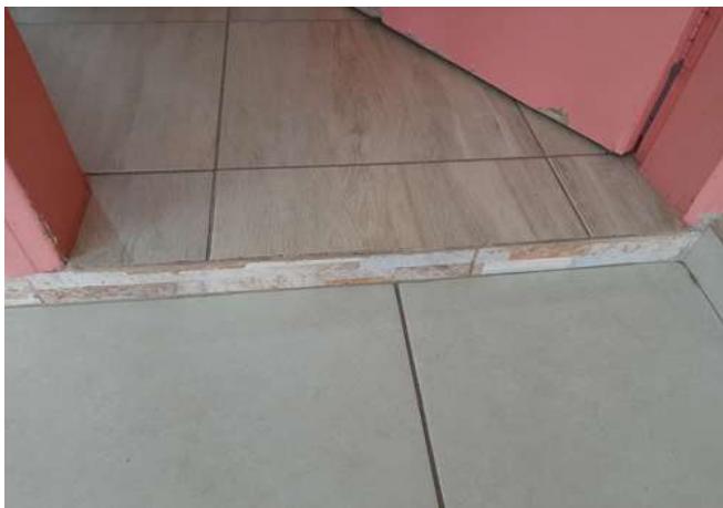
FOTO 19 Degrau entrada do banheiro feminino alunos
