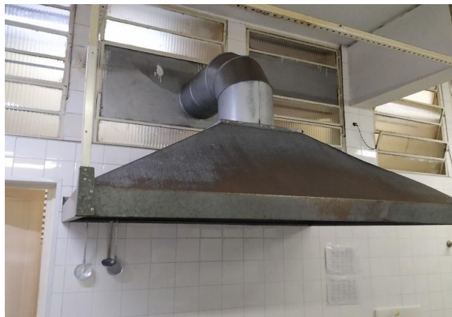
FOTO 92 Coifa instalado na cozinha.
