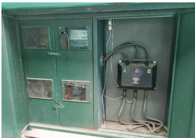
FOTO 5 Dispositivo de proteção. Condutor fase, neutro e terra.
