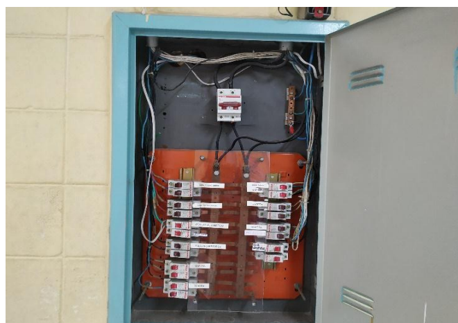
FOTO 10 Interior do quadro de distribuição.
