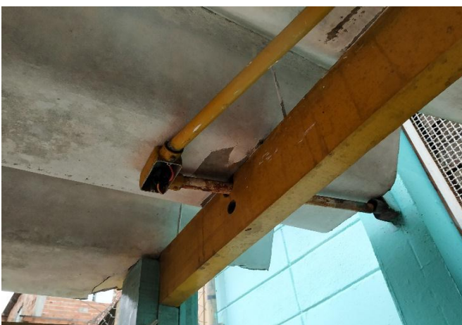
FOTO 59 Conduletes em mal estado de conservação, fundos.
