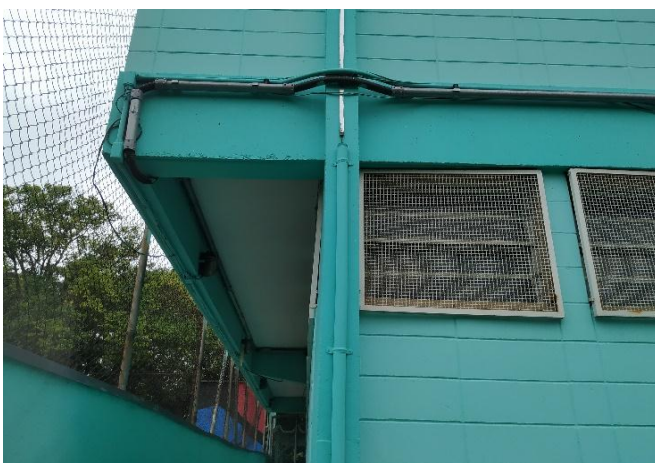
FOTO 5 Tubo de proteção.
