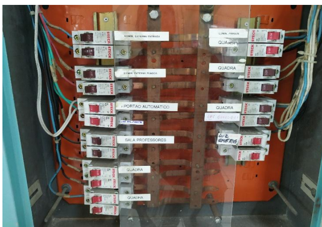
FOTO 11 Adaptação na distribuição do barramento/cabo. Cabos de distribuição fora do padrão de cores.
