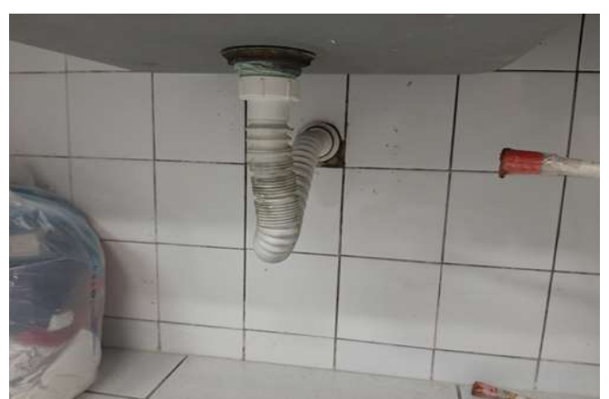
FOTO 64 Sifão de pia
