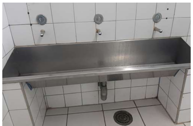
FOTO 66 Lavatório com torneiras antivandalismo
