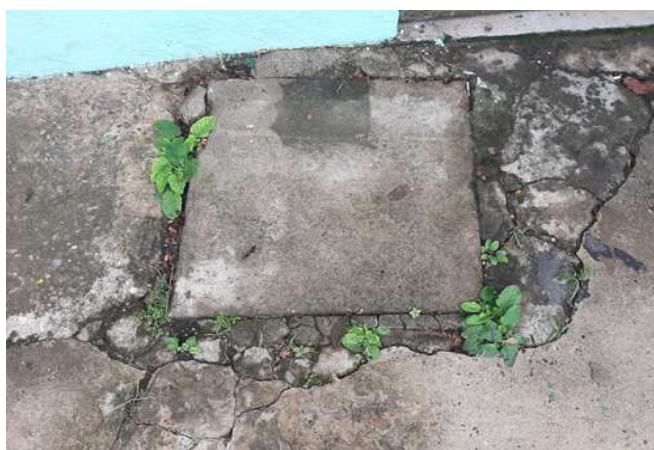
FOTO 34 Caixa de passagem
