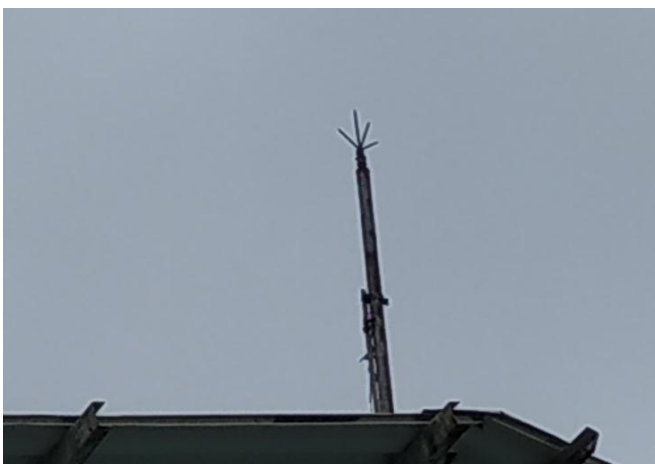
FOTO 3 Captor tipo Franklin, do sistema de SPDA. Falta luz de sinalização.
