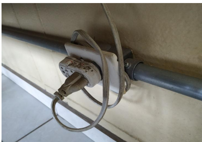
FOTO 75 Tomada padrão brasileiro, utilização de benjamin "T", instalar mais tomadas, na sala de aula 3.
