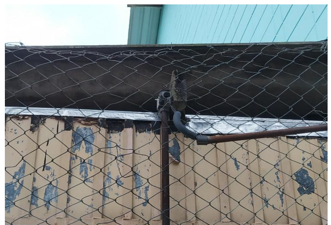
FOTO 60 Conduletes em mal estado de conservação, cabos elétricos expostos. Fundos.
