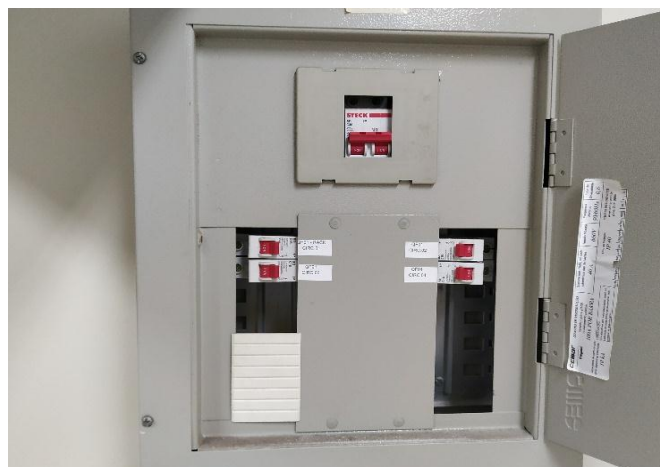
FOTO 16 Quadro de distribuição, instalado na secretaria.
