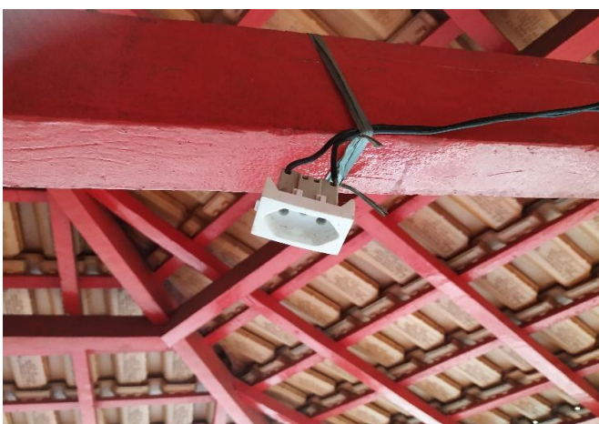
FOTO 71 Adaptação com módulo de tomada, cabos elétricos expostos, quiosque do playground.
