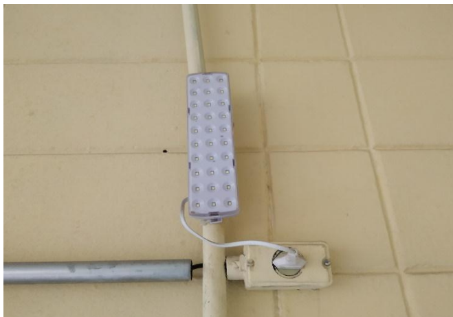
FOTO 19 Iluminação de emergência.
