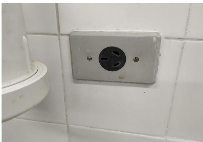
FOTO 77 Tomada padrão pino chato, substituir por padrão brasileiro, cozinha.
