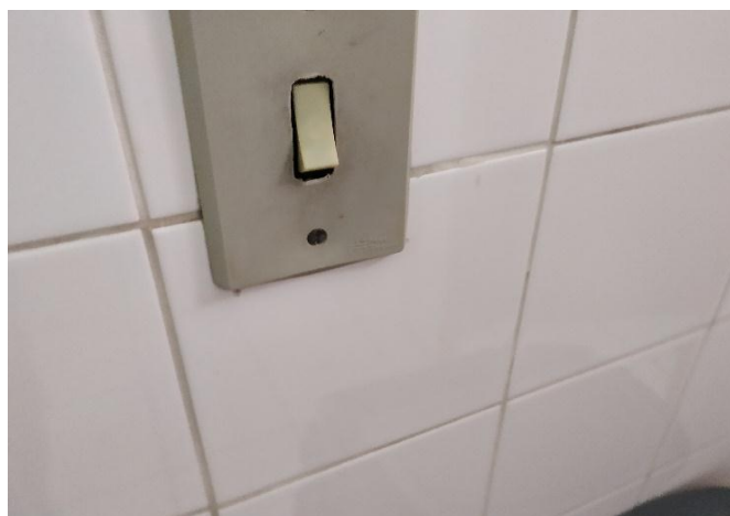
FOTO 46 Interruptor, banheiro dos funcionários.
