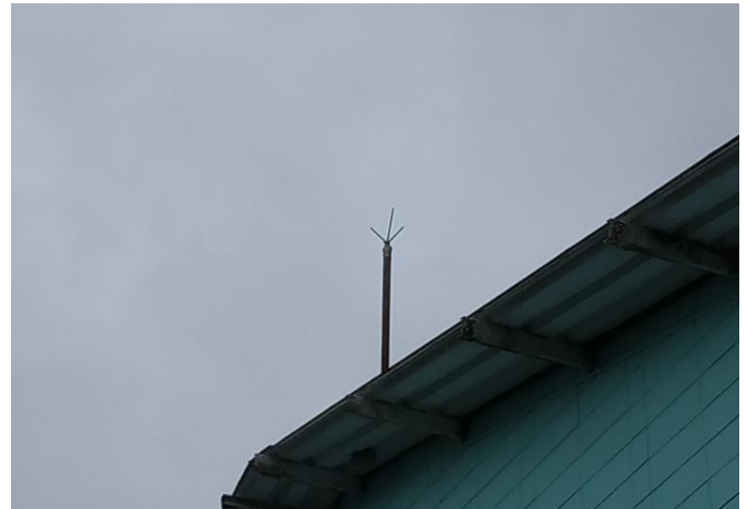
FOTO 2 Captor tipo Franklin, do sistema de SPDA. Falta luz de sinalização.
