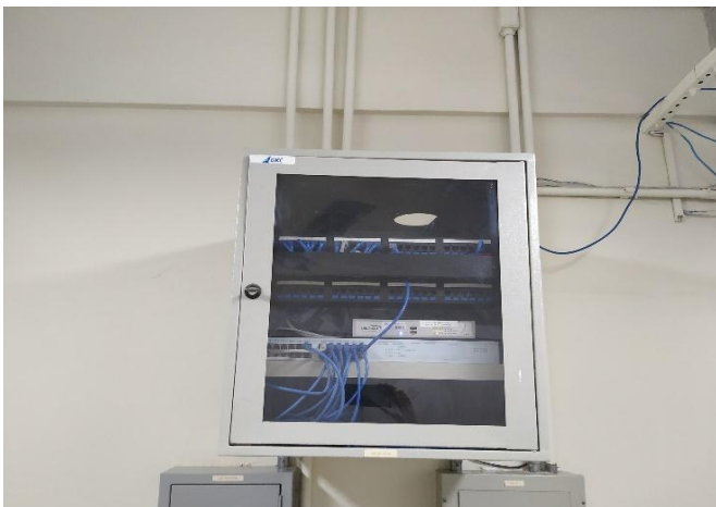
FOTO 79 Rack dos switch, secretaria.
