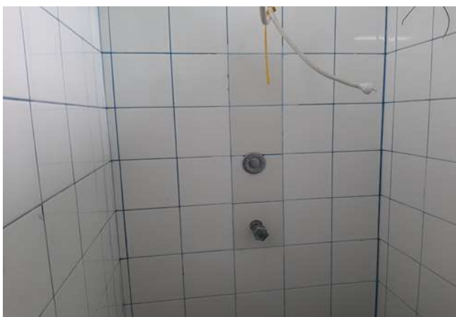
FOTO 59 Válvula de acionamento automático
