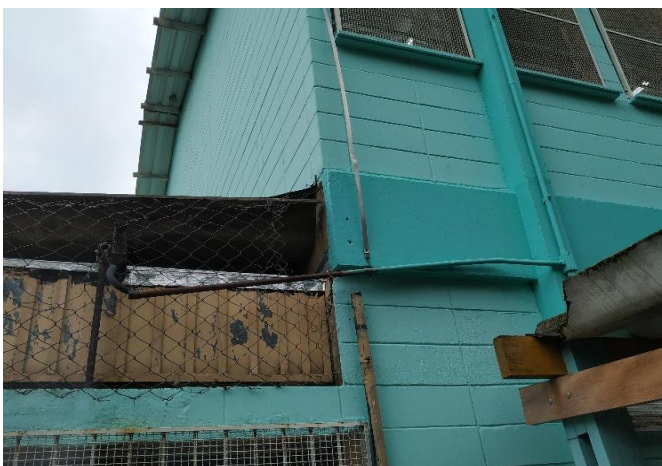
FOTO 11 Barra chata rompida.
