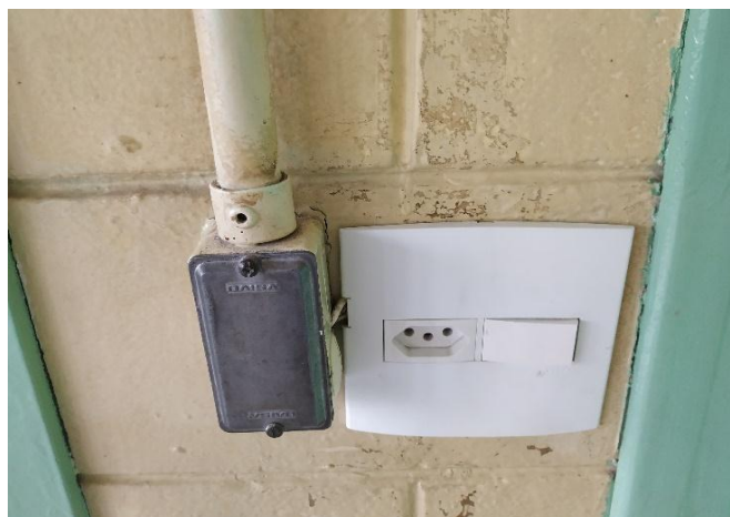
FOTO 42 Interruptor e tomada padrão brasileiro, sala de aula 2.
