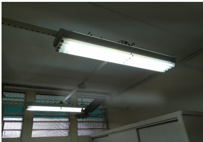
FOTO 19 Luminárias sobrepor com lâmpadas tubular de LED, secretaria.
