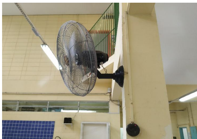
FOTO 84 Ventilador de parede, refeitório.
