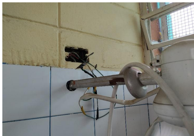
FOTO 18 Chuveiro elétrico, revisar os cabos de alimentação e instalar conector apropriado. Banheiro infantil, superior.
