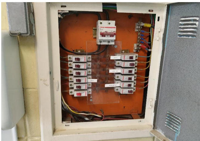
FOTO 13 Interior do quadro de distribuição, piso superior.
