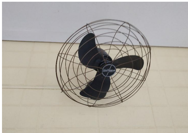
FOTO 86 Ventilador de parede, sala de aula 1.
