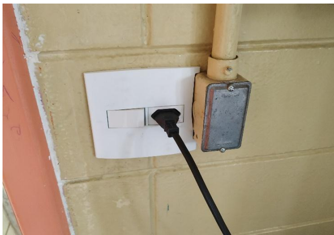
FOTO 43 Interruptor e tomada padrão brasileiro, sala de aula 3.
