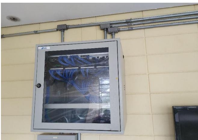
FOTO 81 Rack dos switch, sala de aula 3.
