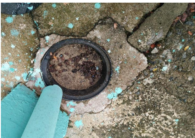
FOTO 9 Caixa de inspeção sem tampa, realizar limpeza.
