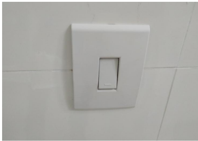
FOTO 38 Interruptor, banheiro dos funcionários.
