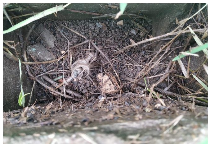
FOTO 6 Caixa de inspeção. Conector não adequado ao sistema.
