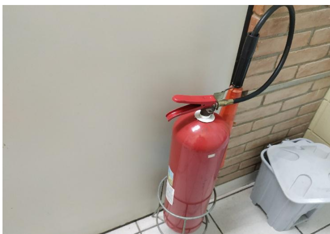
FOTO 15 Extintor CO2, 1 (uma) unidade.
