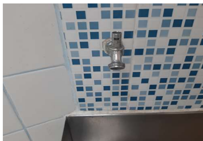
FOTO 60 Torneira de uso restrito
