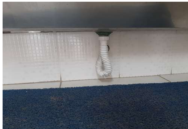
FOTO 56 Sifão lavatório parede
