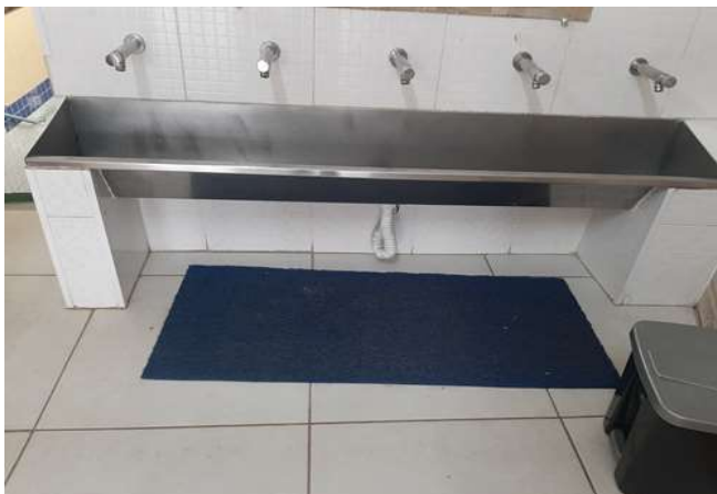
FOTO 55 Lavatório parede com arejador
