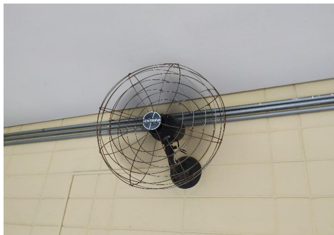
FOTO 90 Ventilador de parede, sala de aula 3.
