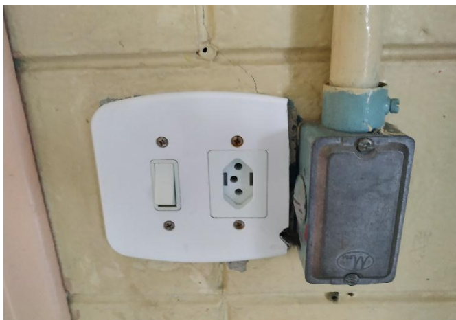
FOTO 41 Interruptor e tomada padrão brasileiro, sala de aula 1.
