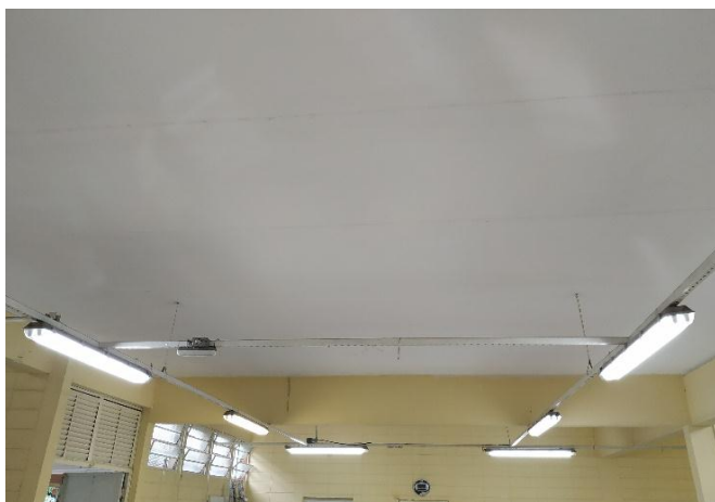
FOTO 23 Luminárias sobrepor com lâmpadas tubular de LED, refeitório.
