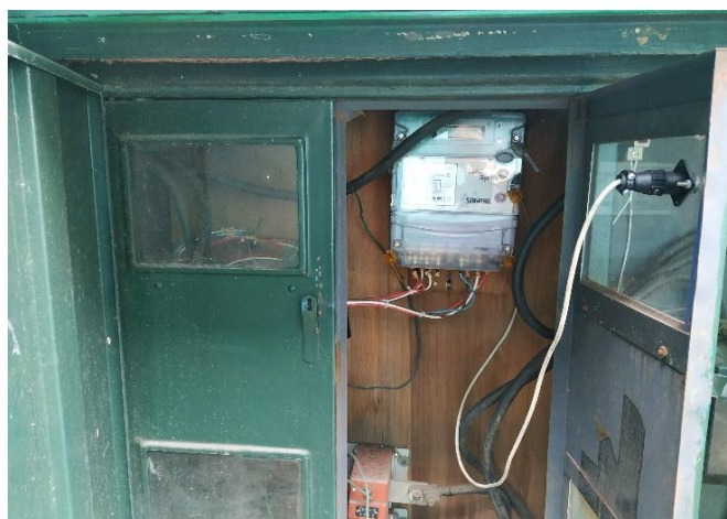
FOTO 4 Caixa de medição de energia.
