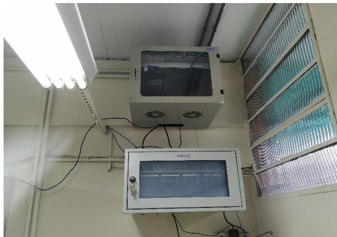
FOTO 80 Rack dos equipamentos de banda larga, secretaria.
