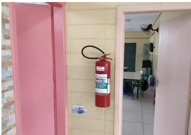
FOTO 13 Extintor de água, 2 (duas) unidades.
