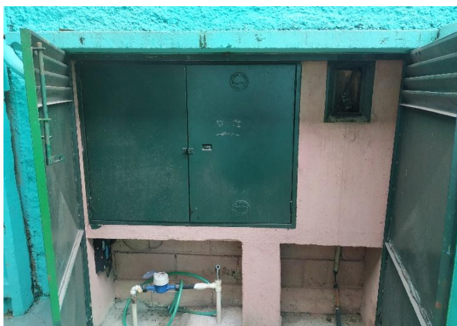
FOTO 3 Quadro de entrada de energia.
