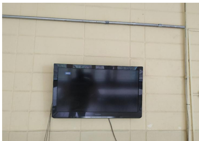
FOTO 94 Televisor instalado na sala de aula 1.
