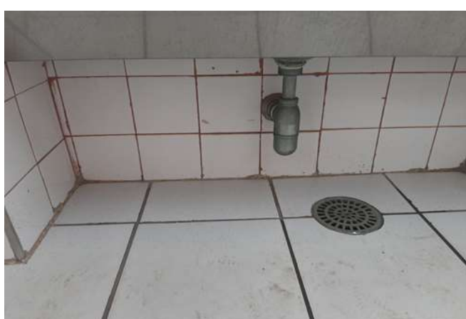
FOTO 46 Ralo lavatório banheiro fem. Alunos
