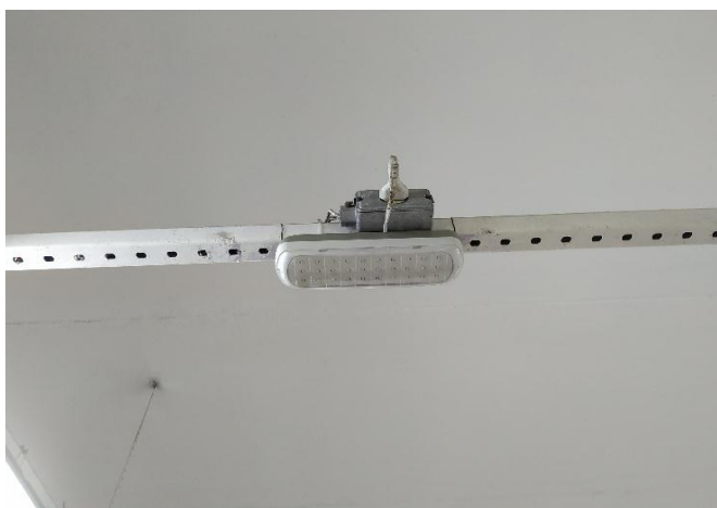
FOTO 17 Iluminação de emergência.
