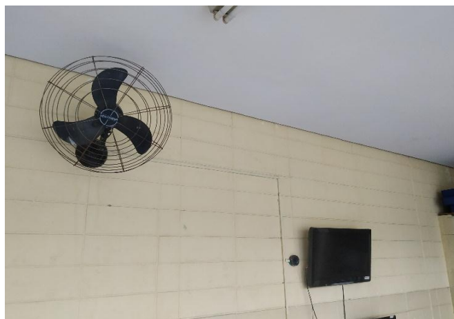
FOTO 88 Ventilador de parede, sala de aula 2.
