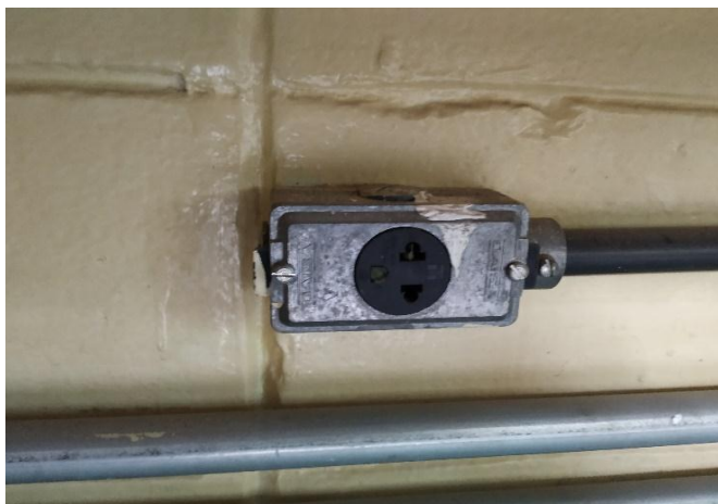
FOTO 73 Tomada padrão americano antigo, substituir por padrão brasileiro, sala de aula 1.
