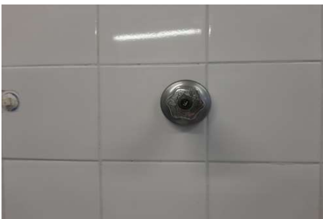
FOTO 65 Registro de gaveta oxidado
