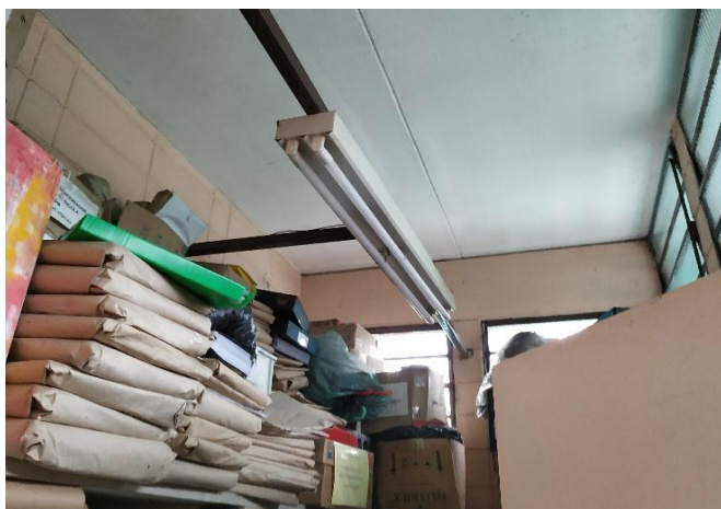
FOTO 21 Luminárias sobrepor com lâmpadas tubular de LED, depósito da secretaria.
