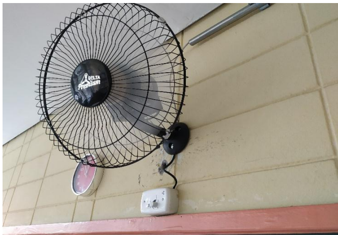
FOTO 91 Ventilador de parede, sala de aula 3.
