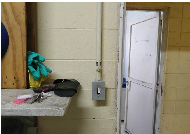
FOTO 47 Interruptor, depósito da limpeza.
