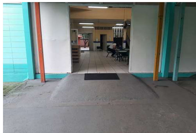
FOTO 6 Portão de acesso pátio
