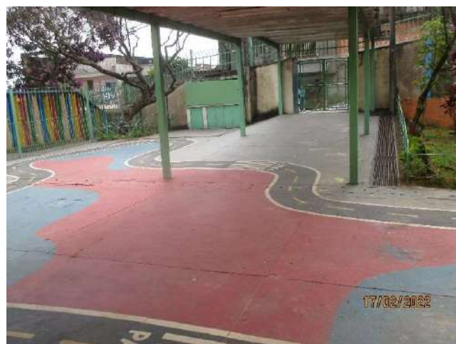
FOTO 44 PÁTIO DESCOBERTO PINTURA DESBOTANDO
