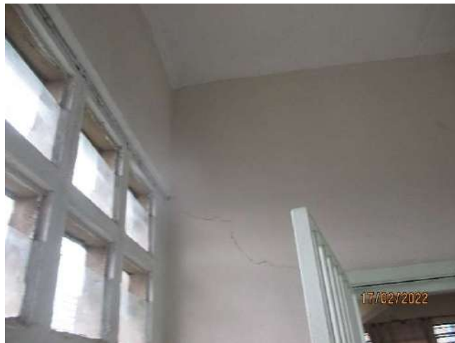
FOTO 35 SALA DE AULA 01 COM FISSURA E TRINCA
