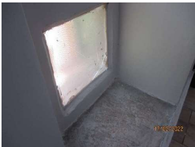
FOTO 77 SALA DIRETOR FECHAMENTO COM VIDRO QUEBRADO
