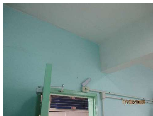
FOTO 34 SALA 01 COM TRINCA
