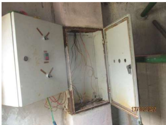
FOTO 13 RESERVATÓRIO DE ÁGUA QUADRO DISJUNTORES
