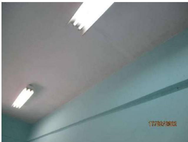
FOTO 31 SALA DE AULA 01 COM FISSURA E TRINCA NA PAREDE
