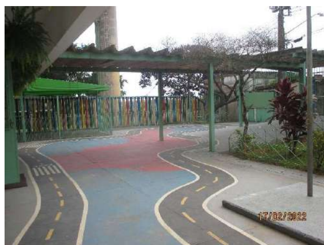
FOTO 45 PÁTIO DESCOBERTO PINTURA DESBOTANDO
