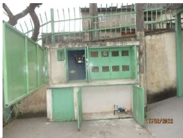
FOTO 26 QUADRO ENTRADA DE ENERGIA E CAVALETE
