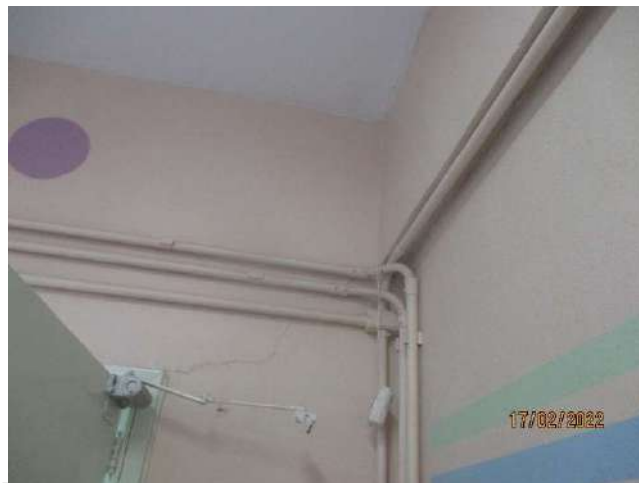
FOTO 32 BRINQUEDOTECA COM TRINCA NA PAREDE
