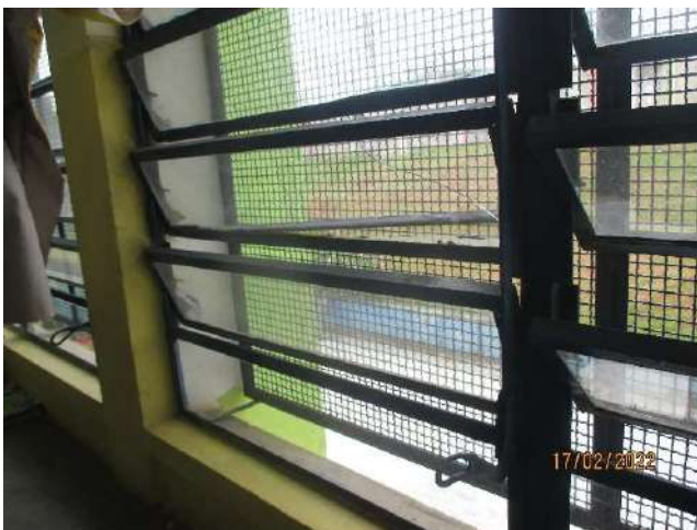
FOTO 42 SALA DE AULA 05 COM VIDRO QUEBRADO E COM PARTES SOLTAS
