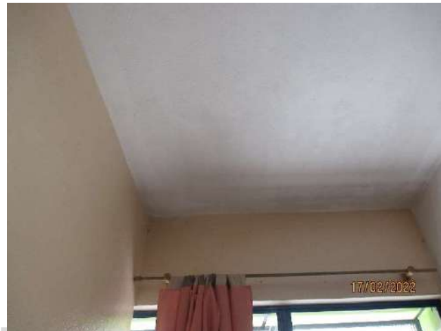
FOTO 74 SALA DOS PROFESSORES FORRO COM SUJIDADES
