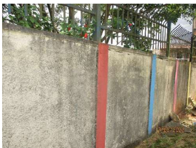
FOTO 15 MURO DIVISA COM DESCOLORAÇÃO PINTURA
