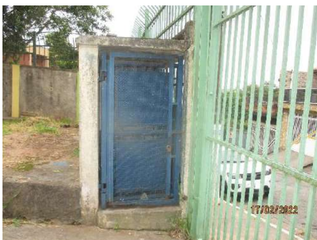
FOTO 9 LIXEIRA COM PINTURA DESCOLORIDA
