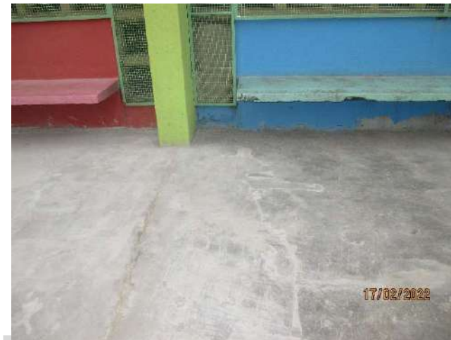
FOTO 24 PÁTIO DESCOBERTO PINTURA DESCOLORIDA
