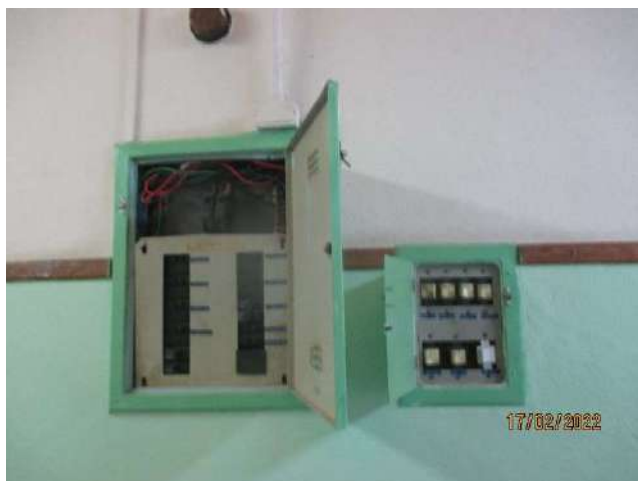
FOTO 37 QUADRO DE DISJUNTORES PISO SUPERIOR
