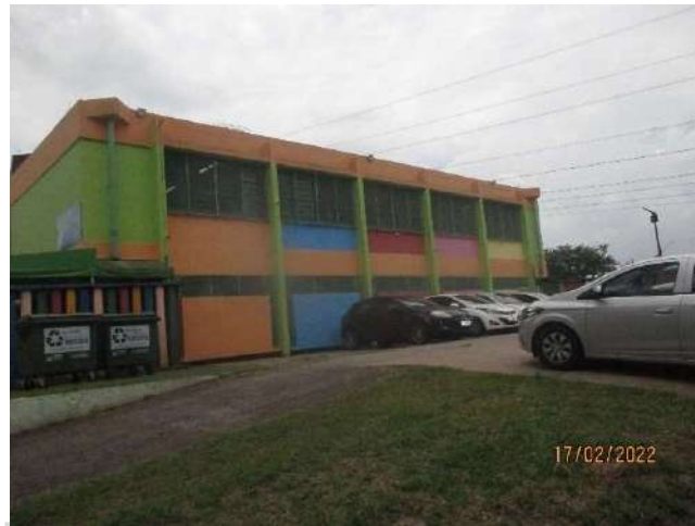
FOTO 2 FACHADA LATERAL DIREITA COM MANCHAS E SUJIDADES
