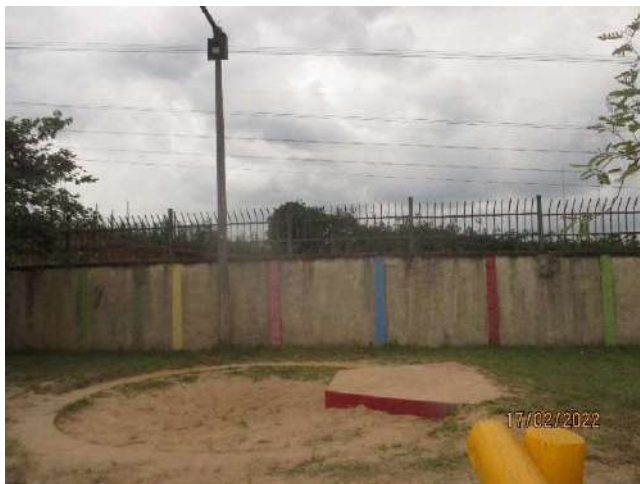
FOTO 19 MURO FACHADA POSTERIOR COM COM DESCOLORAÇÃO NA PINTURA E MANCHAS DE
