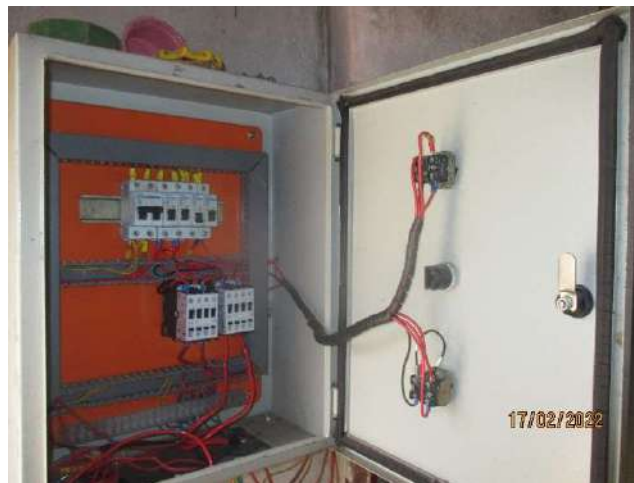
FOTO 14 RESERVATÓRIO DE ÁGUA QUADRO DISJUNTORES
