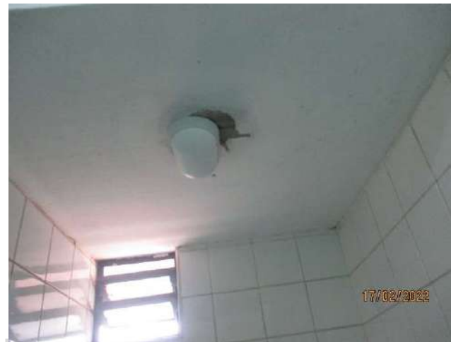
FOTO 54 SANITÁRIO ALUNO FEMININO TERREO COM TRINCAS E SUJIDADES
