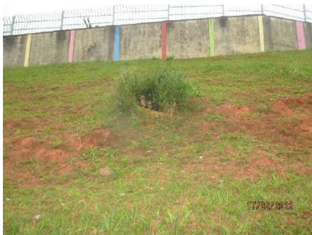
FOTO 21 MURO LATERAL ESQUERDA COM DESCOLORAÇÃO NA PINTURA E MANCHAS DE
