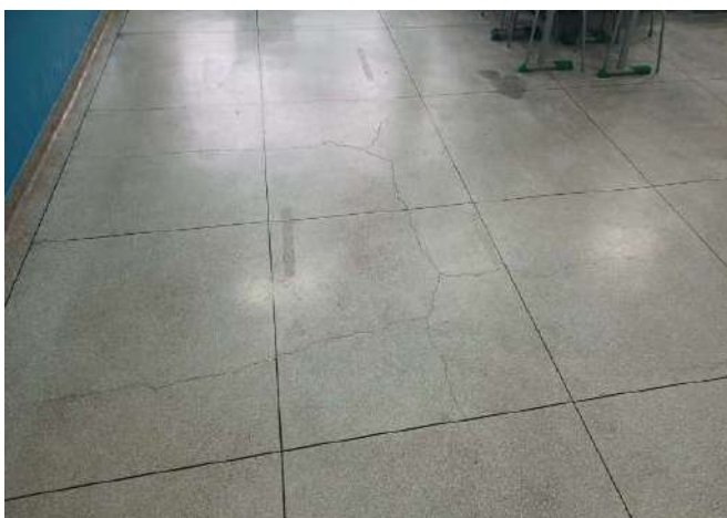
FOTO 267 SALA DE AULA 15 COM FISSURAS NO PISO
