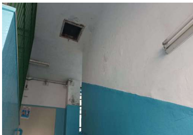
FOTO 298 ESCADARIA COM INFILTRAÇÃO
