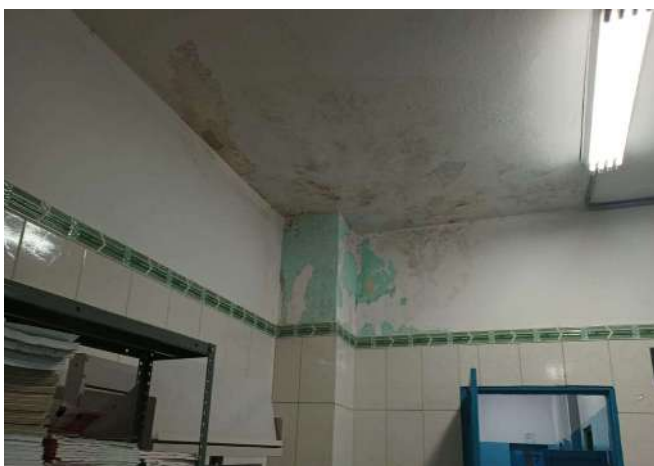
FOTO 159 SALA DE AULA 6 COM INFILTRAÇÃO
