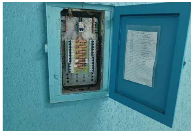
FOTO 188 QUADRO DE DISTRIBUIÇÃO DE LUZ
