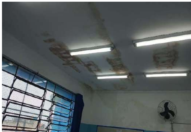
FOTO 200 SALA DE AULA 1 COM INFILTRAÇÃO
