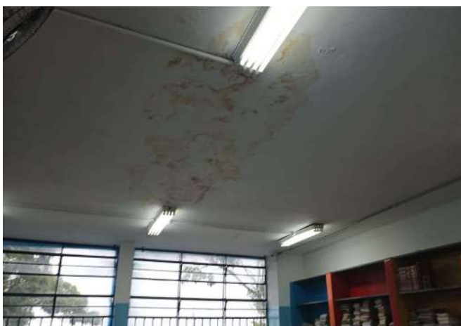
FOTO 225 SALA DE LEITURA COM INFILTRAÇÃO
