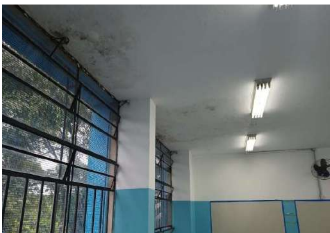
FOTO 291 SALA DE AULA 16 COM INFILTRAÇÃO
