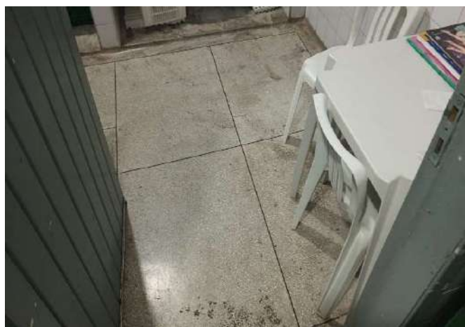
FOTO 142 DEPÓSITO DE MERENDA COM FISSURAS NO PISO
