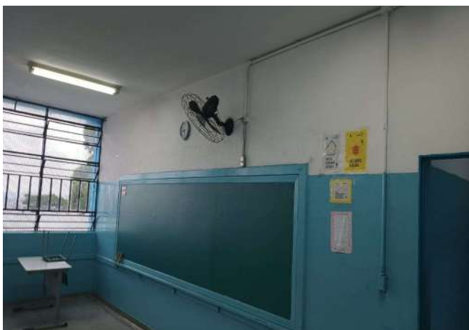
FOTO 293 SALA DE AULA 16 COM IMPROVISOS NA ELÉTRICA
