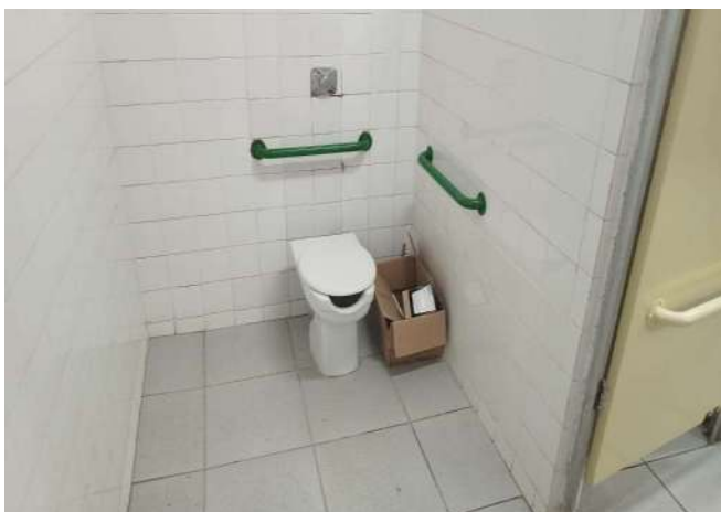
FOTO 119 BANHEIRO FEMININO DE ALUNOS COM FISSURA NOS REVESTIMENTOS
