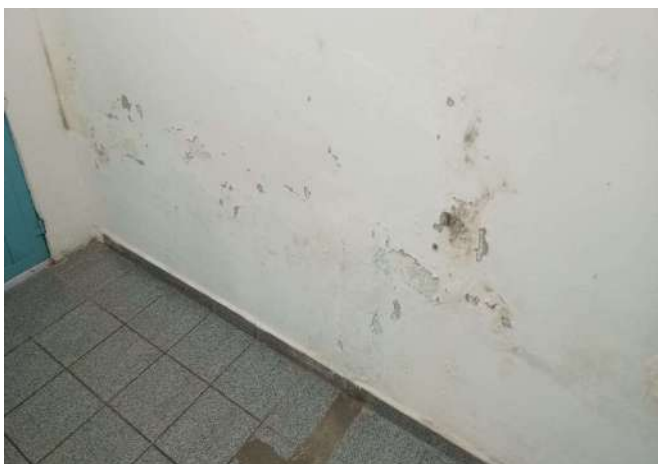
FOTO 59 SECRETARIA COM SUJIDADES NAS PAREDES
