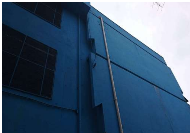
FOTO 86 FACHADA LATERAL DIREITA COM INFILTRAÇÃO
