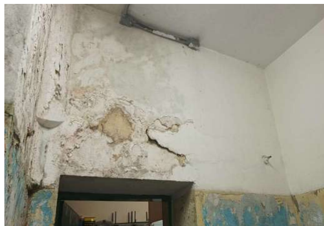
FOTO 66 DEPÓSITO DO PÁTIO COM INFILTRAÇÃO
