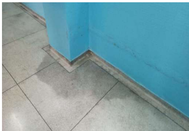
FOTO 288 CORREDOR DE SALA DE AULA COM INFILTRAÇÃO
