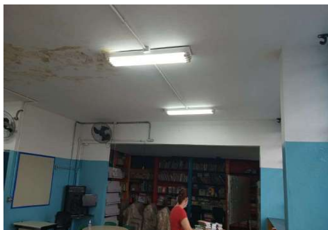
FOTO 226 SALA DE LEITURA COM INFILTRAÇÃO
