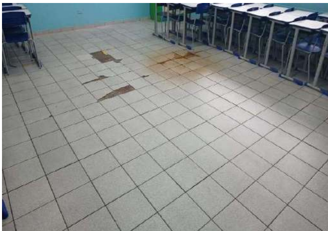
FOTO 205 SALA DE AULA 1 COM PISO DANIFICADO
