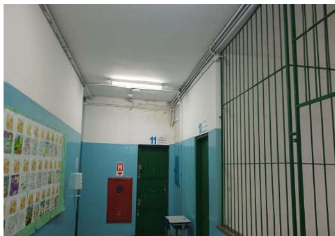
FOTO 222 CORREDORES SEM EXTINTORES, ALARME E BOTOEIRA DO SISTEMA DE INCÊNDIO
