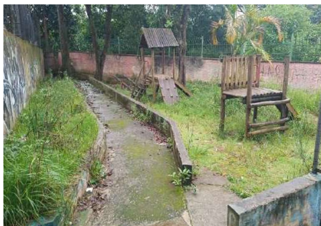
FOTO 88 PLAY GROUND COM FISSURAS NO PISO
