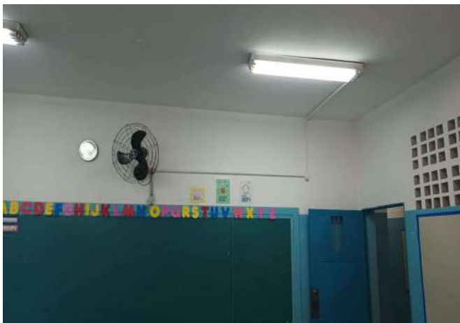
FOTO 175 SALA DE AULA 5 COM IMPROVISOS NA ELÉTRICA
