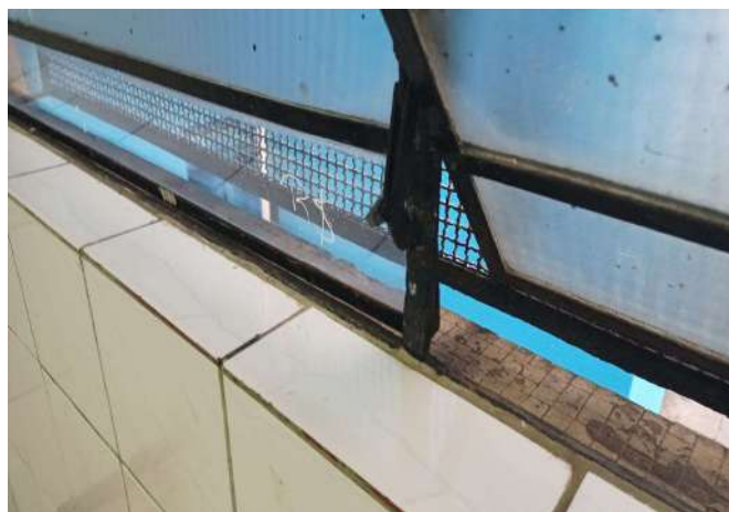
FOTO 180 SALA DE AULA 9 COM CAIXILHOS DANFICADOS
