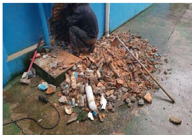
FOTO 78 FACHADA LATERAL DIREITA VAZAMENTO NA PRUMADA DE HIDRÁULICA
