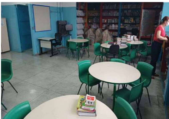
FOTO 227 SALA DE LEITURA COM FISSURAS NO PISO
