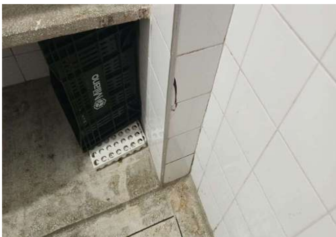
FOTO 143 DEPÓSITO DE MERENDA COM REVESTIMENTOS QUEBRADOS E SOLTOS
