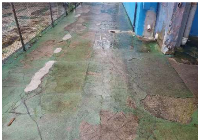
FOTO 90 ACESSO A QUADRA DE ESPORTES COM FISSURAS NO PISO
