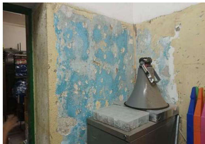
FOTO 68 DEPÓSITO DO PÁTIO COM INFILTRAÇÃO
