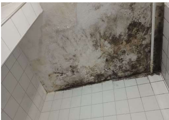
FOTO 147 DEPÓSITO DE MERENDA COM INFILTRAÇÃO
