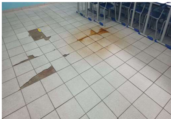
FOTO 198 SALA DE AULA 1 COM DESTACAMENTO DO PISO
