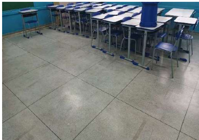
FOTO 194 SALA DE AULA 1 COM FISSURAS NO PISO
