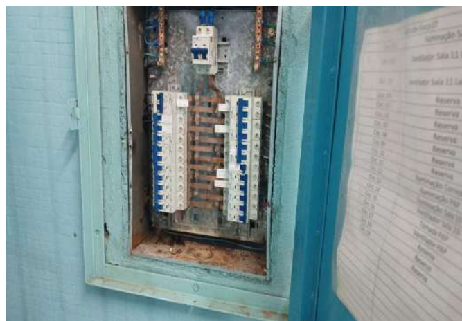
FOTO 232 QUADRO DE DISTRIBUIÇÃO DE LUZ
