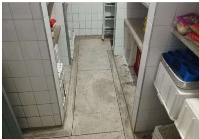
FOTO 144 DEPÓSITO DE MERENDA COM FISSURAS NO PISO
