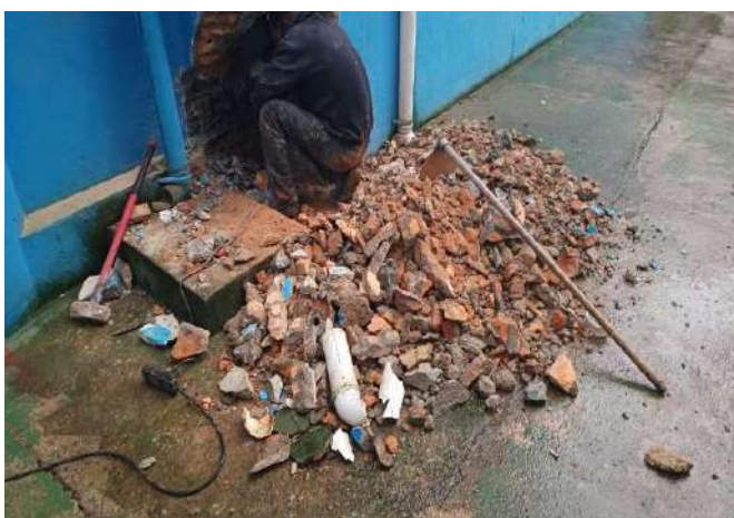
FOTO 77 FACHADA LATERAL DIREITA VAZAMENTO NA PRUMADA DE HIDRÁULICA
