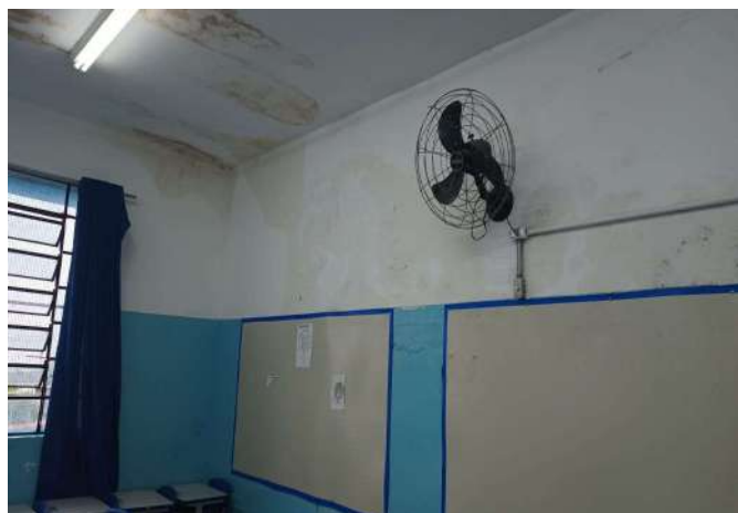
FOTO 204 SALA DE AULA 1 COM INFILTRAÇÃO
