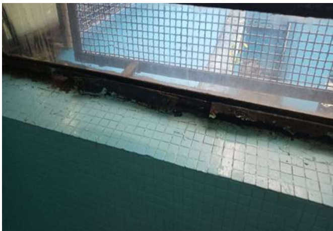
FOTO 295 CORREDOR COM CAIXILHOS DANIFICADOS
