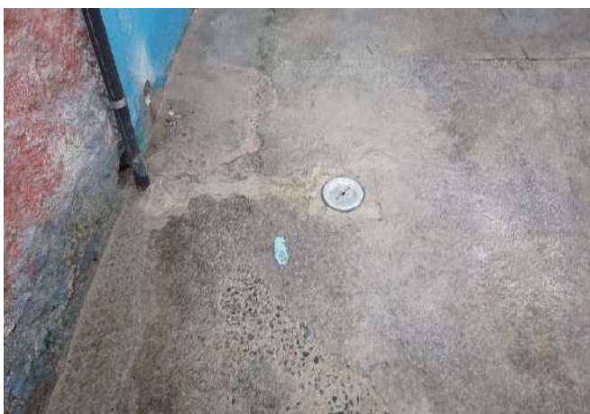
FOTO 305 ESTACIONAMENTO COM FISSURA NO PISO
