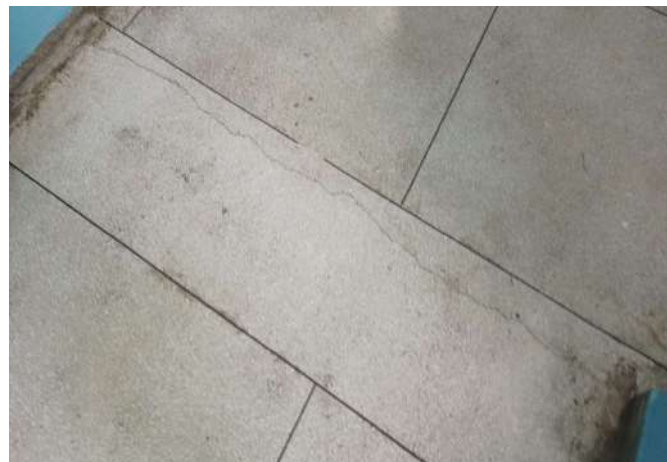
FOTO 230 CORREDORES COM FISSURAS NO PISO
