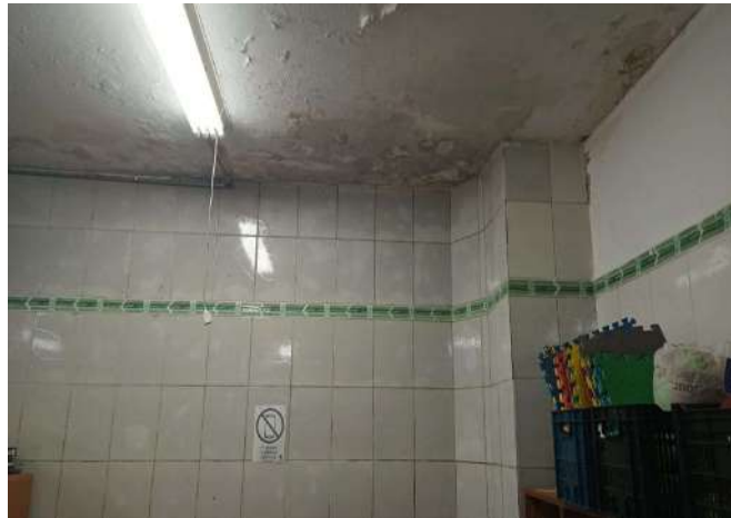
FOTO 158 SALA DE AULA 6 COM INFILTRAÇÃO
