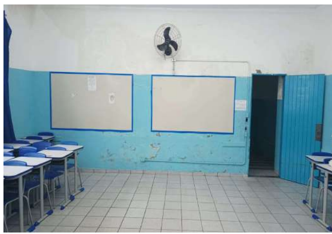
FOTO 202 SALA DE AULA 1 COM DESTACAMENTO DAS PAREDES
