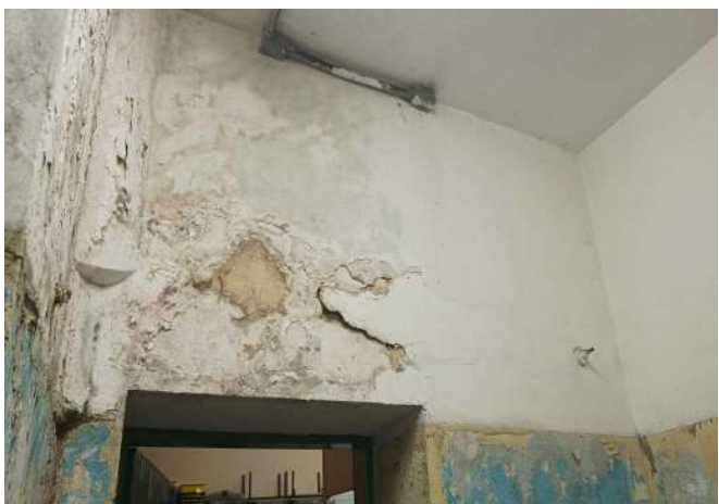
FOTO 65 DEPÓSITO DO PÁTIO COM INFILTRAÇÃO
