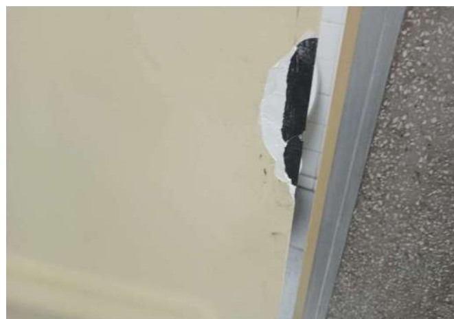
FOTO 118 BANHEIRO FEMININO DE ALUNOS COM PORTA DANIFICADA
