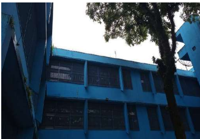
FOTO 303 FACHADA LATERAL ESQUERDA COM INFILTRAÇÃO NA VIGA CALHA
