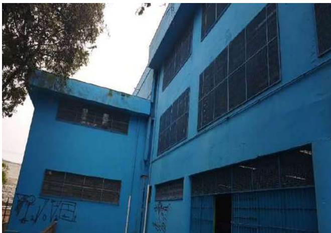
FOTO 85 FACHADA LATERAL DIREITA COM FISSURA
