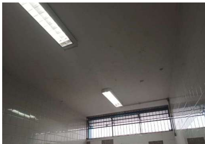
FOTO 36 BANHEIRO MASCULINO COM DESTACAMENTO NO TETO
