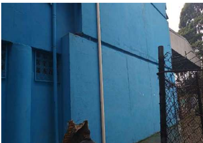
FOTO 87 FACHADA LATERAL DIREITA COM INFILTRAÇÃO
