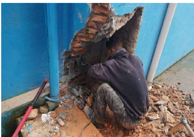
FOTO 75 FACHADA LATERAL DIREITA VAZAMENTO NA PRUMADA DE HIDRÁULICA
