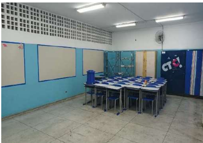
FOTO 179 SALA DE AULA 9 COM IMPROVISOS NA ELETTRICA
