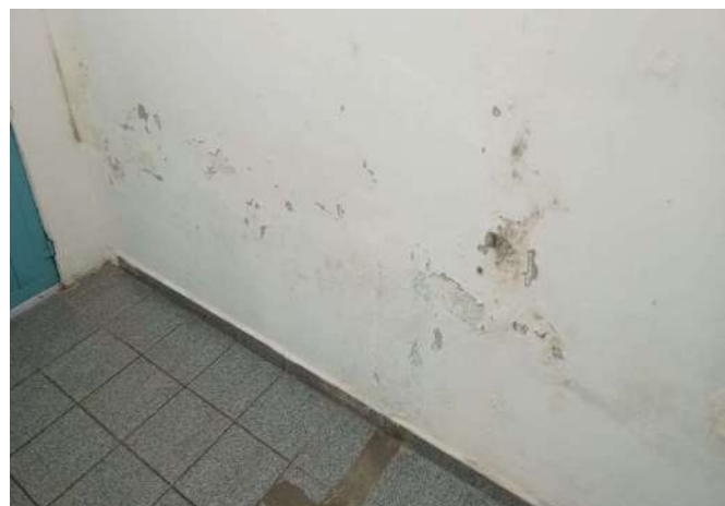
FOTO 60 SECRETARIA COM DESTACAMENTO DO REVESTIMENTO DAS PAREDES
