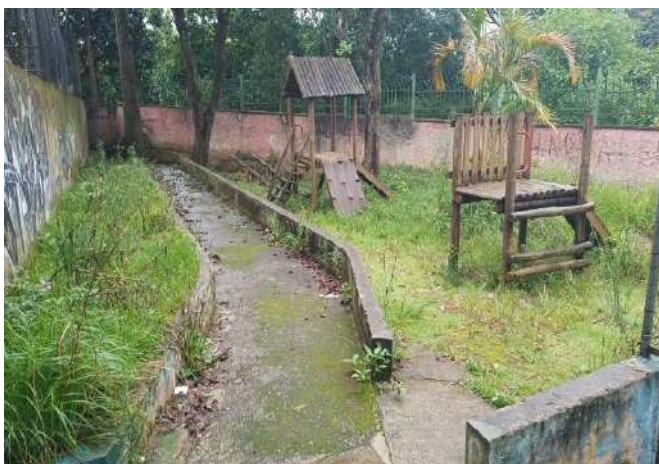
FOTO 89 PLAY GROUND COM FISSURAS NO PISO
