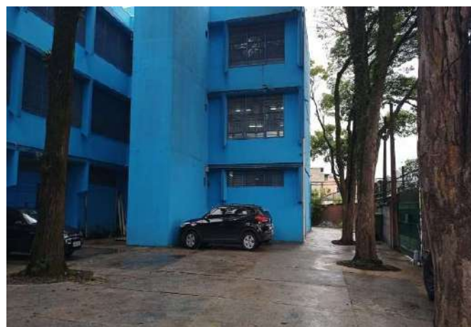
FOTO 302 ESTACIONAMENTO COM FISSURA NO PISO
