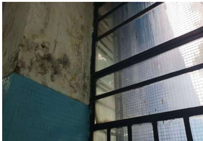
FOTO 296 CORREDOR COM INFILTRAÇÃO
