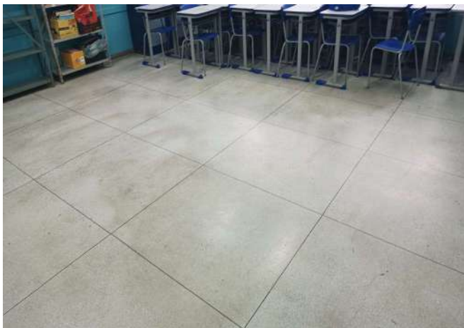
FOTO 247 SALA DE AULA 13 COM FISSURA NO PISO
