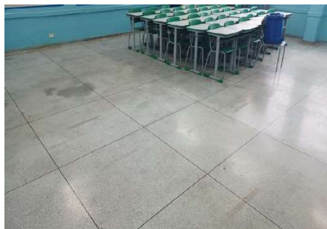
FOTO 292 SALA DE AULA 16 COM FISSURAS NO PISO
