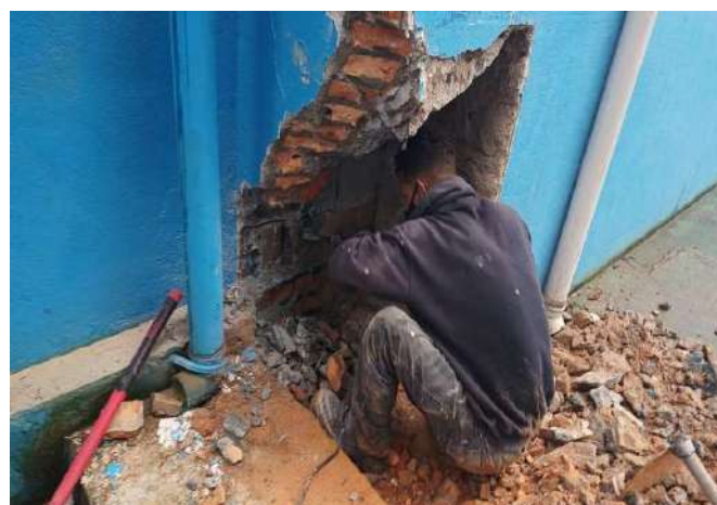
FOTO 76 FACHADA LATERAL DIREITA VAZAMENTO NA PRUMADA DE HIDRÁULICA
