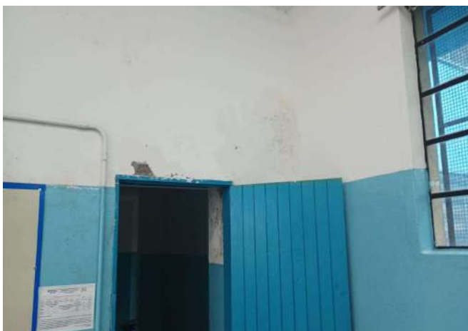
FOTO 203 SALA DE AULA 1 COM INFILTRAÇÃO
