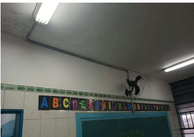
FOTO 160 SALA DE AULA 6 COM IPROVISOS NA ELÉTRICA
