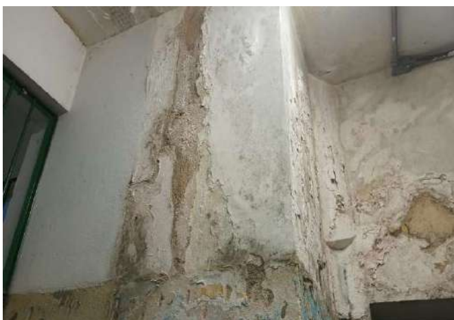
FOTO 63 DEPÓSITO DO PÁTIO COM INFILTRAÇÃO
