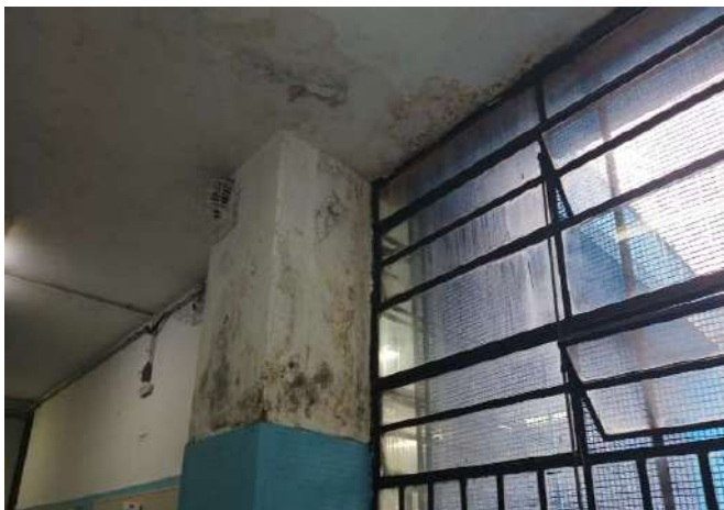
FOTO 289 CORREDOR DE SALA DE AULA COM INFILTRAÇÃO
