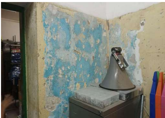
FOTO 67 DEPÓSITO DO PÁTIO COM INFILTRAÇÃO
