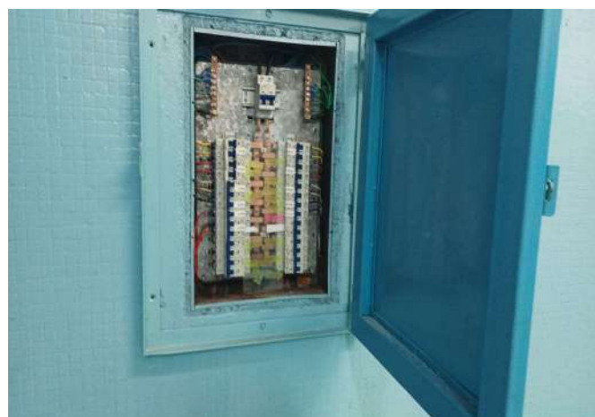
FOTO 192 QUADRO DE DISTRIBUIÇÃO DE LUZ
