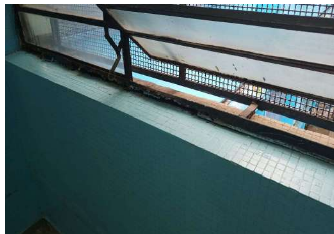
FOTO 294 SALA DE AULA 16 COM CAIXILHOS DANIFICADOS
