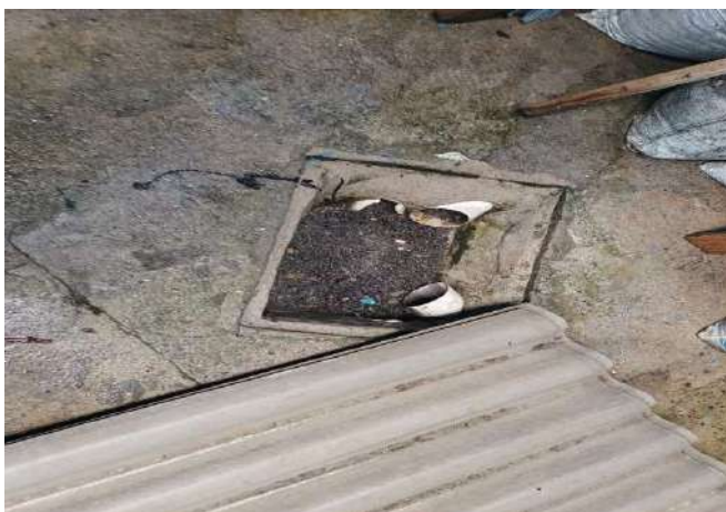
FOTO 299 ESTACIONAMENTO COM CAIXA DE INSPEÇÃO DANIFICADA
