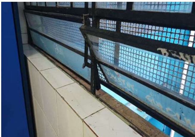
FOTO 181 SALA DE AULA 9 COM CAIXILHOS DANIFICADOS
