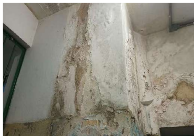
FOTO 64 DEPÓSITO DO PÁTIO COM INFILTRAÇÃO
