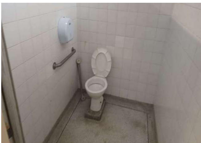
FOTO 285 SANITÁRIO DE ALUNOS FEMININO COM FISSURAS NOS REVESTIMENTOS
