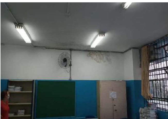
FOTO 195 SALA DE AULA 1 COM INFILTRAÇÃO
