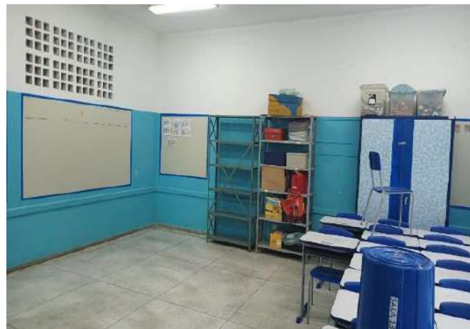
FOTO 248 SALA DE AULA 13 COM SUJIDADES NO TETO E PAREDES
