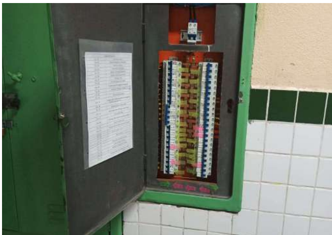
FOTO 49 QUADRO DE DISTRIBUIÇÃO DE LUZ
