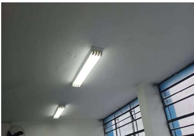
FOTO 269 SALA DE AULA 15 COM SUJIDADES
