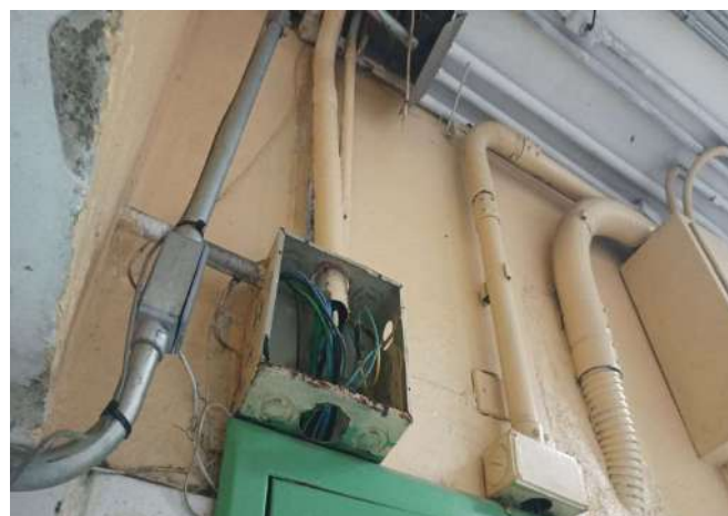
FOTO 52 PÁTIO IMPROVISSOS NA ELÉTRICA
