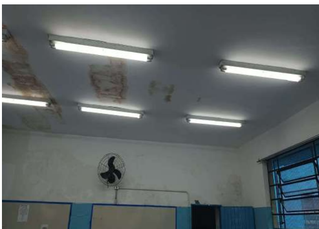
FOTO 201 SALA DE AULA 1 COM INFILTRAÇÃO
