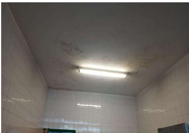
FOTO 287 SANITÁRIO DE ALUNOS FEMININO COM INFILTRAÇÃO
