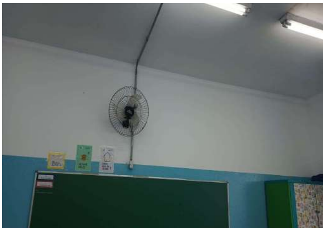
FOTO 199 SALA DE AULA 1 COM IMPROVISOS NA ELÉTRICA
