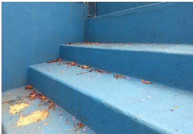
FOTO 115 ARQUIBANCADA COM TRINCA
