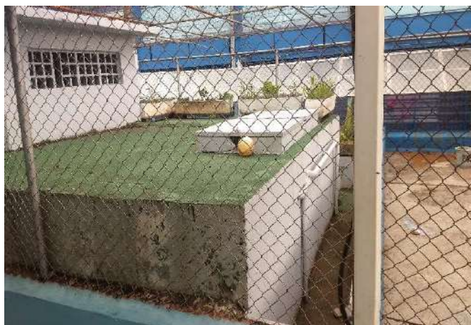
FOTO 119 RESERVATÓRIO PAREDE COM MANCHAS DE BOLOR
