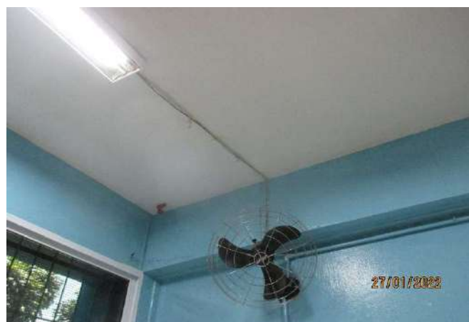
FOTO 30 FIAÇÃO EXPOSTA LAB. DE INFORMÁTICA
