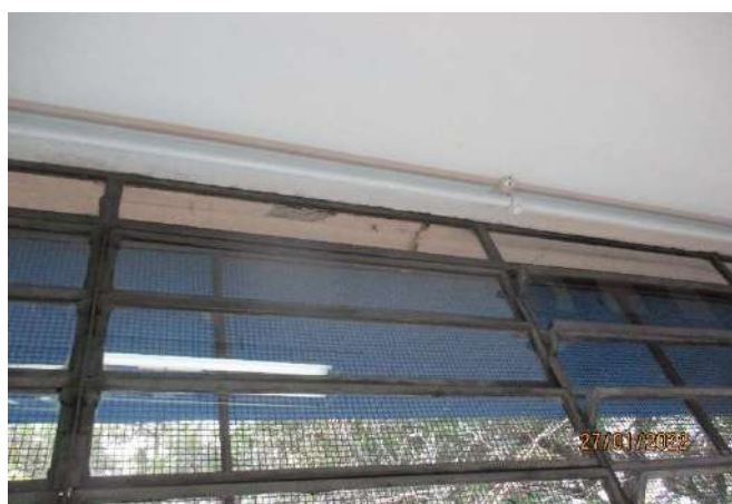
FOTO 75 SALA DE AULA 8 ESQUADRIA COM CORROSÃO, PAREDE COM SUJIDADES, TRINCA E MANCHAS
