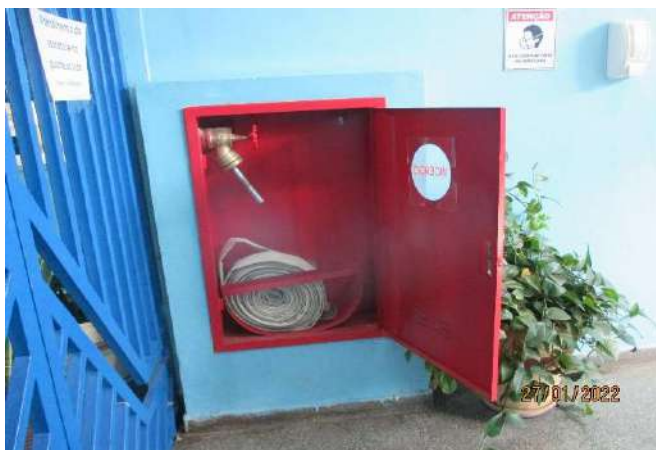
FOTO 7 HIDRANTE HALL PRINCIPAL
