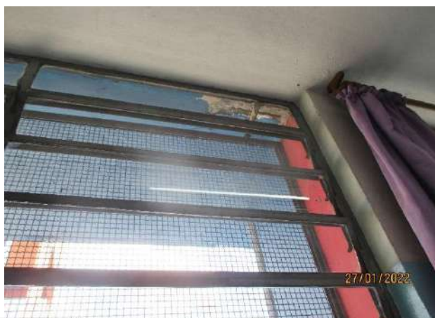
FOTO 63 SALA DE AULA 3 ESQUADRIA COM CORROSÃO, SUJIDADES E MANCHAS DE BOLOR
