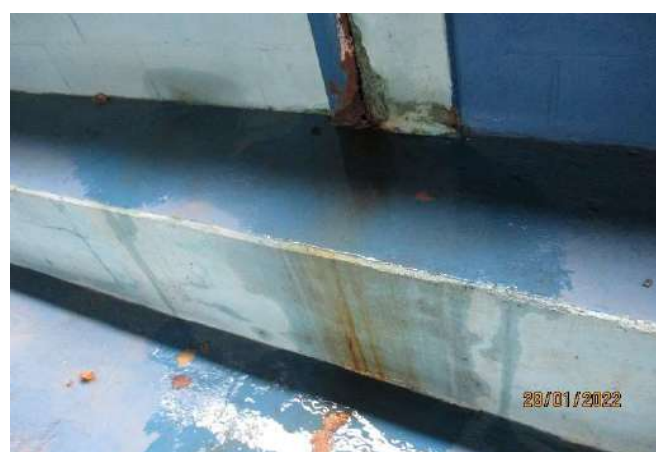
FOTO 124 PILAR METÁLICO QUADRA DE ESPORTES COBERTA COM CORROSÃO
