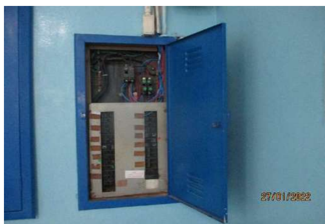
FOTO 10 QUADRO DISJUNTORES HALL PRINCIPAL
