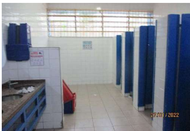
FOTO 33 SANITÁRIO MASCULINO ALUNOS ESQUADRIA COM CORROSÃO
