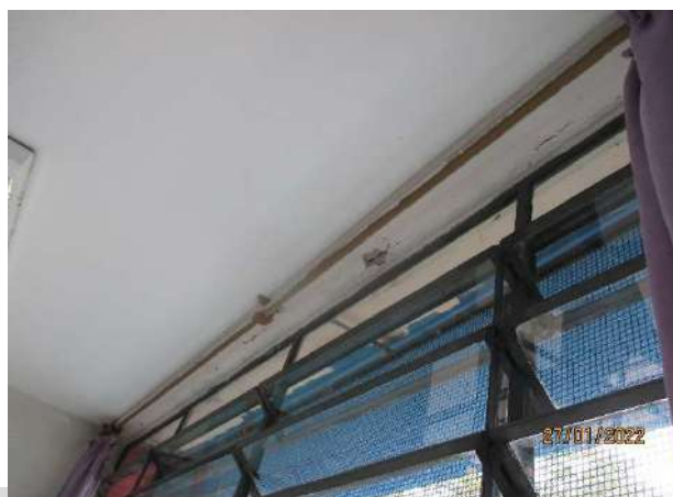
FOTO 66 SALA DE AULA 10 COM INFILTRAÇÃO
