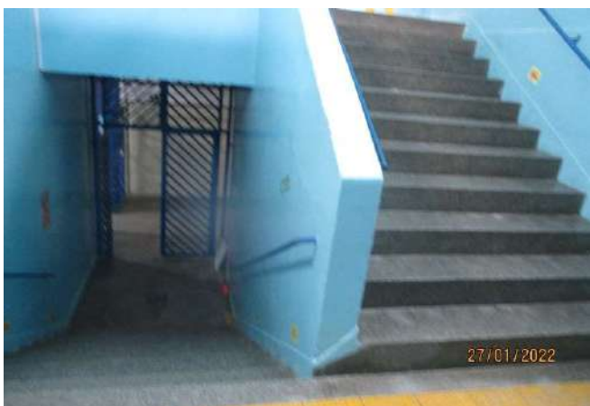
FOTO 51 ACESSO PISO SUPERIOR ESCADA SEM FITA ANTIDERRAPANTE
