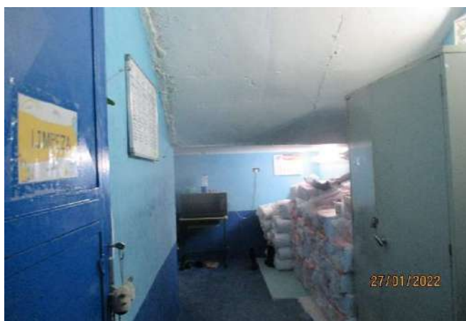
FOTO 35 DEPÓSITO 3 PAREDE COM MANCHAS DE BOLOR E SUJIDADES
