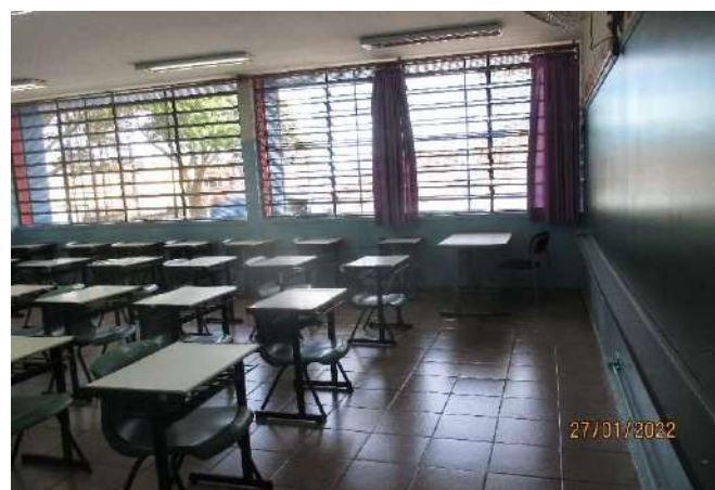
FOTO 59 SALA DE AULA 2 ESQUADRIA COM CORROSÃO
