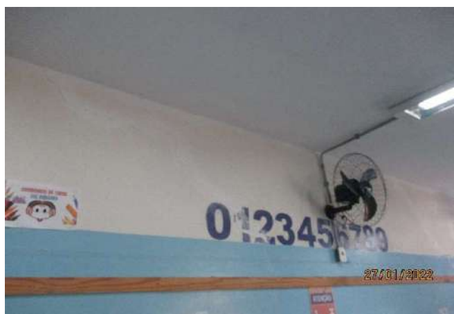
FOTO 71 SALA DE AULA 9 COM SUJIDADES E MANCHAS DE BOLOR
