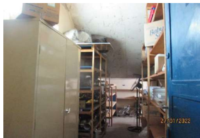
FOTO 24 DEPÓSITO DE MATERIAIS PAREDE COM MANCHAS DE BOLOR E SUJIDADES
