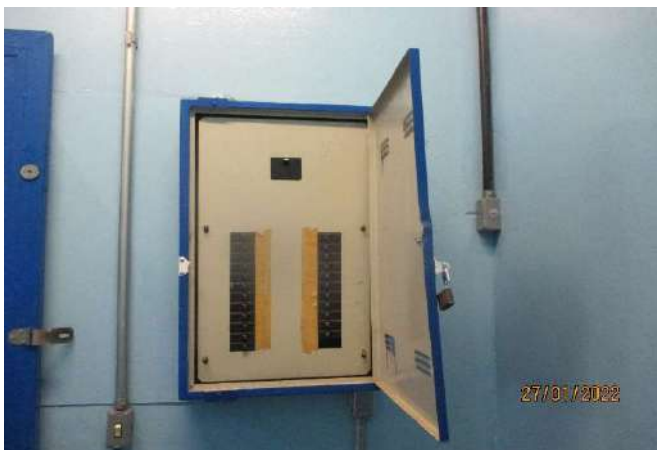
FOTO 73 QUADRO DISJUNTORES - DEPÓSITO 1
