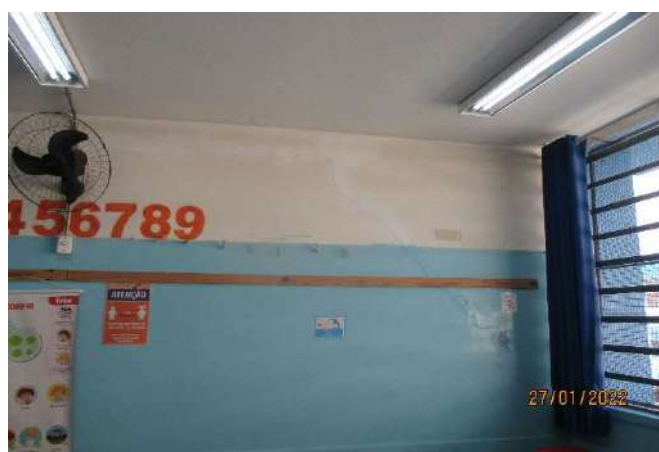
FOTO 78 SALA DE AULA 9 COM TRINCA, SUJIDADES E MANCHAS DE BOLOR
