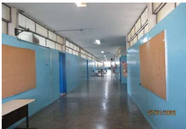
FOTO 53 CORREDOR SEGUNDO PAVIMENTO PAREDE COM SUJIDADES
