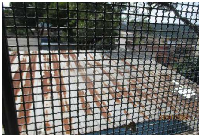
FOTO 56 TELHADO BRINQUEDOTECA COM SUJEIDADES E CORROSÃO
