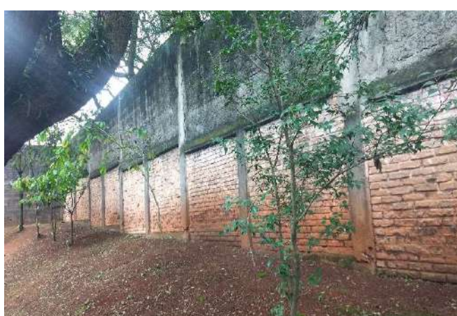
FOTO 126 MURO DIVISA COM MANCHAS DE BOLOR
