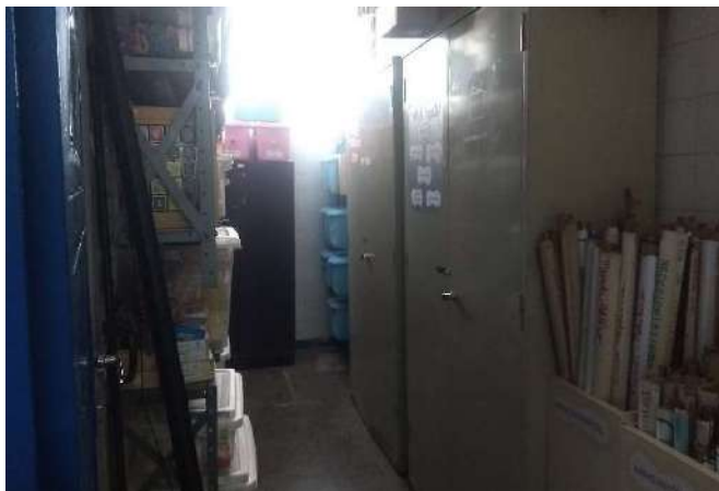
FOTO 121 SALA DE JOGOS PEDAGÓGICOS PAREDES COM SUJIDADES
