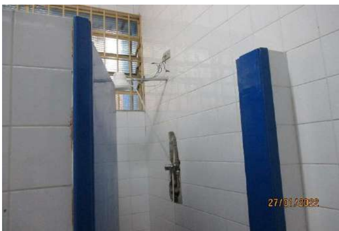
FOTO 45 VESTIÁRIO FEMININO TERCEIRIZADA PAREDE QUEBRADA
