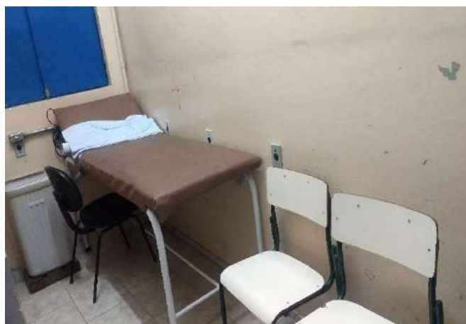
FOTO 120 SALA AUXILIAR DE VIDA ESCOLAR PAREDE COM SUJIDADES
