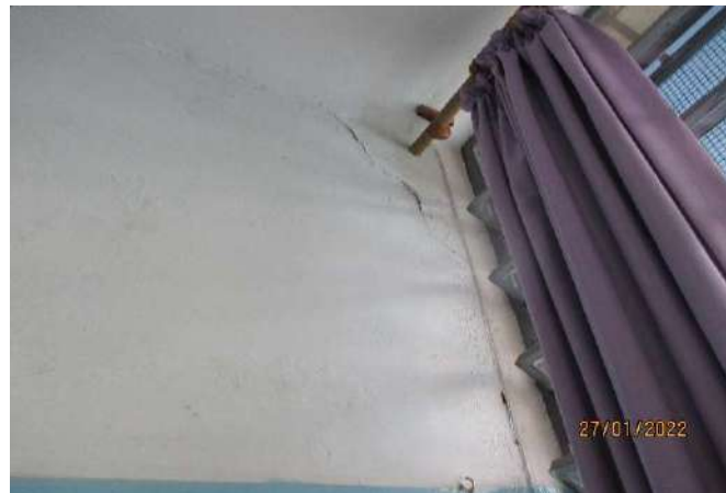
FOTO 68 SALA DE AULA 4 ESQUADRIA COM CORROSÃO, SUJIDADES, MANCHAS DE BOLOR E TRINCAS
