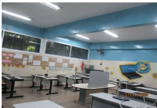
FOTO 29 LABORATÓRIO DE INFORMÁTICA PAREDE COM MANCHAS DE BOLOR E SUJIDADES
