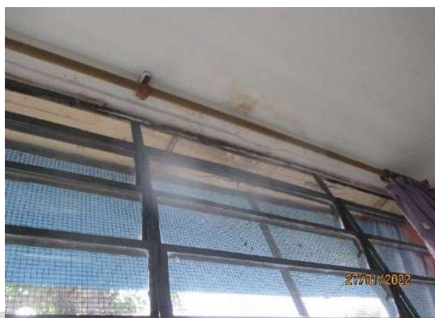
FOTO 65 SUJIDADES E MANCHAS DE BOLOR
