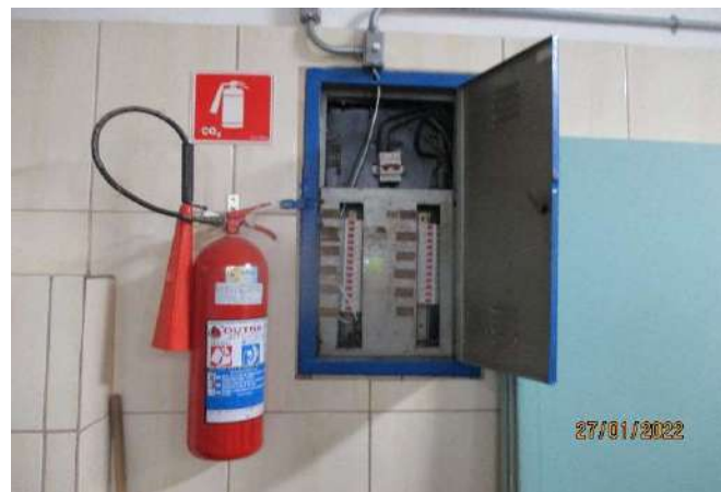
FOTO 46 QUADRO DISJUNTORES REFEITÓRIO
