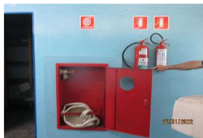
FOTO 60 HIDRANTE SEGUNDO PAVIMENTO
