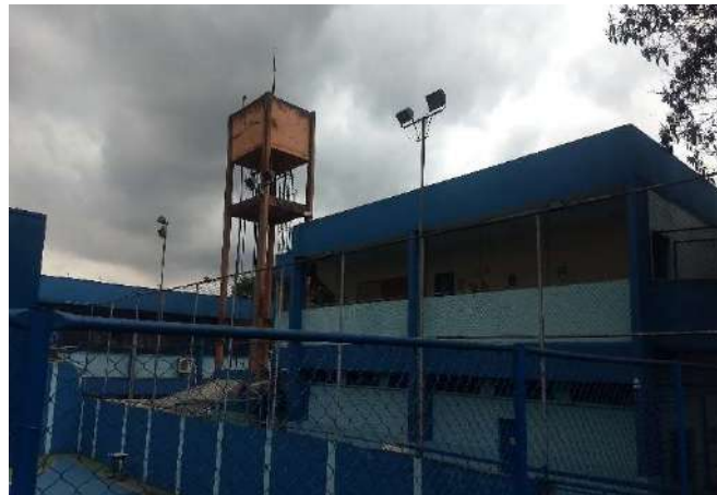
FOTO 116 RESERVATÓRIO COM MANCHAS DE BOLOR
