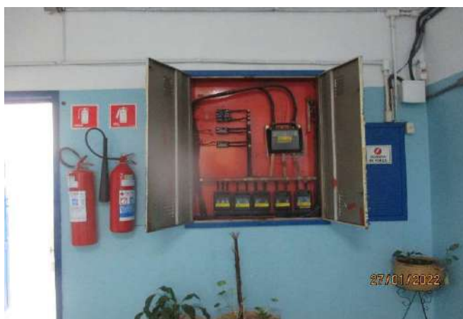
FOTO 9 QUADRO ENERGIA HALL PRINCIPAL
