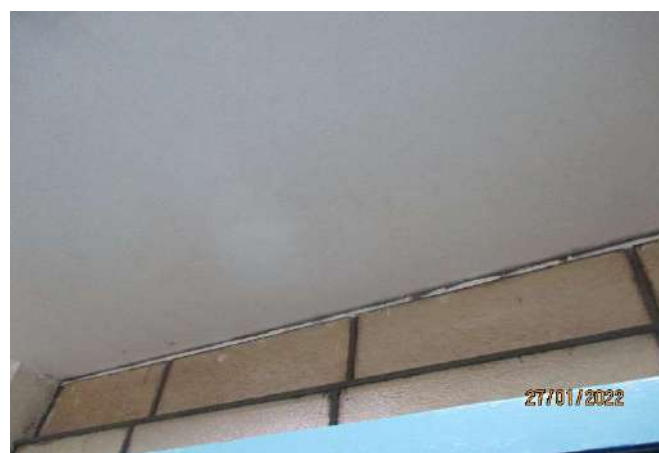
FOTO 76 SALA DE AULA 8 COM INFILTRAÇÃO
