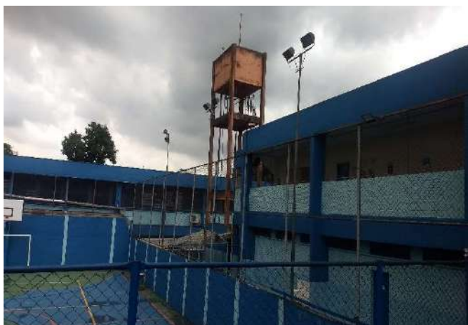
FOTO 117 FACHADA POSTERIOR COM SUJIDADES
