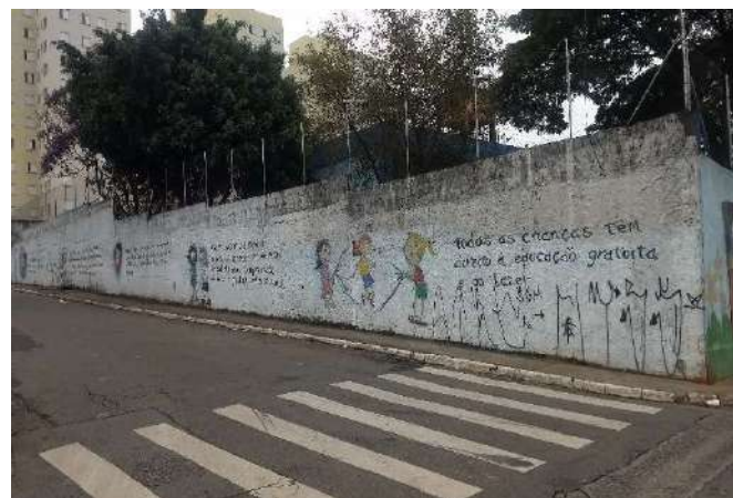
FOTO 4 FACHADA LATERAL, MURO COM PAREDE COM MANCHAS DE BOLOR E SUJIDADES
