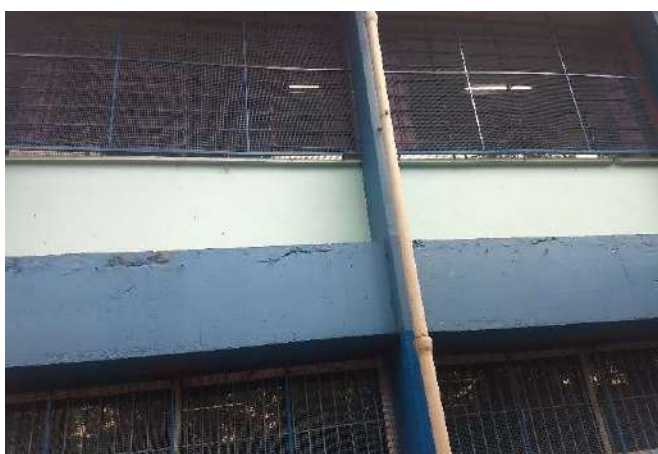
FOTO 125 FACHADA LATERAL DIREITA COM TRINCAS
