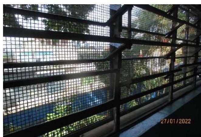
FOTO 58 SALA DE AULA 2 ESQUADRIA COM CORROSÃO
