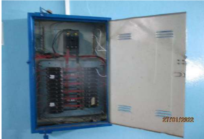
FOTO 52 QUADRO DISJUNTORES PISO SUPERIOR
