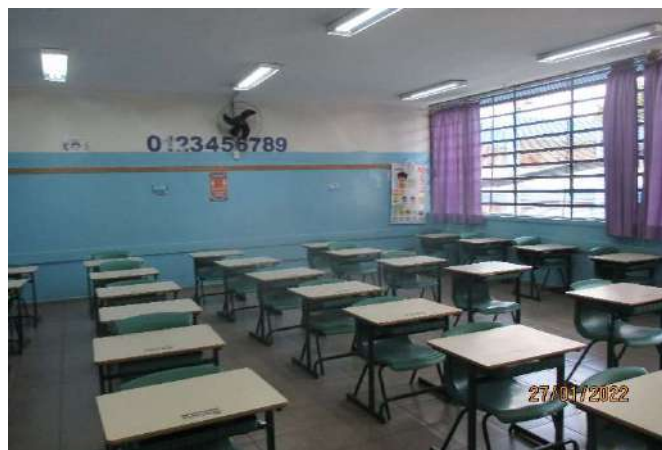
FOTO 70 SALA DE AULA 9 COM MANCHAS DE BOLOR
