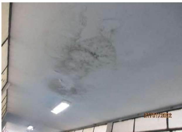
FOTO 61 INFILTRAÇÃO FORRO CORREDOR SUPERIOR
