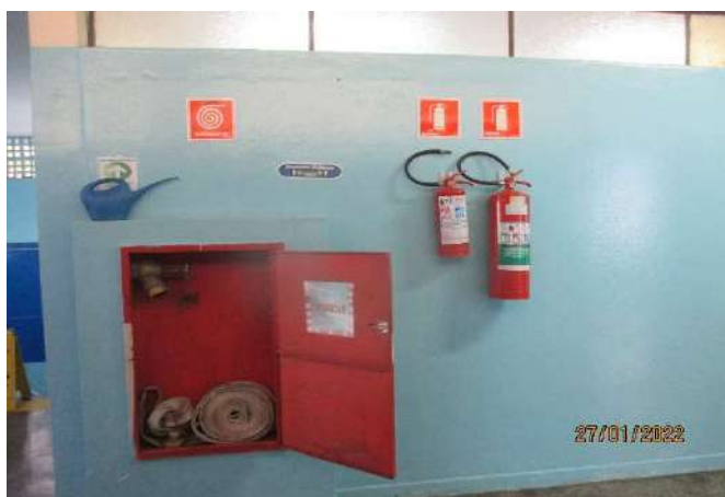
FOTO 72 HIDRANTE 2 - PISO SUPERIOR
