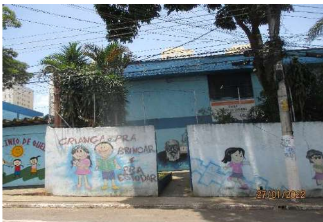
FOTO 1 FACHADA PRINCIPAL PINTURA DESBOTADA
