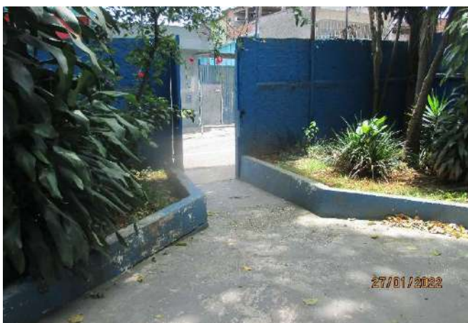
FOTO 5 ACESSO 1 PAREDE COM MANCHAS DE BOLOR E SUJIDADES
