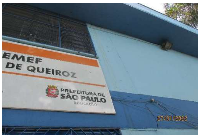
FOTO 3 COMUNICAÇÃO VISUAL, FACHADA PRINCIPAL PAREDE COM MANCHAS DE BOLOR E SUJIDADES
