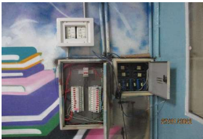
FOTO 25 QUADRO DISJUNTORES PALCO SEM PROTEÇÃO
