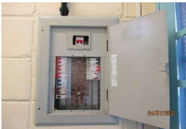
FOTO 13 QUADRO DISJUNTORES HALL PRINCIPAL
