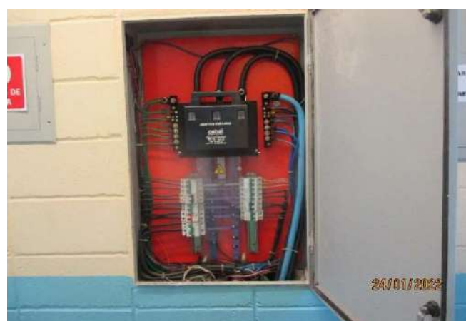
FOTO 14 QUADRO DISJUNTORES HALL PRINCIPAL
