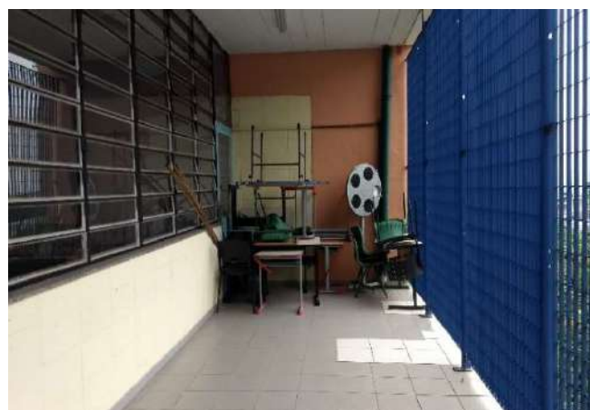
FOTO 105 VARANDA SALA PROFESSORES PAREDE COM SUJIDADES
