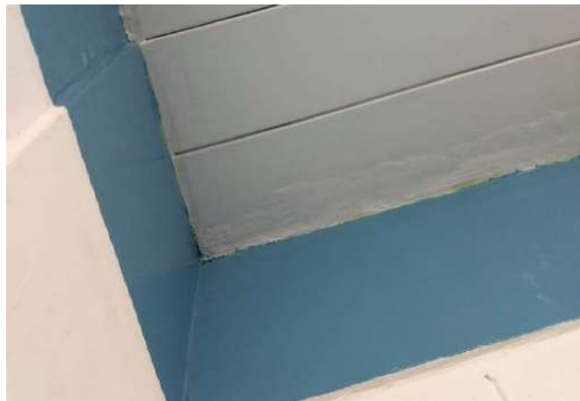
FOTO 104 SALA DOS PROFESSORES FORRO COM INFILTRAÇÃO E SUJIDADES
