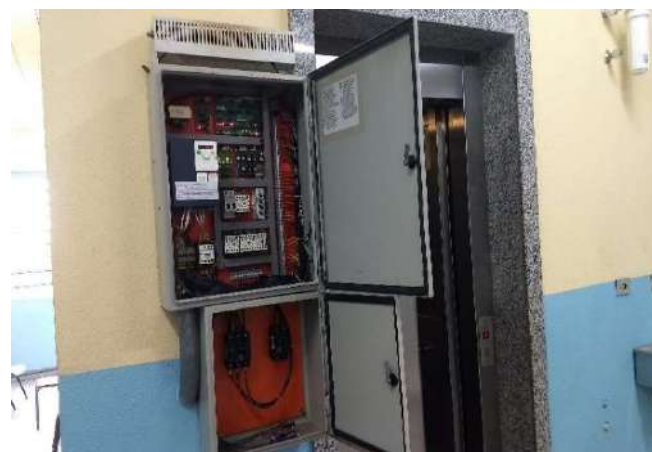
FOTO 113 QUADRO DE ENERGIA DO ELEVADOR
