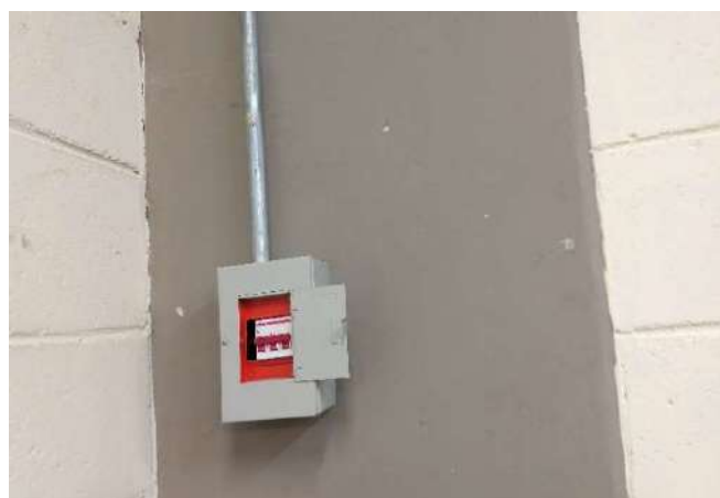
FOTO 125 DISJUNTOR AR CONDICIONADO SALA DE INFORMÁTICA
