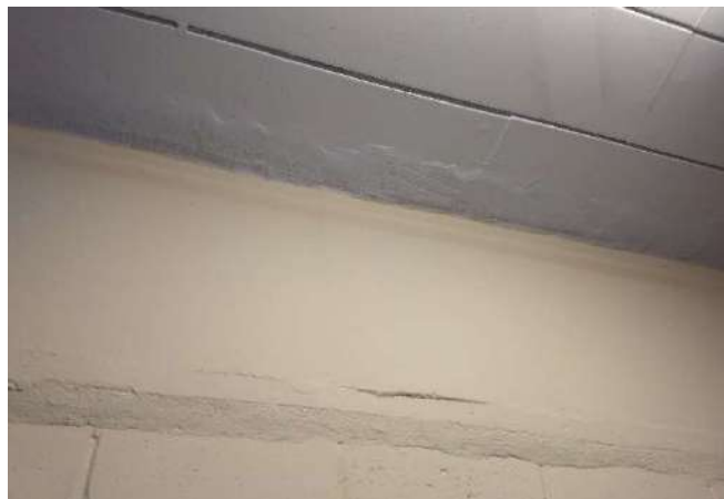
FOTO 74 SALA DE AULA 3 PAREDE COM TRINCA
