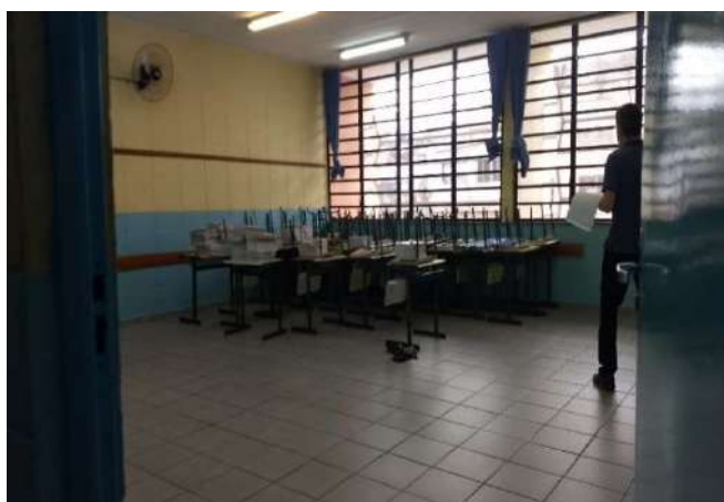
FOTO 99 SALA DE AULA 13 PAREDE COM SUJIDADES
