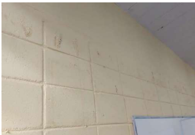
FOTO 101 PAREDE SALA DE AULA 14 PAREDE COM SUJIDADES
