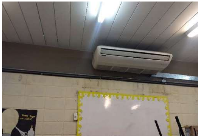
FOTO 124 SALA DE INFORMÁTICA PAREDES COM MANCHA DE BOLOR E SUJIDADES
