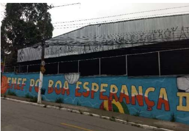
FOTO 5 FACHADA PRINCIPAL QUADRA ESPORTES COBERTA COM CORROSÃO
