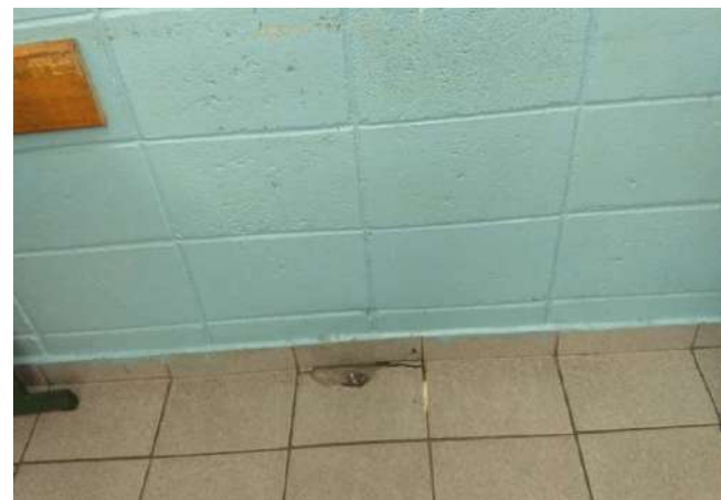
FOTO 102 SALA DE AULA 14 PISO QUEBRADO
