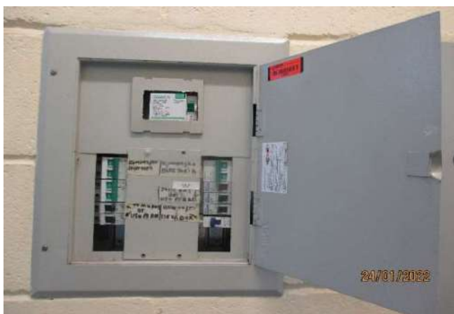
FOTO 15 QUADRO DISJUNTORES HALL PRINCIPAL
