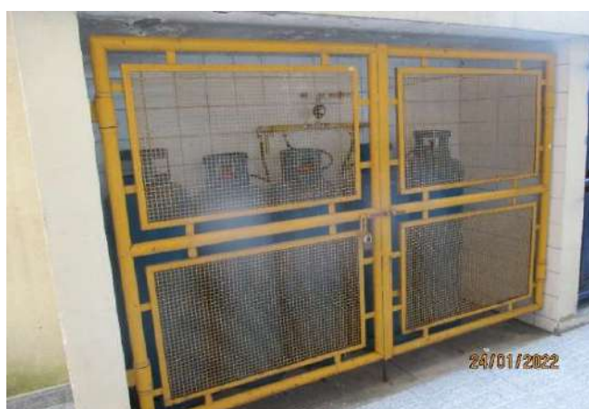
FOTO 62 DEPÓSITO GÁS PAREDE COM MANCHA DE BOLOR
