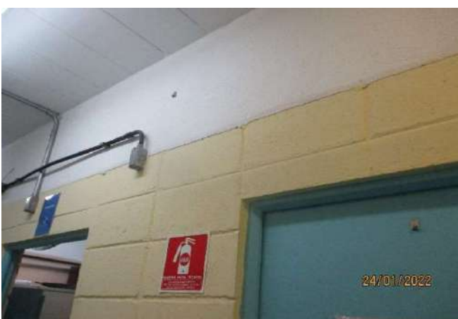
FOTO 17 PAREDE / TETO HALL PRINCIPAL COM SUJIDADES
