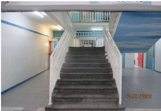
FOTO 52 ACESSO A PAVIMENTO INTERMEDIÁRIO SEM FITA ANTIDERRAPANTE
