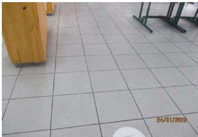
FOTO 61 PISO PÁTIO COBERTO COM TRINCAS
