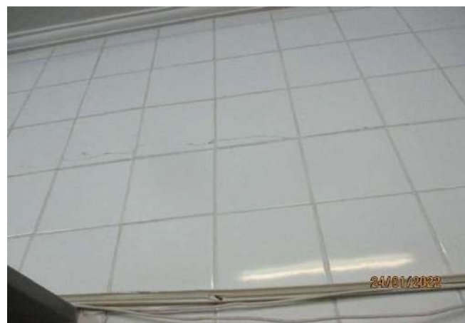
FOTO 60 DISPENSA PAREDES COM TRINCAS
