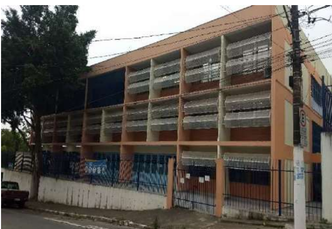
FOTO 3 FACHADA POSTERIOR COM MANCHAS DE BOLOR
