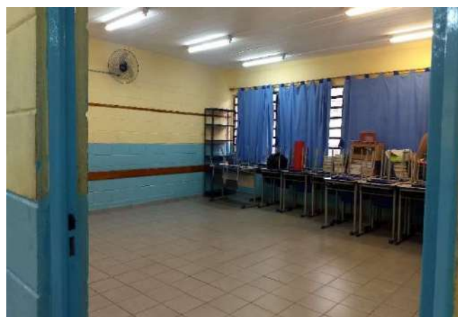
FOTO 76 SALA DE AULA 4 PAREDE COM SUJIDADES
