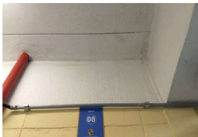
FOTO 78 SALA DE AULA 8 FORRO COM MANCHAS DE BOLOR E INFILTRAÇÃO
