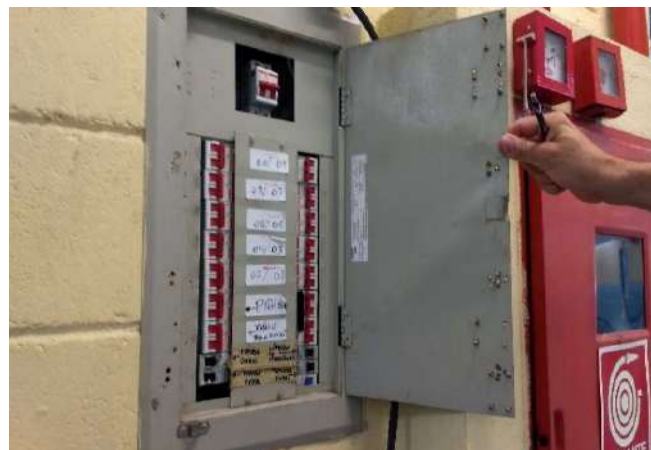
FOTO 80 QUADRO DE DISJUNTORES PISO INTERMEDIÁRIO
