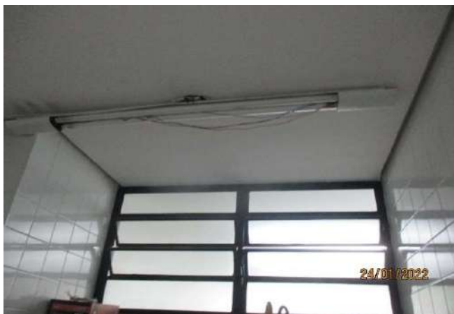
FOTO 51 LUMINÁRIA SANITÁRIO PCD TÊRREO FIAÇÃO APARENTE
