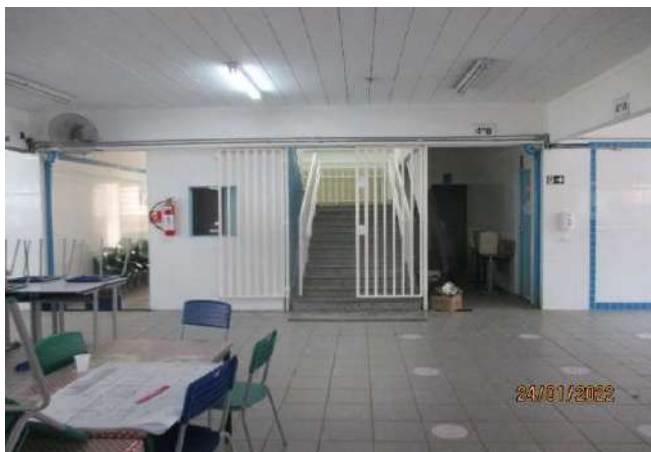
FOTO 53 ACESSO B PAVIMENTO INTERMEDIÁRIO SEM FITA ANTIDERRAPANTE
