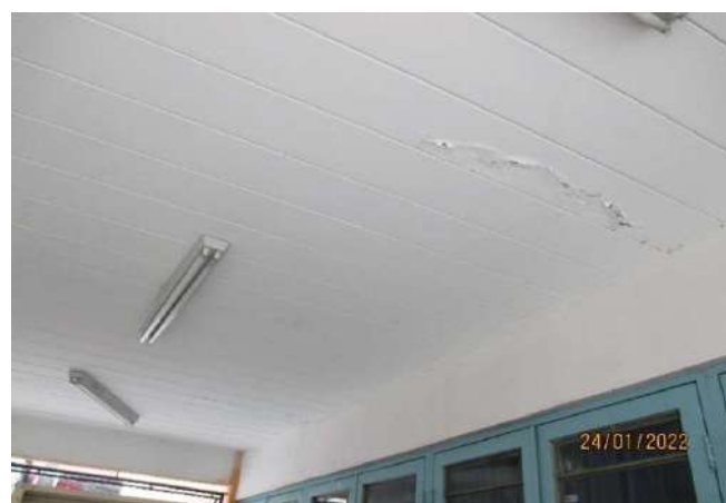
FOTO 41 DEPÓSITO FORRO COM INFILTRAÇÃO
