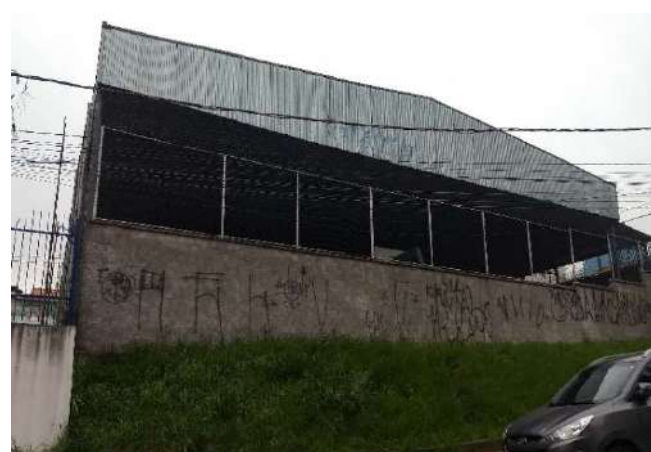
FOTO 6 FACHADA POSTERIOR QUADRA ESPORTES COBERTA COM CORROSÃO
