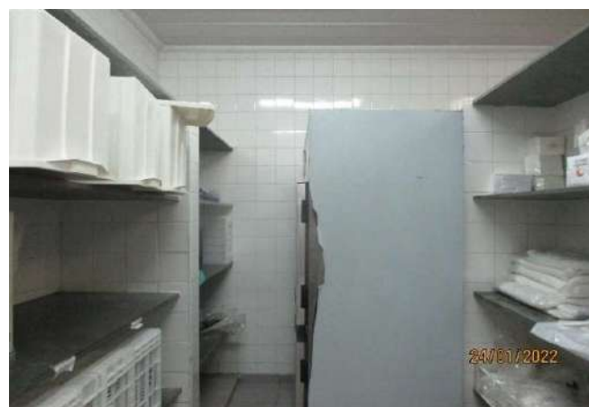
FOTO 58 DISPENSA PAREDES COM TRINCAS
