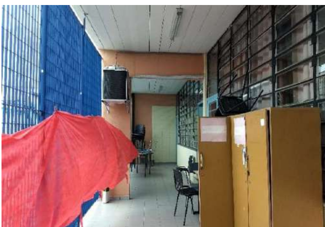
FOTO 106 VARANDA SALA DE VÍDEO PAREDE COM SUJIDADES
