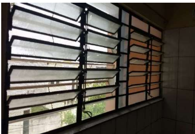
FOTO 83 SALA DE AULA 9 ESQUADRIA COM CORROSÃO
