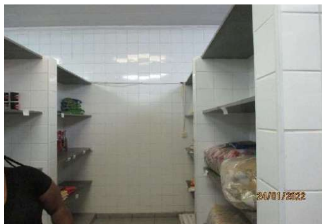
FOTO 57 DISPENSA PAREDES COM TRINCAS
