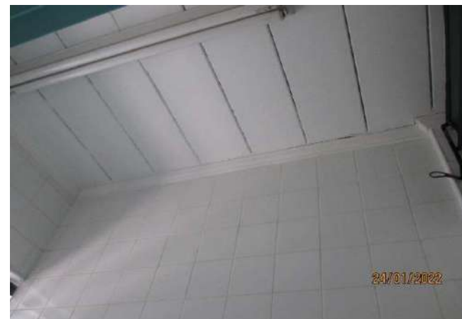
FOTO 10 SANITÁRIO FEMININO FUNCIONÁRIOS COM TRINCAS NO FORRO
