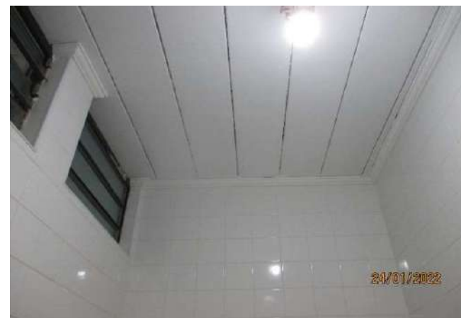
FOTO 12 SANITÁRIO PCD COM FISSURAS NO FORRO
