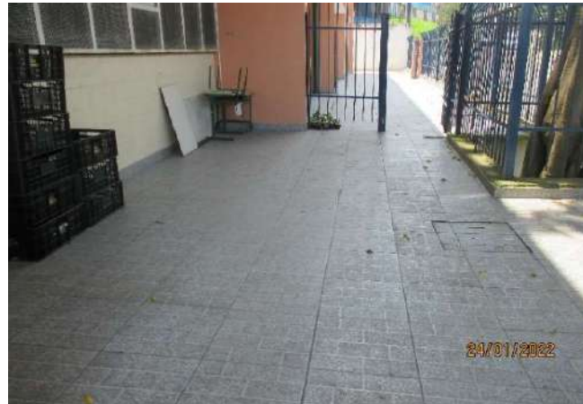
FOTO 64 LATERAL POSTERIOR PAREDE COM SUJIDADES E DESCOLRAÇÃO DA PINTURA
