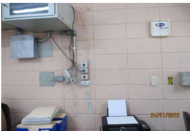
FOTO 21 SECRETARIA PAREDE DESCASCANDO E MANCHAS DE BOLOR
