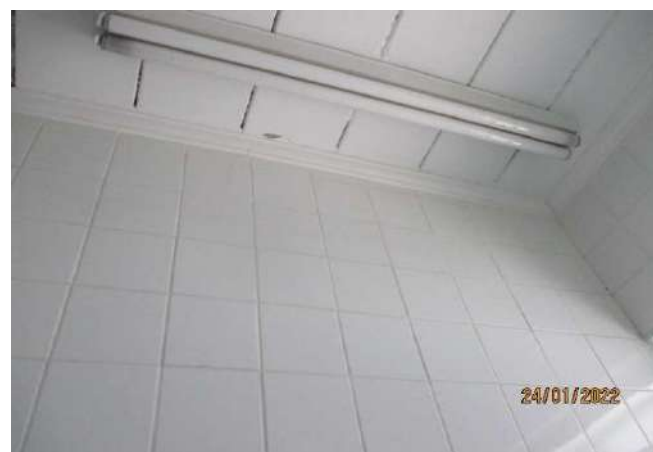
FOTO 24 SANITÁRIO SALA ASSISTENTE DA DIREÇÃO COM FORRO DESCASCANDO
