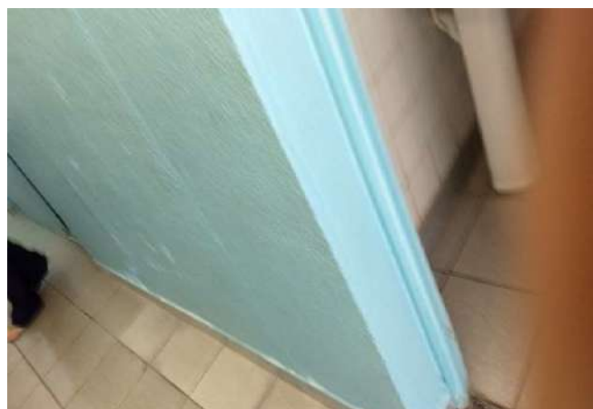
FOTO 116 PAREDE EXTERNA SANITÁRIO UNISEX PISO SUPERIOR
