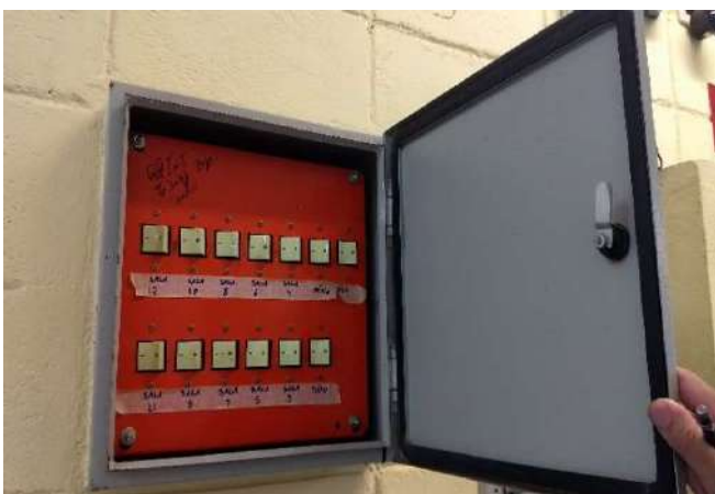
FOTO 81 QUADRO DISJUNTORES PISO INTERMEDIÁRIO
