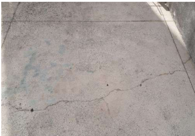
FOTO 25 FISSURAS E TRINCAS NOS PISOS EXTERNOS
