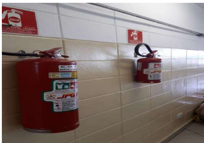
FOTO 3 ESCOLA POSSUI SISTEMA DE EXTINTORES
