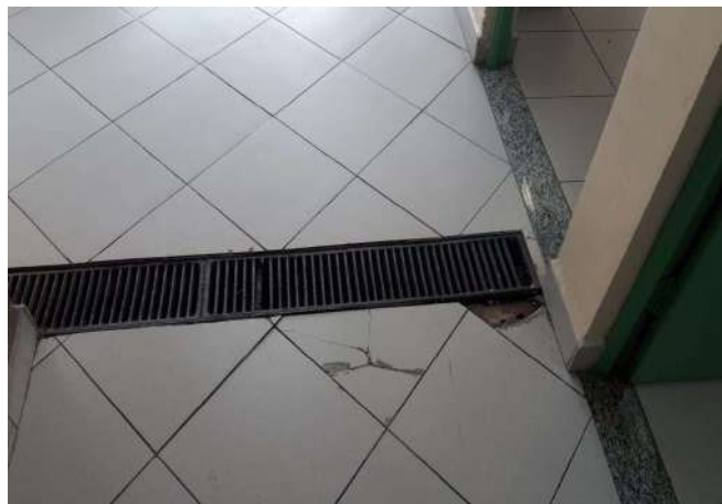
FOTO 8 FISSURAS E TRINCAS NOS PISOS INTERNOS
