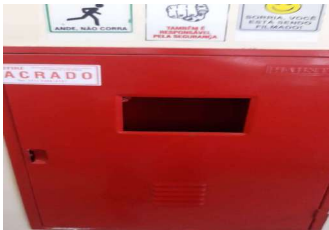
FOTO 1 ESCOLA POSSUI SISTEMA COM HIDRANTES
