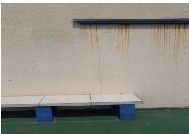
FOTO 15 TRINCAS NAS PAREDES EXTERNAS E ÁREA DA QUADRA
