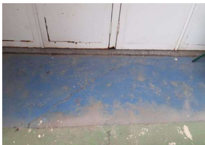
FOTO 12 FISSURAS E TRINCAS NO PISO EXTERNO, PORTAS DE FERRO COM CORROSÃO
