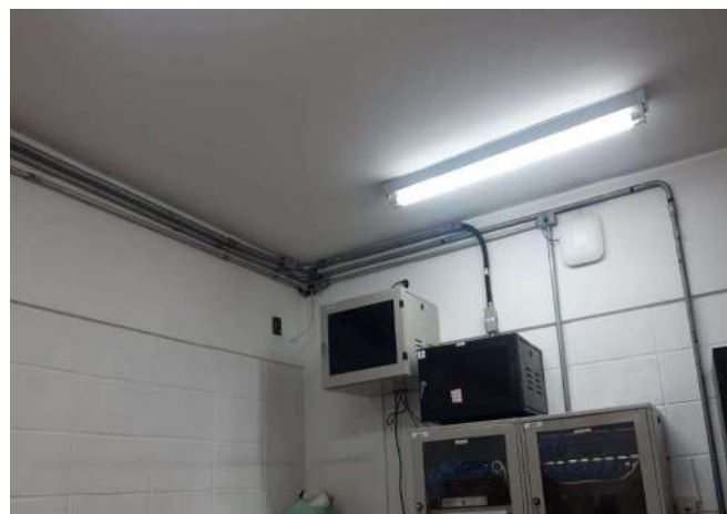
FOTO 18 REVISÃO DA ELÉTRICA, FALTAM ESPELHOS, TOMADAS E HÁ FIOS SOLTOS
