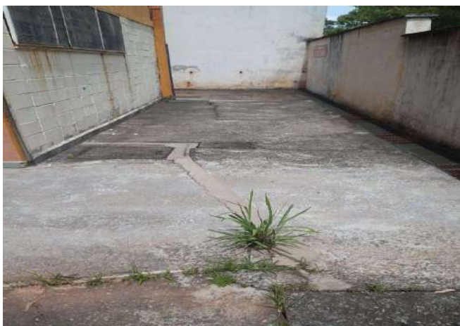
FOTO 17 FISSURAS E TRINCAS NOS PISOS EXTERNOS
