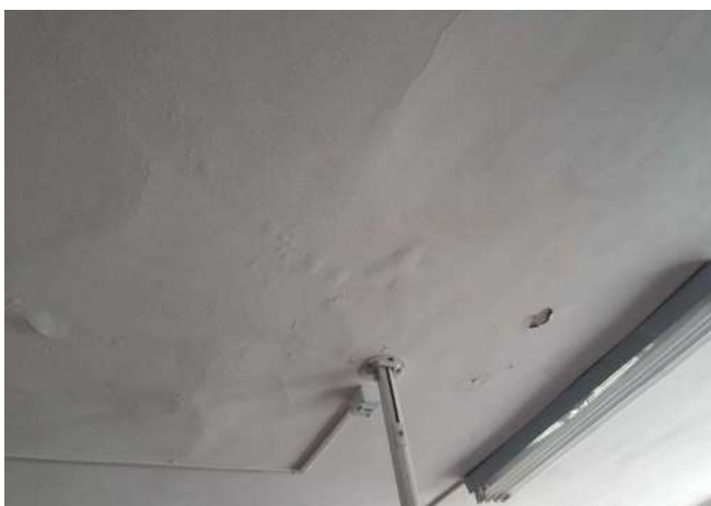
FOTO 9 BOLHAS E ENRUGAMENTO NO TETO DEVIDO A UMIDADE
