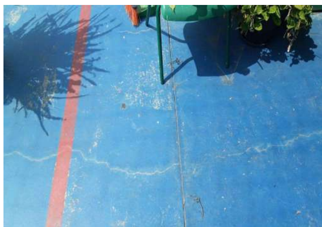
FOTO 6 FISSURAS E TRINCAS NO PISO EXTERNO E QUADRA
