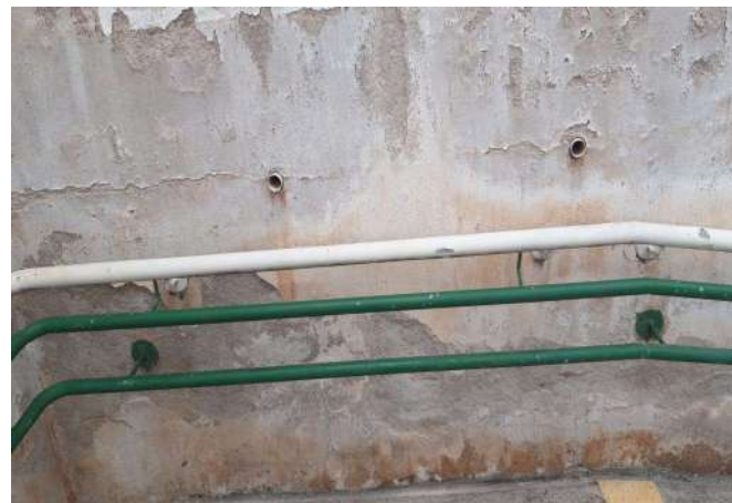
FOTO 26 PAREDES DAS RAMPAS DE ACESSO APRESENTAM DESCASCAMENTO, NECESSÁRIO
