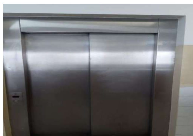
FOTO 10 ELEVADOR DA UNIDADE
