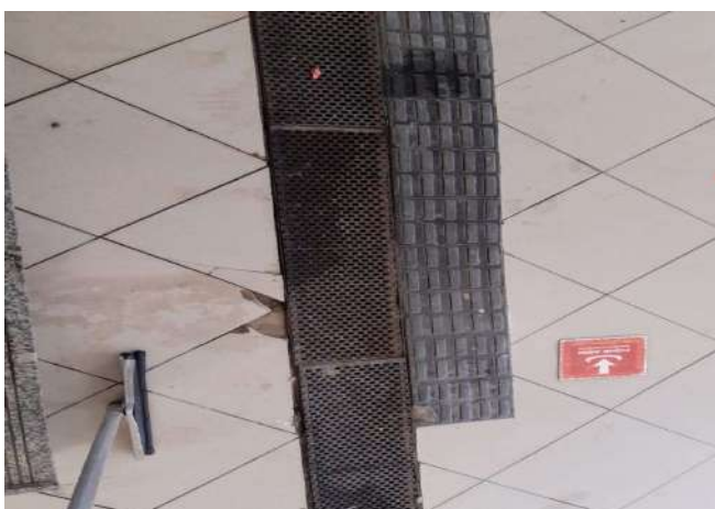
FOTO 11 FISSURAS E TRINCAS NOS PISOS INTERNOS
