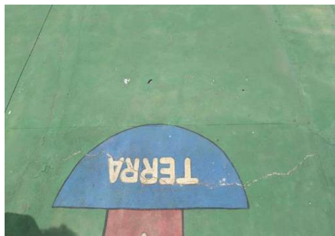
FOTO 16 FISSURAS E TRINCAS NOS PISOS EXTERNOS, ÁREA DO SOLÁRIO
