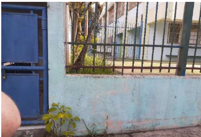
FOTO 7 Área Externa - Trincas
