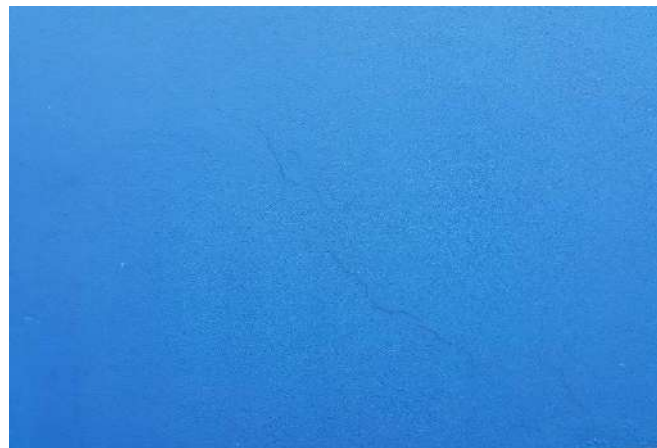
FOTO 8 Área Externa - Trinca
