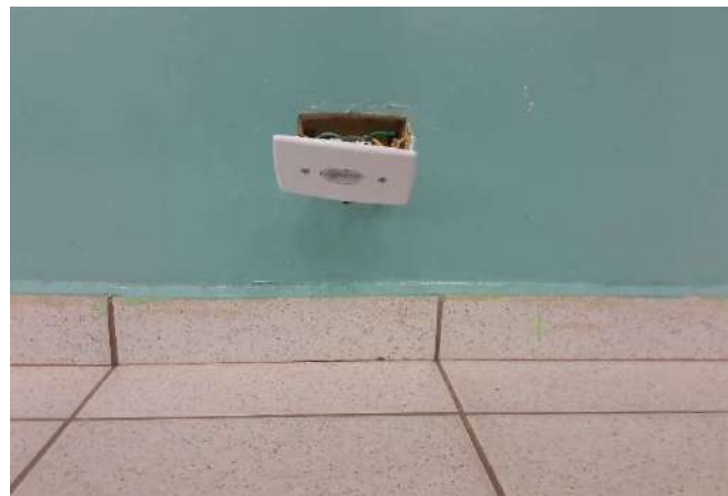
FOTO 98 Sala 6 - Tomada inadequada (perigoso)
