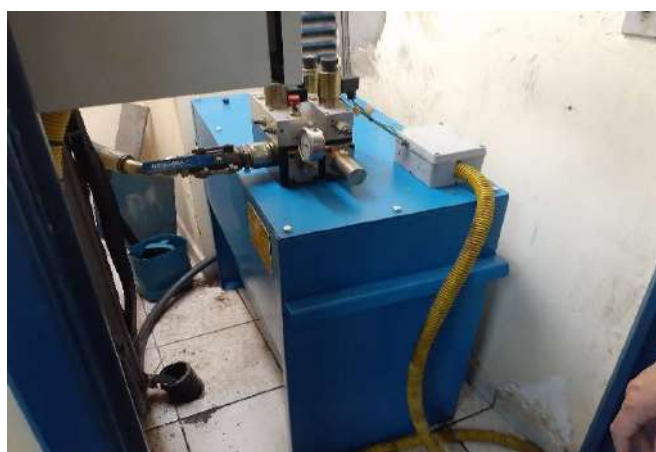
FOTO 33 Casa de máquina do elevador- Visão geral
