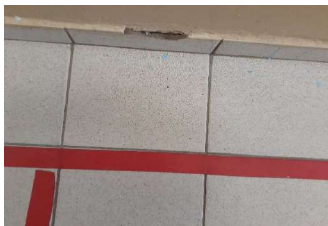
FOTO 22 Corredor de Acesso - Rodapé quebrado
