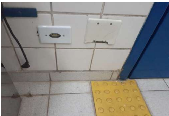
FOTO 27 Hall 2 - Espelho da tomada danificada
