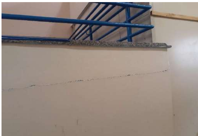
FOTO 19 Escada de Acesso - Trinca
