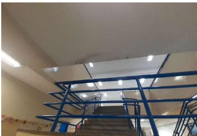
FOTO 17 Escada de Acesso - Infiltração, mancha de mofo/bolor
