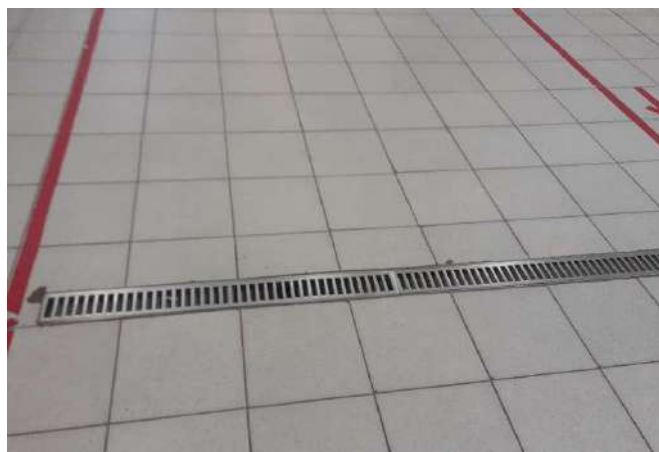
FOTO 30 Hall 3 - Piso ceramico quebrado
