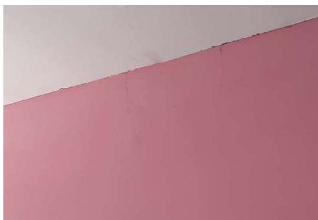
FOTO 78 Sala coordenação - Mancha de mofo/bolor
