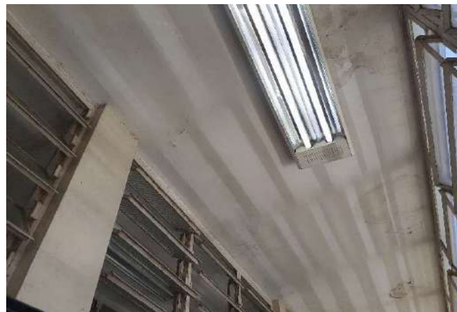
FOTO 46 Depósito 2 Pavto - Infiltração
