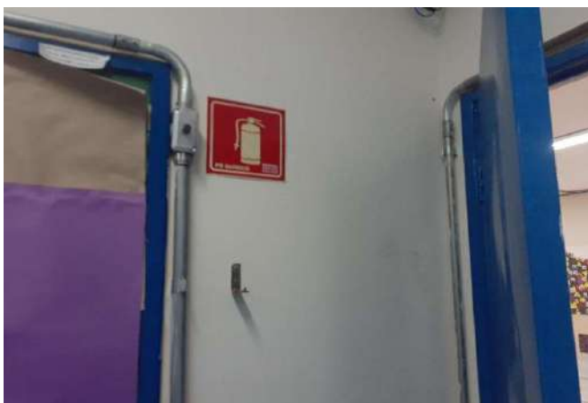
FOTO 107 Extintor - Sem cilindro
