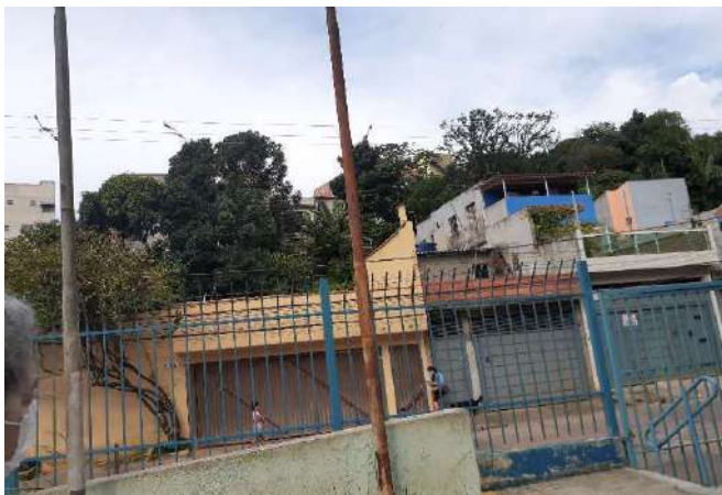
FOTO 13 Área Externa - Poste oxidado
