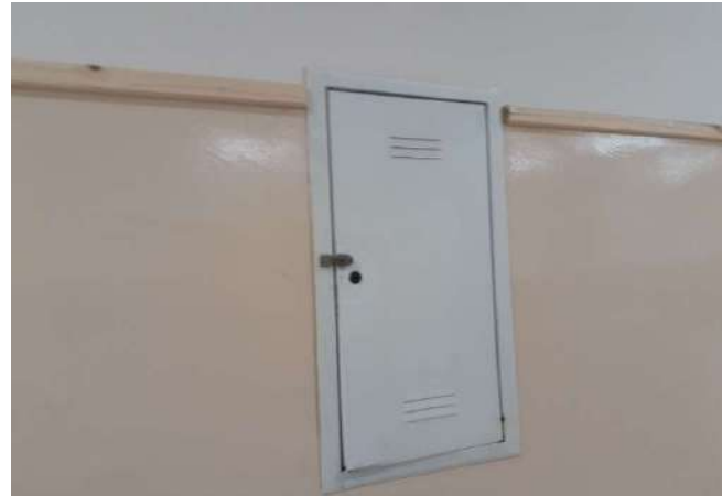
FOTO 106 Quadro de energia - Trancado
