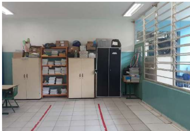
FOTO 104 Sala 15 - Piso desgastado
