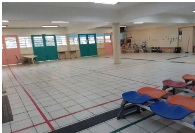
FOTO 66 Refeitório - Piso quebrado
