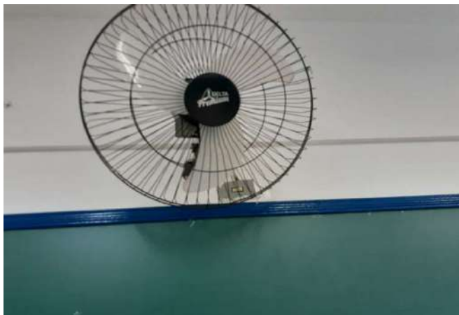
FOTO 103 Sala 7 - Ventilador não funciona
