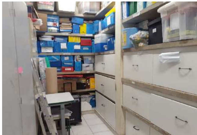
FOTO 32 Almojarifado - Piso desgastado
