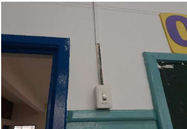
FOTO 103 Sala 16 - Improviso elétrico
