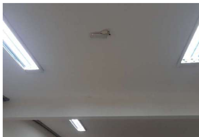
FOTO 108 Luz de emergência
