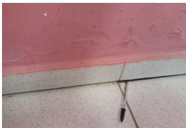
FOTO 76 Sala coordenação - Recalque e bolhas
