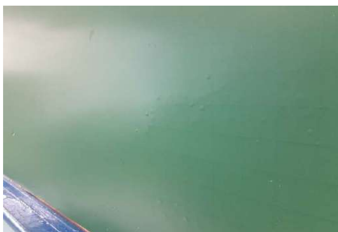
FOTO 105 Sala 12 - Bolhas no quadro
