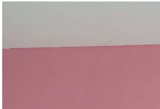
FOTO 104 Sala de Projetos - Trinca parede e teto
