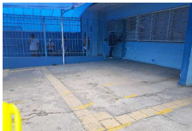
FOTO 10 Área Externa - Trincas
