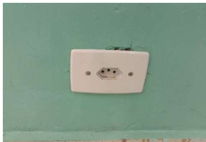
FOTO 106 Sala 10 - Falha na tomada
