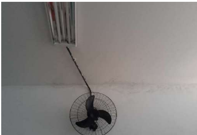
FOTO 103 Sala 13 - Improviso elétrico
