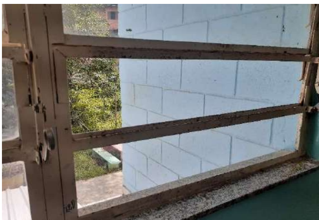
FOTO 107 Sala 10 - Vidro quebrado
