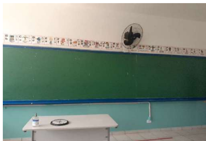
FOTO 108 Sala 13 - Improviso elétrico
