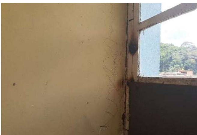
FOTO 47 Depósito 2 Pavto - Trincas
