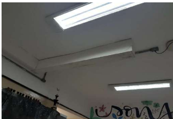
FOTO 21 Corredor de Acesso - Improvisos elétricos
