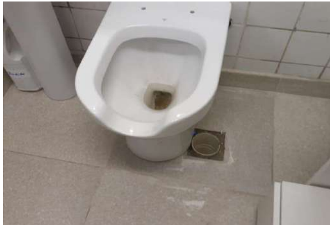
FOTO 106 Sanit. Unisex Deficiente - Falta tampa vaso e ralo
