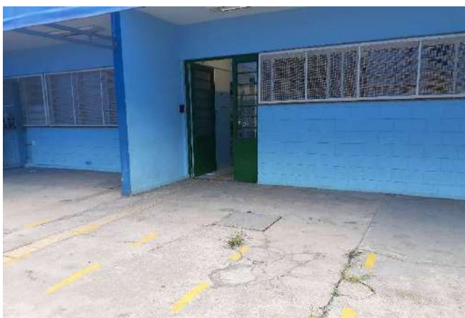
FOTO 9 Área Externa - Juntas de dilatação ineficiente
