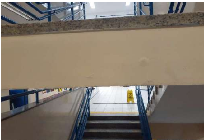
FOTO 18 Escada de Acesso - Bolhas e enrugamento
