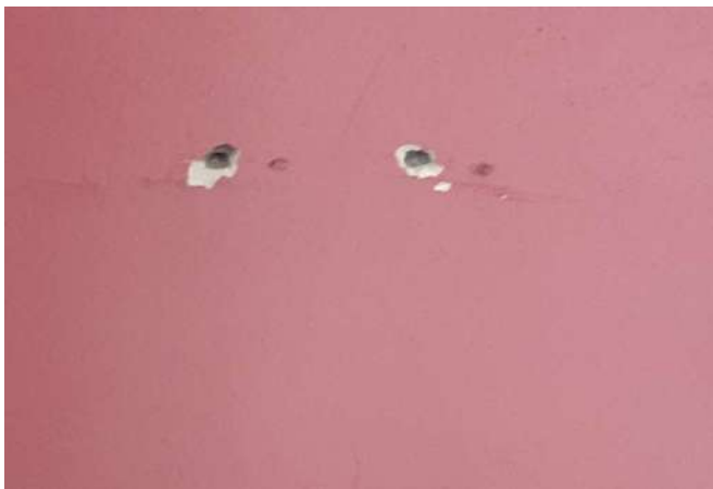
FOTO 79 Sala coordenação - Irregularidade
