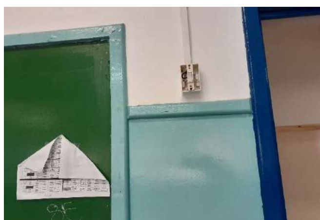
FOTO 102 Sala 7 - Tomada inadequada
