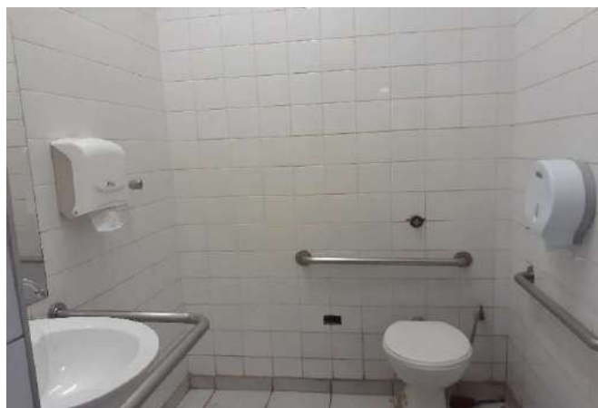
FOTO 108 Sanit. Unisex Deficiente - Acabamento descarga e espelho da tomada faltantes
