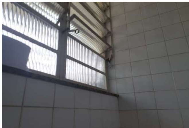
FOTO 104 Sanit. Func. Masc. - Esquadria enferrujada
