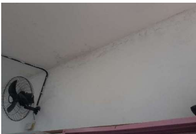
FOTO 105 Sala 13 - Improviso elétrico e bolor
