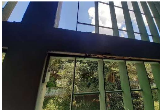
FOTO 86 Sala de leitura - Esquadria enferrujada
