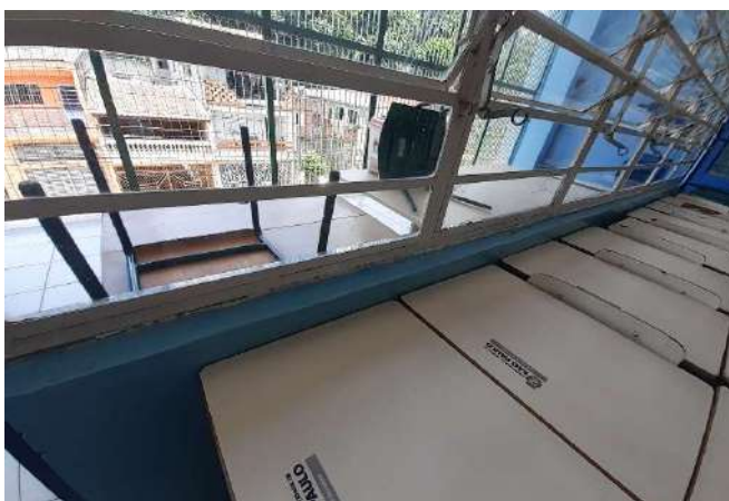
FOTO 105 Sala 19 - Esquadria emperrada
