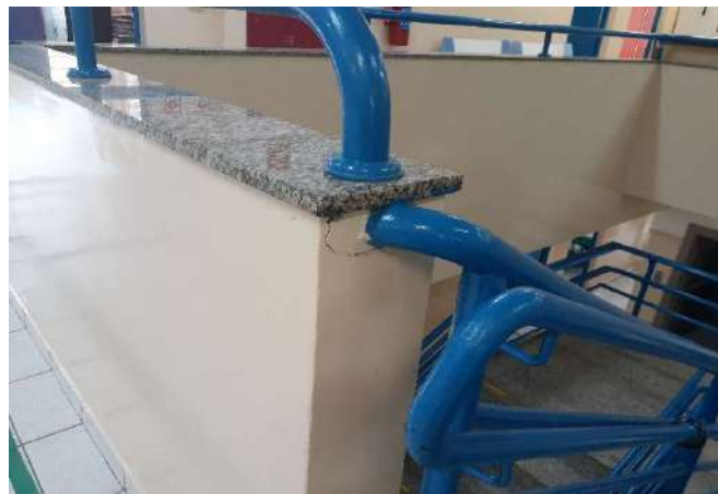
FOTO 20 Escada de Acesso - Fixação deficiente
