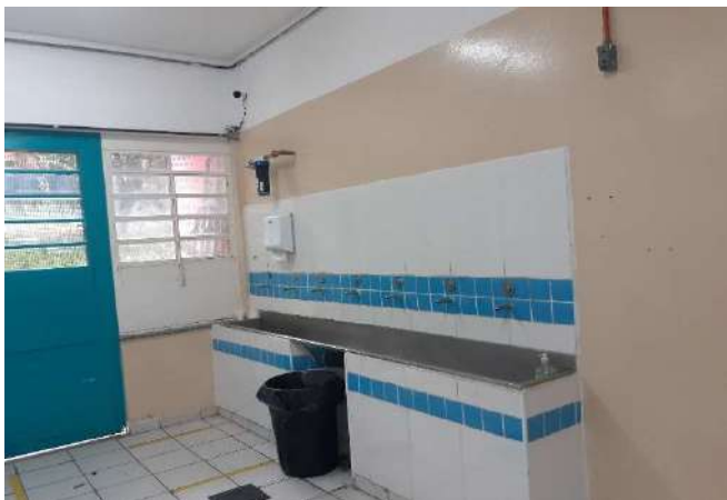
FOTO 67 Refeitório - Improviso elétrico
