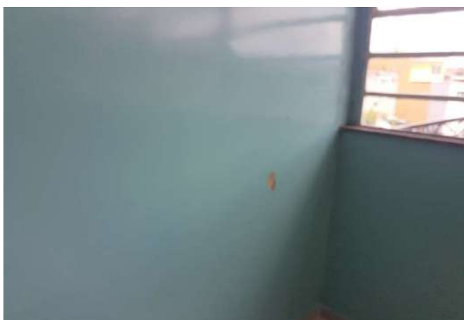
FOTO 105 Sala 18 - Parte quebrada
