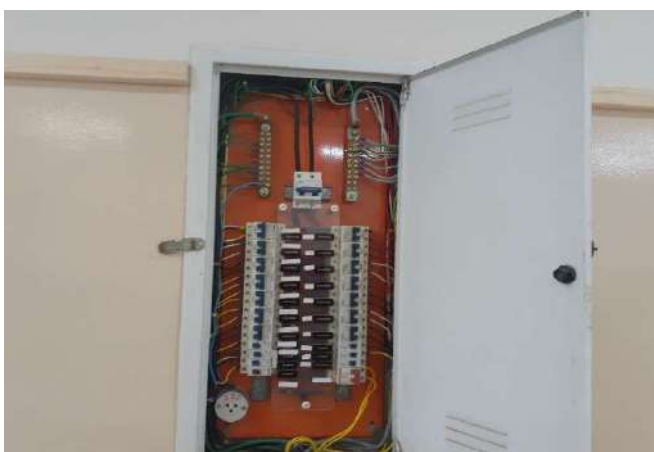
FOTO 107 Quadro de energia - Visão Geral
