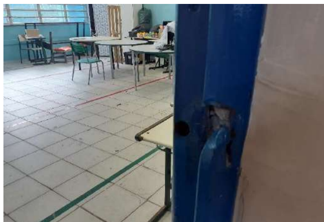
FOTO 102 Sala 2 - Piso desgastado
