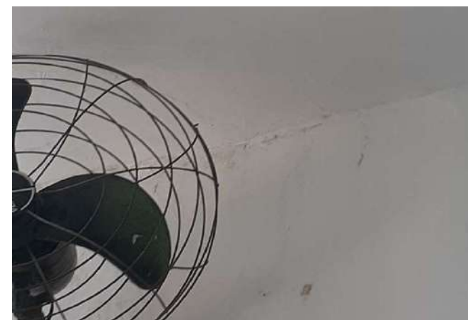
FOTO 106 Sala 19 - Bolhas e mancha de bolor/mofo
