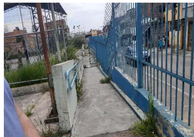
FOTO 5 Acesso Deficiente - Visão geral
