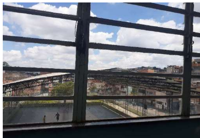
FOTO 106 Sala 18 - Esquadria sem deslizamento
