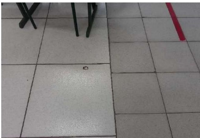
FOTO 101 Sala 5 - Piso partes quebrada
