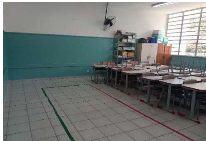
FOTO 104 Sala 16 - Piso desgastado
