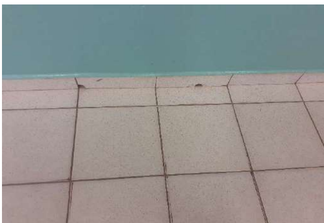
FOTO 99 Sala 6 - Rodapé partes quebradas
