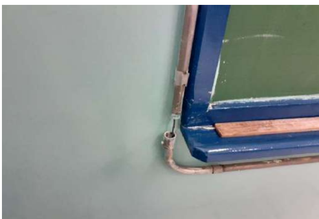
FOTO 107 Sala 14 - Improviso elétrico
