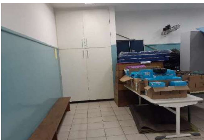
FOTO 99 Sala 1 - Piso desgastado
