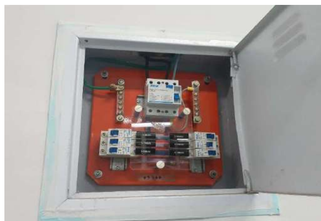
FOTO 108 Quadro de energia - Visão Geral
