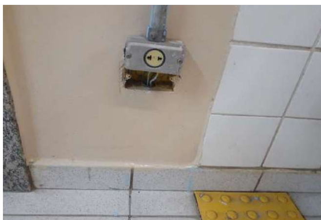
FOTO 23 Corredor de Acesso - Improvisos elétricos com fios aparentes
