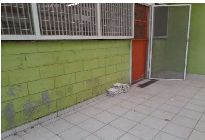
FOTO 15 Área Externa - Mancha de umidade
