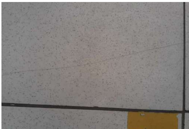
FOTO 103 Sala 12 - Piso trinca
