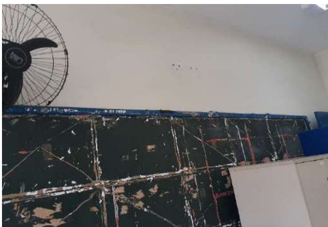
FOTO 89 Sala dos professores - Fixação antiga de elementos
