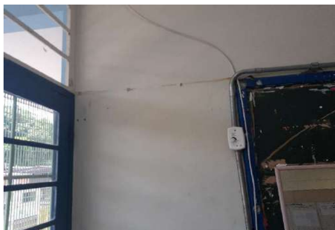
FOTO 88 Sala dos professores - Improviso elétrico
