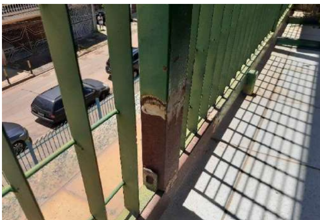
FOTO 71 Refeitório Prof externo - Grade danificada
