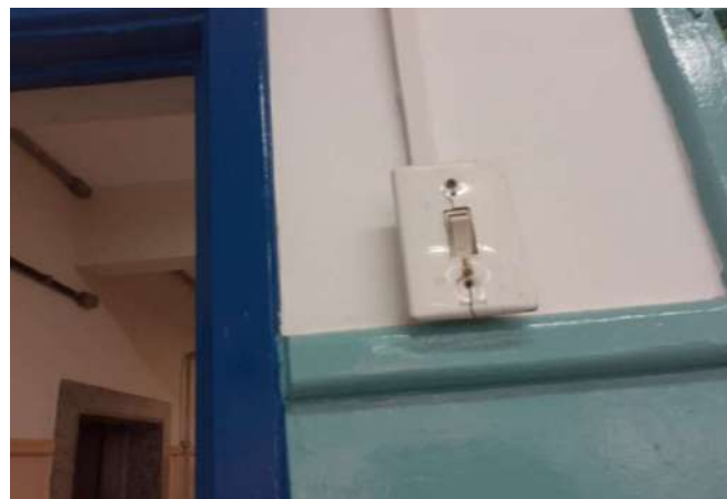
FOTO 100 Sala 6 - Interruptor quebrado
