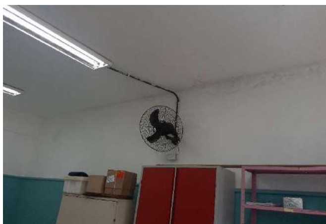
FOTO 107 Sala 13 - Mancha de mofo/bolor
