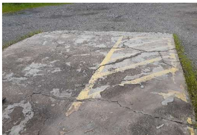
FOTO 58 Estacionamento - Vaga deficiente com trincas
