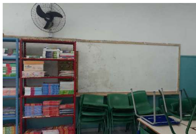
FOTO 108 Sala 17 - Ventilador na funciona, mancha de mofo/ bolor
