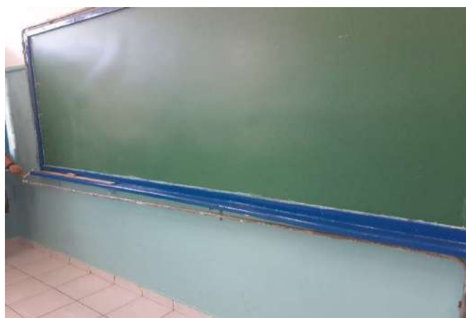
FOTO 108 Sala 14 - Bolor na parede
