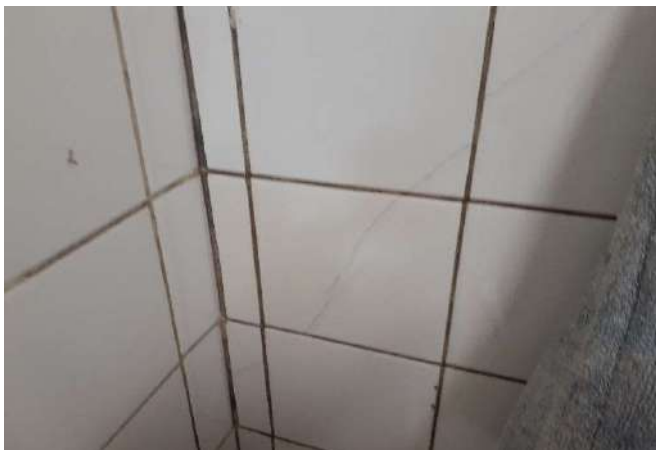
FOTO 55 Despensa - Azulejo com trinca
