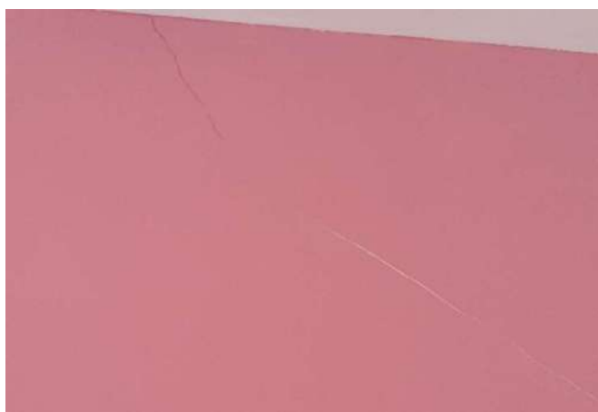
FOTO 77 Sala coordenação - Trinca
