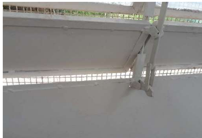
FOTO 68 Refeitório - Esquadria quebrada
