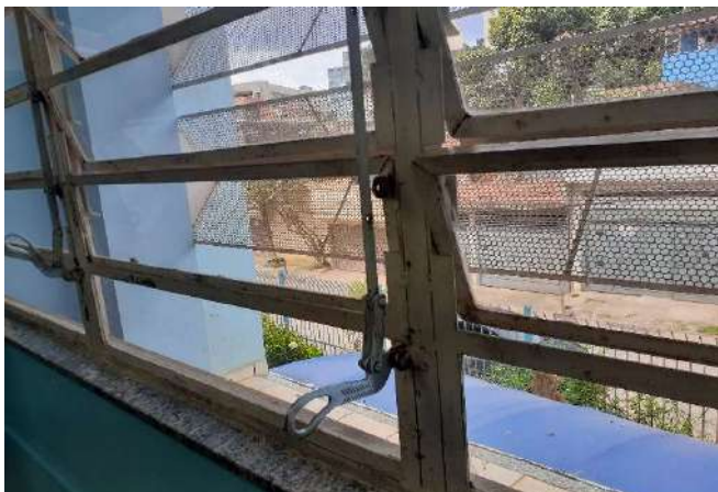
FOTO 97 Sala 5 - Esquadria quebrada
