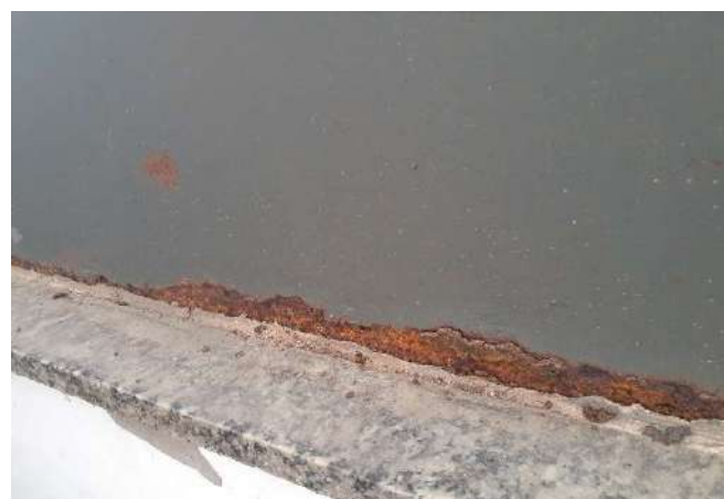
FOTO 45 Depósito 2 Pavto - Esquadria quebrada e enferrujada
