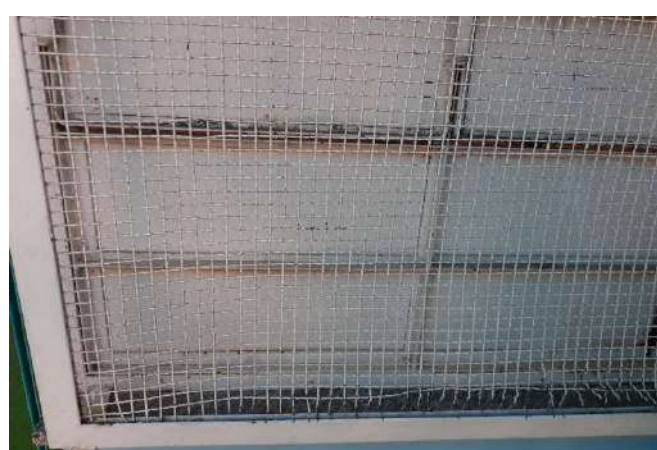
FOTO 12 Área Externa - Gradil danificado
