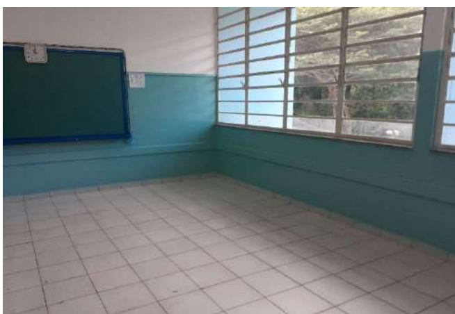
FOTO 107 Sala 17 - Piso desgastado
