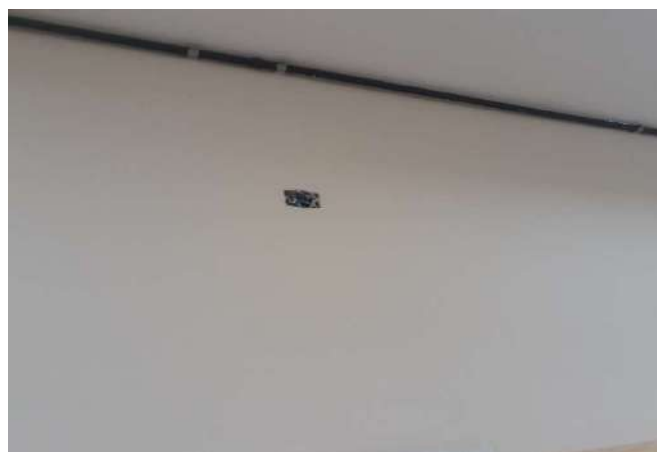
FOTO 28 Hall 2 - Tomada sem acabamento
