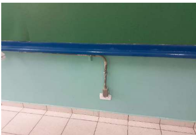
FOTO 105 Sala 16 - Improviso elétrico
