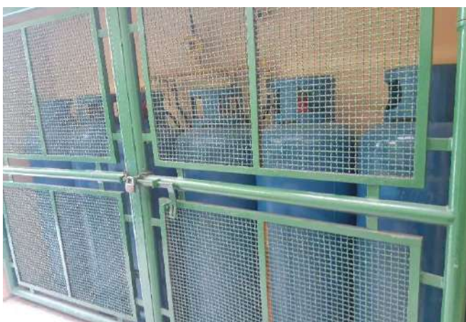
FOTO 107 Gás - Visão geral
