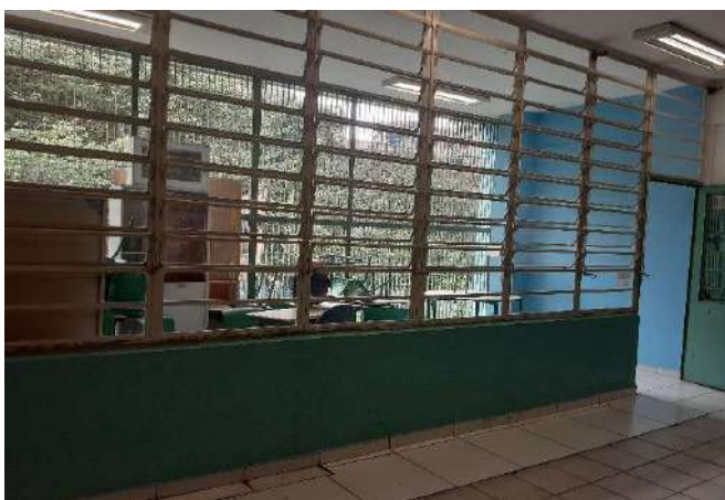
FOTO 105 Sala 15 - Esquadria emperrada
