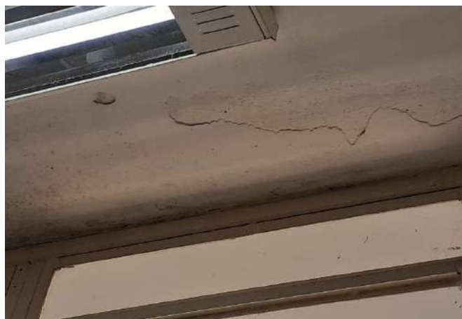
FOTO 90 Sala dos professores - Trinca
