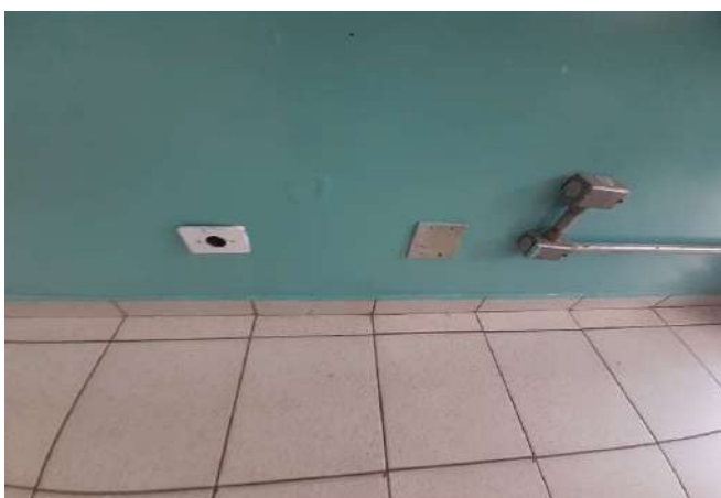
FOTO 107 Sala 19 - Tomada/ interruptor danificados
