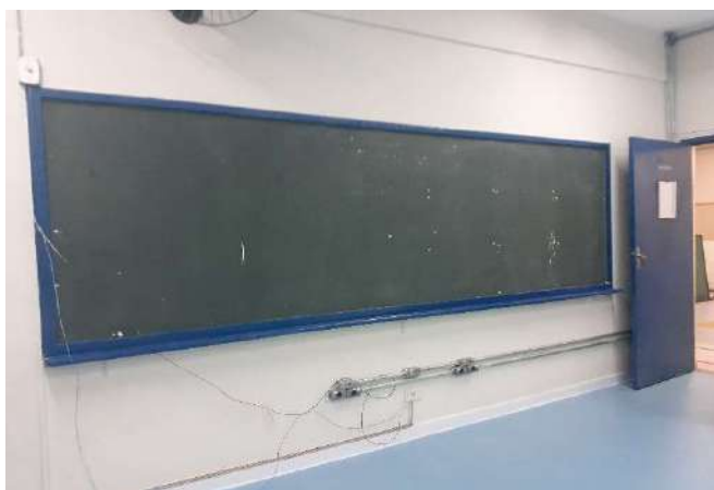
FOTO 81 Sala de Leitura - Improvisos elétricos
