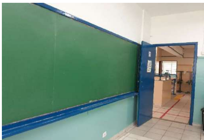
FOTO 105 Sala 11 - Esquadria danificada (porta)
