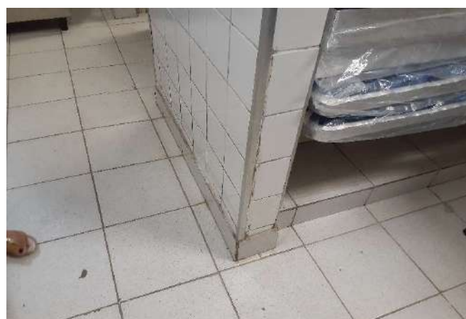
FOTO 56 Despensa - Cantoneira danificada
