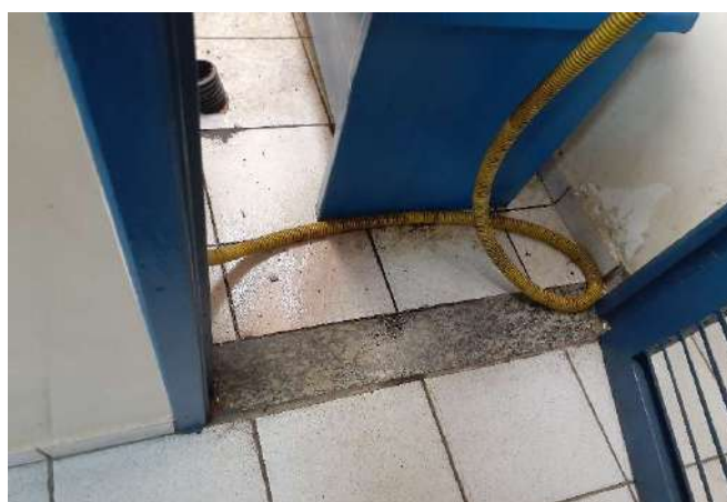
FOTO 34 Casa de máquina do elevador - Vazamento de óleo
