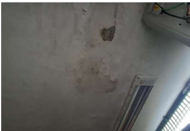
FOTO 107 Sala 15 - Infiltração, mancha de mofo/bolor
