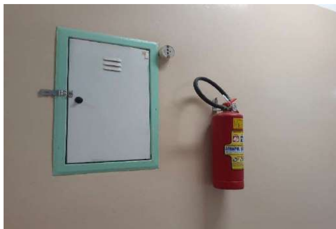
FOTO 108 Extintor - Sem placa
