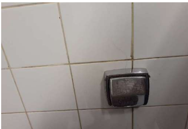
FOTO 107 Sanit. Aluno Masc - Azulejo trincado
