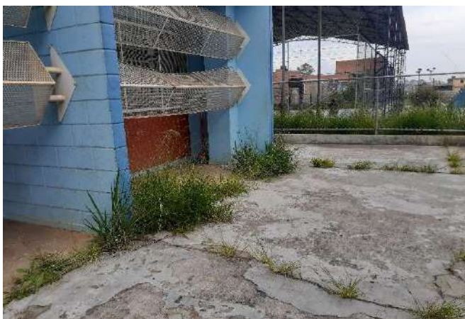
FOTO 11 Área Externa - Deficiência na juntas de trabalho
