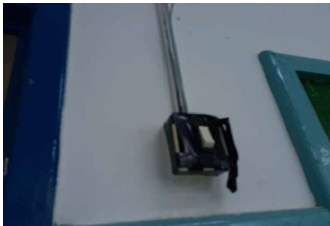
FOTO 103 Sala 10 - Irregularidade fora de norma
