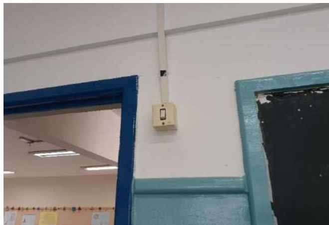
FOTO 98 Sala 3 - Canaleta sem continuidade
