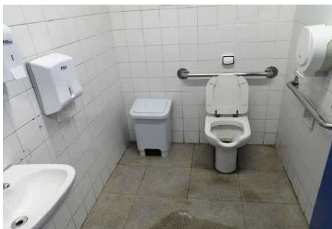
FOTO 59 Sanitário PNE alunos Masculino - Piso manchado
