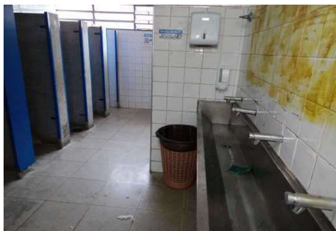
FOTO 52 Sanitário aluno masculino - Manchas nos azulejos/sujidades
