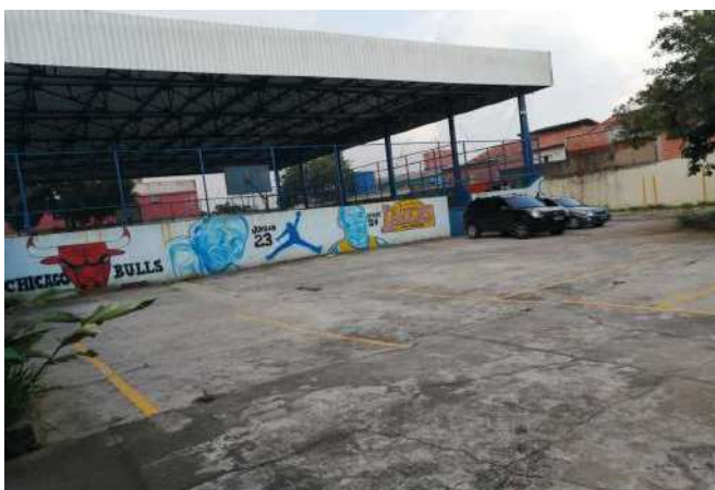
FOTO 21 Estacionamento - Visão geral / fissuras e juntas de dilatação deficientes
