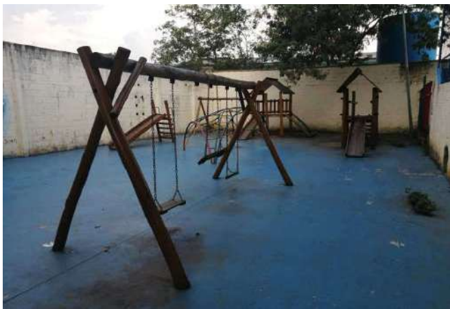
FOTO 19 Playground - Deficiência nas juntas de dilatação
