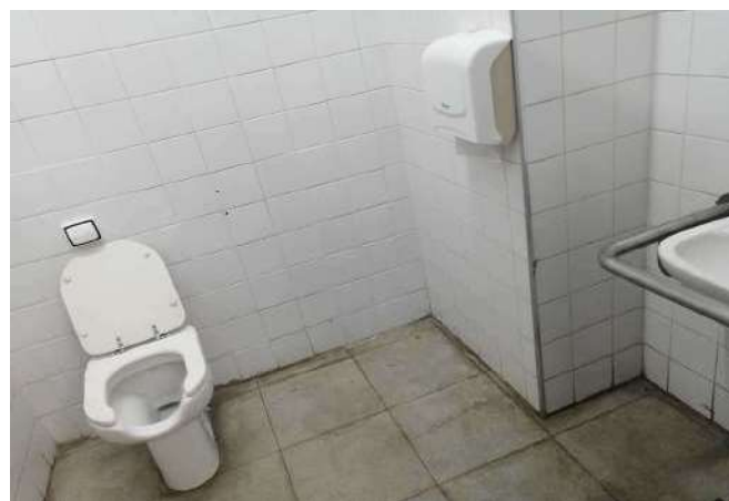
FOTO 60 Sanitário PNE alunos Feminino - Piso manchado
