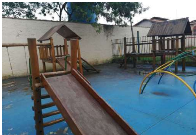
FOTO 20 Playground - Visão geral / umidade ascendente do solo
