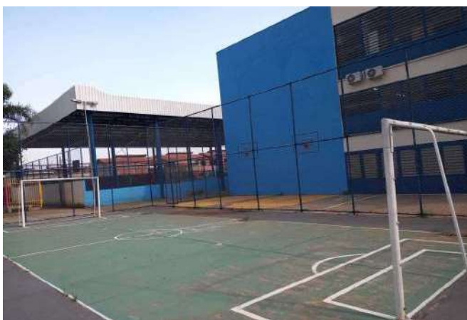
FOTO 15 Quadra descoberta - Pintura desgastada e juntas de dilatação deficientes
