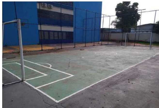
FOTO 14 Quadra descoberta - Visão geral (fissuras)
