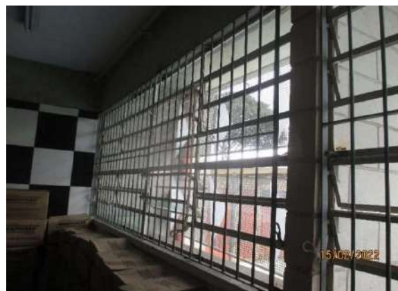
FOTO 32 SALA DE XADREZ COM ESQUADRIA TRAVADA
