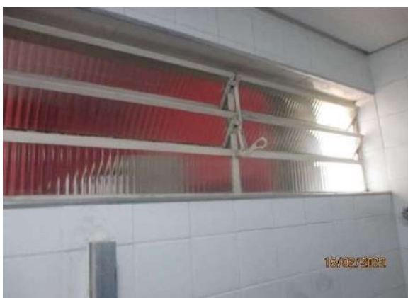
FOTO 69 SANITÁRIO ALUNO FEMININO ESQUADRIA TRAVADA
