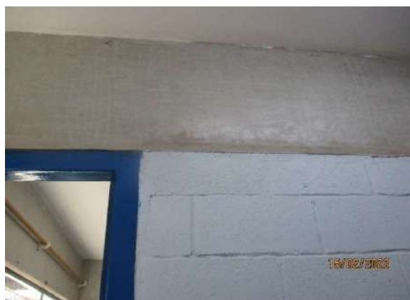
FOTO 44 DEPÓSITO 1 COM TRINCANA PAREDE
