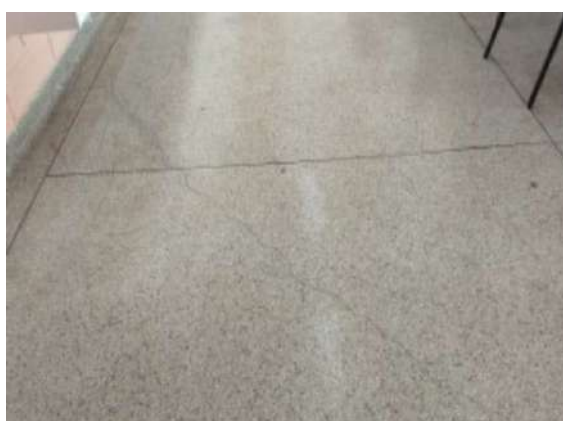
FOTO 178 SALA PROFESSORES COM TRINCAS NO PISO
