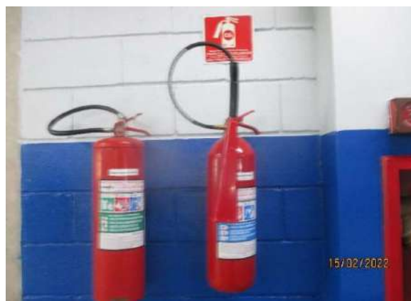
FOTO 131 EXTINTORES PAVIMENTO INTERMEDIÁRIO
