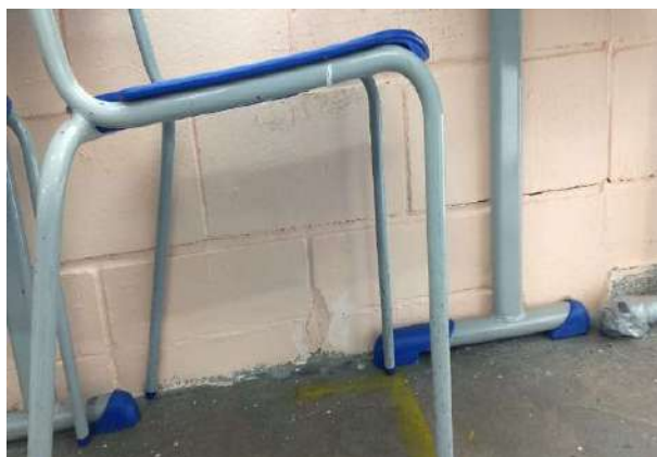
FOTO 177 SALA 16 COM TRINCA NO PISO E PAREDE
