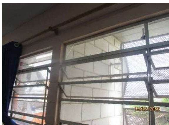
FOTO 173 SALA 14 COM ESQUADRIA TRAVADA E VIDRO QUEBRADO
