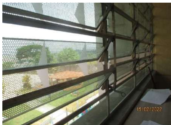
FOTO 160 SALA LEITURA COM ESQUADRIA TRAVADA
