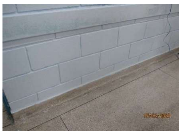
FOTO 34 SECRETARIA PISO COM FISSURAS (INTERNO)
