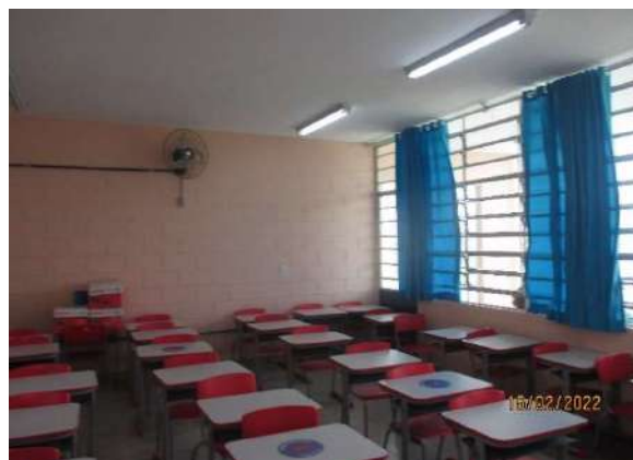
FOTO 170 SALA 13 COM TRINCA NA PAREDE
