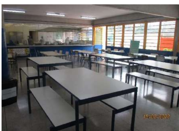
FOTO 46 REFEITÓRIO PISO COM TRINCAS E ESQUADRIA TRAVADA
