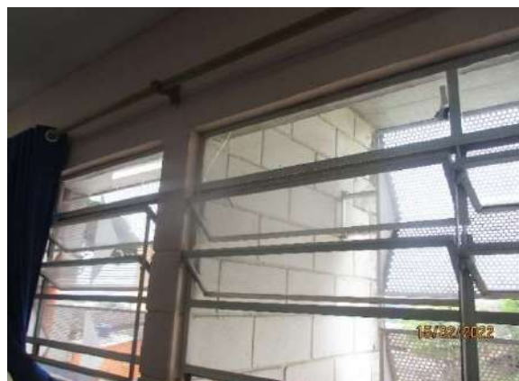
FOTO 144 SALA 05 COM VIDRO QUEBRADO
