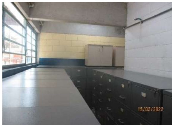
FOTO 40 ARQUIVO PAREDE COM TRINCA
