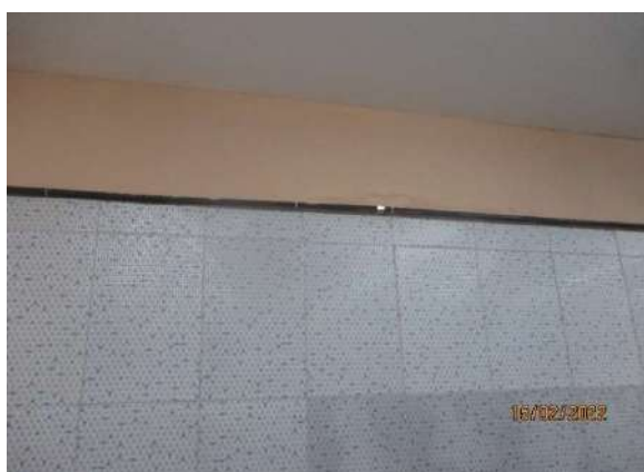
FOTO 139 SALA 10 COM INFILTRAÇÃO NA PAREDE
