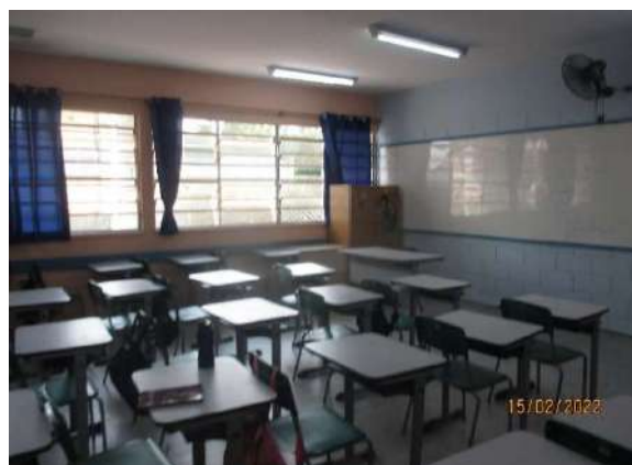
FOTO 152 SALA 08 COM TRINCA NO PISO
