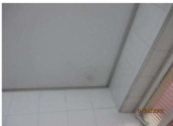
FOTO 71 SANITÁRIO ALUNO FEMININO INFILTRAÇÃO NO FORRO
