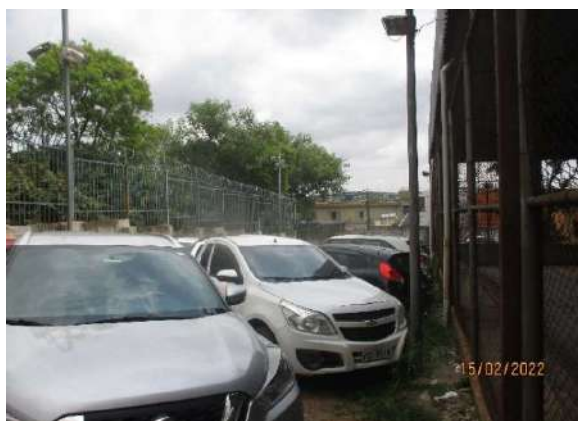
FOTO 7 ESTACIONAMENTO PISO DANIFICADO
