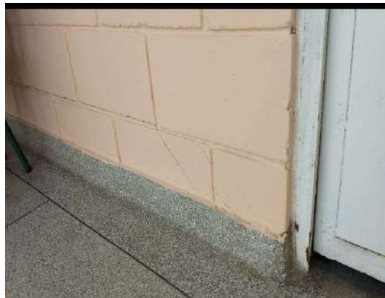
FOTO 176 SALA 16 COM TRINCA NO PISO E PAREDE
