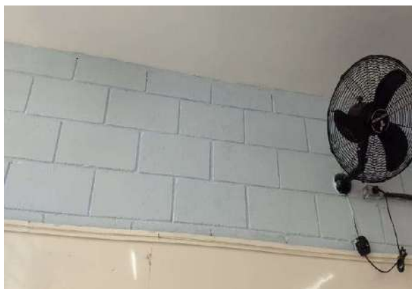
FOTO 181 SALA INFORMÁTICA COM TRINCAS NA PAREDE
