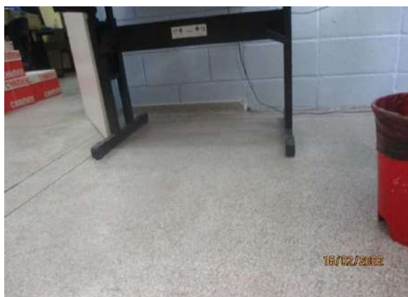
FOTO 75 SALA COORDENAÇÃO COM TRINCA NO PISO
