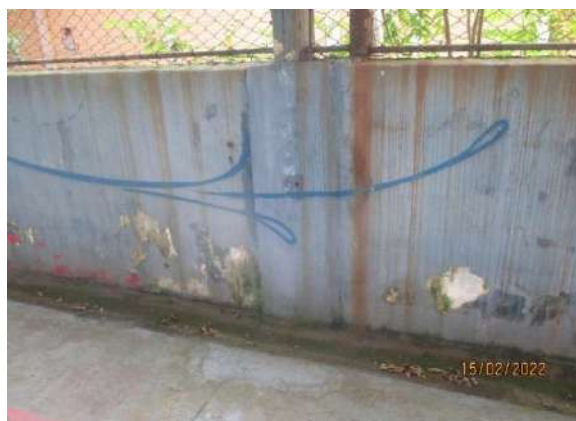
FOTO 108 QUADRA DE ESPORTES COBERTA COM BOLOR E EFLORESCÊNCIA
