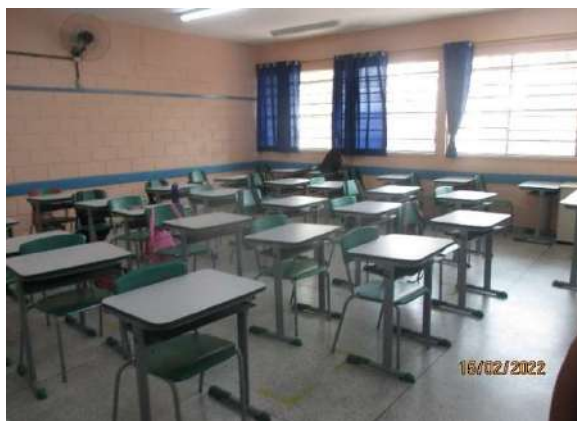
FOTO 151 SALA 07 COM TRINCA NO PISO
