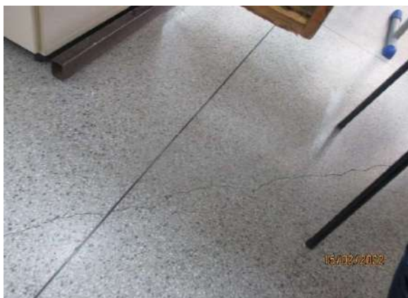
FOTO 127 SALA DE AULA 01 COM TRINCAS NO PISO
