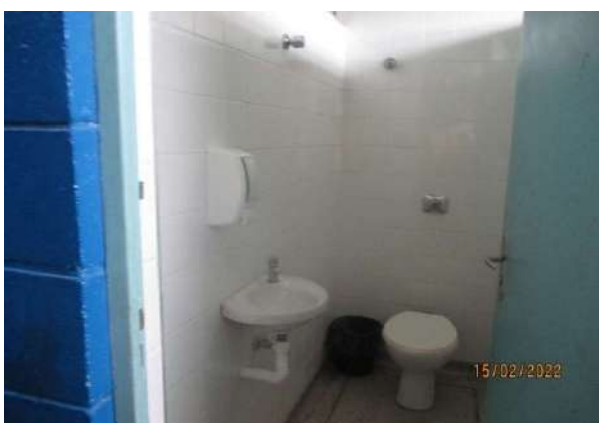
FOTO 185 SANITÁRIO MASCULINO COM INFILTRAÇÃO E TRINCAS
