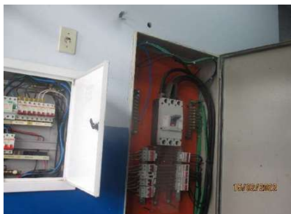
FOTO 80 QUADRO DE DISJUNTORES SEM PROTEÇÃO
