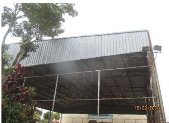
FOTO 9 QUADRA COBERTA COM CORROSÃO
