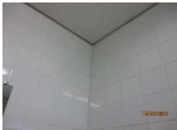
FOTO 138 SANITÁRIO FEMININO ALUNOS PAVIMENTO INTERMEDIÁRIO COM TRINCA NO REVESTIMENTO
