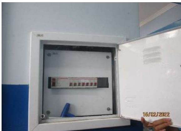
FOTO 81 QUADRO DE DISJUNTORES
