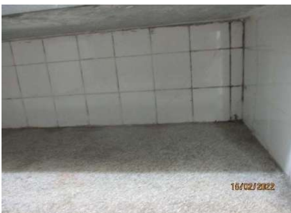
FOTO 59 DISPENSA DE ALIMENTOS COM TRINCAS NAS PAREDES
