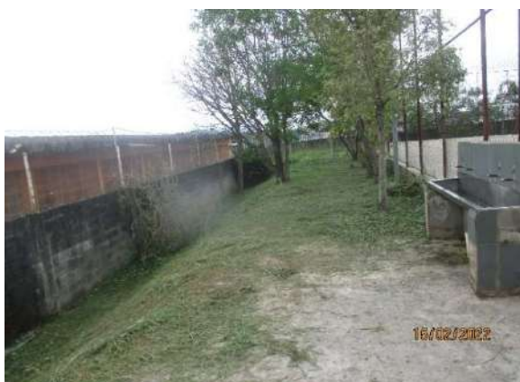
FOTO 103 MURO DIVISA COM MANCHAS DE BOLOR E SUJIDADES
