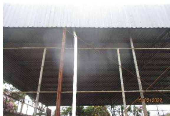
FOTO 12 QUADRA COBERTA COM ESTRUTURA METÁLICA COM CORROSÃO
