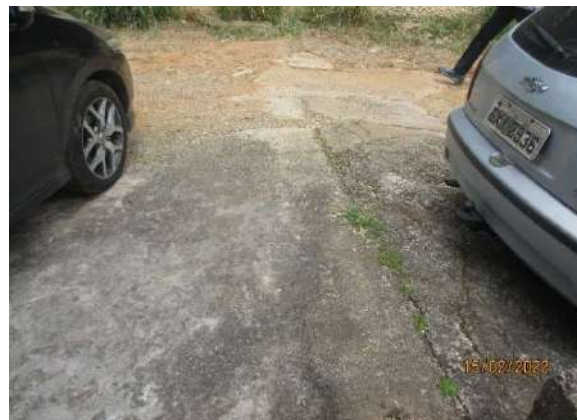
FOTO 8 ESTACIONAMENTO PISO DANIFICADO
