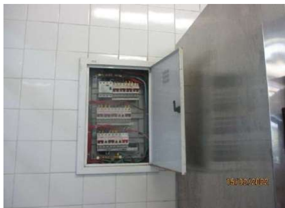
FOTO 53 QUADRO DE DISJUNTORES COZINHA
