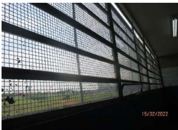
FOTO 171 SALA 13 COM ESQUADRIA TRAVADA E VIDRO QUEBRADO
