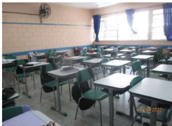
FOTO 143 SALA 04 COM TRINCA NO PISO
