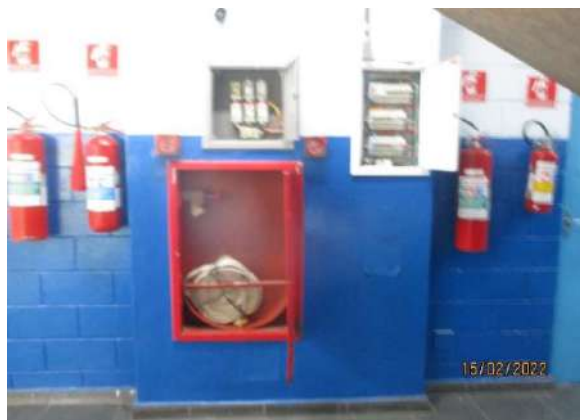
FOTO 51 HIDRANTE, EXTINTORES E QUADRO DE DISJUNTORES PISO TÉRREO
