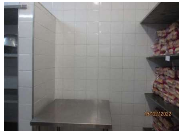
FOTO 58 DISPENSA DE ALIMENTOS COM TRINCAS NAS PAREDES
