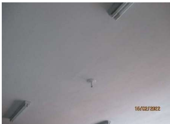
FOTO 159 SALA LEITURA COM INFILTRAÇÃO NA PAREDE
