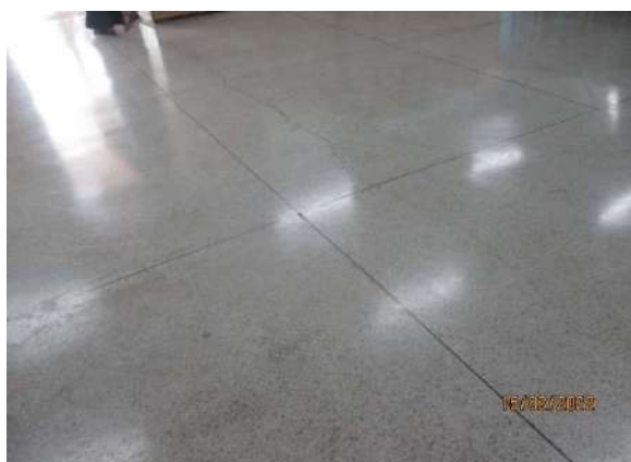
FOTO 157 PISO PAVIMENTO SUPERIOR COM TRINCA
