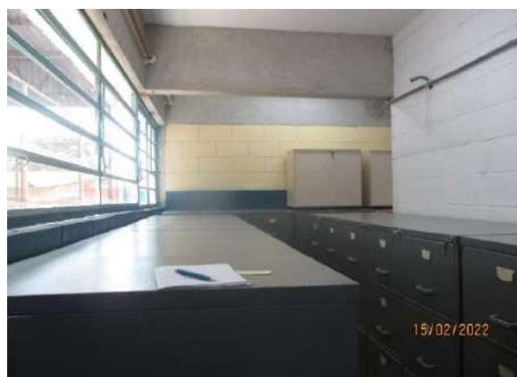
FOTO 41 ARQUIVO PAREDE COM TRINCA
