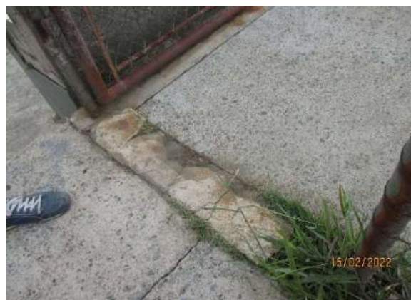
FOTO 98 ACESSO QUADRA DESCOBERTA COM PISO TRINCADO
