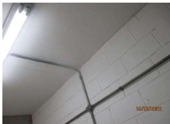
FOTO 45 DEPÓSITO 1 COM TRINCA NA PAREDE, ESQUADRIA TRAVADA E INFILTRAÇÃO NO
