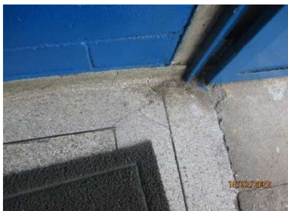
FOTO 49 REFEITÓRIO PISO COM TRINCAS
