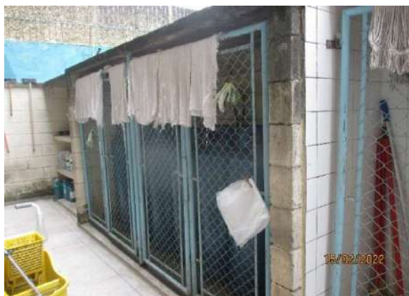
FOTO 21 ABRIGO GÁS PAREDES COM MANCHAS E SUJIDADES
