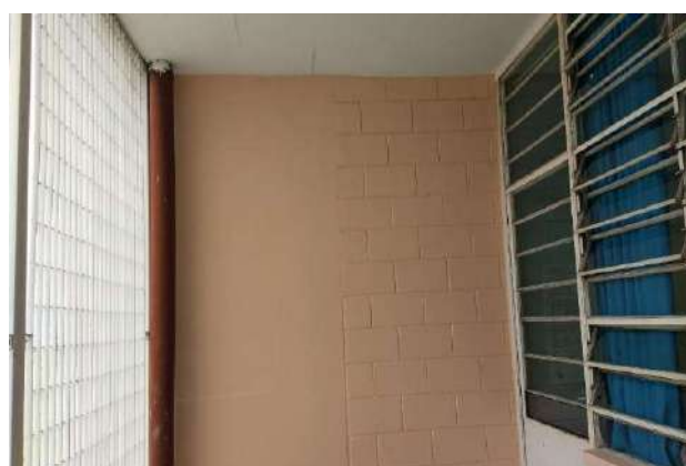
FOTO 184 PAREDE LATERAL ESQUERDA COM INFILTRAÇÃO
