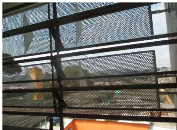
FOTO 166 SALA 11 COM VIDRO QUEBRADO
