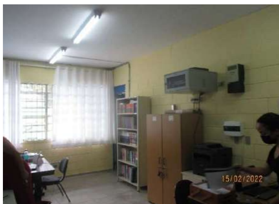
FOTO 73 SALA COORDENAÇÃO COM TRINCA NO PISO E INFILTRAÇÃO NO FORRO
