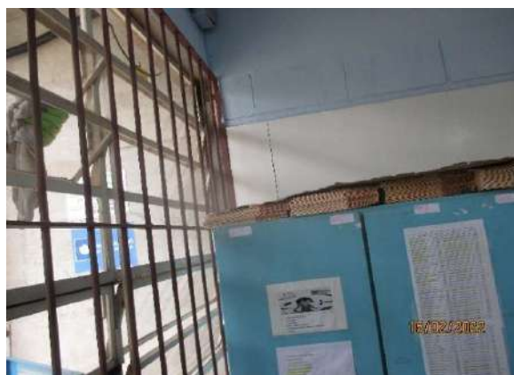
FOTO 37 SECRETARIA PAREDE COM TRINCA
