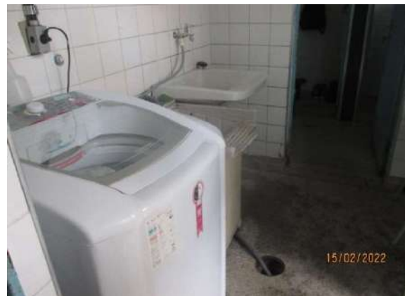
FOTO 24 LAVANDERIA COM REVESTIMENTO QUEBRADO E TRINCAS
