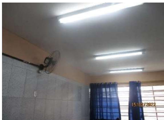
FOTO 140 SALA 10 COM INFILTRAÇÃO NA PAREDE
