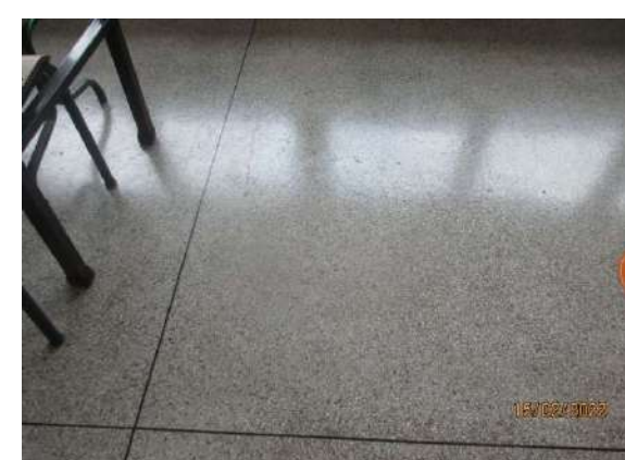
FOTO 48 REFEITÓRIO PISO COM TRINCAS
