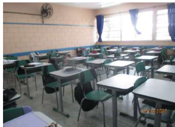
FOTO 172 SALA 14 COM TRINCA NO PISO
