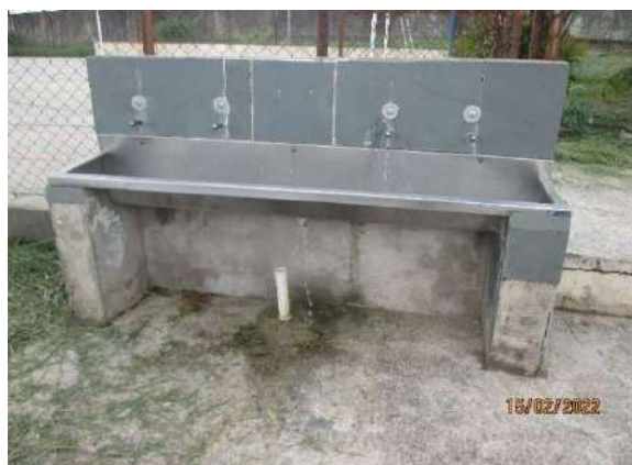
FOTO 104 BEBEDOURO QUADRA DESCOBERTA COM CANO QUEBRADO
