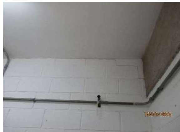
FOTO 42 ARQUIVO PAREDE COM TRINCA
