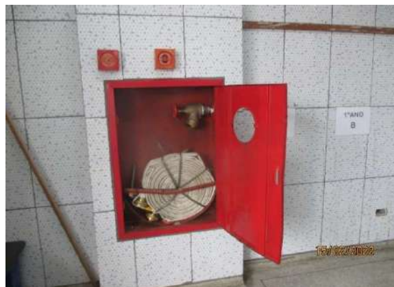
FOTO 52 HIDRANTE PISO TÉRREO PÁTIO COBERTO
