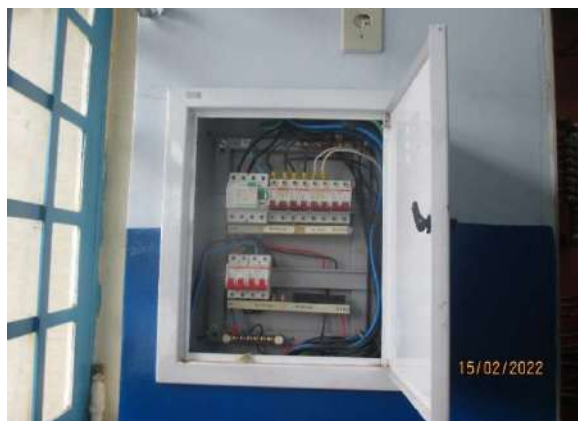
FOTO 79 QUADRO DE DISJUNTORES SEM PROTEÇÃO
