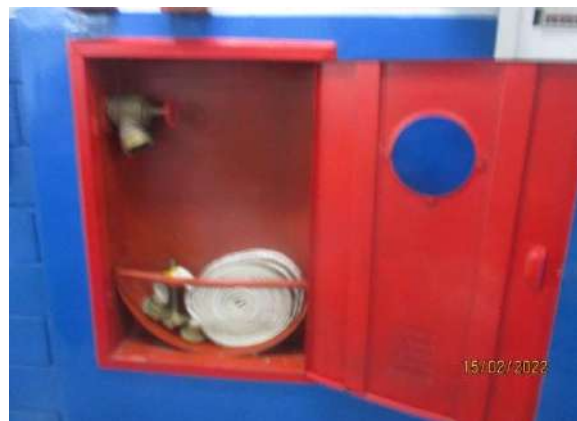
FOTO 130 HIDRANTE PAVIMENTO INTERMEDIÁRIO
