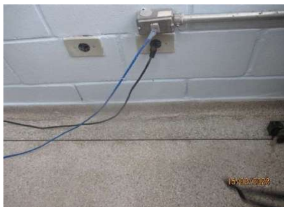
FOTO 76 SALA COORDENAÇÃO COM TRINCA NO PISO
