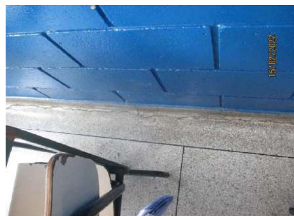
FOTO 47 REFEITÓRIO PISO COM TRINCAS
