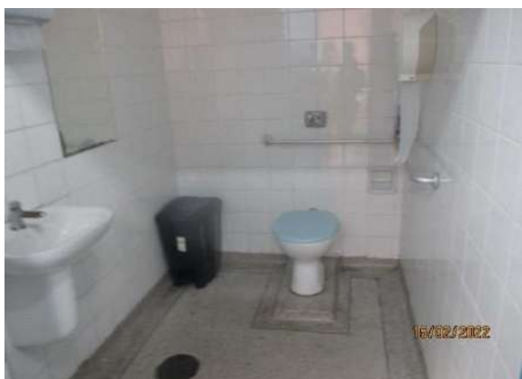
FOTO 89 SANITÁRIO PCD FUNCIONÁRIO SEM BARRA DE APOIO NA PIA
