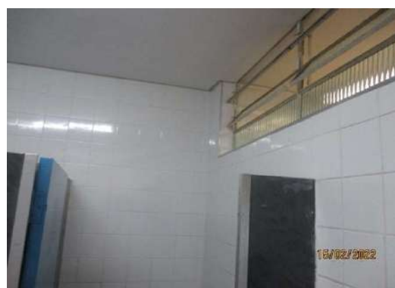
FOTO 68 SANITÁRIO ALUNO FEMININO COM TRINCAS NA PAREDE
