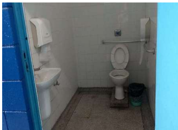
FOTO 182 SANITÁRIO PCD UNISEX PISO SUPERIOR PIA SEM BARRA DE APOIO
