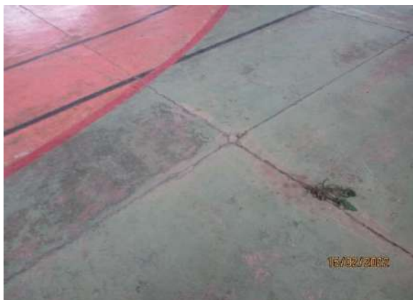
FOTO 107 QUADRA DE ESPORTES COBERTA COM PINTURA DESCOLORIDA
