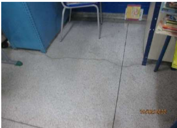
FOTO 169 SALA 13 COM TRINCAS NO PISO
