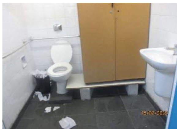
FOTO 65 SANITÁRIO PCD, PIA SEM BARRA DE APOIO
