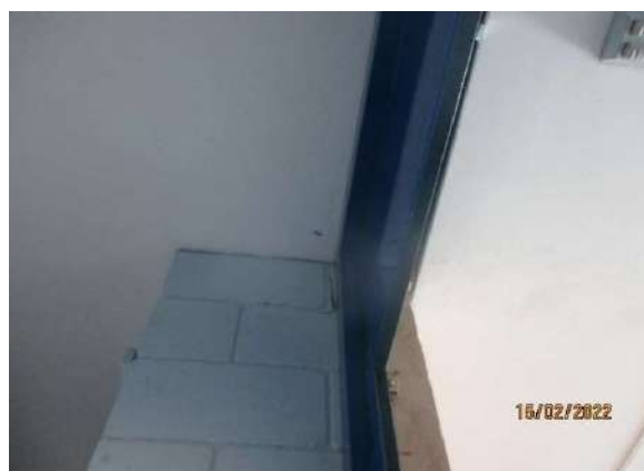
FOTO 164 SALA RECUPERAÇÃO PARALELA PAREDE COM TRINCA
