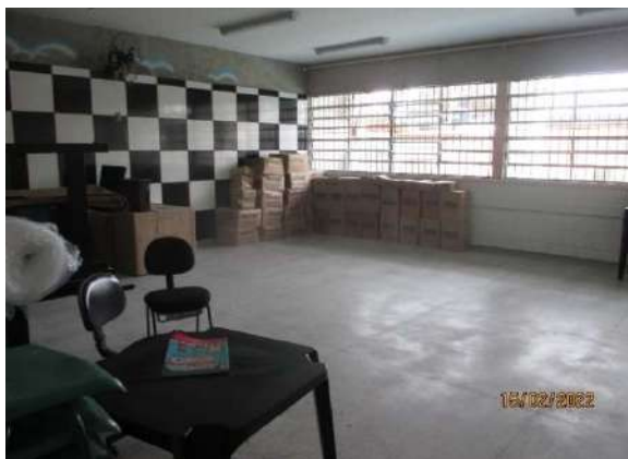
FOTO 30 SALA DE XADREZ COM TRINCAS NA PAREDE
