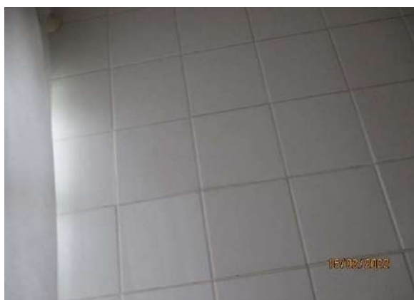
FOTO 87 SANITÁRIO FEMININO FUNCIONÁRIO COM TRINCA NO REVESTIMENTO
