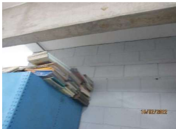
FOTO 168 SALA 12 COM TRINCAS
