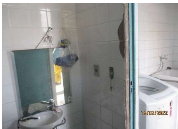
FOTO 23 VESTIÁRIO TERCEIRIZADA COM REVESTIMENTO QUEBRADO
