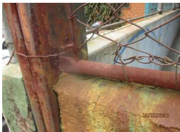
FOTO 11 QUADRA COBERTA COM ESTRUTURA METÁLICA COM CORROSÃO
