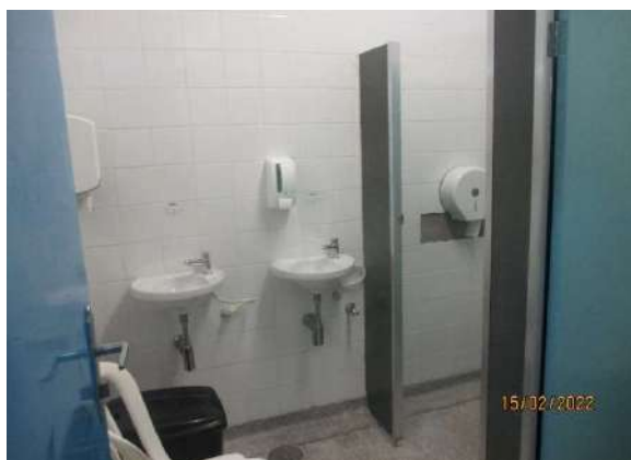
FOTO 137 SANITÁRIO FEMININO ALUNOS PAVIMENTO INTERMEDIÁRIO COM TRINCA NO REVESTIMENTO
