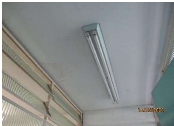
FOTO 135 SANITÁRIO MASCULINO ALUNOS PAVIMENTO INTERMEDIÁRIO COM INFILTRAÇÃO NO FORRO
