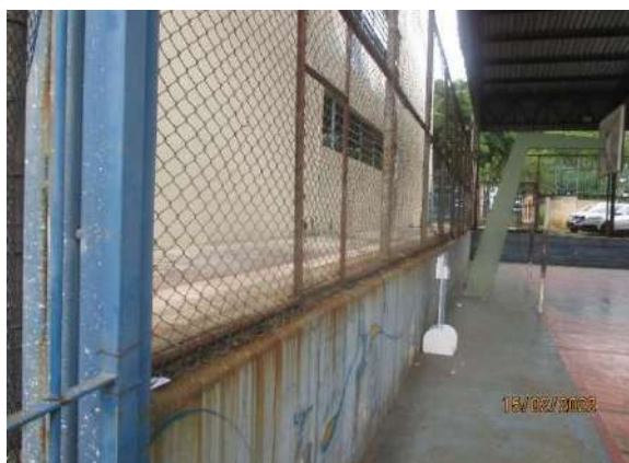
FOTO 106 QUADRA DE ESPORTES COBERTA GRADIL COM CORROSÃO
