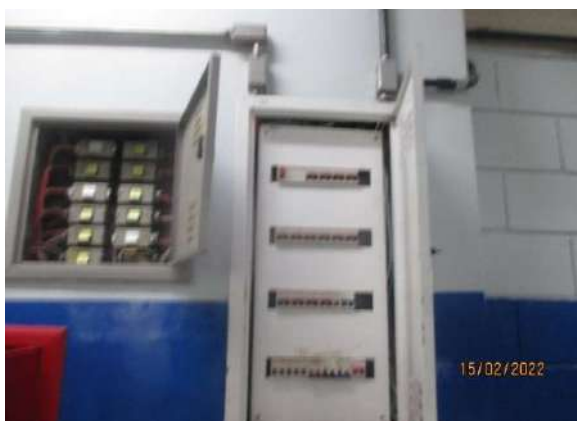
FOTO 129 QUADRO DISJUNTORES PAVIMENTO INTERMEDIÁRIO
