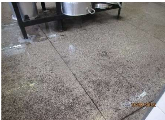
FOTO 61 COZINHA PISO COM TRINCAS
