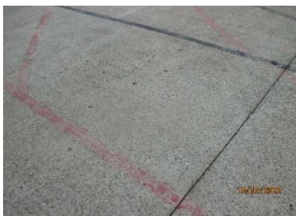
FOTO 100 QUADRA DESCOBERTA PINTURA DESCOLORIDA E PISO RÚSTICO
