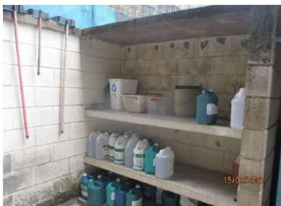
FOTO 25 DML COM MANCHAS DE MOFO E INFILTRAÇÃO
