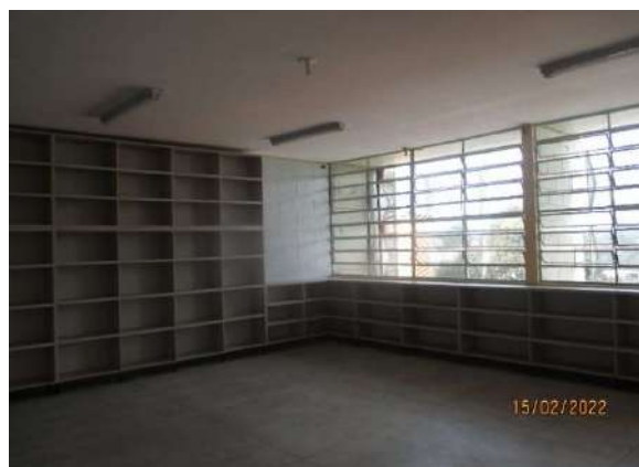
FOTO 158 SALA DE LEITURA COM INFILTRAÇÃO NA PAREDE
