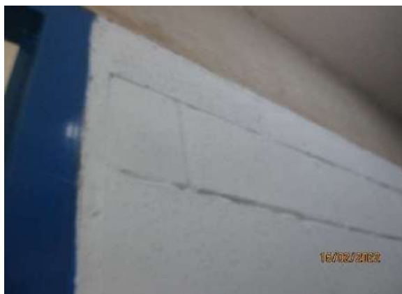
FOTO 43 DEPÓSITO 1 COM TRINCANA PAREDE
