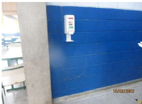
FOTO 33 SECRETARIA PAREDE COM TRINCA
