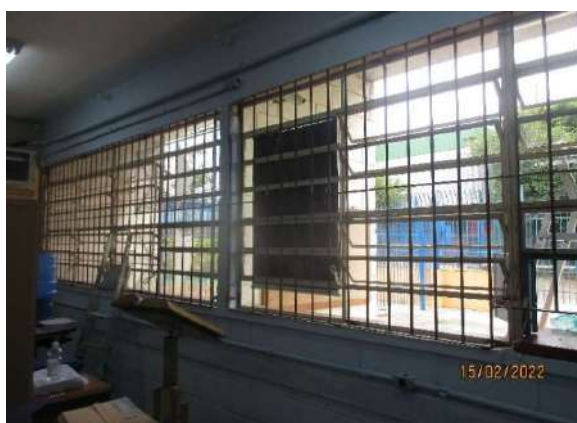
FOTO 35 SECRETARIA ESQUADRIA TRAVADA
