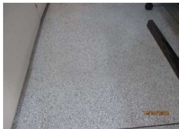
FOTO 88 SALA ASSISTENTE DIREÇÃO COM TRINCA NO PISO
