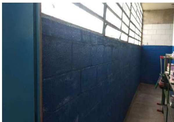
FOTO 183 PAREDE INTERNA FACHADA DIREITA COM INFILTRAÇÃO E PINTURA DESCASCANDO
