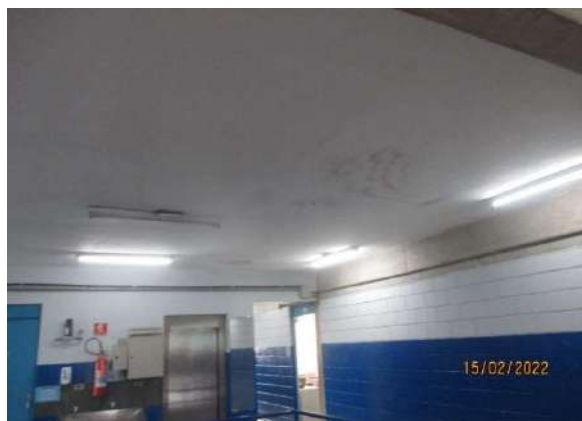
FOTO 156 PISO SUPERIOR COM INFILTRAÇÃO NO FORRO
