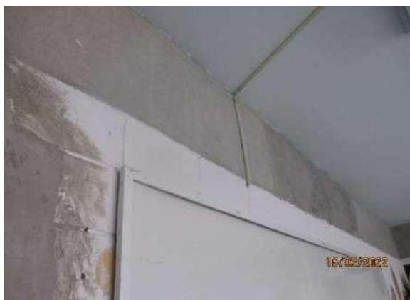
FOTO 31 SALA DE XADREZ COM TRINCAS NA PAREDE
