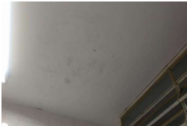
FOTO 81 SANITÁRIO ALUNO FEMININO COM INFILTRAÇÃO FORRO
