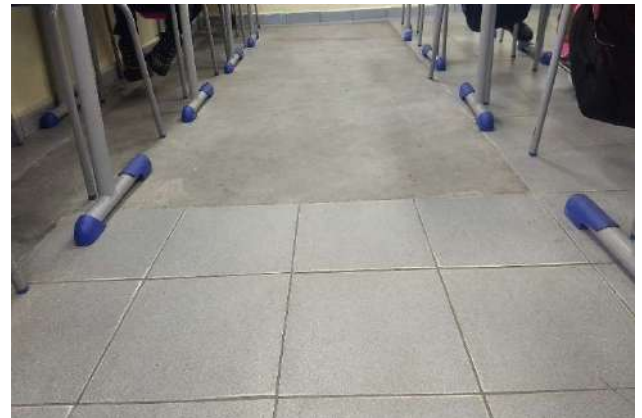
FOTO 76 SALA DE AULA 04 COM DESTACAMENTO DE PISO
