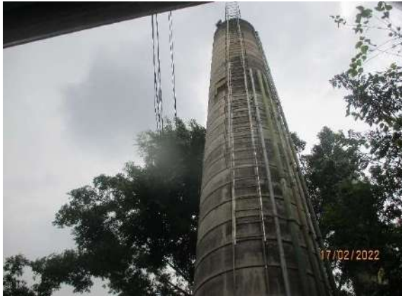
FOTO 7 RESERVATÓRIO DE ÁGUA COM MANCHAS E SUJIDADES
