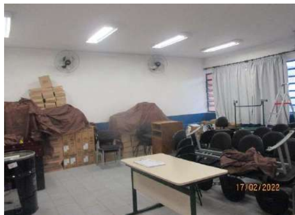
FOTO 33 SALA DE VÍDEO COM TRINCA NA PAREDE
