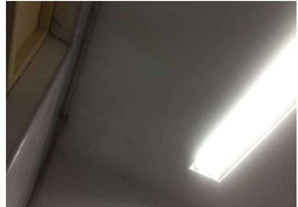
FOTO 58 VESTIÁRIO TERCEIRIZADA COM INFILTRAÇÃO
