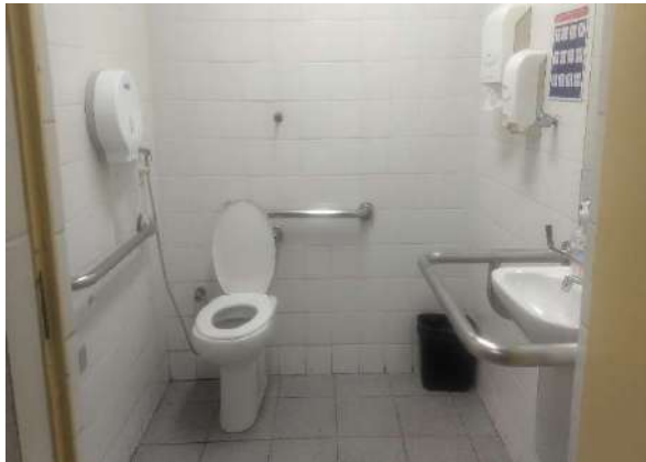
FOTO 55 SANITÁRIO PCD UNISEX TÉRREO
