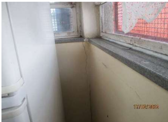
FOTO 45 COPA FUNCIONÁRIOS COM TRINCAS E FISSURAS NA PAREDE
