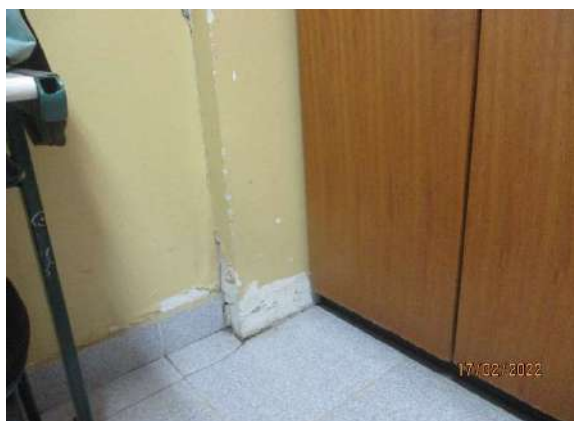
FOTO 47 COPA FUNCIONÁRIOS COM EFLORESCÊNCIA
