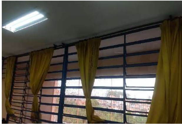
FOTO 115 SALA DE AULA 14 COM INFILTRAÇÃO
