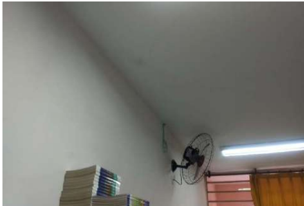
FOTO 111 SALA DE AULA 15 COM INFILTRAÇÃO NO FORRO E PAREDE
