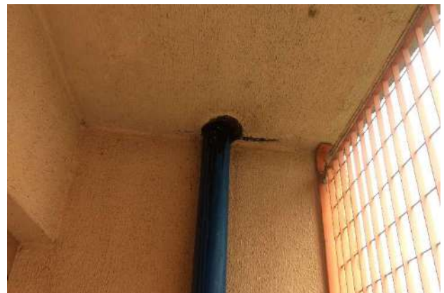
FOTO 114 VARANDA SALA DE AULA 15 COM INFILTRAÇÃO NO FORRO E PAREDE
