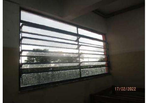
FOTO 38 ESQUADRIA TRAVADA LATERAL DO ELEVADOR
