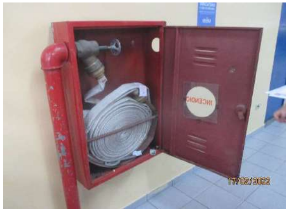
FOTO 31 HIDRANTE PISO TÉRREO
