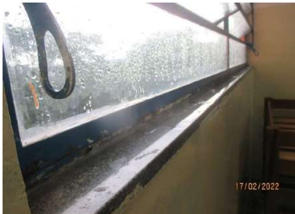
FOTO 39 ESQUADRIA TRAVADA LATERAL DO ELEVADOR
