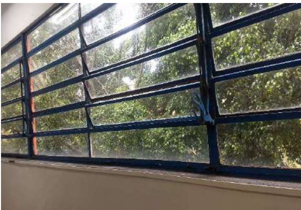
FOTO 117 ESQUADRIA LATERALESQUERDA COM CORROSÃO
