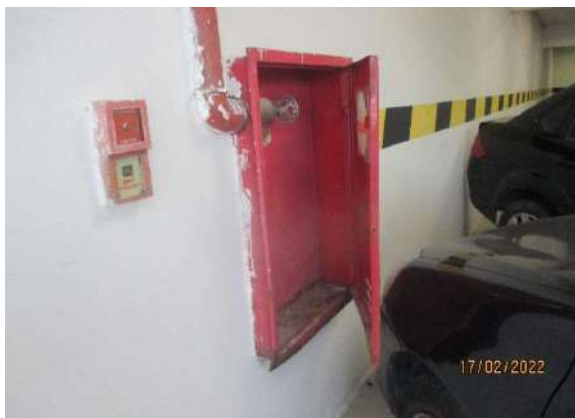
FOTO 11 CAIXA HIDRANTE DETERIORADA
