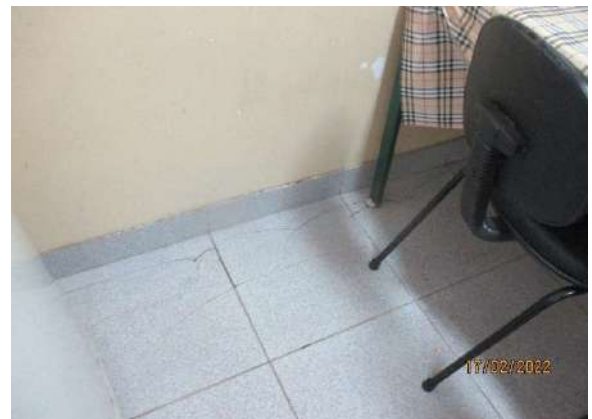
FOTO 46 COPA FUNCIONÁRIOS COM TRINCAS E FISSURAS NA PAREDE E PISO
