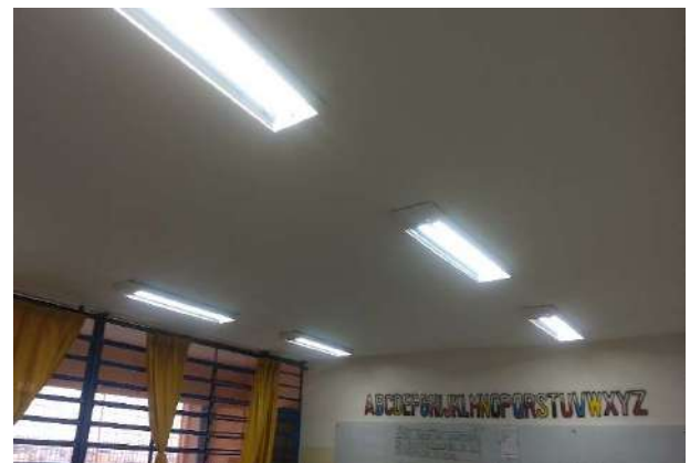
FOTO 118 SALA DE AULA 14 COM INFILTRAÇÃO
