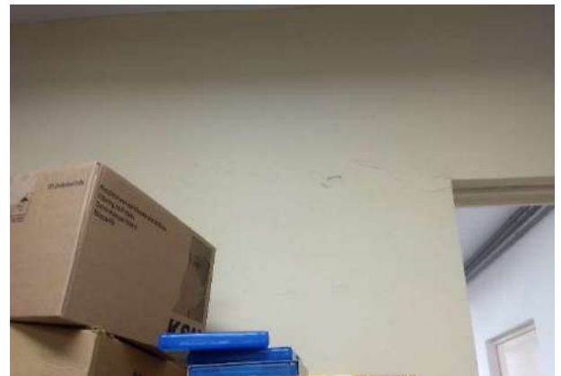
FOTO 118 SALA MATERIAL PEDAGÓGICO COM TRINCA NA PAREDE
