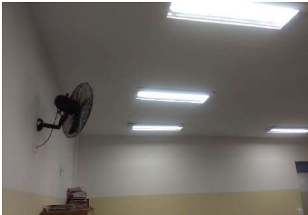
FOTO 103 SALA DE AULA 06 COM INFILTRAÇÃO NA PAREDE
