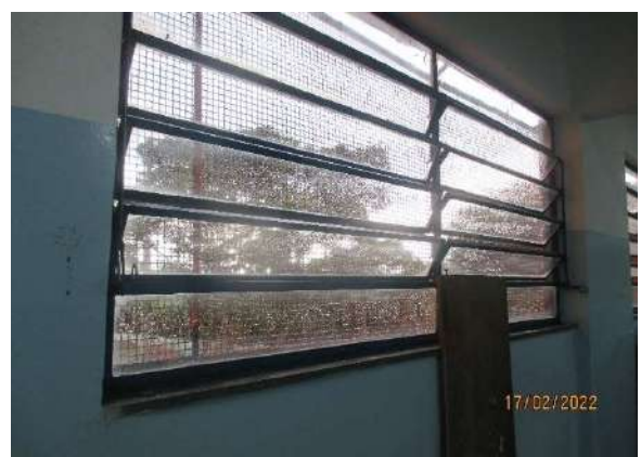
FOTO 42 ESQUADRIA TRAVADA NO SUBSOLO
