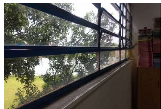
FOTO 118 ESQUADRIA LATERALESQUERDA COM CORROSÃO
