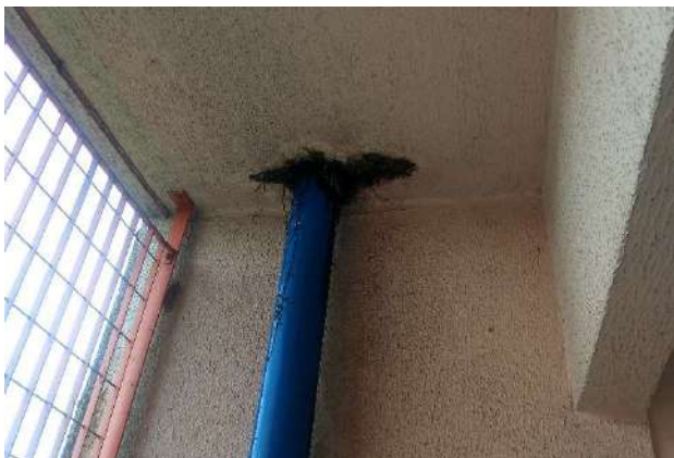
FOTO 117 VARANDA SALA DE AULA 14 COM INFILTRAÇÃO
