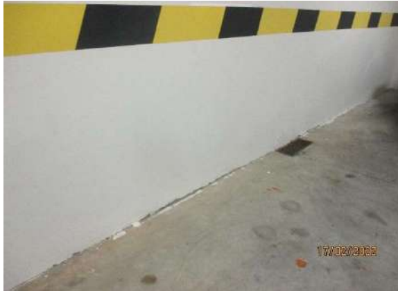
FOTO 13 PISO ESTACIONAMENTO PAREDE COM FISSURA E TRINCA
