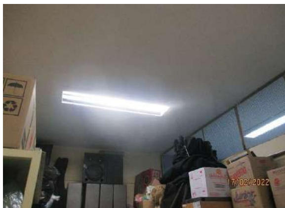
FOTO 29 ALMOXARIFADO COM SUJEIRAS NA PAREDE E FORRO
