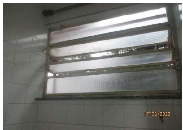
FOTO 16 SANITÁRIO FEMININO FUNCIONÁRIO COM TRINCA NA PAREDE
