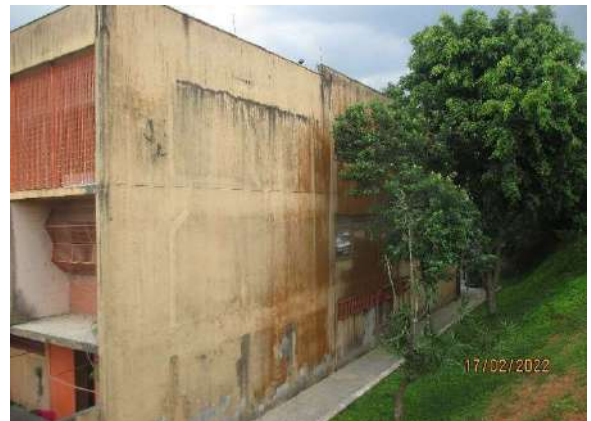
FOTO 4 FACHADA LATERAL ESQUERDA COM INFILTRAÇÃO, MANCHAS, ARMADURA EXPOSTA E SUJEIDADES
