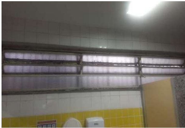
FOTO 61 SANITÁRIO FEMININO ALUNO TÉRREO COM VIDRO QUEBRADO
