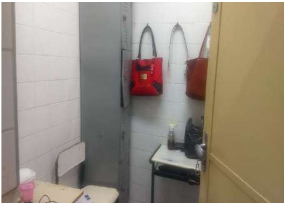
FOTO 57 VESTIÁRIO TERCEIRIZADA COM INFILTRAÇÃO
