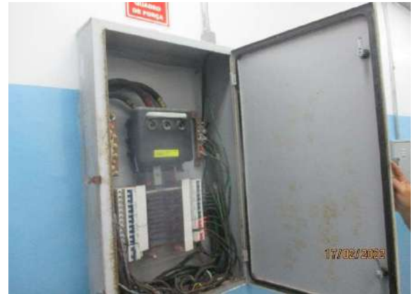
FOTO 20 QUADRO ENTRADA DE ENERGIA
