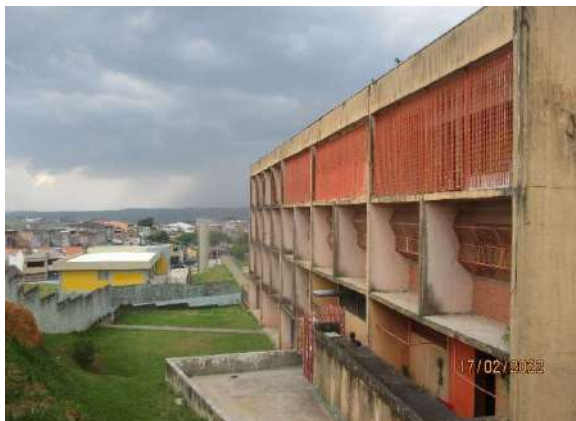
FOTO 3 FACHADA POSTERIOR (FUNDOS) COM MANCHAS, ARMADURA EXPOSTA E SUJEIDADES
