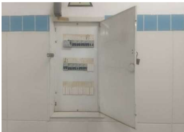
FOTO 59 QUADRO DE DISJUNTORES PAVIMENTO TÉRREO
