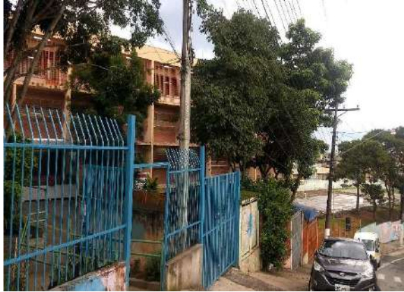
FOTO 1 FACHADA PRINCIPAL COM MANCHAS E SUJEIDADES
