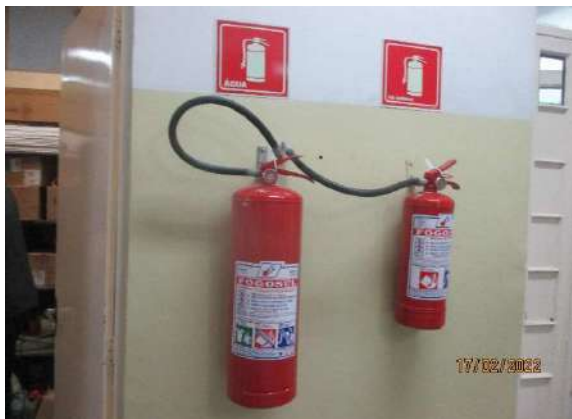
FOTO 27 EXTINTORES HALL PRINCIPAL
