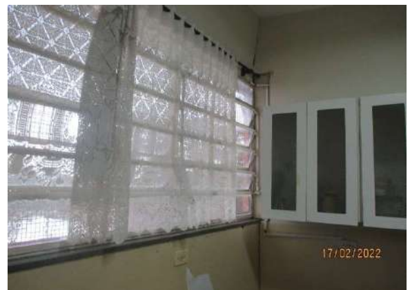
FOTO 44 COPA FUNCIONÁRIOS COM TRINCAS E FISSURAS NA PAREDE E CAXILHO ENFERRUJADO
