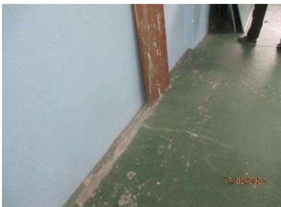
FOTO 41 ESTACIONAMENTO (SUBSOLO) COM RECALQUE DIFERENCIAL
