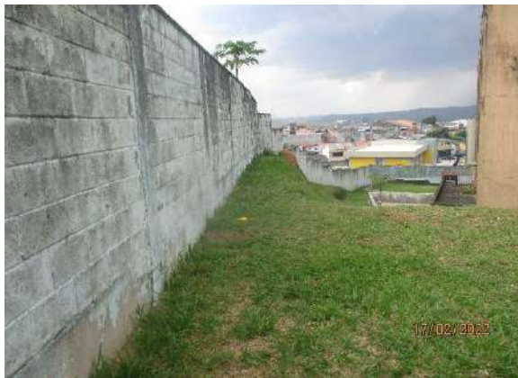
FOTO 5 MURO DIVISA FUNDOS
