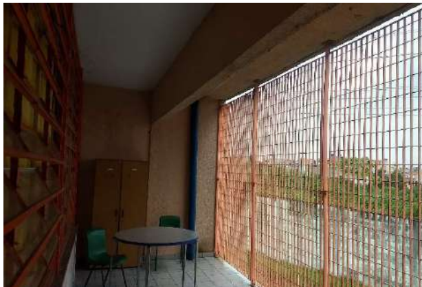
FOTO 113 VARANDA SALA DE AULA 15 COM INFILTRAÇÃO NO FORRO E PAREDE
