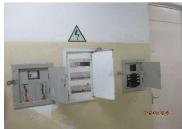
FOTO 30 QUADRO DE DISJUNTORES
