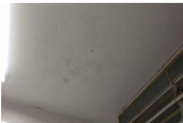
FOTO 83 VESTIÁRIO PRIMEIRO PAVIMENTO FORRO COM INFILTRAÇÃO
