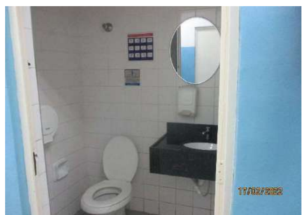
FOTO 18 SANITÁRIO MASCULINO FUNCIONÁRIO COM TRINCA NA PAREDE
