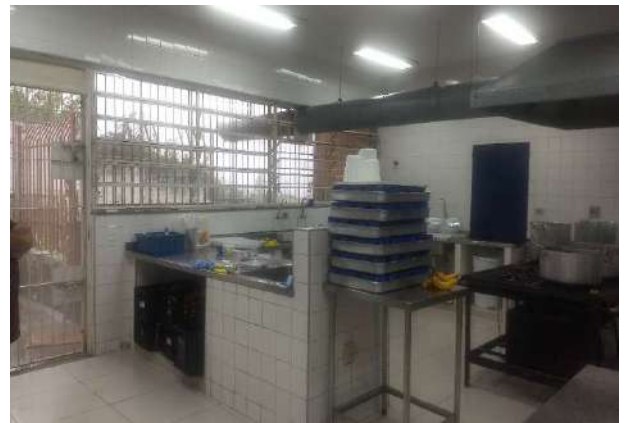
FOTO 62 COZINHA CAXILHO COM CORROSÃO E EXAUSTOR SUPERAQUECENDO
