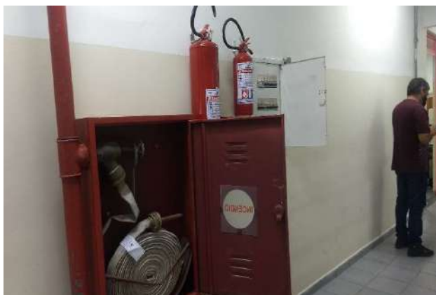
FOTO 77 HIDRANTE PAVIMENTO INTERMEDIÁRIO
