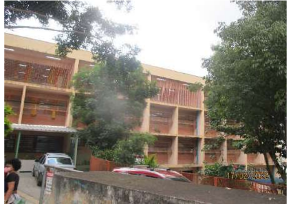
FOTO 2 FACHADA PRINCIPAL COM MANCHAS, ARMADURA EXPOSTA E SUJEIDADES
