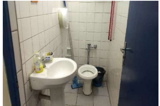
FOTO 92 SANITÁRIO TERCEIRIZADA COM CORROSÃO NO CAXILHO, PINTURA DESCASCANDO E E
