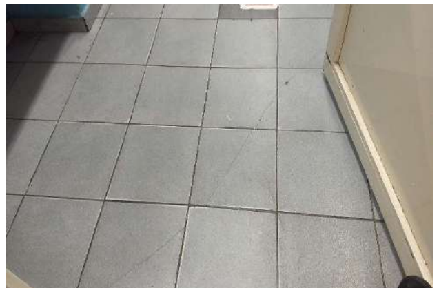
FOTO 120 VARANDA SALA DE LEITURA COM FISSURA PISO
