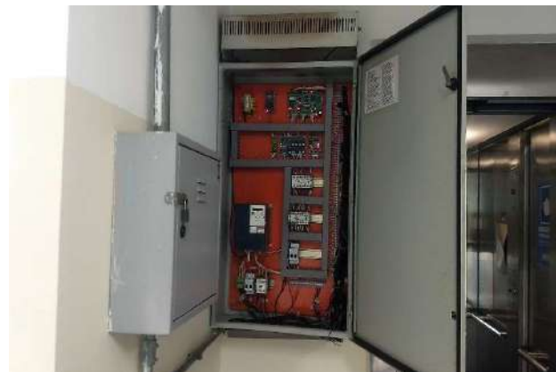
FOTO 118 QUADRO DE DISJUNTORES ELEVADOR
