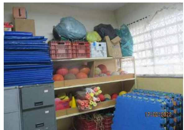
FOTO 48 SALA EDUCAÇÃO FÍSICA PAREDE COM TRINCA E FISSURA
