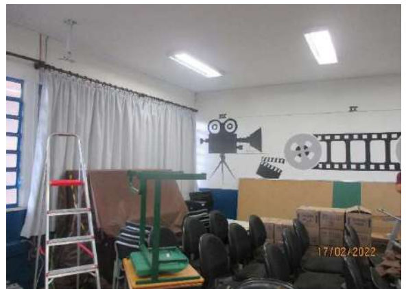
FOTO 34 SALA DE VÍDEO COM TRINCA NA PAREDE
