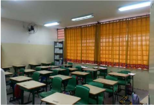
FOTO 109 SALA DE AULA 15 COM INFILTRAÇÃO NO FORRO E PAREDE
