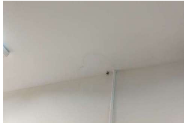
FOTO 110 SALA DE AULA 15 COM INFILTRAÇÃO NO FORRO E PAREDE
