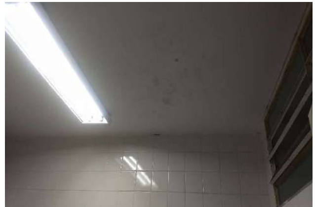
FOTO 80 SANITÁRIO ALUNO FEMININO COM INFILTRAÇÃO FORRO E PAREDE COM TRINCA
