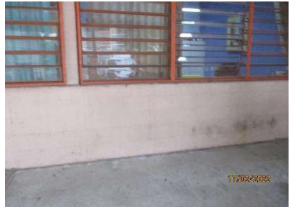
FOTO 8 PAREDE EXTERNA SECRETARIA COM MANCHAS E SUJIDADES
