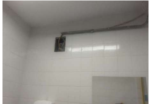
FOTO 56 SANITÁRIO PCD UNISEX TÉRREO COM FIAÇÃO EXPOSTA PAREDE COM TRINCA
