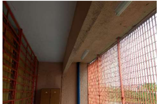
FOTO 112 VARANDA SALA DE AULA 15 COM INFILTRAÇÃO NO FORRO E PAREDE
