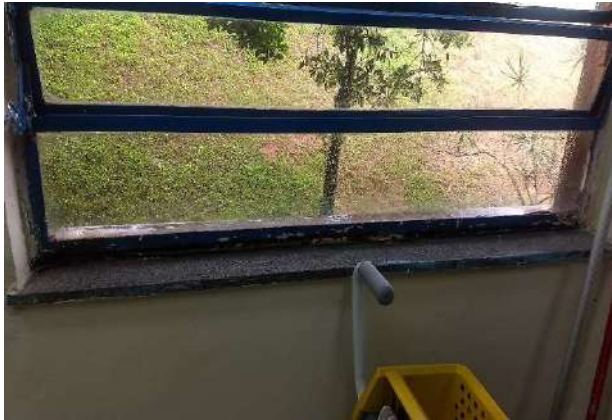
FOTO 91 CAXILHO FACHADA LATERAL DIREITA DIREITA PRIMEIRO ANDAR COM CORROSÃO E
