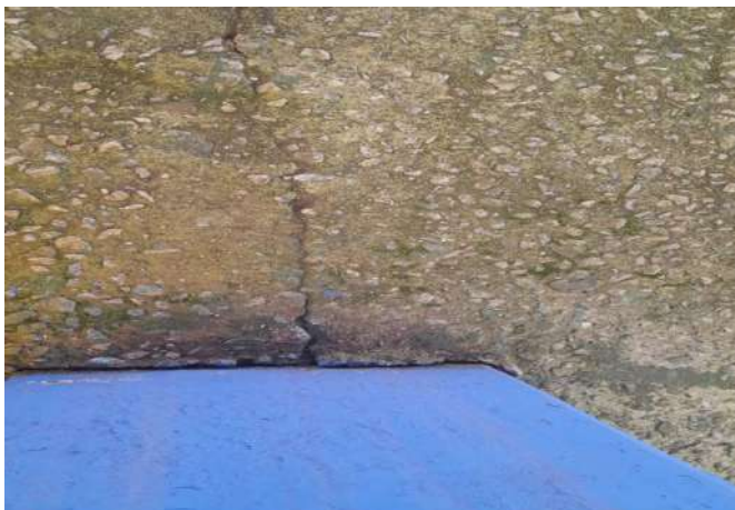
FOTO 55 Trinca no piso de acesso a quadra de esportes
