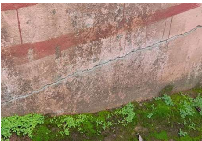
FOTO 75 Trincas na entrada de acesso de carga e descarga
