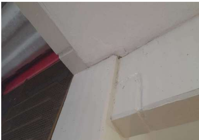
FOTO 37 Infiltração próximo a escada de acesso ao pátio
