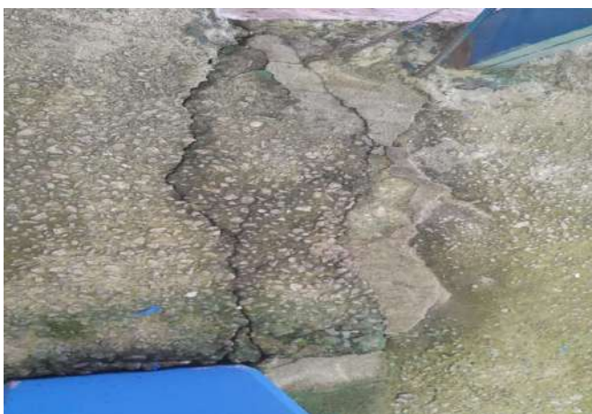
FOTO 9 Trincas no piso de acesso a quadra de esportes
