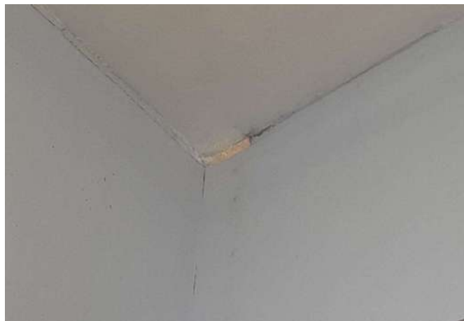
FOTO 80 Infiltração no teto
