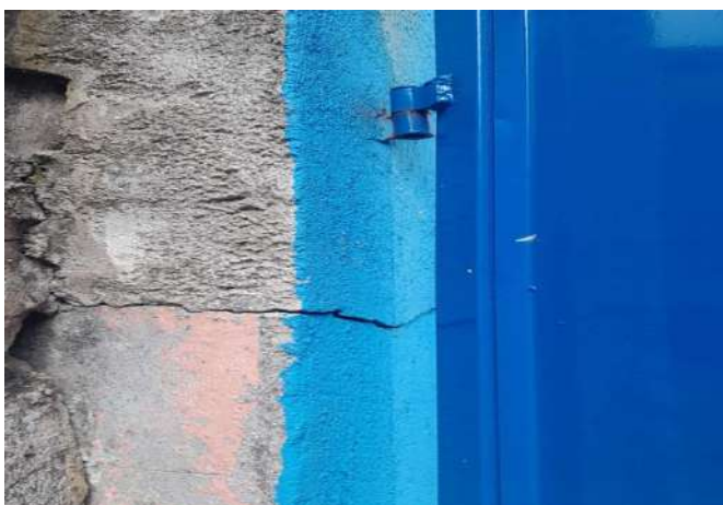
FOTO 3 Trincas na entrada de acesso de carga e descarga
