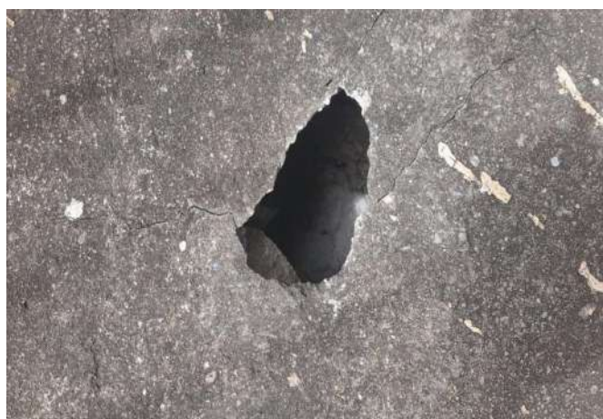
FOTO 18 Piso de acesso a secretária com trincas
