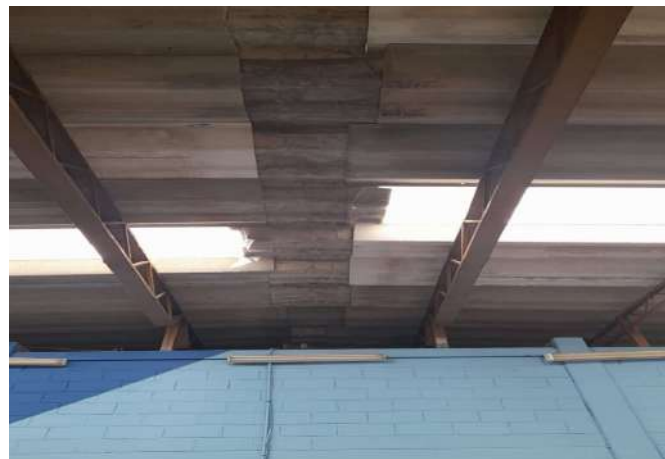
FOTO 2 Vazamento no telhado do pátio
