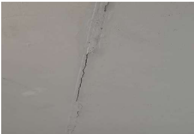
FOTO 7 Trinca na parede da sala 1
