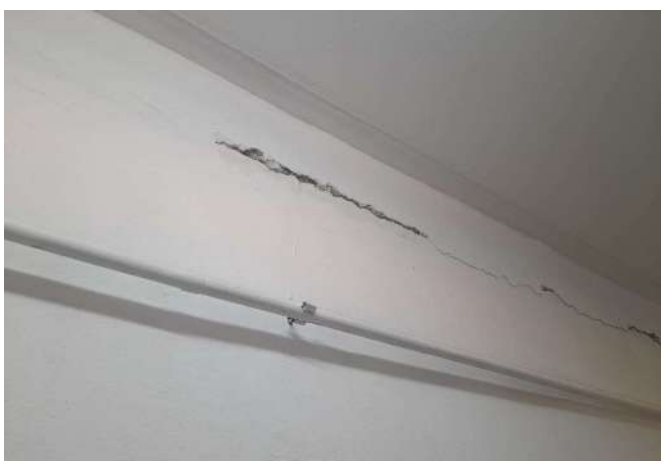
FOTO 59 Trinca na parede do banheiro masculino no andar superior
