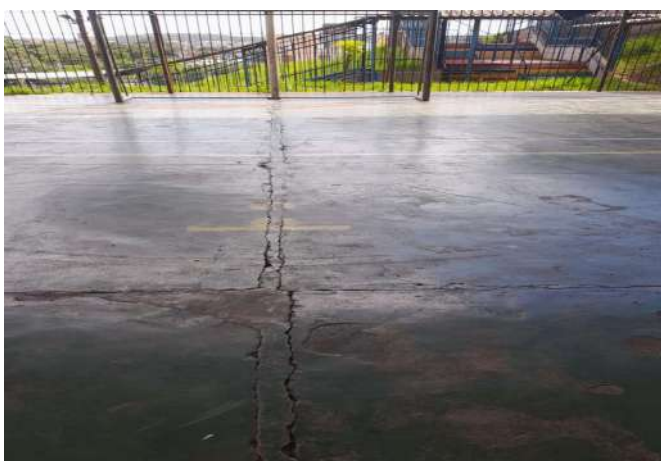
FOTO 11 Trincas na sala de esportes
