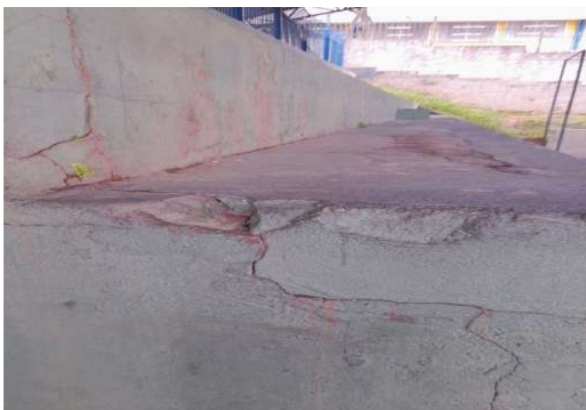
FOTO 53 Trincas na arquibancada da quadra de esportes
