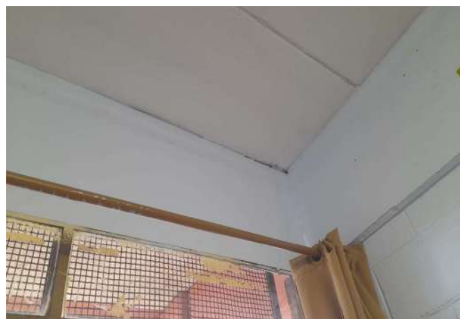
FOTO 10 Infiltração no teto da sala 14
