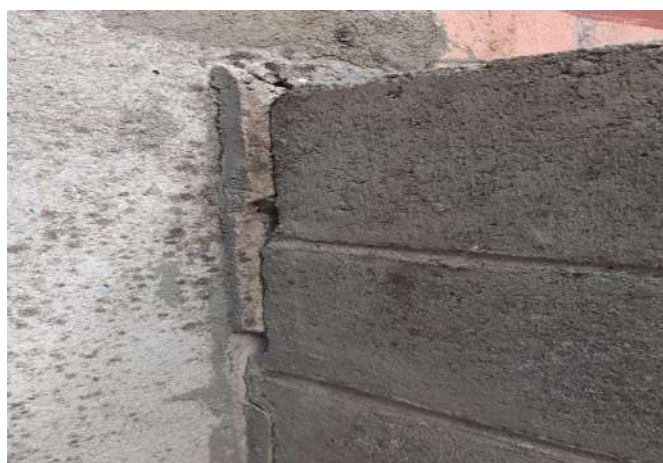
FOTO 78 Trincas na entrada de acesso de carga e descarga
