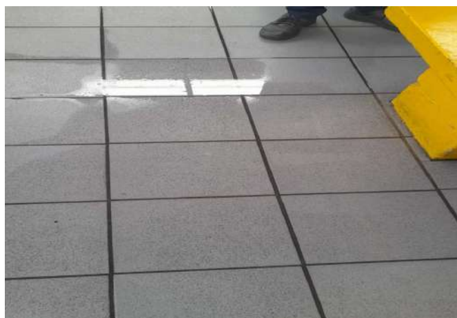
FOTO 64 Caimento do piso invertido
