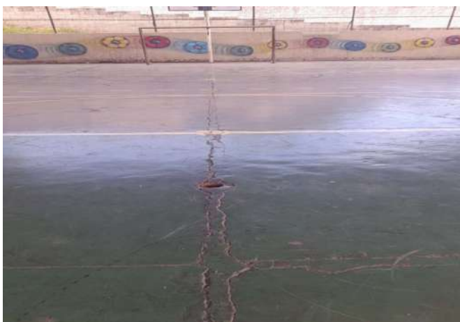
FOTO 51 Trincas na quadra de esportes
