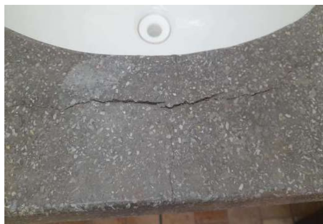
FOTO 12 Trinca na pia de mármore no banheiro masculino no piso superior
