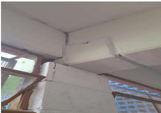
FOTO 49 Trinca no pré moldado frente a sala 07 do piso inferior
