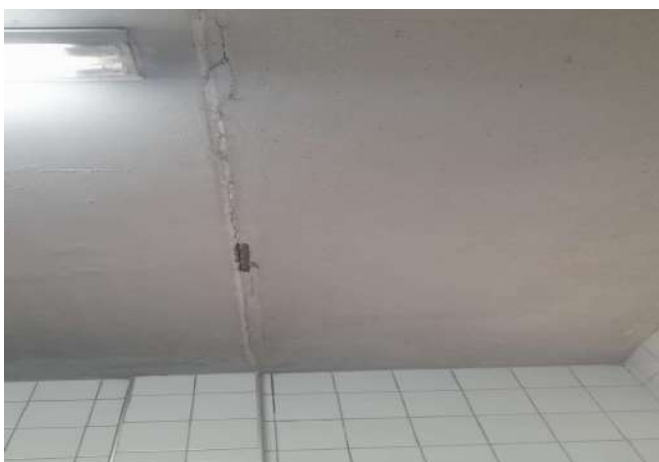
FOTO 63 Infiltração no teto da cozinha
