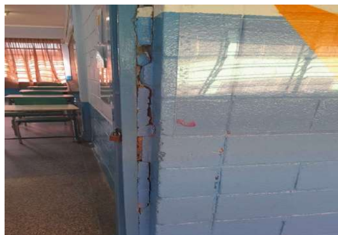
FOTO 4 Trinca na porta da sala 01 no piso inferior
