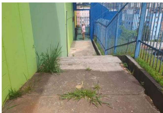
FOTO 72 Piso de acesso a secretária com trincas
