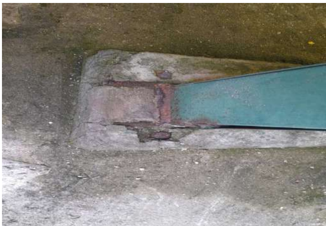
FOTO 79 Trinca no piso de acesso à quadra de esportes
