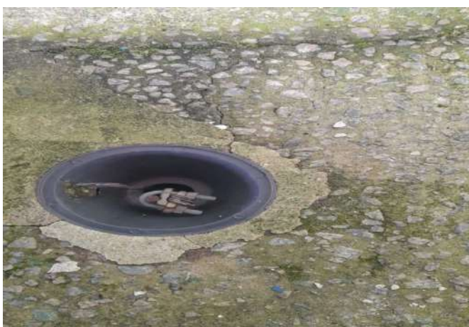
FOTO 71 Falta as tampas das caixas de aterramento
