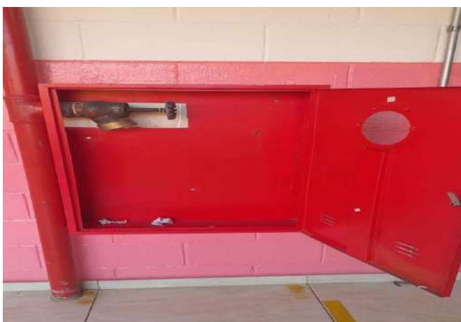
FOTO 65 Falta a mangueira e chave de acionamento do hidrante no corredor do andar superior próximo a sala
