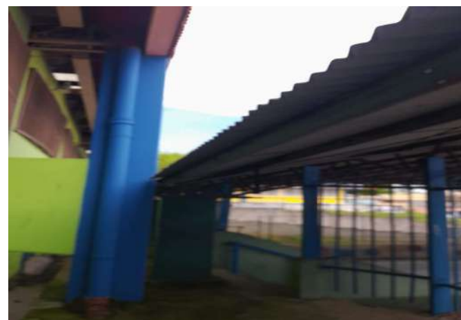
FOTO 40 Sem coleta de águas pluviais, nas extensão de 40 metros
