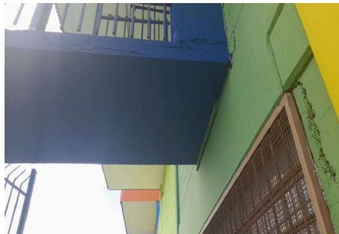
FOTO 8 Trincas na laje de acesso a secretária
