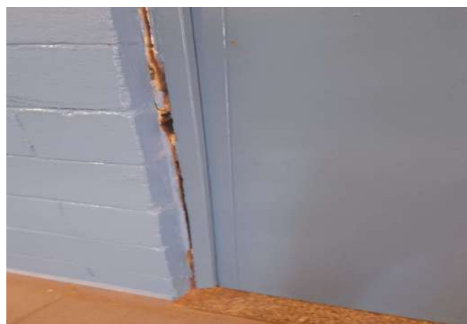
FOTO 6 Trinca na porta da sala multiuso no piso inferior - Sala de Aula 3
