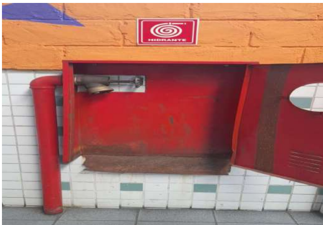
FOTO 13 Caixa do hidrante danificada
