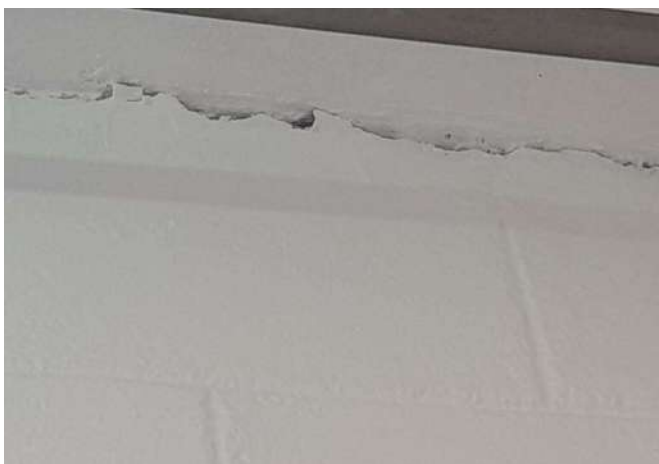
FOTO 41 Trinca no teto da entrada do WC
