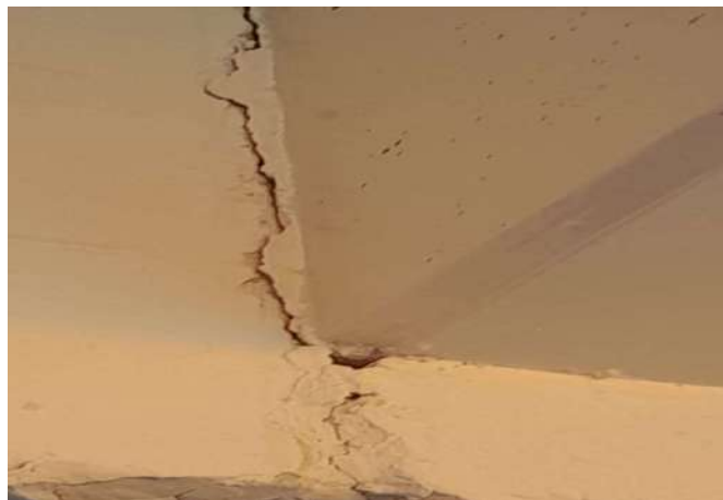
FOTO 62 Trinca na parede e teto na entrada da sala 10
