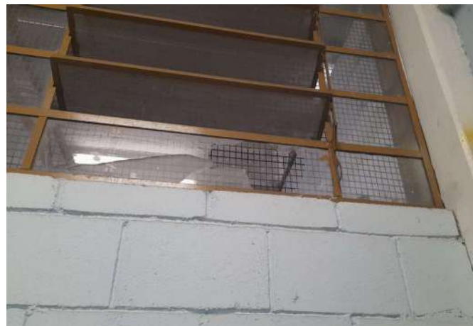
FOTO 56 Infiltração na sala de depósito e vidro do vitro quebrado
