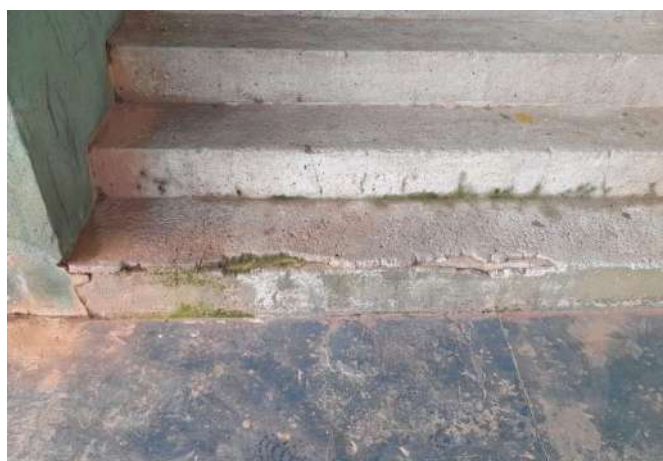
FOTO 66 Trincas na arquibancada da quadra de esportes
