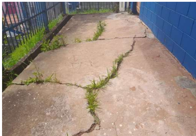
FOTO 50 Piso de acesso a secretária com trincas
