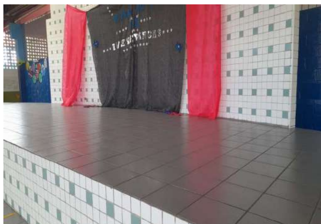
FOTO 16 40% do piso no palco do piso inferior está comprometido
