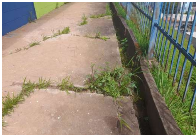
FOTO 38 Piso de acesso a secretária com trincas
