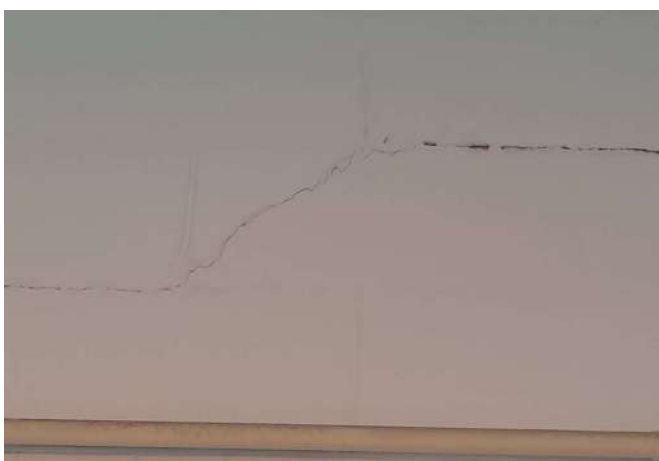
FOTO 17 Trinca na parede da sala 18
