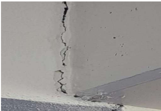
FOTO 67 Trinca na parede da sala 01
