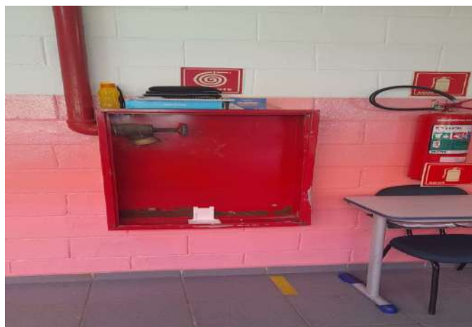
FOTO 54 Caixa de hidrante falta a porta e a mangueira
