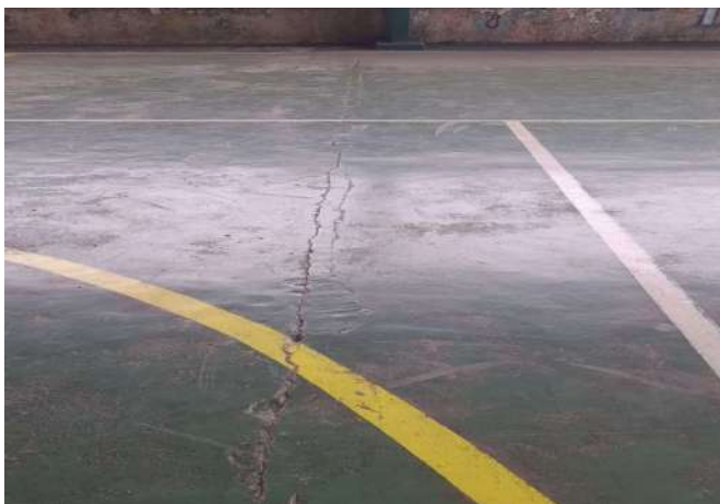
FOTO 73 Trincas na quadra de esportes
