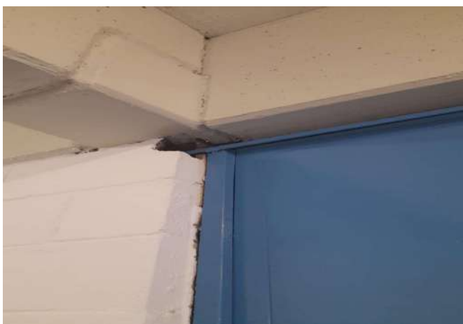
FOTO 69 Trinca na porta da sala multiuso no piso inferior
