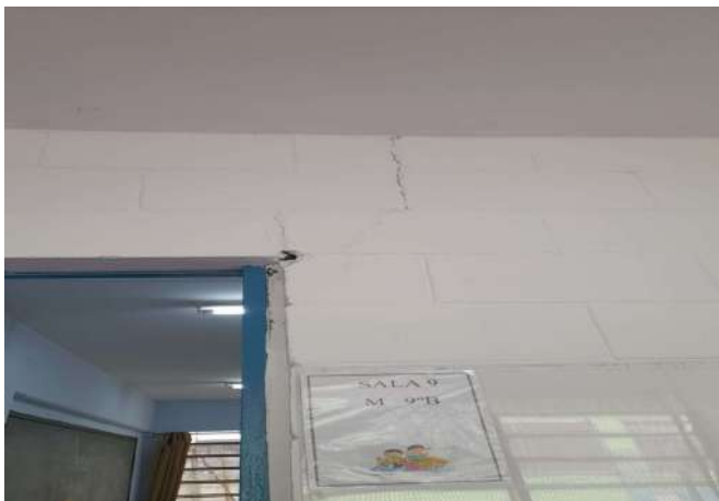
FOTO 61 Trinca na parede da sala 09 do piso inferior
