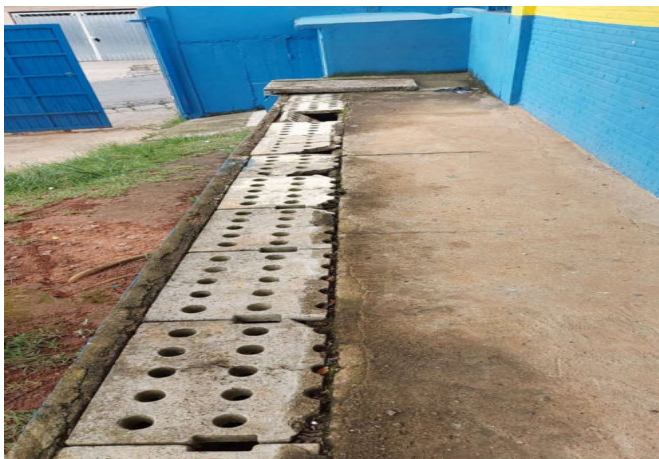
FOTO 27 GRELHAS DE CONCRETO COM TRINCAS E AVARIAS - QUADRA DESCOBERTA
