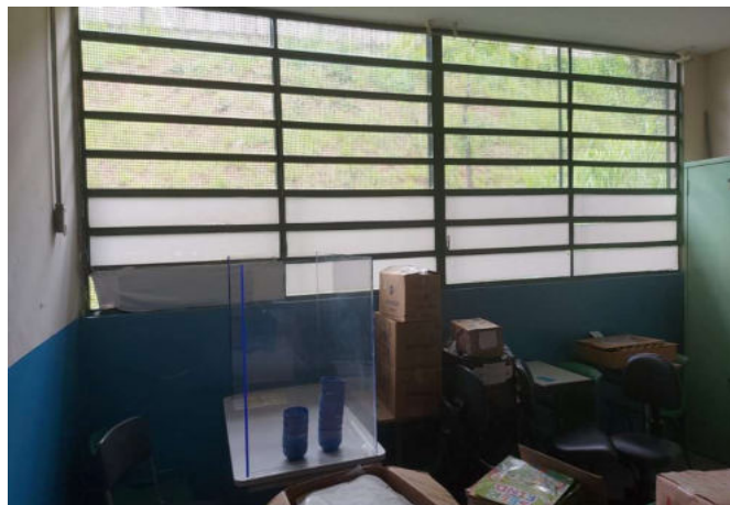
FOTO 26 SALA 1 VIDRO QUEBRADO - ALMOJARIFADO
