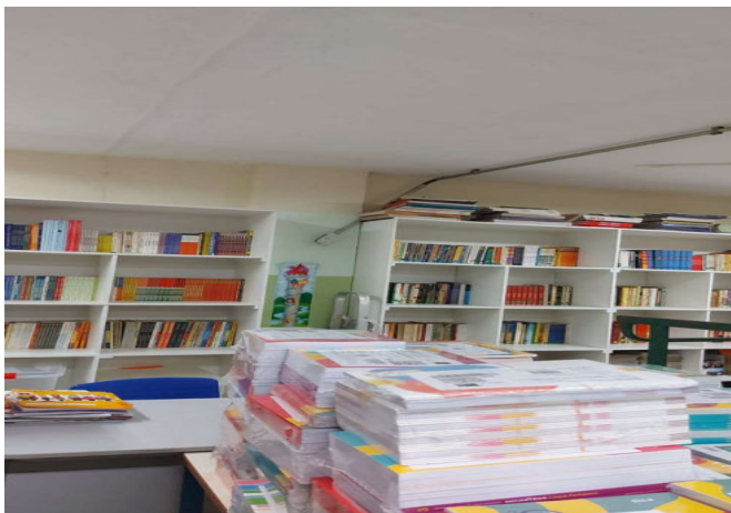
FOTO 1 TRINCA NO FORRO DA SALA DE LEITURA
