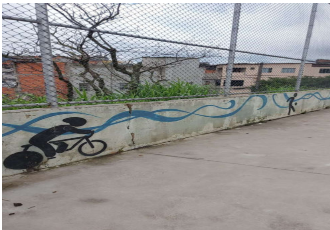
FOTO 13 TRINCA NO MURO DA QUADRA DESCOBERTA
