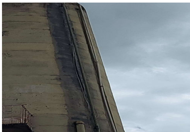
FOTO 4 VAZAMENTO NA PRUMADA - ÁREA EXTERNA
