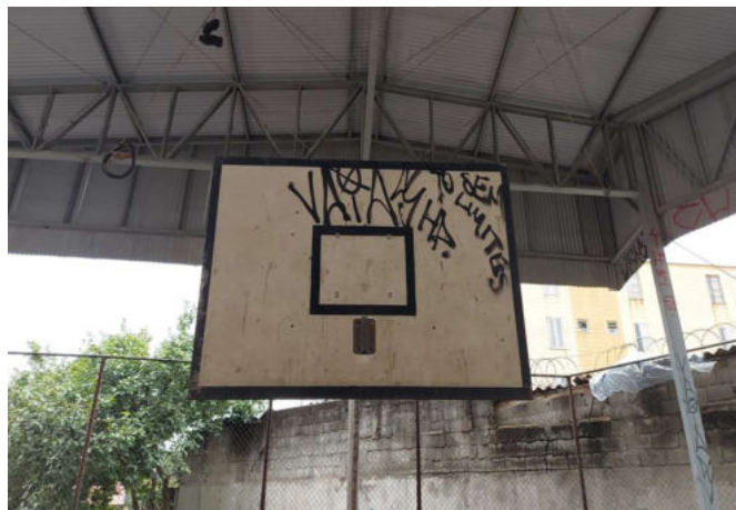
FOTO 14 TABELAS E AROS VANDALIZADOS E ENFERRUJADOS - QUADRA COBERTA
