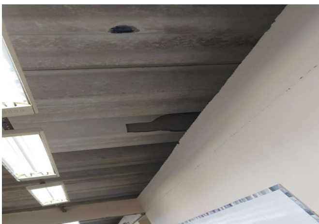
FOTO 15 TRINCAS NO TELHADO DO REFEITÓRIO
