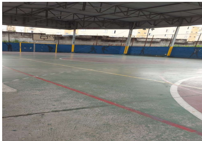
FOTO 32 PINTURA DO PISO DA QUADRA COBERTA GASTO
