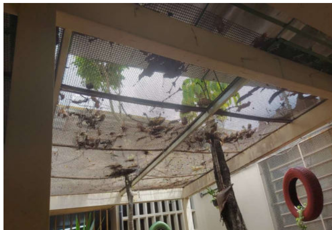
FOTO 2 FORRO GERA ACUMULO DE SUJEIRA DIRETORA SOLICITOU A RETIRADA - JARDIM
