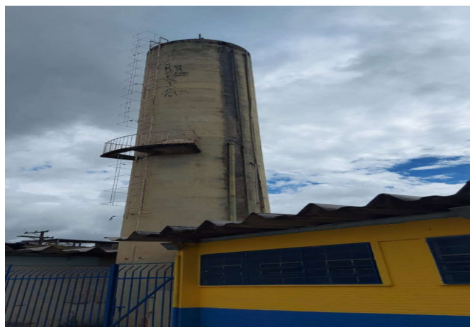
FOTO 30 CAIXA D'ÁGUA COM MANCHA DE UMIDADE
