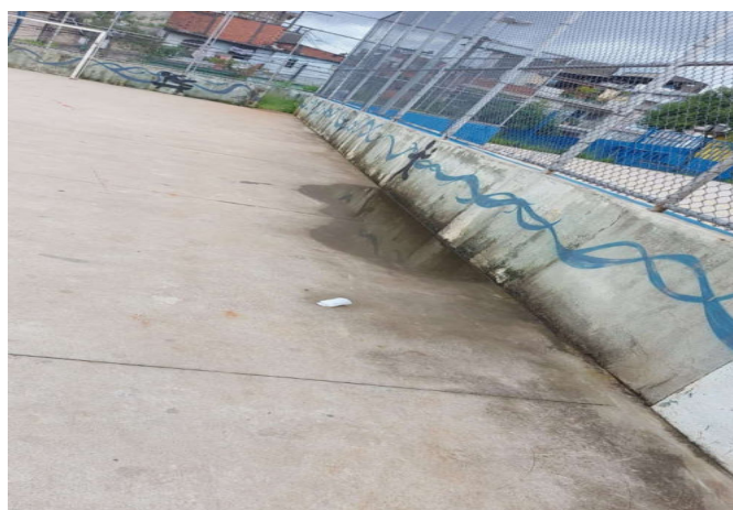
FOTO 6 DESNIVEL NO PISO - QUADRA DESCOBERTA
