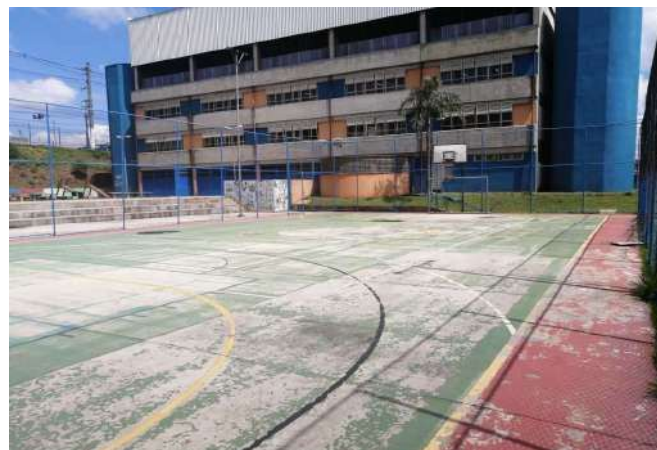
FOTO 26 Quadra descoberta - Visão geral, pintura desgastada (area de esportes)
