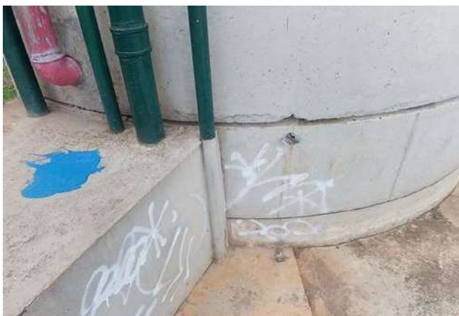
FOTO 107 Fita de alumínio do para raios foi furtada (pé da torre da caixa d'água) UE desprotegida
