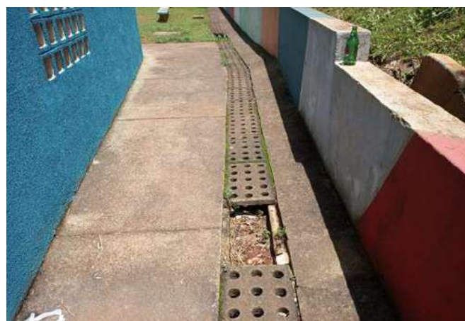
FOTO 100 Canaleta sem as grelhas de concreto
