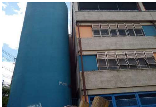
FOTO 102 A parede umida na edificação ao lado da caixa da escada (cor azul)
