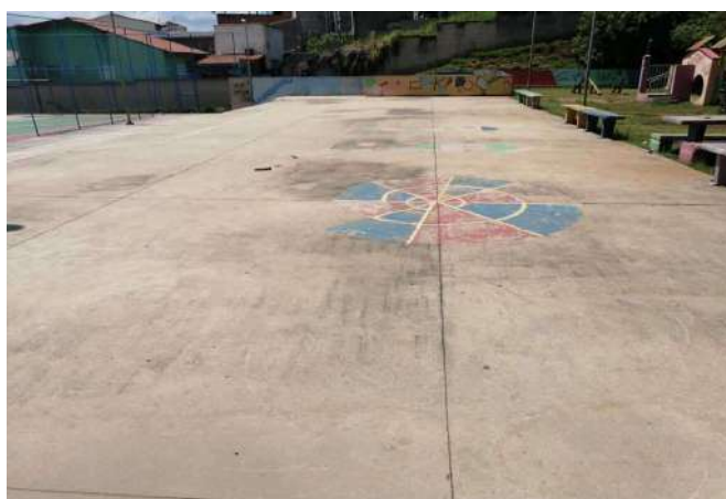
FOTO 23 Patio Descoberto - Pintura desgastada
