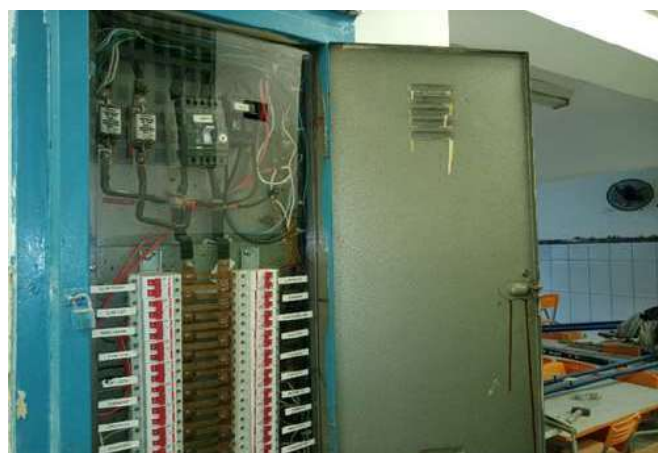
FOTO 106 QD com disjuntor DIN, circuitos nominados, e fiação sem canaleta
