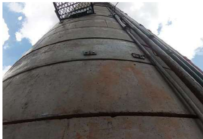
FOTO 104 O 1 módulo da escada de marinheiro foi cortado e furtado da torre da caixa d'água
