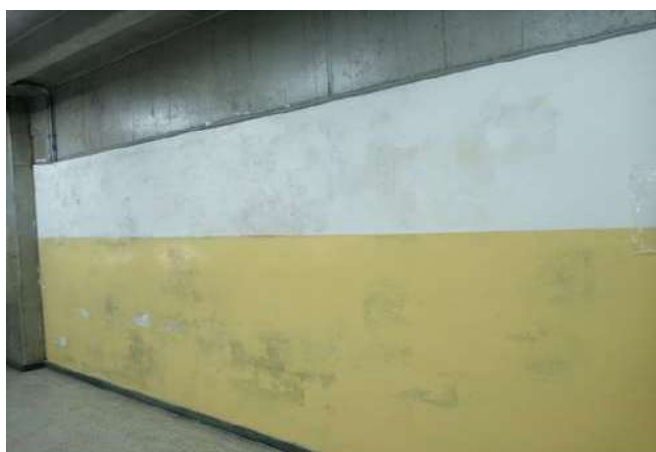
FOTO 101 Parede umida no 2º andar, cuja umidade vem da quadra poliesportiva
