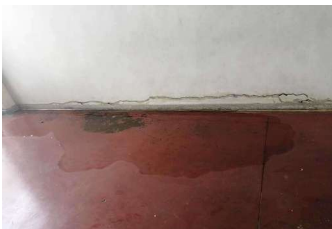
FOTO 33 Quadra coberta - Fissuras (parede e piso)
