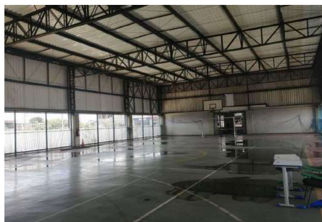
FOTO 28 Quadra coberta - Entrada de água proveniente das laterais, no 3º andar da edificação
