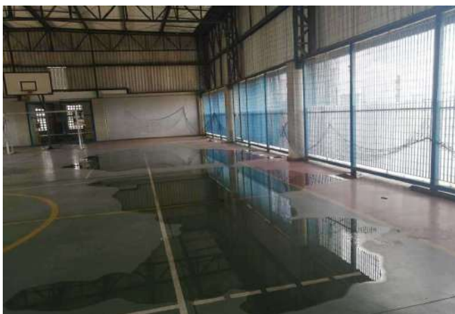
FOTO 29 Quadra coberta, com água na lateral direita
