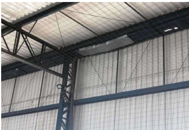
FOTO 31 Quadra coberta - Furo na calha
