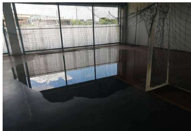
FOTO 30 Quadra coberta, com água na lateral esquerda
