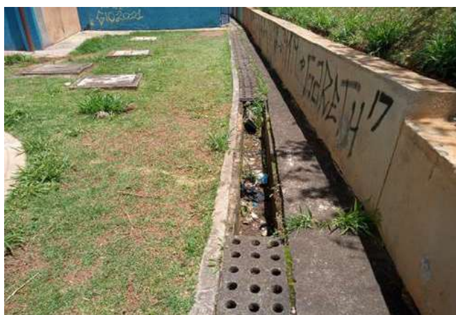
FOTO 99 Canaleta sem as grelhas de concreto
