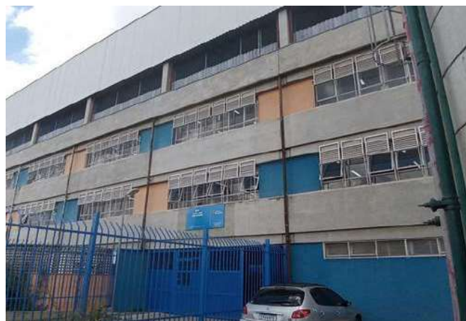
FOTO 108 Não existe descida de para raios na edificação
