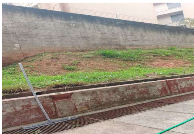
FOTO 16 Sistema pluvial em frente o pátio coleta no do condomínio externo e também da escola, todavia em
