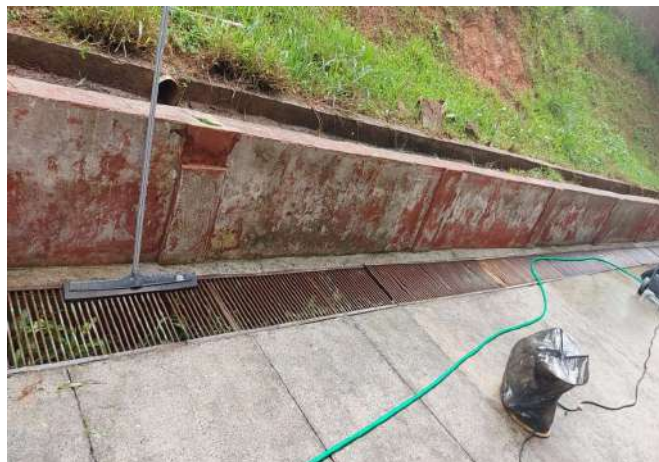
FOTO 20 Sistema pluvial em frente o pátio coleta no do condomínio externo e também da escola, todavia em
