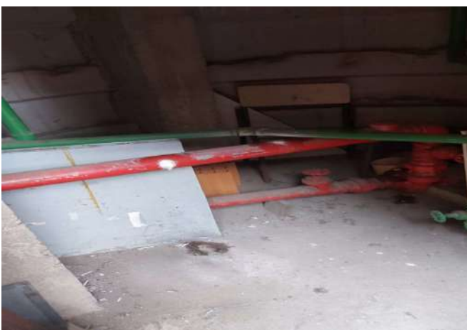
FOTO 33 Falta bomba de pressurização
