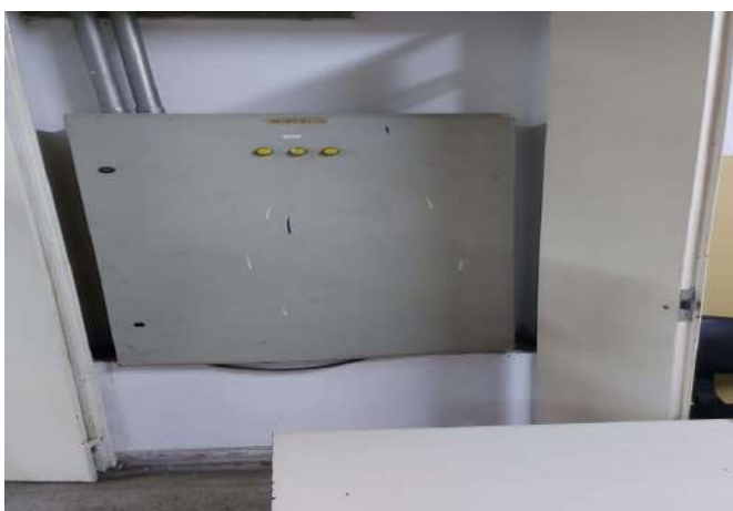
FOTO 5 Quadro de força principal no Térreo
