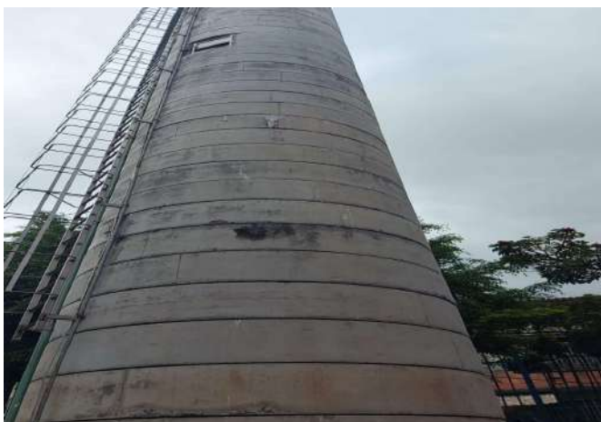
FOTO 53 Falta abrigo de apoio para acessar a célula superior do reservatório
