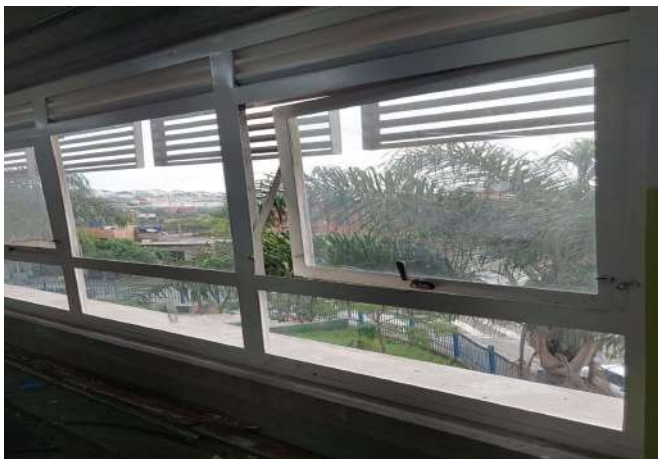
FOTO 13 Quebra de basculante de janela é frequentemente
