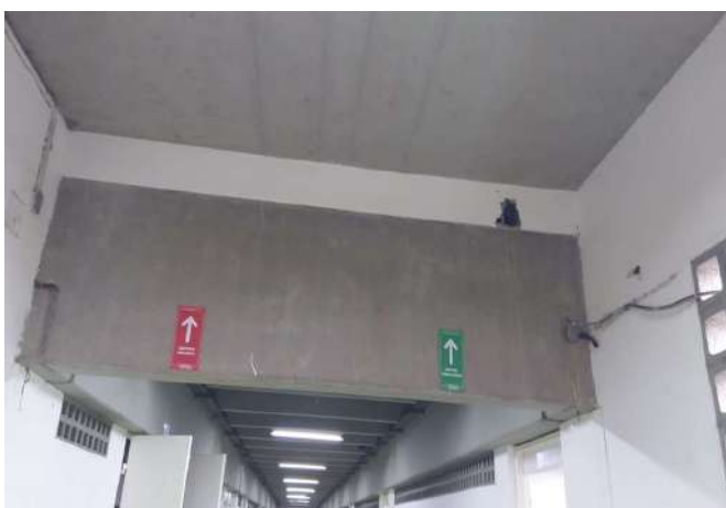
FOTO 11 Furo no vazio para retirar água parada infiltrando
