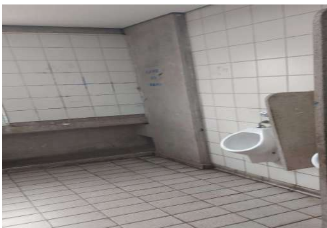
FOTO 9 Os wc's masculino e feminino devido o recalque de solo, trincou piso, paredes.
