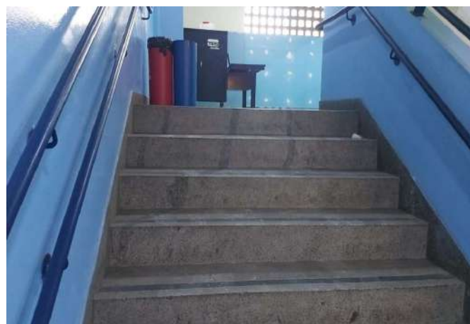
FOTO 10 Escada com trincas devido um incêndio ocorrido na sala debaixo
