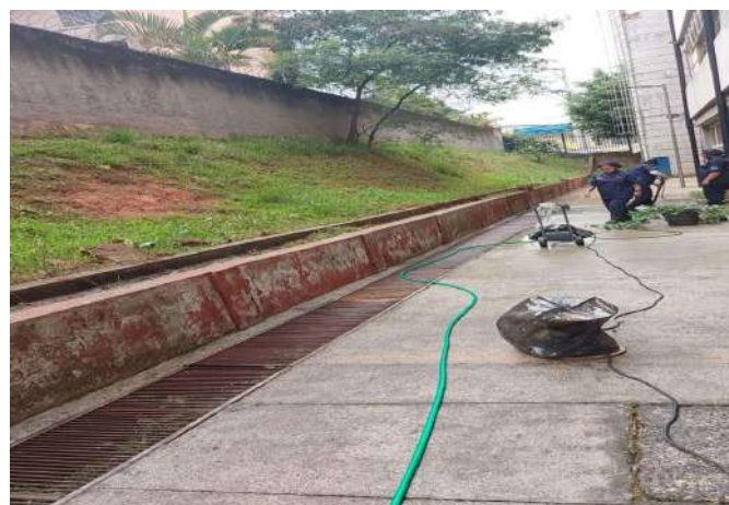
FOTO 40 Sistema pluvial em frente o pátio coleta no do condomínio externo e também da escola, todavia em
