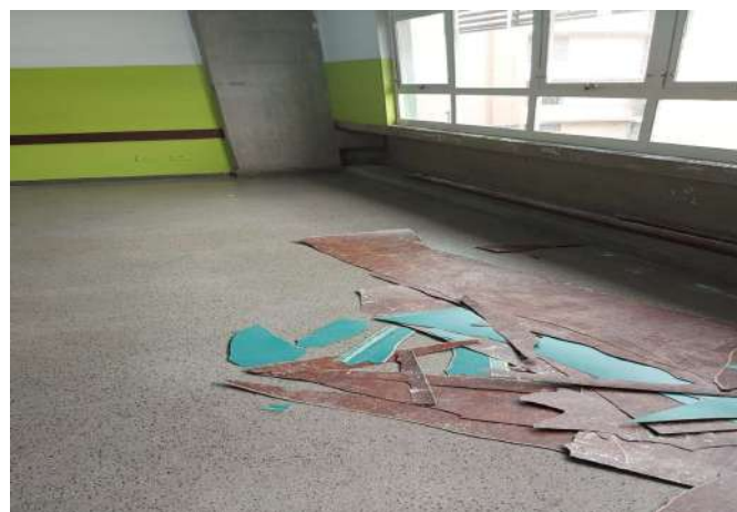
FOTO 4 Trinca no piso granilite na entrada dos wc do 3º pavimento
