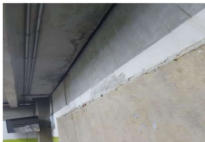
FOTO 36 Esta água represada no vazio infiltração na sala 19 e percolava água no pilar também
