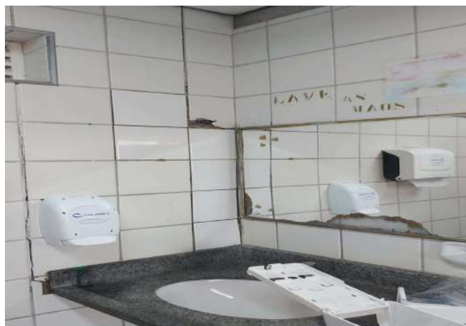
FOTO 54 Os wc's masculino e feminino devido o recalque de solo, trincou piso, paredes.
