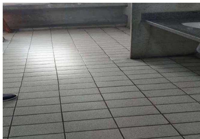
FOTO 34 Os wc's masculino e feminino devido o recalque de solo, trincou piso, paredes.
