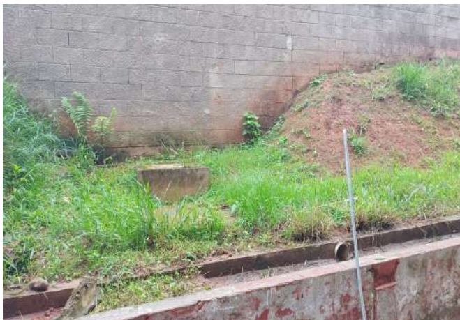
FOTO 55 Infiltração no muro
