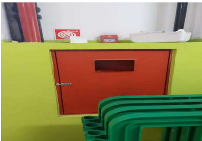
FOTO 17 Só tem botão de alarme porém não tem o botão que ativa a bomba de incêndio
