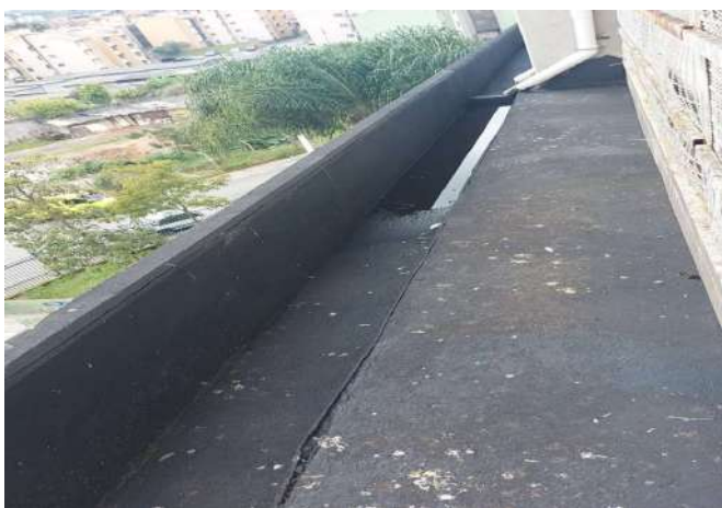
FOTO 21 Infiltração na calha
