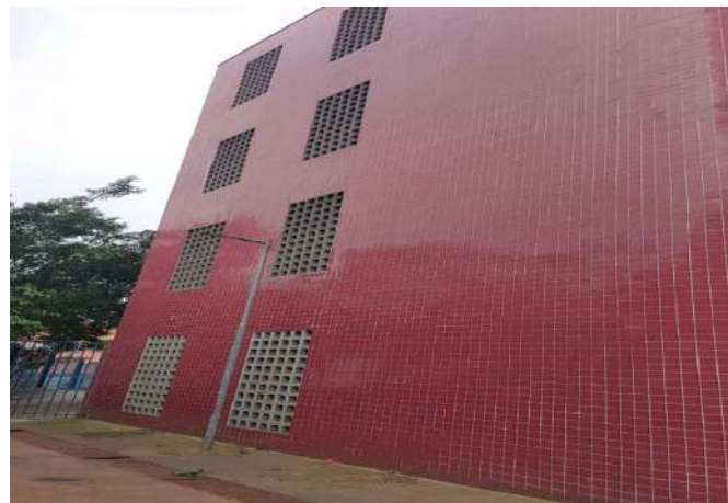
FOTO 8 Bloco de cimento no lugar dos elementos vazados
