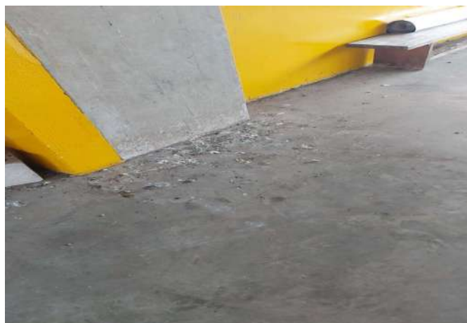
FOTO 60 O prédio sofre com os pombos
