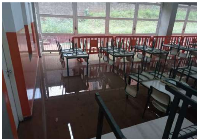
FOTO 24 Alagamento do pátio
