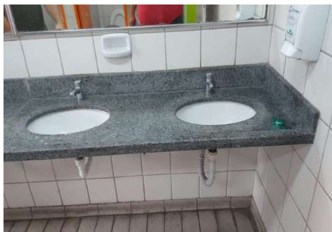
FOTO 52 Os wc's masculino e feminino devido o recalque de solo, trincou piso, paredes.
