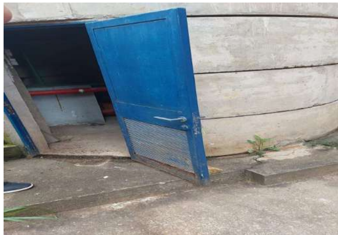
FOTO 50 Portão com metálica danificado
