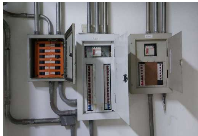
FOTO 32 Atualmente ocorre sobrecarga em alguns circuitos, falta balancear a distribuição para não ocorrer mais
