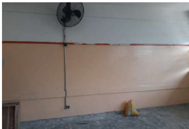
FOTO 108 Sala 6 - Improviso elétrico
