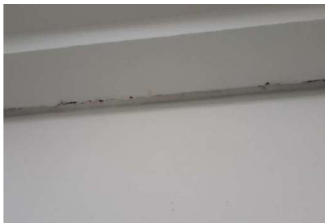
FOTO 108 Sala 8 - Partes quebradas( viga)
