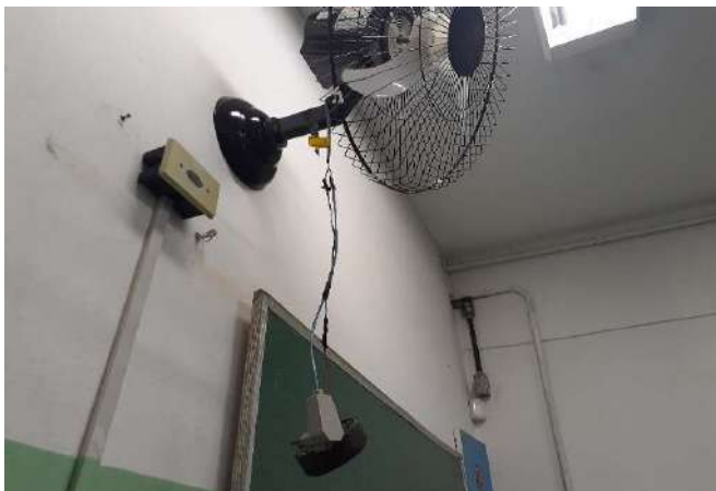
FOTO 97 Sala de Música - Improviso elétrico
