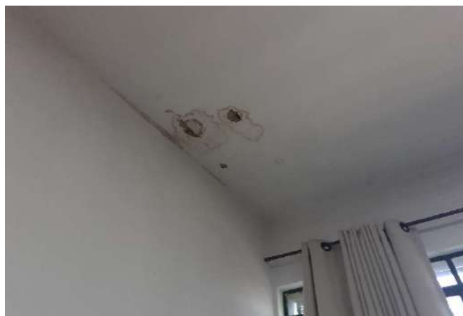
FOTO 90 Sala de leitura - Mancha de mofo/bolor
