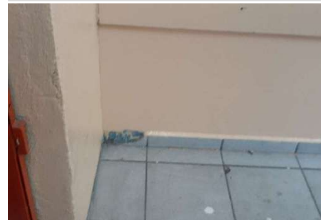
FOTO 106 Sala 11 - Partes quebradas
