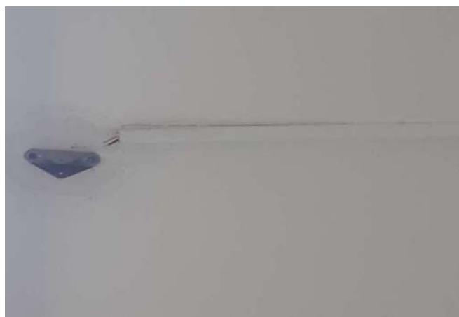
FOTO 10 Brinquedoteca - Improviso elétrico
