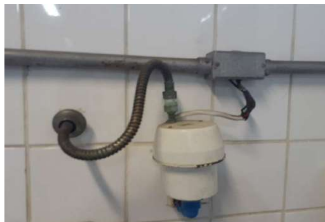
FOTO 18 Cozinha - Improviso elétrico
