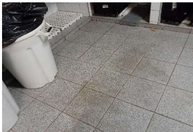
FOTO 24 Despensa - Piso danificado
