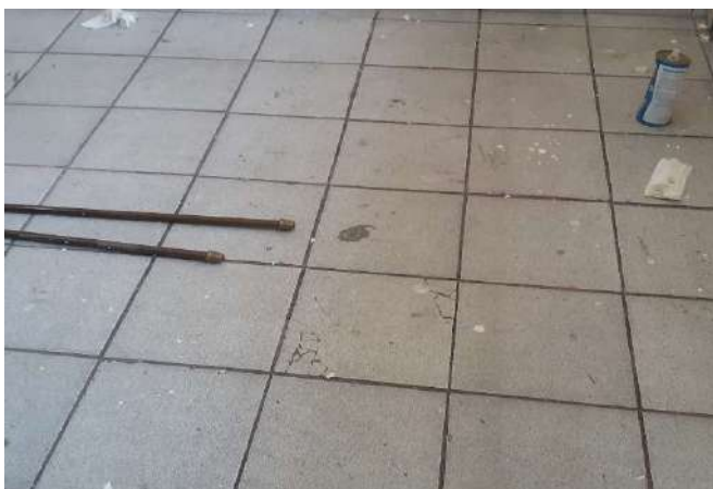
FOTO 107 Sala 11 - Piso desgastado
