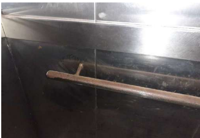
FOTO 29 Elevador - Barra não está fixa
