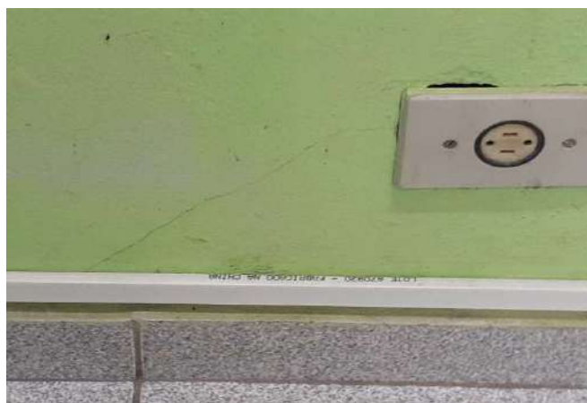
FOTO 100 Sala de Apoio - Fissura e tomada fora de norma
