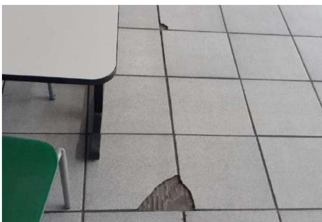
FOTO 53 Laboratório informática - Piso quebrado
