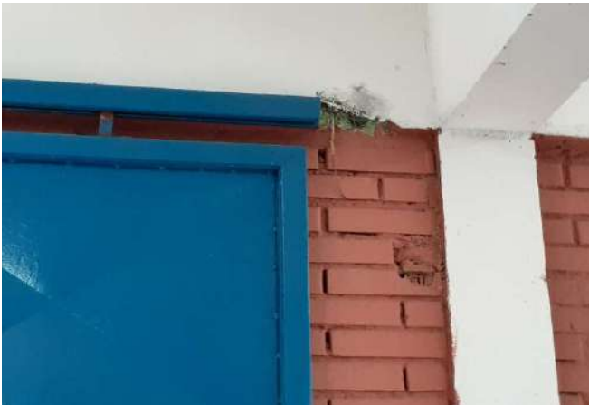
FOTO 61 Pátio coberto - Partes quebradas
