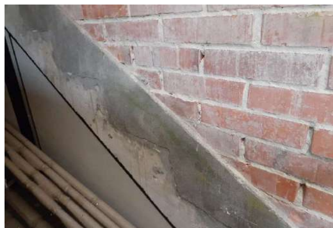
FOTO 34 Depósito em baixo da escada - Fissura
