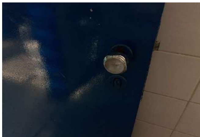
FOTO 84 Sala do coordenador - Fechadura danificada
