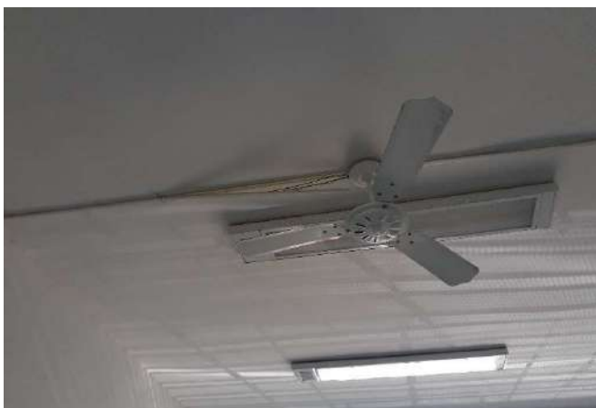
FOTO 95 Sala dos Professores - Improviso elétrico
