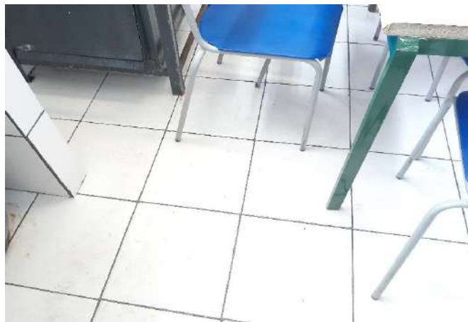
FOTO 20 Cozinha funcionário - Piso desgastado
