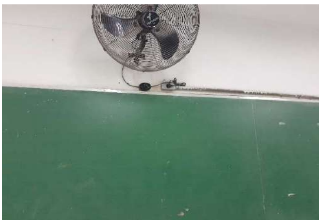
FOTO 105 Sala 1 - Improviso elétrico
