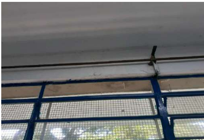
FOTO 103 Sala 1 - Esquadria emperrada
