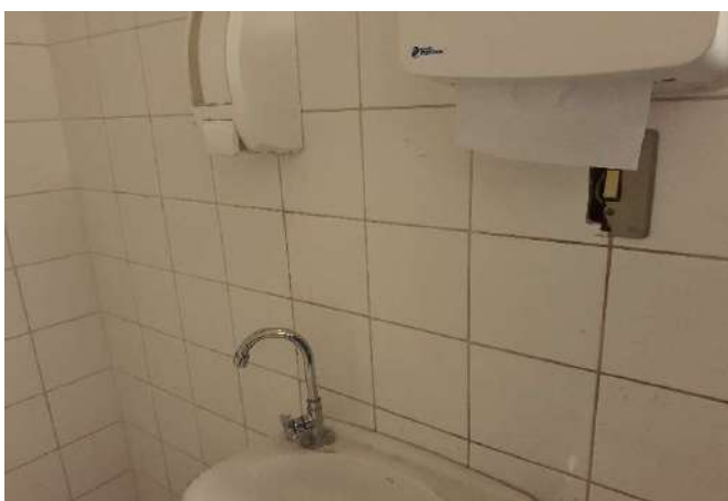
FOTO 107 Sanit. Aluno Masc. - Espelho de tomada quebrado
