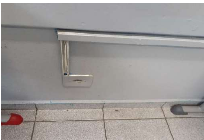
FOTO 105 Sala 15 - Improviso elétrico
