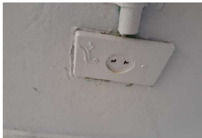
FOTO 108 Sala 4 - Tomada fora de norma
