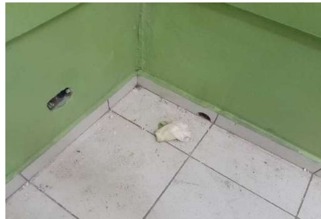
FOTO 106 Sala 7 - Abertura para passagem de fios irregular
