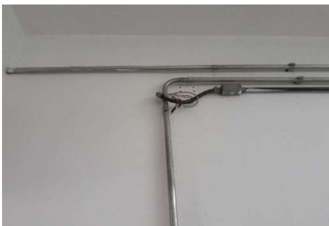
FOTO 105 Hall - Improviso elétrico
