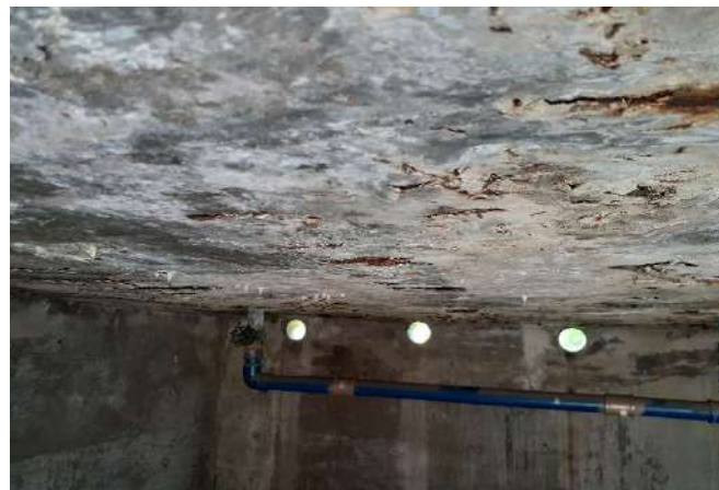
FOTO 14 Casa de Máquina do Reservatório - Bolhas e descamamento
