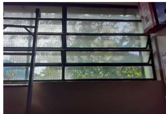
FOTO 106 Arquivo - Esquadria emperrada
