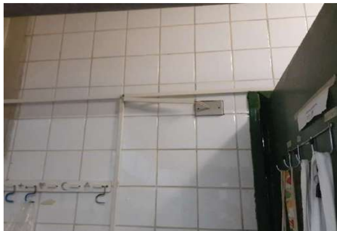
FOTO 26 Despensa - Canaleta descolada e improviso elétrico
