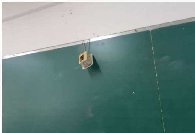
FOTO 104 Sala 7 - Improviso elétrico
