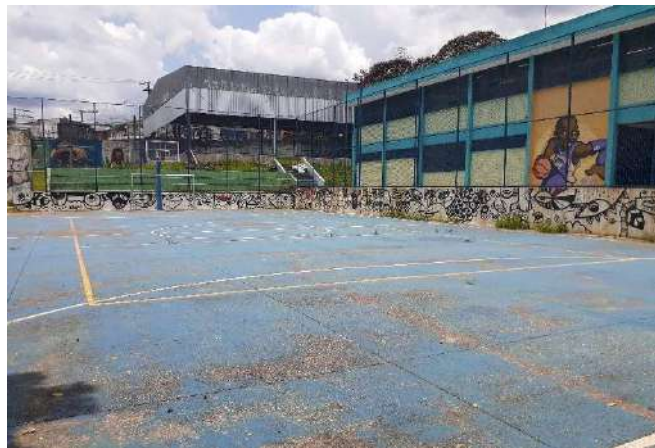
FOTO 74 Quadra descoberta - Umidade ascendente do solo (Falta manutenção)
