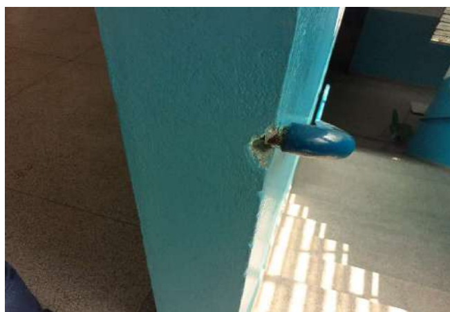
FOTO 108 Escadas - Partes quebradas
