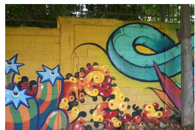
FOTO 64 Playground - Trinca no muro
