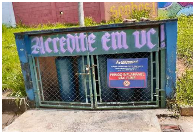
FOTO 104 Gás - Em conformidade
