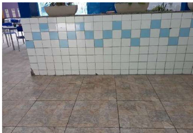
FOTO 78 Refeitório - Partes quebradas
