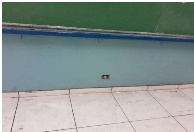
FOTO 104 Sala 1 - Falta espelho
