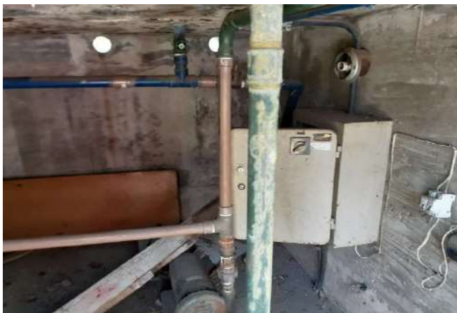
FOTO 13 Casa de Máquina do Reservatório - Visão geral e improviso elétrico
