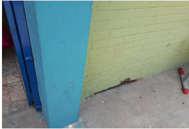
FOTO 6 Acesso - Partes Quebradas
