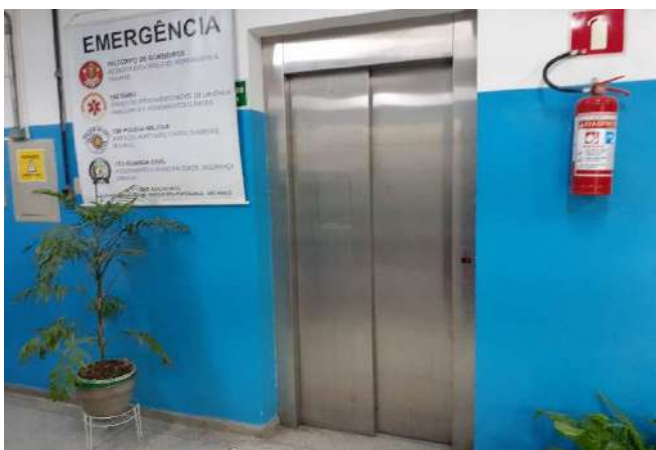
FOTO 27 Elevador - Visão geral
