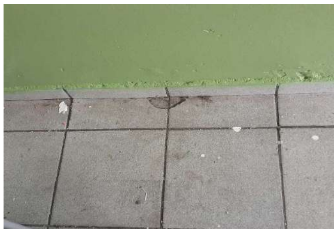
FOTO 108 Sala 12 a 14 - Piso danificado
