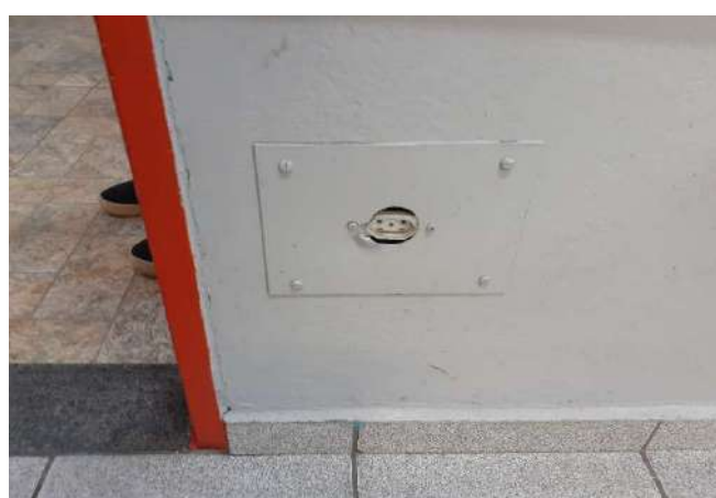
FOTO 106 Sala 15 - Tomada irregular
