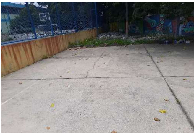
FOTO 75 Quadra descoberta - Umidade do solo e trinca
