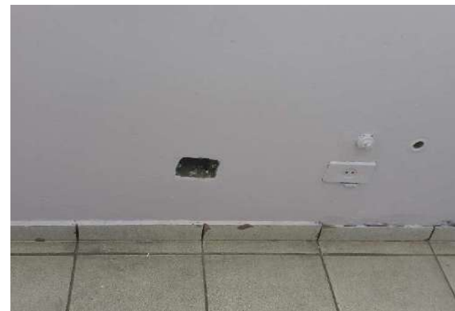
FOTO 106 Sala 10 - Abertura para passagem de fios irregular
