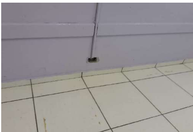
FOTO 105 Sala 5 - Abertura para fios irregular
