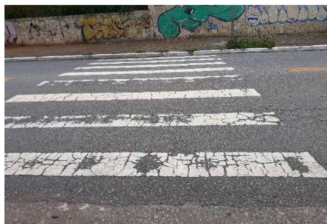
FOTO 108 Sinalização viária - Faixa de pedestre
