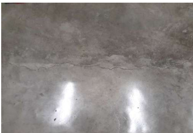
FOTO 99 Sala dos tercerizados - Piso com fissura
