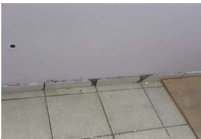
FOTO 107 Sala 10 - Rodapé quebrado
