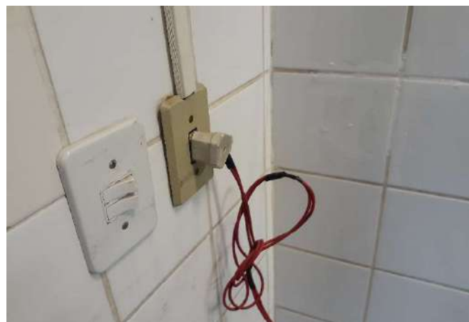
FOTO 23 Despensa - Improviso elétrico
