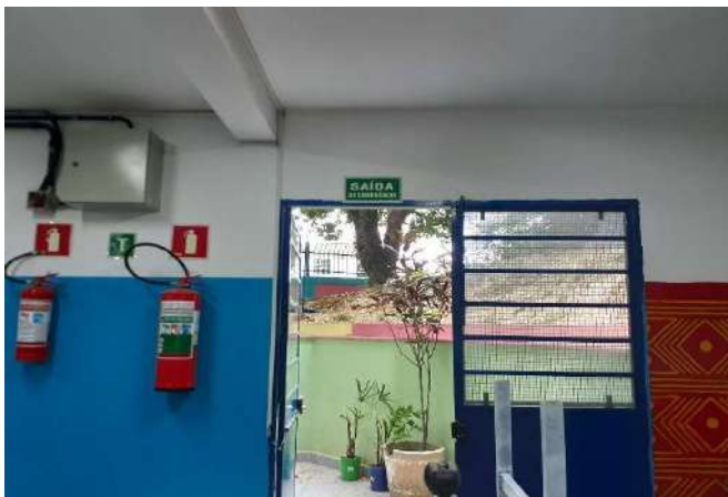
FOTO 103 Saída de Emergência - Em conformidade
