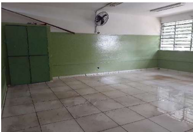
FOTO 107 Sala 2 - Visão geral e improviso elétrico para o ventilador
