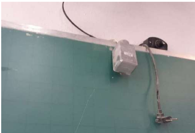
FOTO 103 Sala 10 - Improviso elétrico
