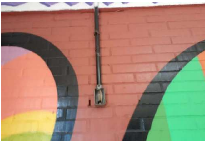
FOTO 77 Refeitório - Fora de norma, sem proteção
