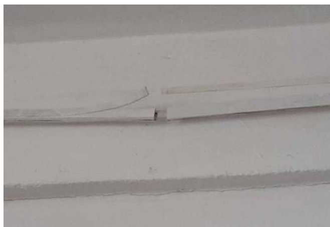
FOTO 46 Laboratório informática - Cnaletas soltas
