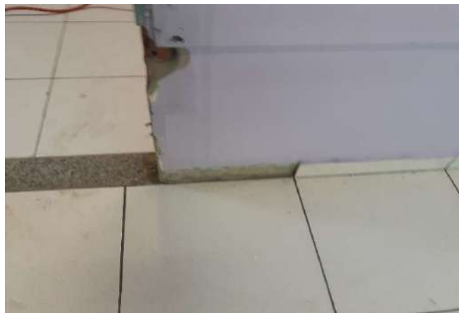
FOTO 104 Sala 5 - Rodapé quebrado
