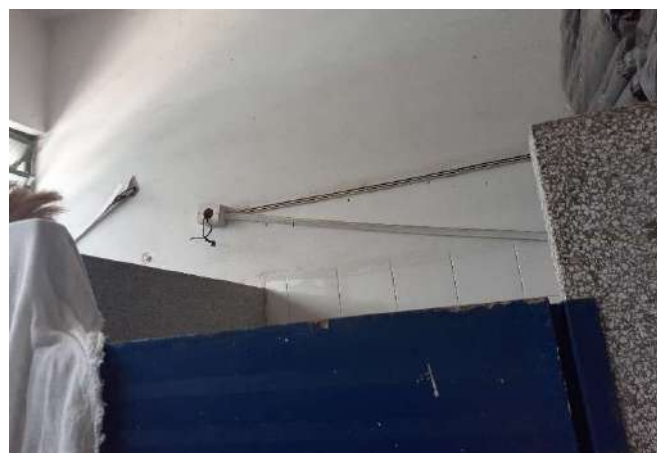
FOTO 100 Sala dos tercerizados - Fiação exposta
