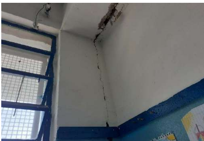
FOTO 105 Sala 8 - Trinca e partes quebradas
