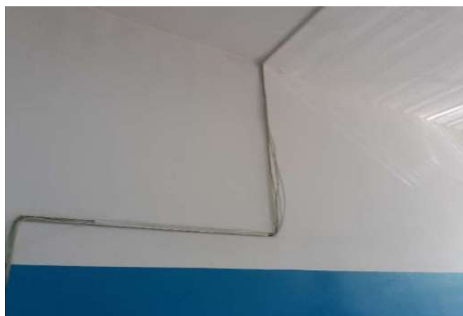
FOTO 94 Sala dos Professores - Improviso elétrico
