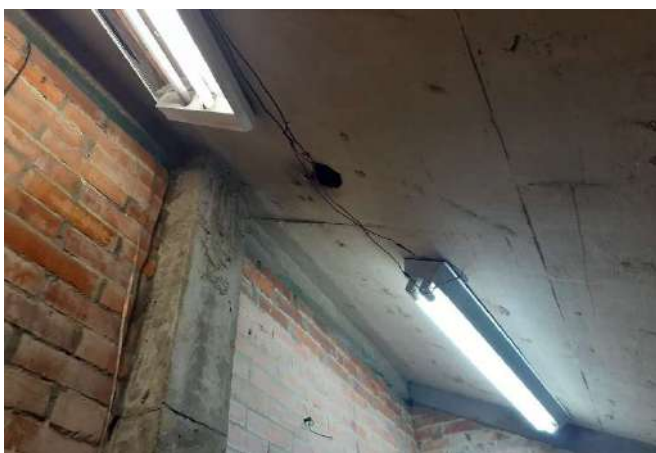
FOTO 33 Depósito em baixo da escada - Improviso elétrico
