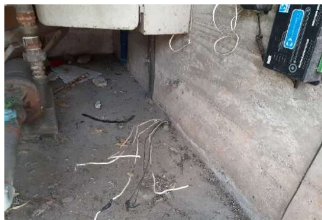
FOTO 16 Casa de Máquina do Reservatório - Fiação aparente e partes expostas
