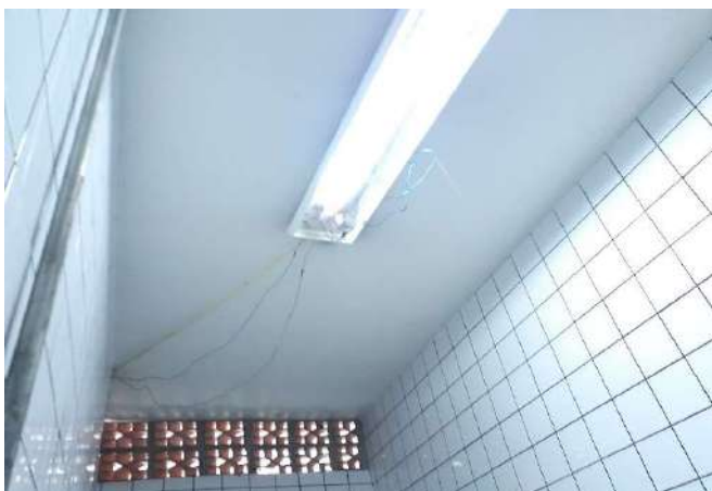
FOTO 107 Vestiário - Improvisos elétrico
