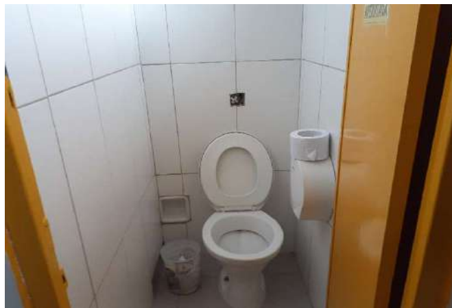
FOTO 104 Sanit. Aluno Masc. - Falta acabamento da descarga
