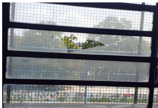
FOTO 108 Sala 10 - Vidro quebrado
