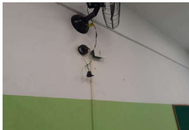
FOTO 102 Sala multifuncionais - Improviso elétrico
