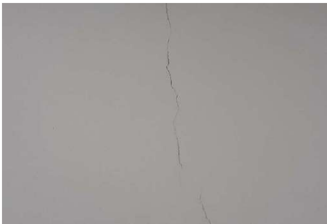
FOTO 97 Sala de Apoio - Fissura
