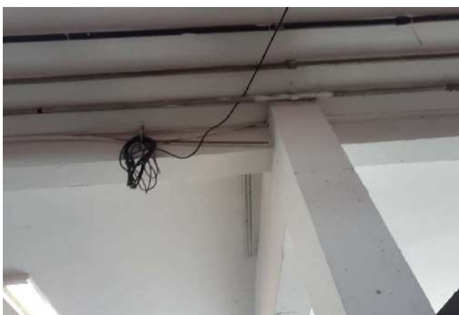
FOTO 107 Palco - Improviso elétrico
