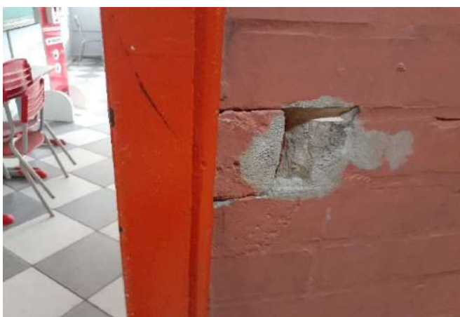
FOTO 107 Sala 15 - Partes quebradas
