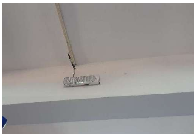
FOTO 106 Luz de Emergência - Em conformidade
