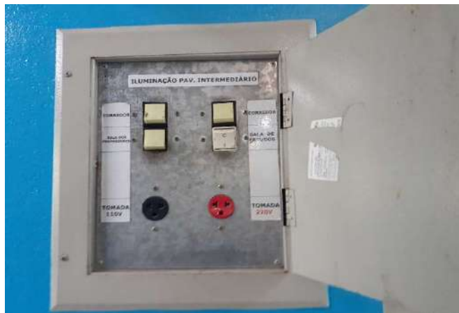
FOTO 104 Quadro de energia - Em conformidade
