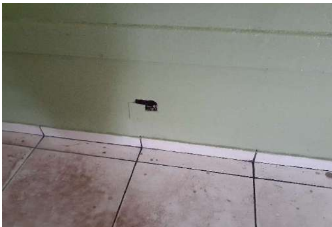
FOTO 103 Sala 2 - Falta espelho
