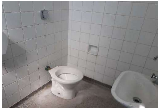
FOTO 106 Sanit. Aluno Masc. - Visão parcial falta tampa do vaso
