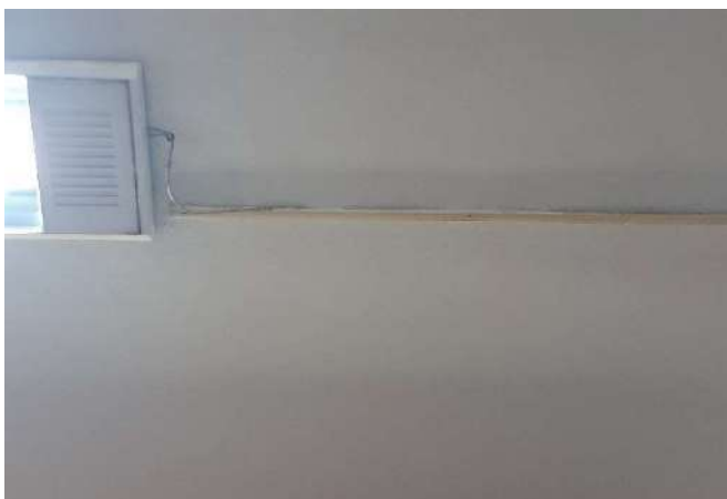
FOTO 103 Sala 9 - Improviso elétrico
