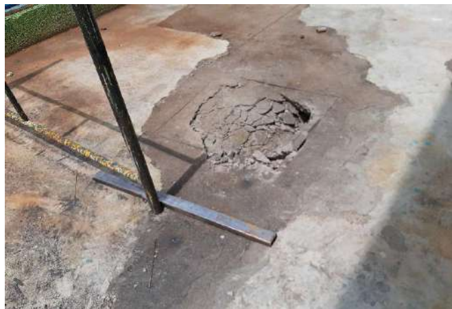
FOTO 104 Piso externo - Abatimento do piso
