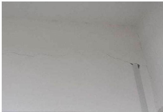
FOTO 98 Sala de Apoio - Fissura
