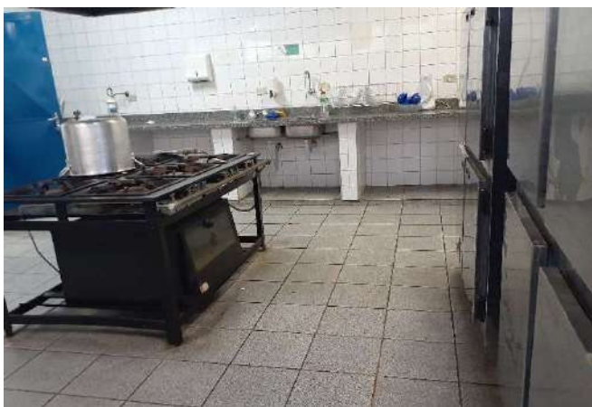
FOTO 17 Cozinha - Visão geral e piso desgastado
