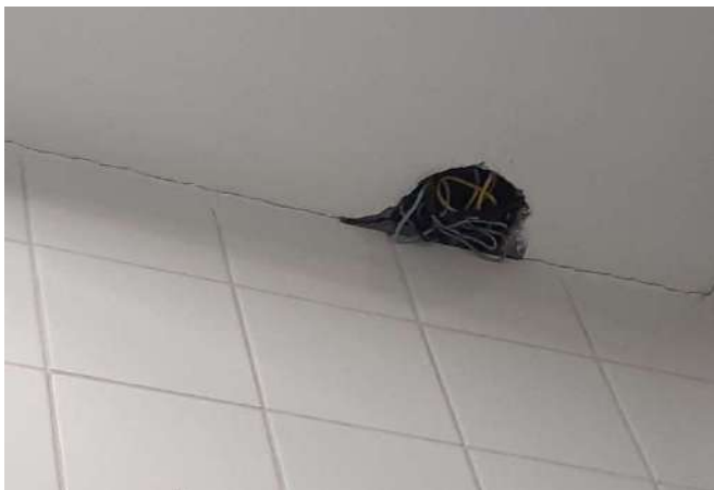
FOTO 103 Sanit. Deficiente unissex - Abertura de fios irregular
