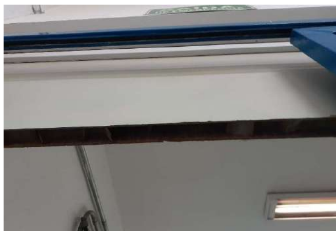
FOTO 82 Sala do coordenador - Falta acabamento
