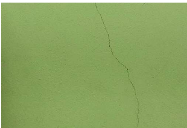
FOTO 99 Sala de Apoio - Fissura horizontal
