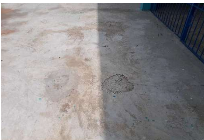
FOTO 105 Piso externo - Abatimento do piso
