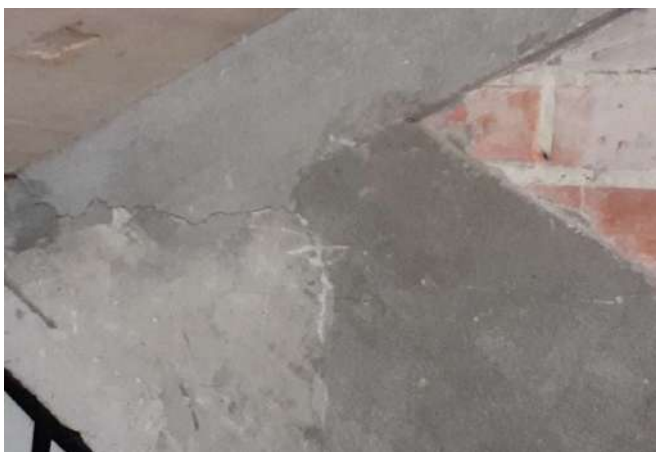
FOTO 35 Depósito em baixo da escada - Fissura
