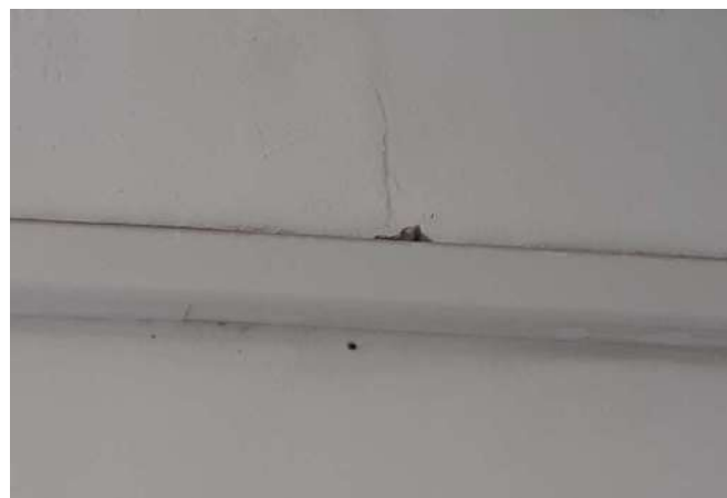
FOTO 50 Laboratório informática - Partes quebradas
