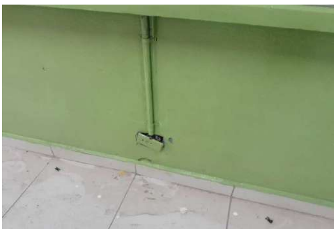
FOTO 105 Sala 7 - Tomada fora de norma
