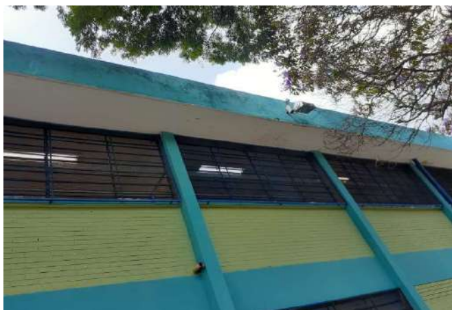
FOTO 5 Fachada - Manchas de bolor e umidade
