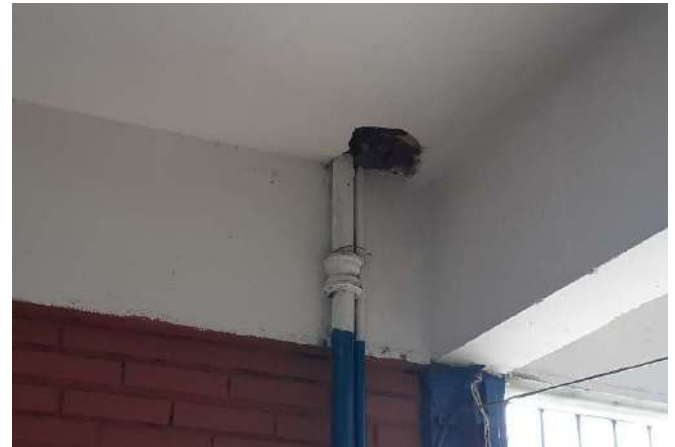
FOTO 62 Pátio coberto - Partes quebradas
