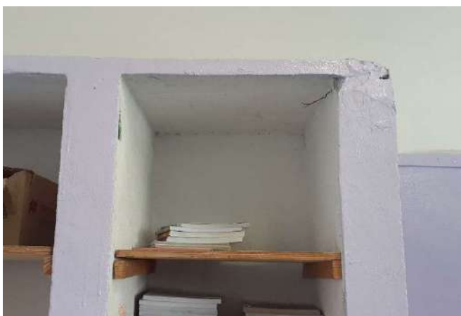
FOTO 105 Sala 10 - Partes quebradas
