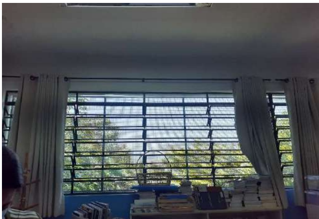
FOTO 91 Sala de leitura - Esquadrias emperradas
