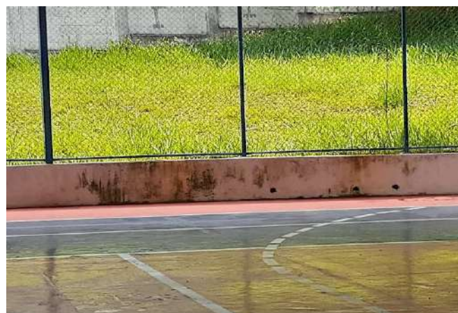
FOTO 70 Quadra coberta - Umidade ascendente do solo
