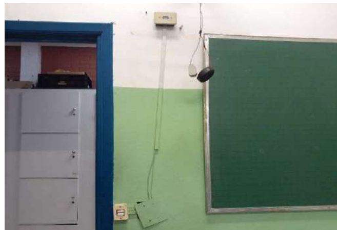
FOTO 98 Sala dos tercerizados - Improvisos elétricos
