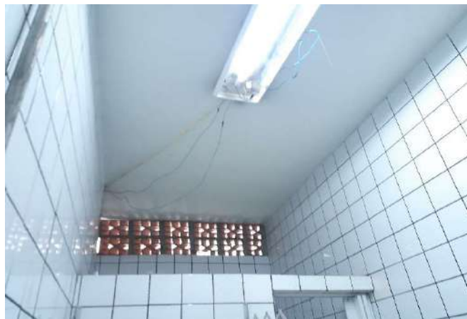
FOTO 56 Lavanderia - Improviso elétrico
