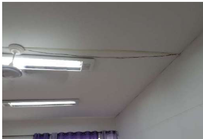
FOTO 80 Sala do diretor e assistente - Improvisos elétricos
