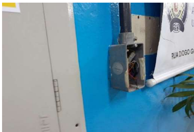
FOTO 88 Secretaria -Caixinha aberta, sem proteção
