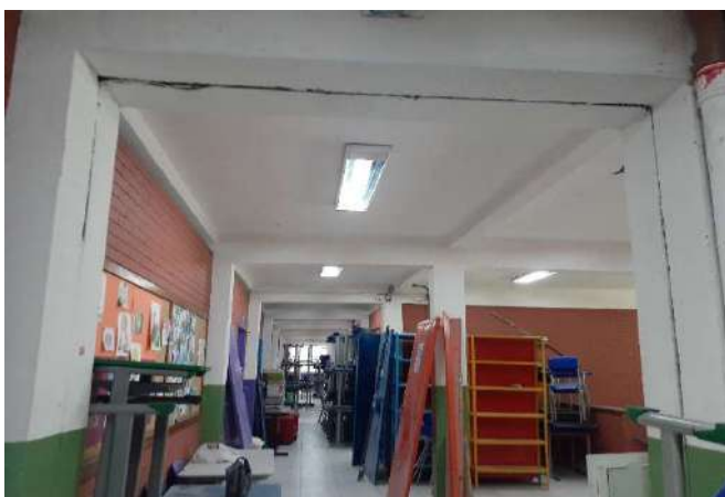
FOTO 105 Corredor - Vista da junta de dilatação aberta
