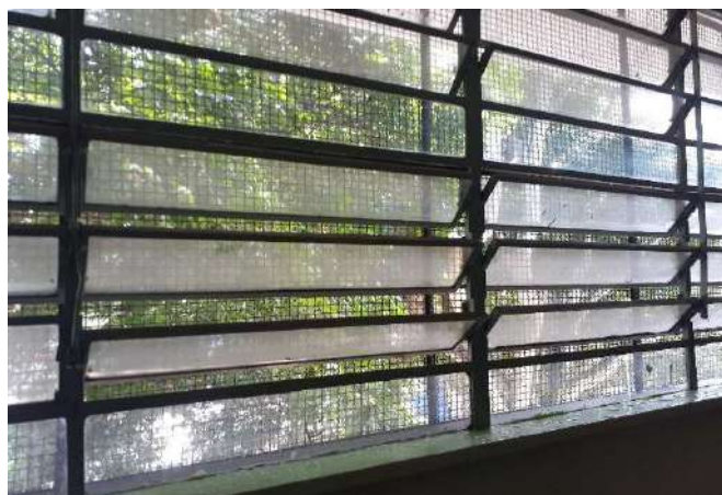
FOTO 108 Sala 2 - Esquadria emperrada
