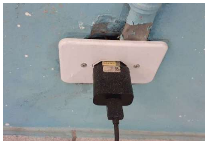
FOTO 106 Sala 9 - Partes quebradas
