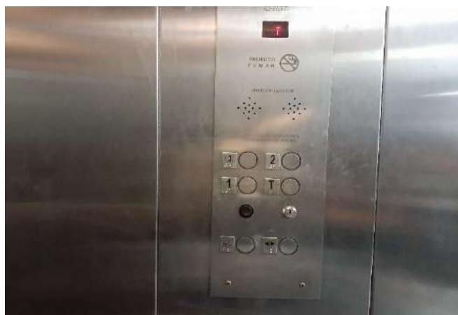
FOTO 28 Elevador - Pannel de controle (Botões, alarme, pânico, emergência, e interfone não funcionam)
