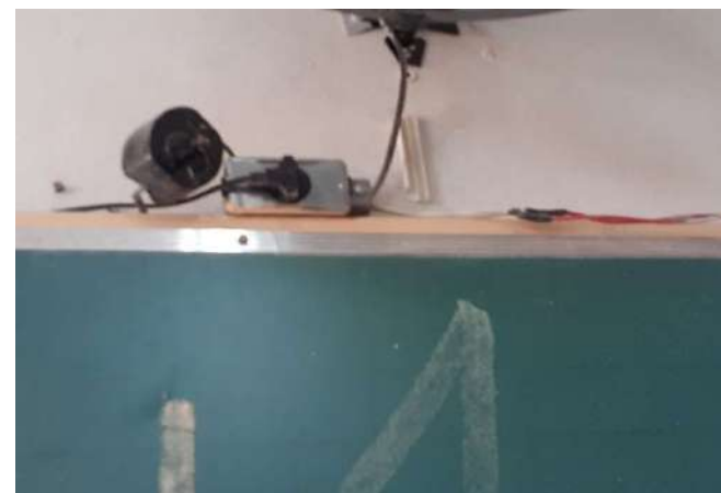
FOTO 108 Sala 11 - Improviso elétrico
