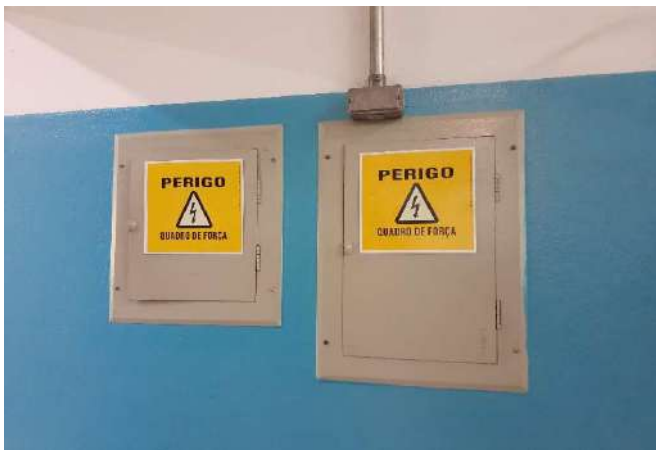
FOTO 103 Quadro de energia - Visão Fechada
