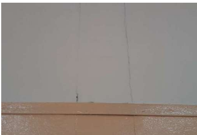
FOTO 105 Sala 11 - Trinca (viga)
