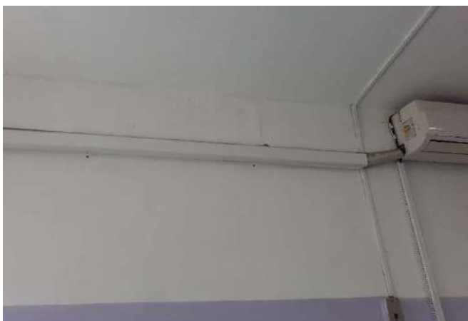
FOTO 49 Laboratório informática - Fissura
