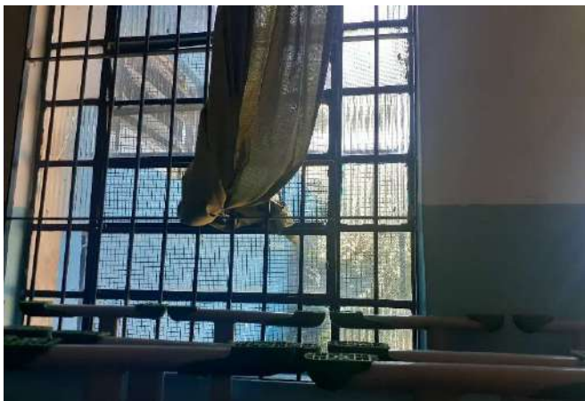
FOTO 115 Sala 11 - Esquadria quebrada
