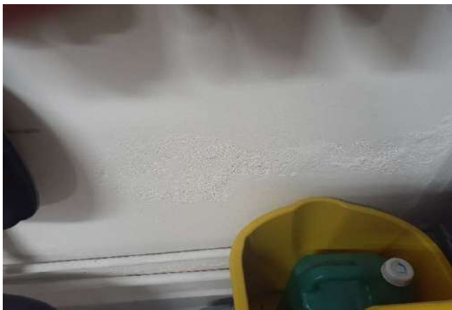
FOTO 115 Vestiário - Antiga Infiltração
