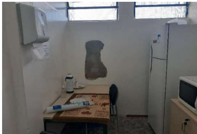
FOTO 14 Cozinha func. - Visão geral e descolamento de azulejo
