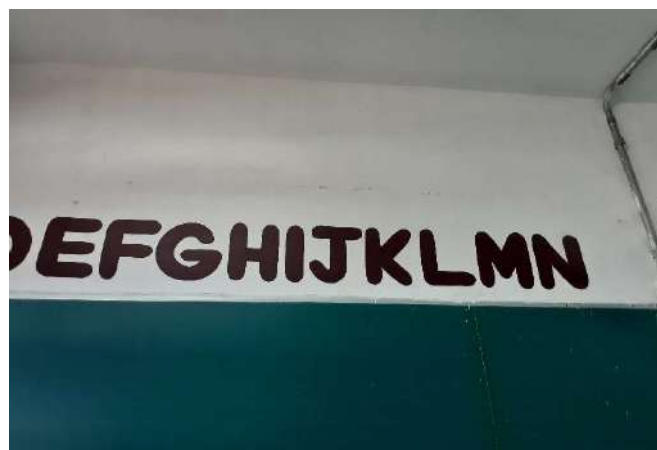
FOTO 112 Sala 8 - Fissura Horizontal
