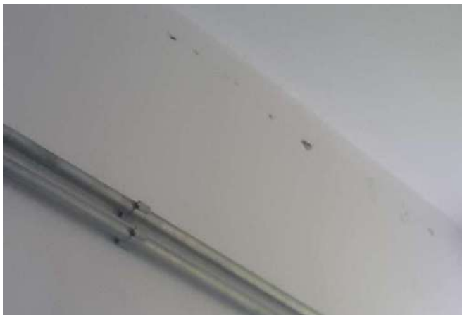
FOTO 115 Sala de Apoio - Trinca horizontal
