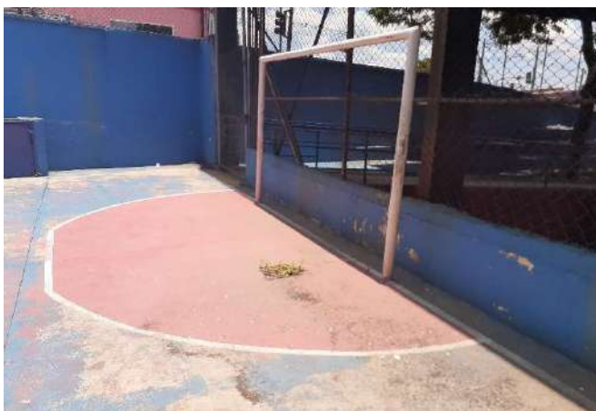
FOTO 65 Quadra descoberta - Ralo obstruído
