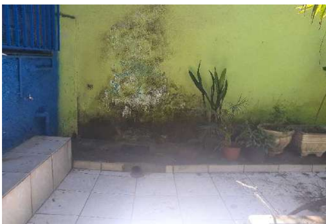
FOTO 117 Área de descanso - Umidade ascendente do solo
