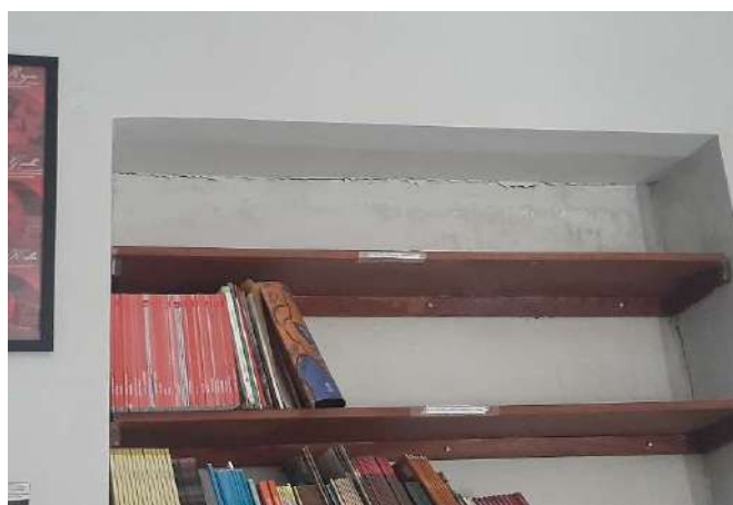
FOTO 78 Sala de leitura - Fissura, mancha de mofo/bolor
