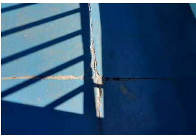
FOTO 5 Acesso - Deficiência de na junta de dilatação
