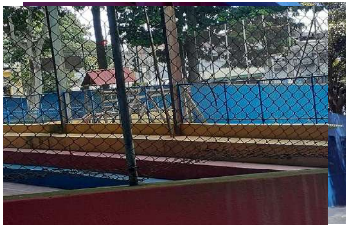
FOTO 57 Pátio descoberto - Manchas umidade
