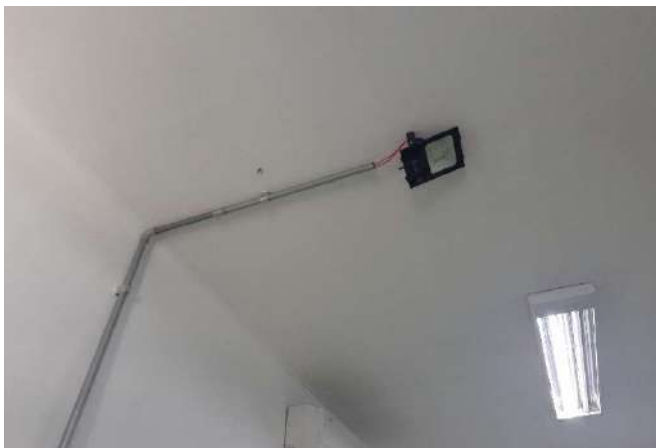
FOTO 49 Sala de informática - Improviso elétrico
