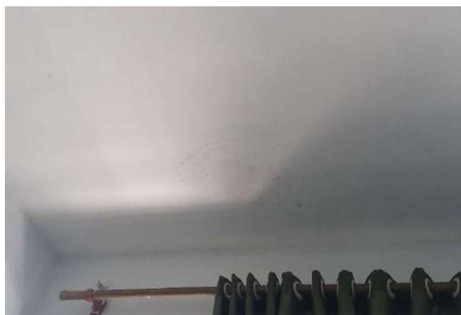
FOTO 118 Sala 9 - Mancha de mofo/ bolor
