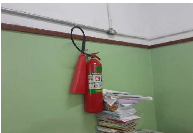
FOTO 53 Sala de informática - Extintor sem placa de identificação
