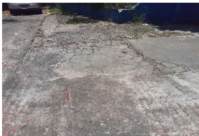
FOTO 46 Estacionamento - Piso quebrado, falta e deficiência na junta de trabalho
