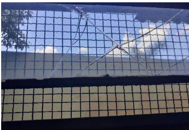
FOTO 119 Sala 15 - Vidro quebrado
