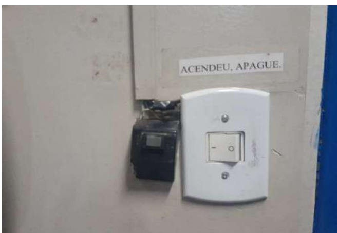
FOTO 77 Sala de leitura - Improviso elétrico
