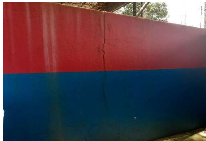
FOTO 8 Área externa - Muro rachado
