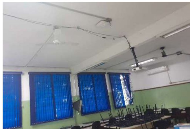
FOTO 50 Sala de informática - Improviso elétrico
