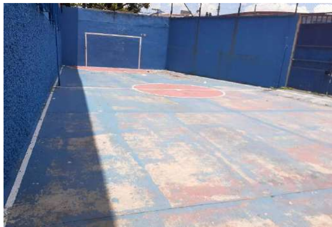
FOTO 64 Quadra descoberta - Visão geral e pintura desgastada
