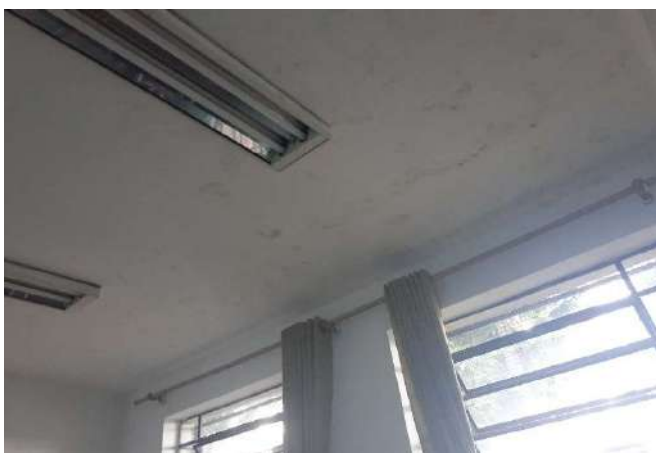
FOTO 117 sala 14 - Vidro quebrado
