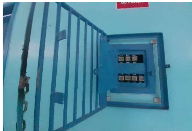
FOTO 116 Quadro de força - Trancado ( Não conforme )
