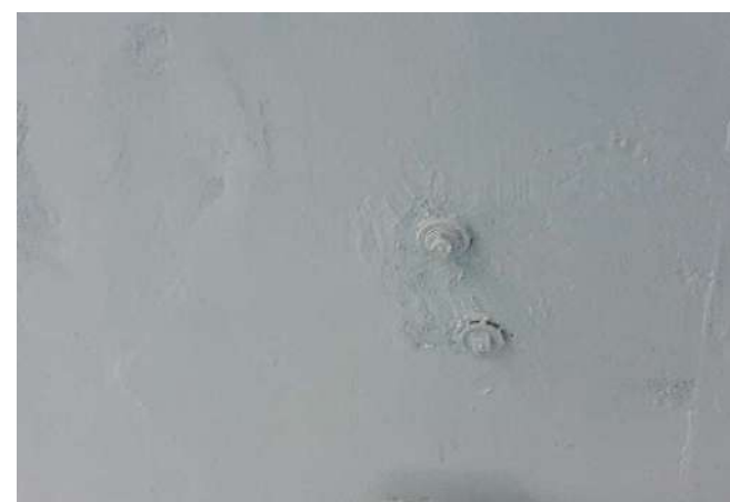
FOTO 24 Corredor - Parafusos e teto irregulares
