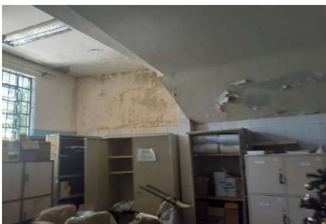
FOTO 35 Depósito - Descamamento, infiltração, mancha de mofo/bolor
