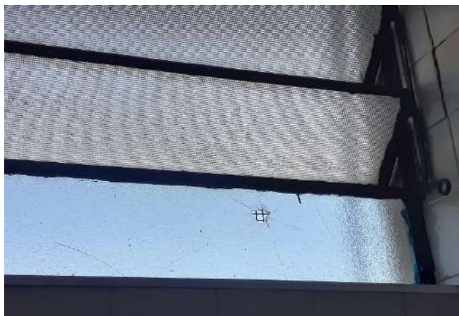
FOTO 119 Sanit. para Deficiente Masc.- Vidro quebrado
