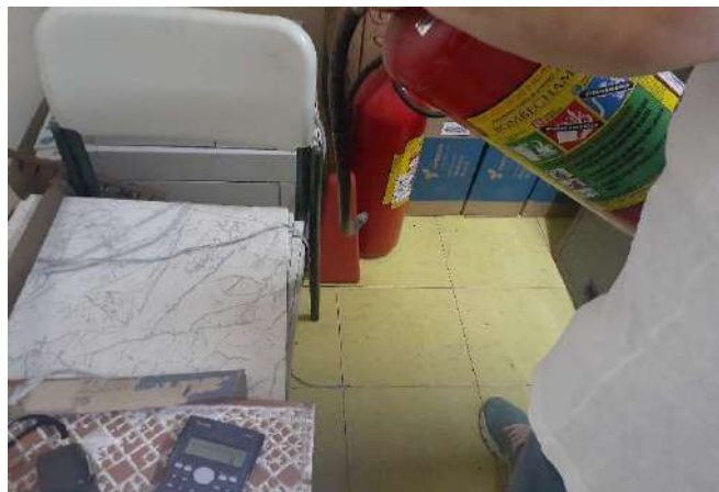
FOTO 116 Extintor - Sem lacre (Almoxarifado)
