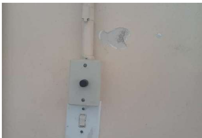
FOTO 81 Sala dos professores - Partes quebrada
