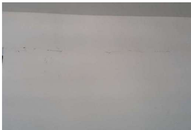
FOTO 120 Sala 9 - Fissura horizontal
