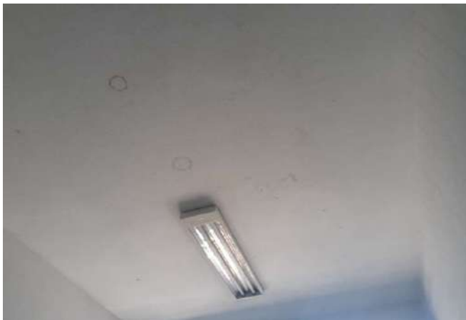
FOTO 115 Sanit aluno Masc - Macha de mofo no teto
