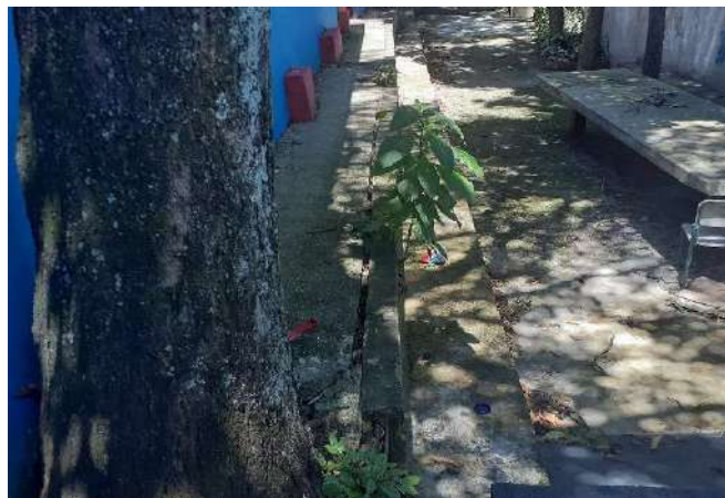
FOTO 56 Pátio descoberto - Juntas deficientes
