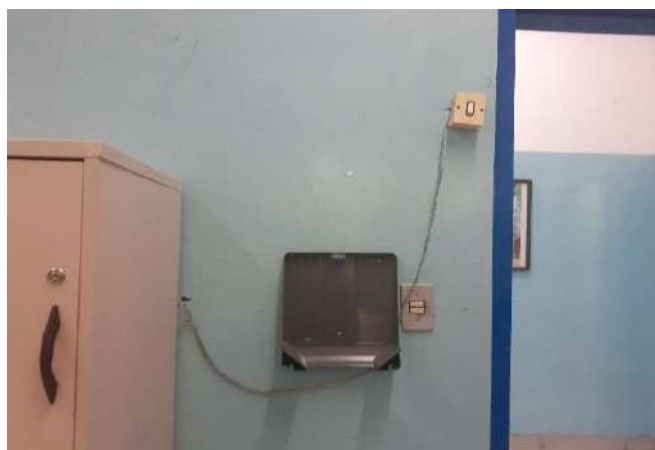
FOTO 82 Sala dos professores - Improviso elétrico
