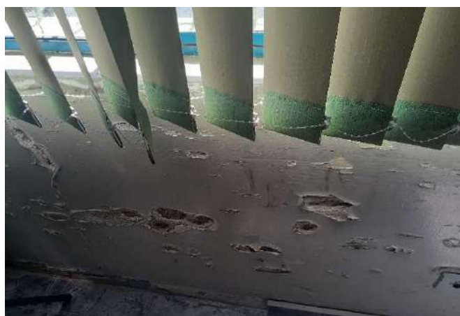
FOTO 76 Sala de leitura - Descascamento/ bolhas
