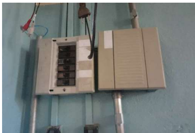
FOTO 40 Depósito - Quadro de luz sem tampa
