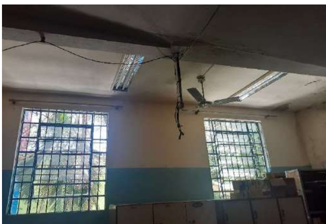
FOTO 39 Depósito - Improviso elétrico
