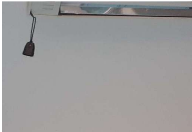
FOTO 85 Todas as salas - Improviso elétrico
