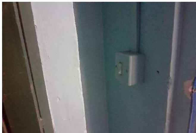
FOTO 32 Depósito - Batente Danificado
