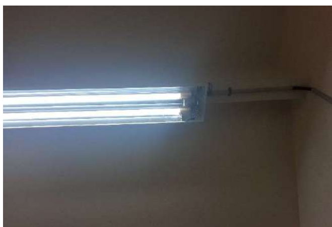
FOTO 28 Almojarifado - Improviso elétrico
