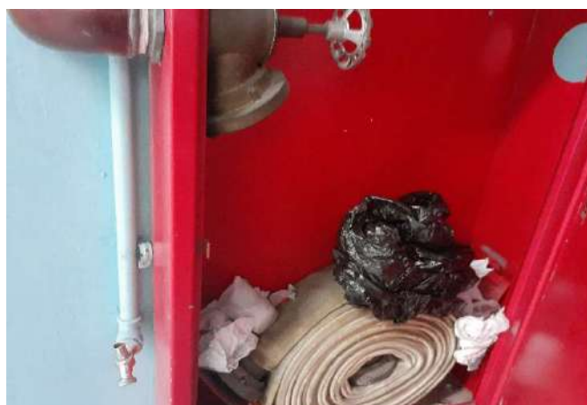
FOTO 120 Hidrante - Não conforme - lixo
