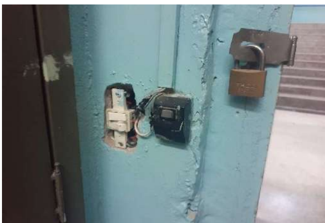
FOTO 33 Depósito - Improviso elétrico
