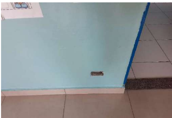
FOTO 99 Sala 5 - Espelho da tomada faltante
