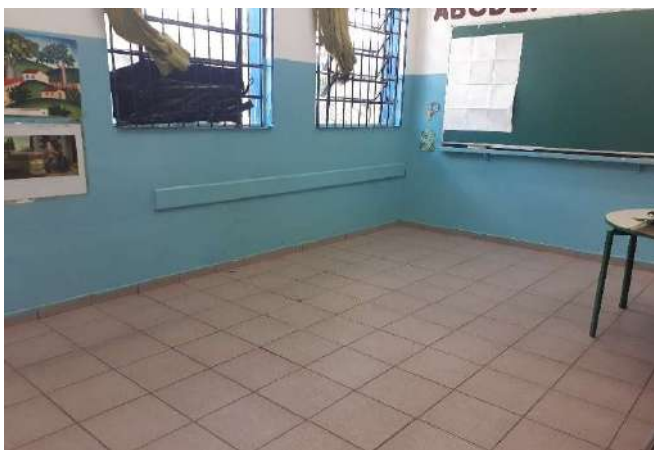
FOTO 115 Sala 13 - Piso quebrado
