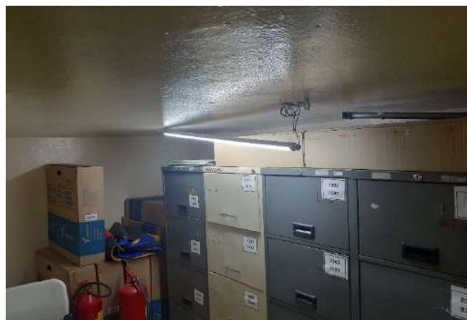
FOTO 27 Almojarifado - Improviso elétrico
