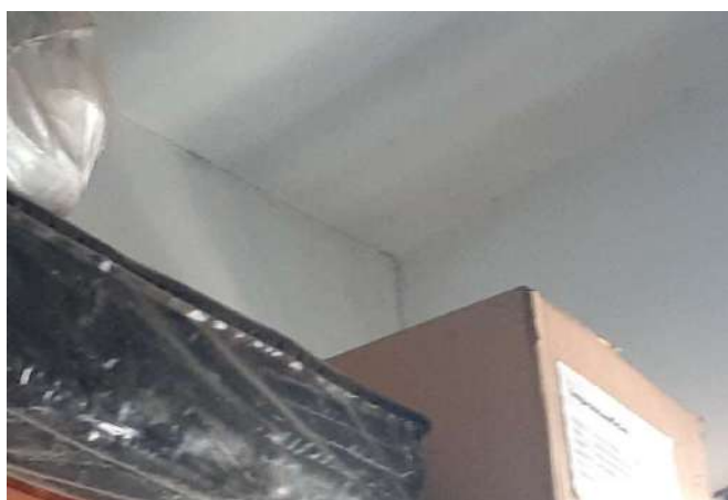
FOTO 119 Sala de Educação física - Mancha de bolor/mofo
