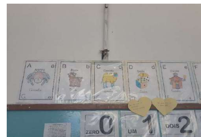
FOTO 120 Sala 11 - Improviso elétrico
