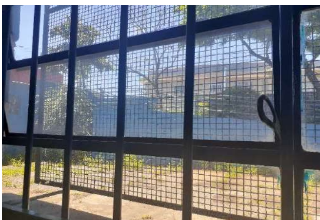
FOTO 119 Sala 12 - Vidro quebrado
