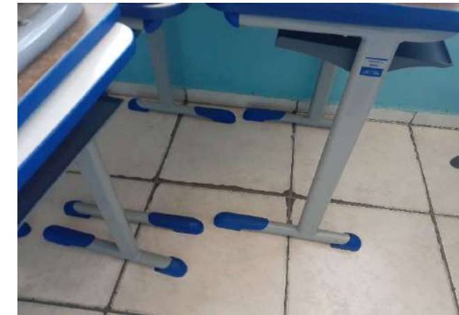
FOTO 96 Sala 4 - Piso desgastado
