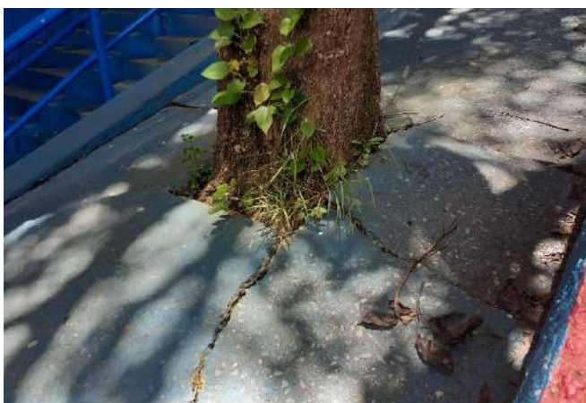
FOTO 9 Área externa - Piso estufado pela raiz da árvore
