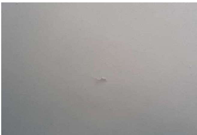
FOTO 119 Sala 9 - Bolha e descascamento
