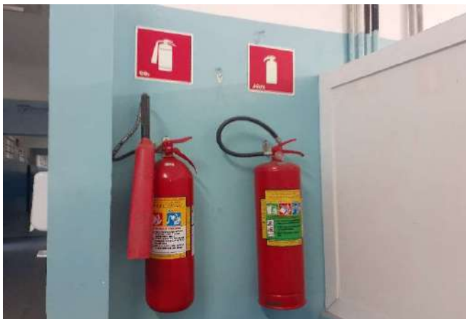
FOTO 115 Extintores em conformidade
