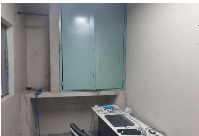
FOTO 117 Sala de som - Improviso
