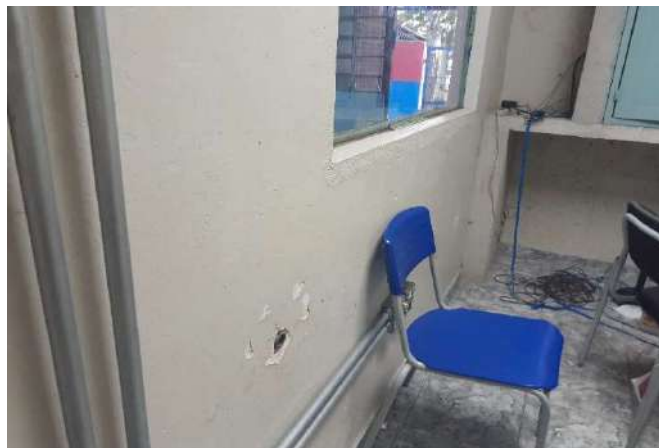
FOTO 116 Sala de som - Abertura de passagem de fios e parede danificada
