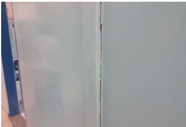
FOTO 115 Sala 9 - Moldura corredor descolando
