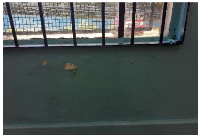
FOTO 116 Sala 13 - Bolhas e descascamento
