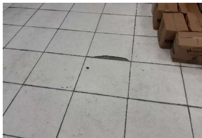
FOTO 118 Sala 12 - Piso quebrado
