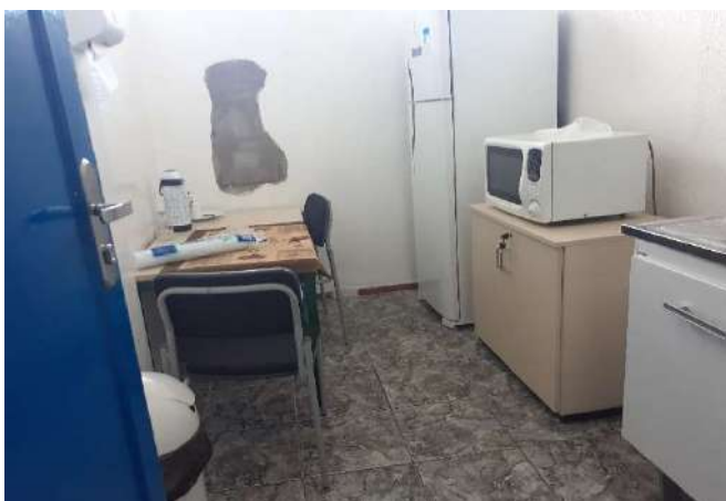
FOTO 15 Cozinha func. - Descolamento
