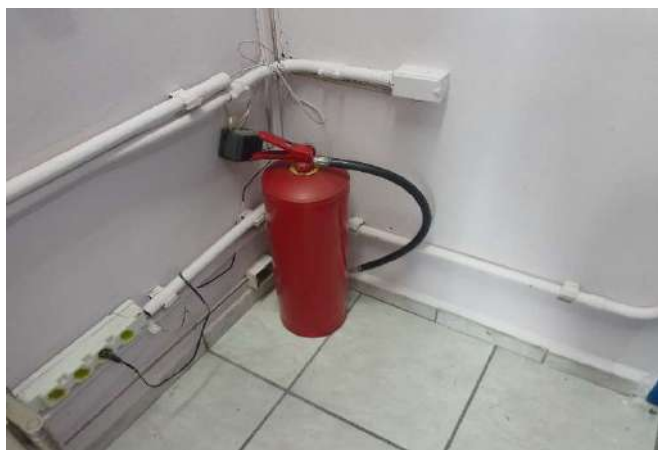
FOTO 83 Secretaria - Extintor irregular no chão
