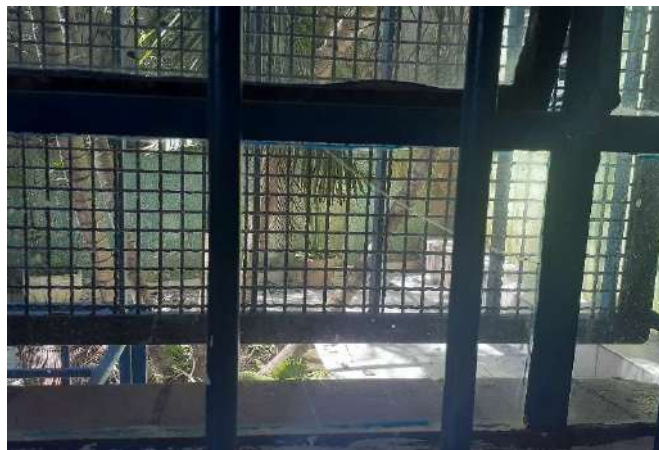
FOTO 80 Sala dos professores - Vidro quebrado
