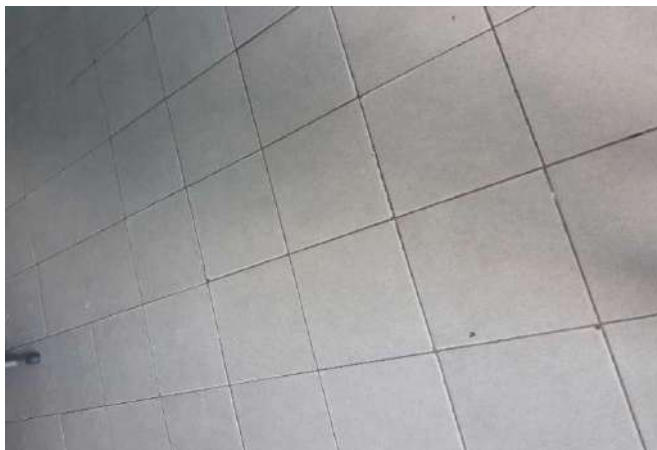
FOTO 115 Sala 15 - Piso desgastado
