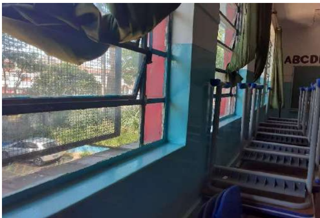
FOTO 97 Sala 4 - Esquadria danificada
