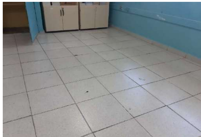
FOTO 110 Sala 8 - Piso desgastado
