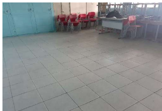
FOTO 120 sala 14 - Piso desgastado
