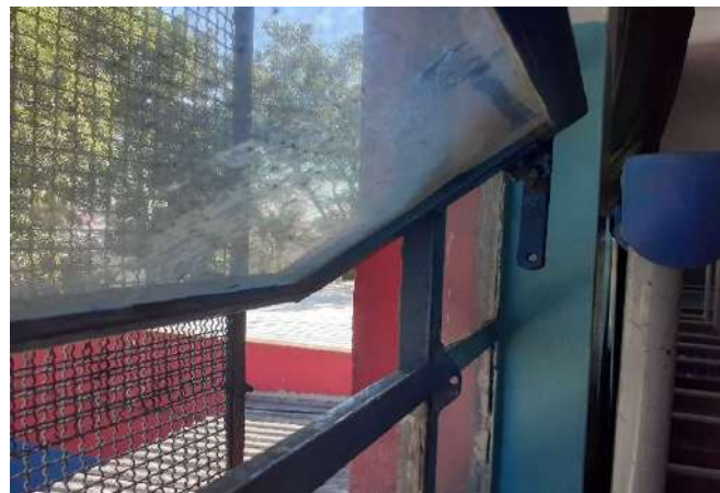
FOTO 116 Sala 10 - Esquadria quebrada
