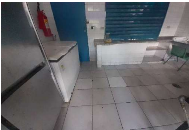
FOTO 13 Cozinha - Piso diferente do original
