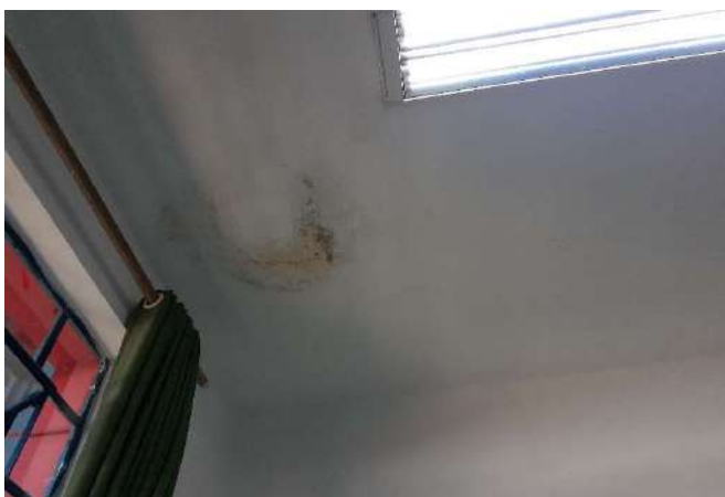
FOTO 111 Sala 8 - Infiltração, mancha de mofo/bolor
