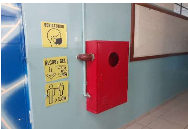
FOTO 119 Hidrante - Visão geral, sem identificação
