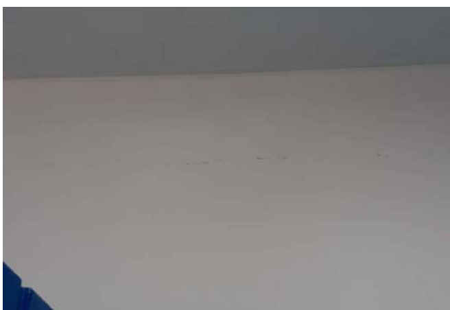
FOTO 113 Sala 8 - Manchas bolor
