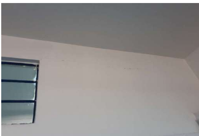
FOTO 107 Sala 7 - Fissura horizontal
