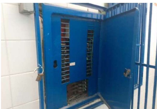
FOTO 119 Quadro de força - Trancado ( Não conforme )
