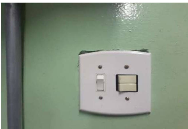
FOTO 51 Sala de informática - Parte quebrada
