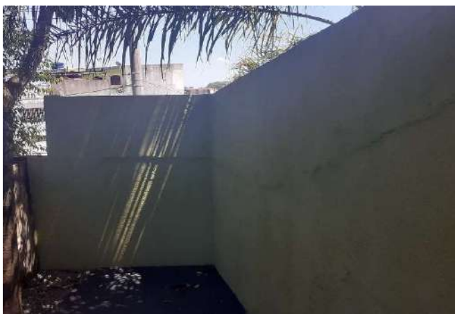
FOTO 59 Pátio descoberto - Muro com trinca
