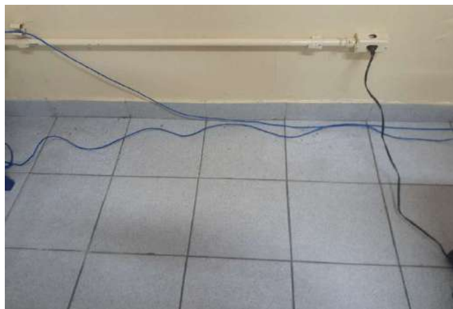
FOTO 74 Sala coordenação - Piso desgastado
