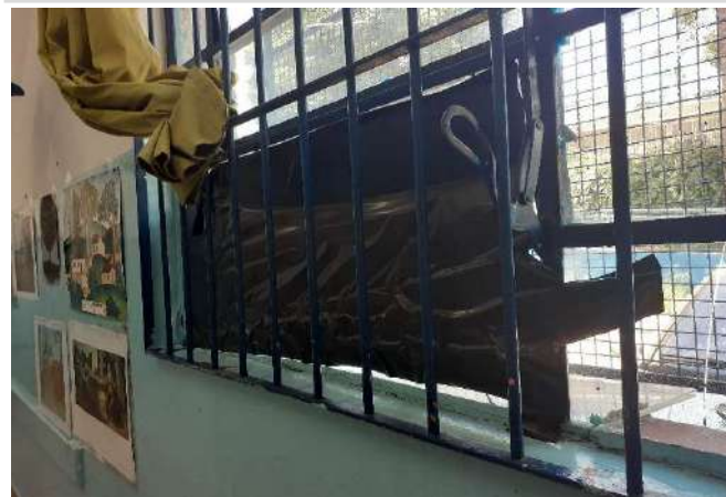
FOTO 118 Sala 13 - Vidro quebrado
