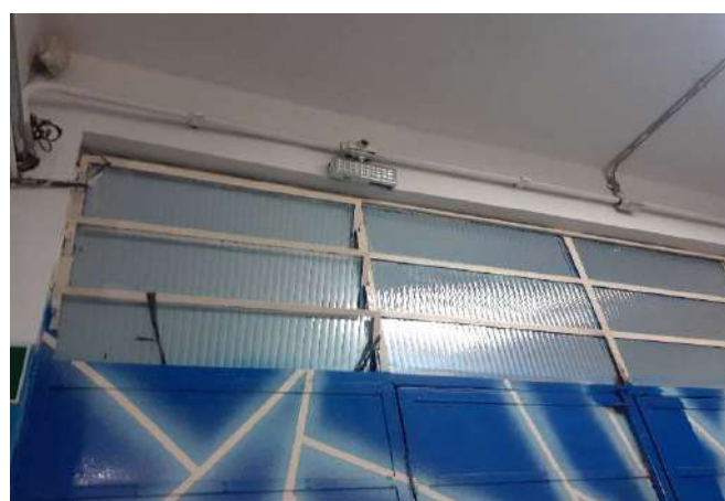
FOTO 120 Luz de emergência - Visão geral
