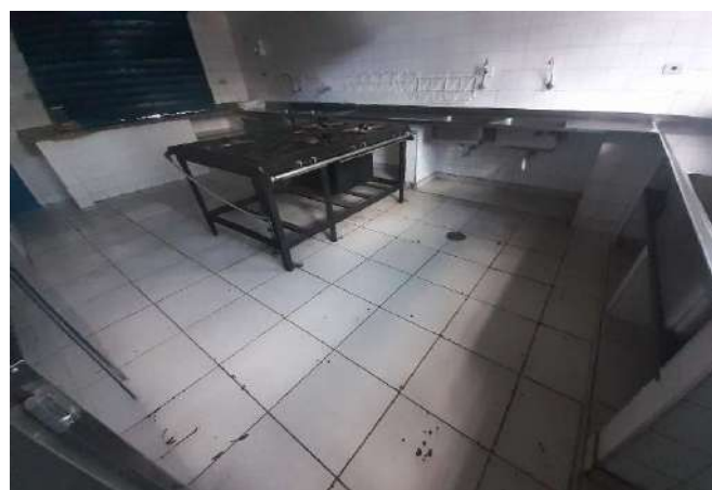
FOTO 12 Cozinha - Piso danificado
