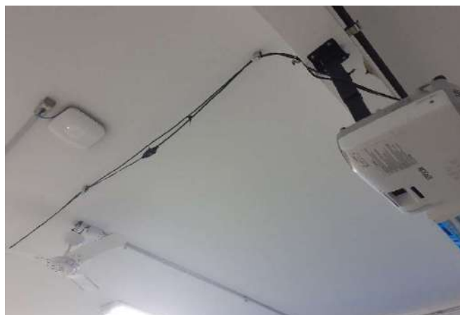
FOTO 48 Sala de informatica - Improvisos elétricos
