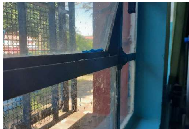
FOTO 88 Sala 1 - Esquadria emperrada/quebrada
