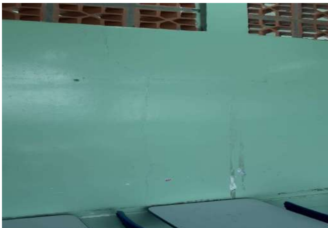
FOTO 1 trinca na parede sala de aula 12
