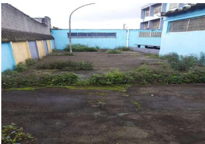
FOTO 59 Rachaduras no piso externo na frente da escola
