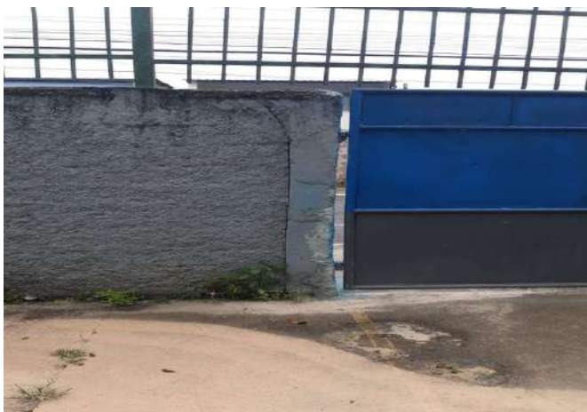
FOTO 7 Trinca no muro da frente e substituição das grades
