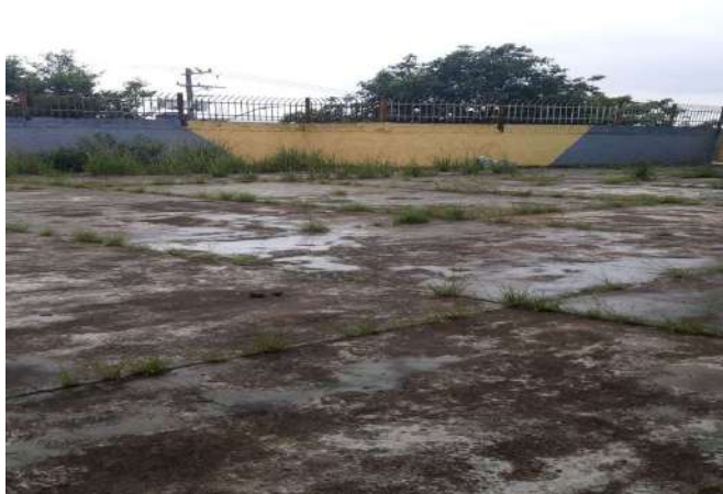
FOTO 57 Piso do pátio descoberto do fundo com trinca e rachaduras
