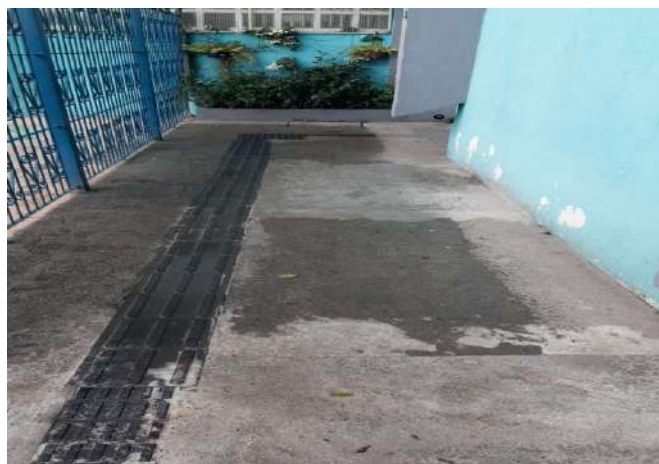
FOTO 48 Piso com desnivelamento e trincas
