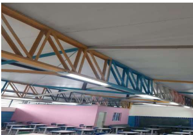
FOTO 3 Telhado do pátio apresenta goteira
