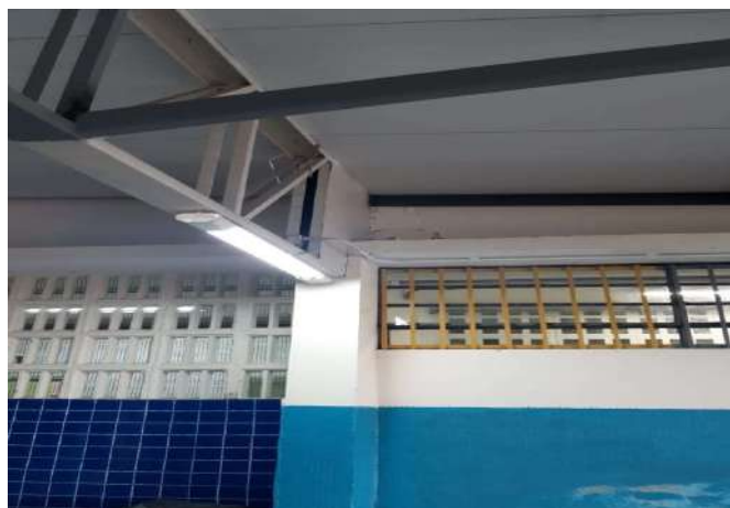
FOTO 38 Rachaduras no vigamento do telhado do pátio coberto
