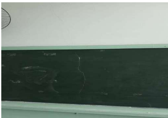
FOTO 39 Trinca na parede da sala de aula 16
