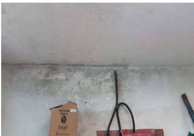
FOTO 45 Trinca, infiltração e umidade na parede e teto do arquivo morto
