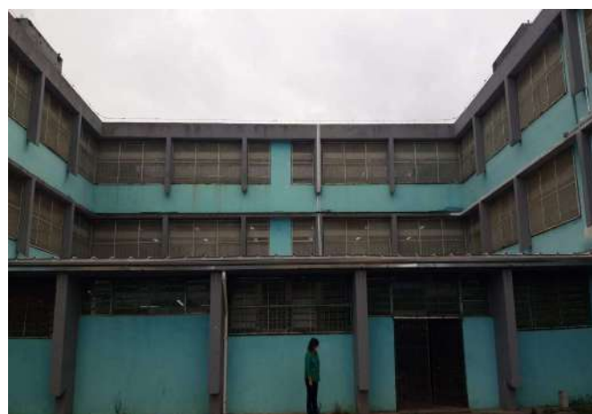
FOTO 60 fundos da escola, necessário pintura geral
