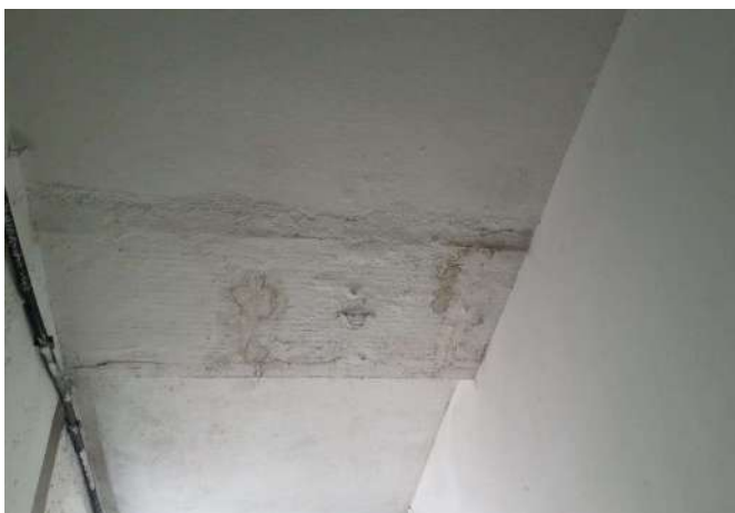
FOTO 5 Goteira e infiltração no corredor de acesso ao arquivo morto
