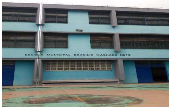
FOTO 2 Piso do pátio descoberto da frente com trincas e rachaduras
