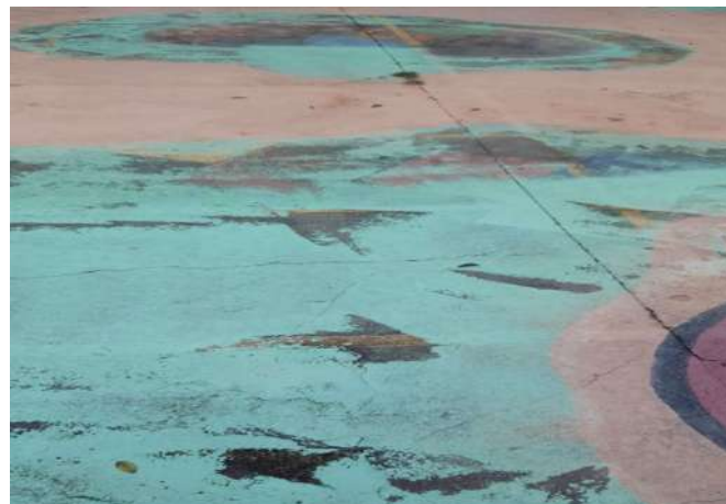
FOTO 56 Piso do pátio descoberto da frente com trinca e rachaduras
