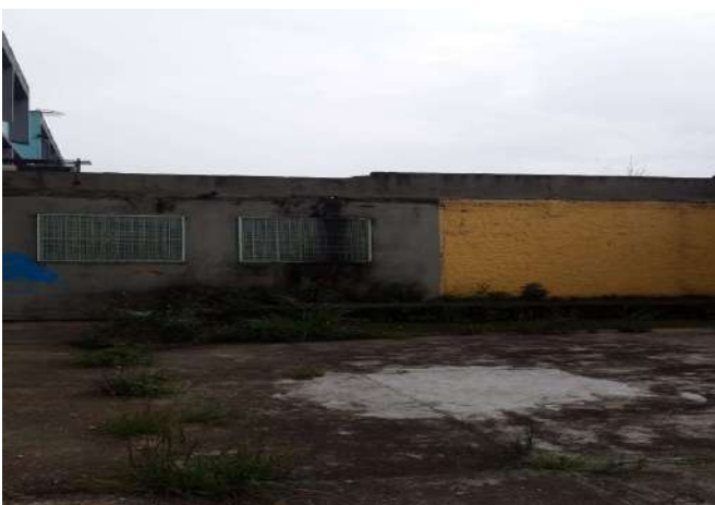
FOTO 17 Umidade e infiltração na parede externa de leitura
