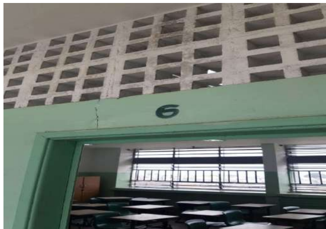
FOTO 44 Trinca e rachaduras na sala de aula 6
