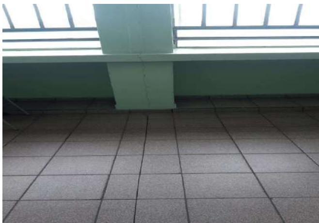
FOTO 37 Trinca na sala 12 de aula
