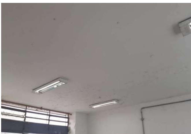
FOTO 11 Sala de aula 7 com umidade e infiltração
