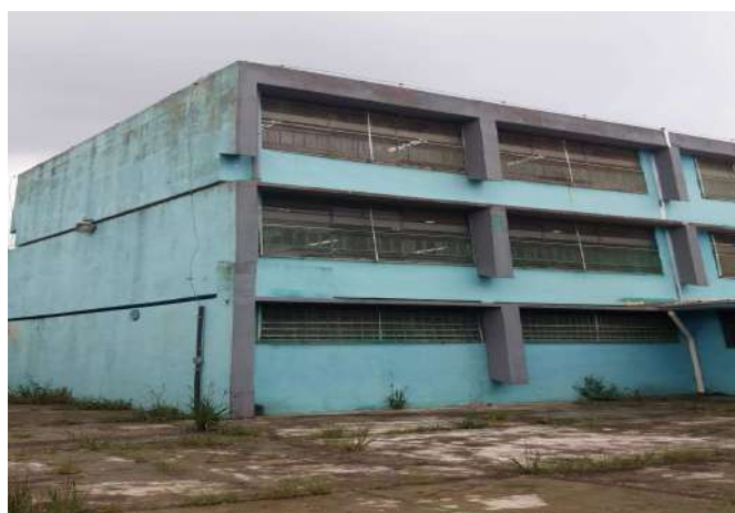
FOTO 42 fundos da escola, descascamento da pintura da unidade
