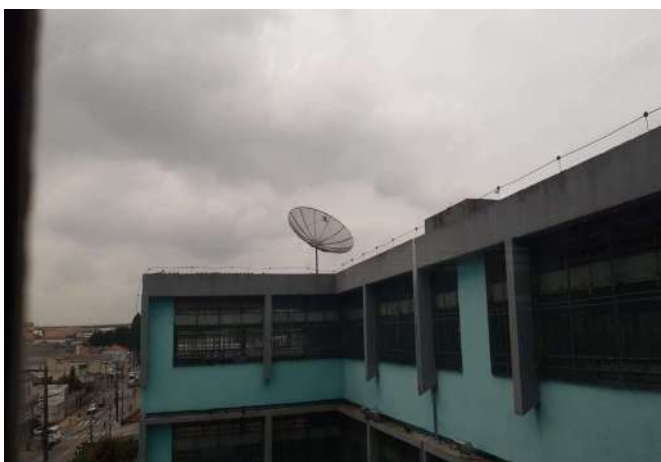
FOTO 27 Telhado da escola com vazamento
