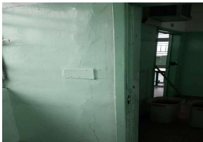
FOTO 8 Trinca na parede do corredor da sala de aula 16
