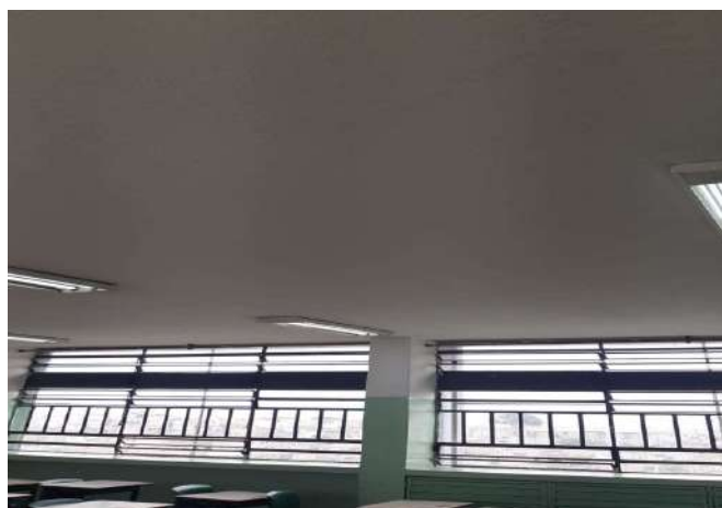
FOTO 16 Escola alega goteira na sala de aula 5
