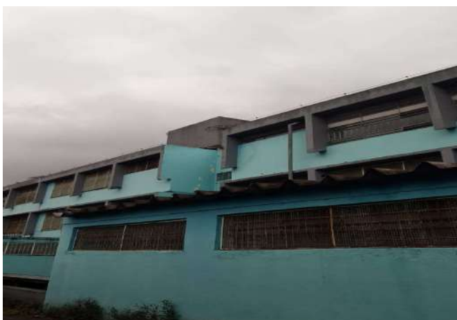
FOTO 9 Caixa da água sem guarda corpo
