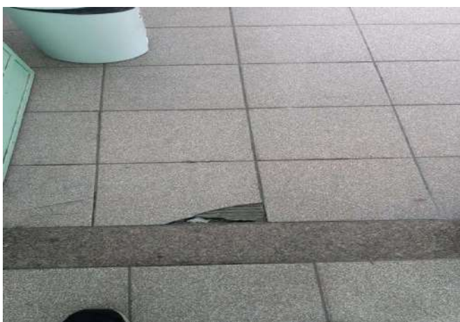
FOTO 29 Trinca no piso da sala aula 5
