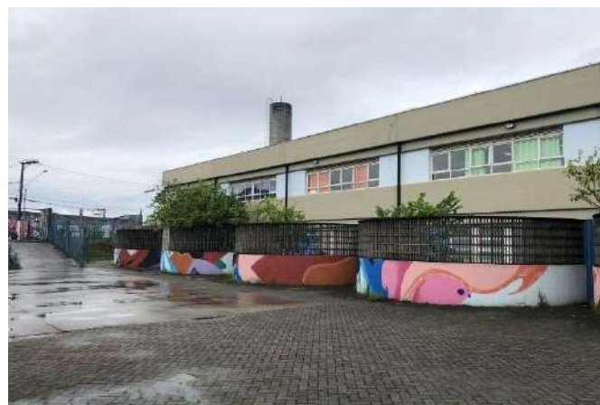
FOTO 260 PÁTIO DESCOBERTO DA ENTRADA / DANIFICADA
