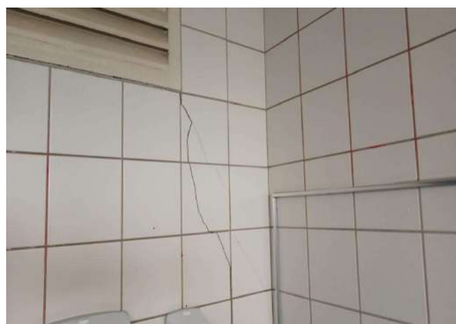
FOTO 76 BANHEIRO MASC ALUNO, PAREDE COM FISSURAS
