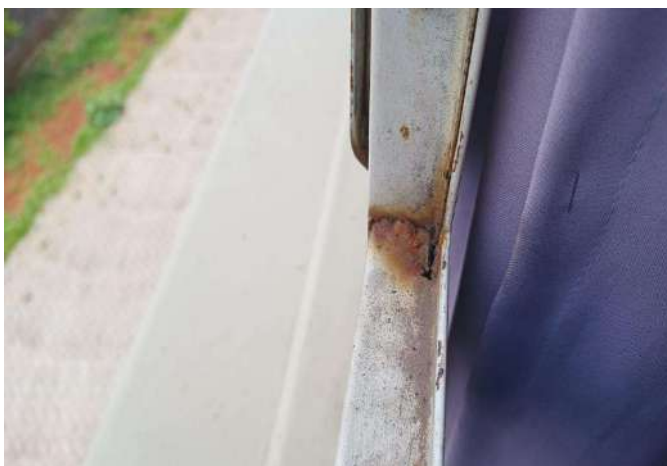
FOTO 123 SALA DE ARTES / JANELA COM FERRUGEM.
