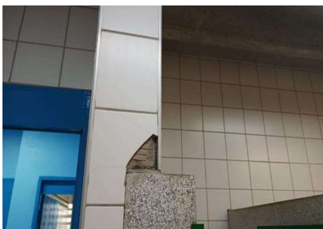
FOTO 226 BANHEIRO MASC ALUNO / PAREDE COM AZULEJO QUEBRADO.
