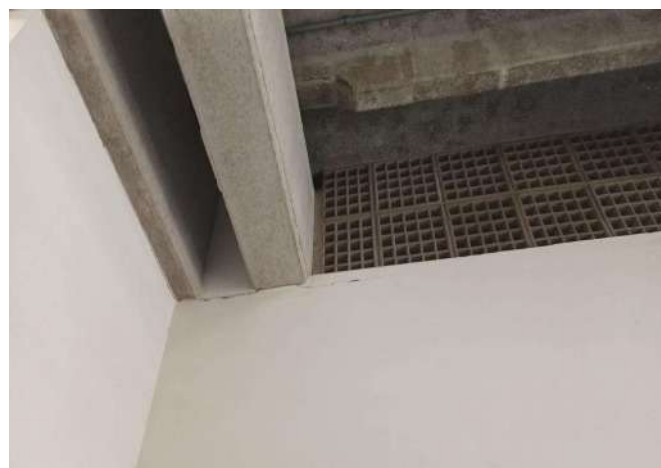
FOTO 114 SALA DE LEITURA, PAREDE COM TRINCA
