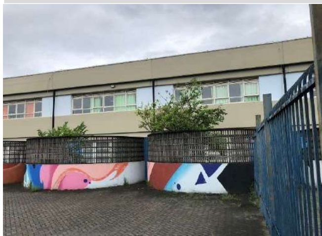
FOTO 257 PÁTIO DESCOBERTO / DANIFICADO
