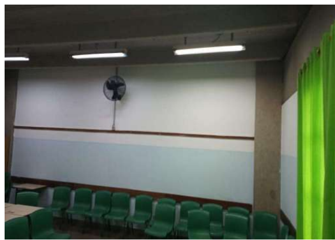
FOTO 10 SALA 1 DE ALUNO COM ADAPTAÇÕES DE TOMADAS E VENTILADORES.
