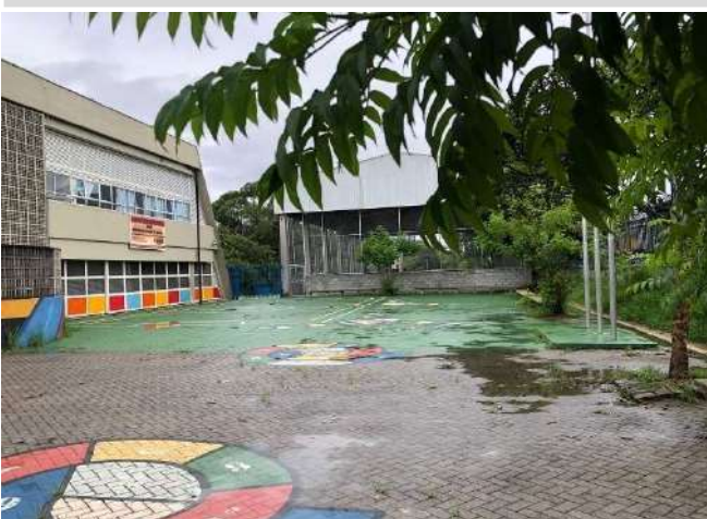
FOTO 258 PÁTIO DESCOBERTO / DANIFICADO
