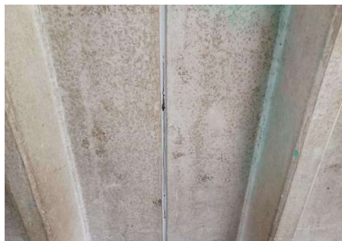
FOTO 102 SALA DE LEITURA ALUNO / TETO COM FISSURA NA JUNTA DE DILATAÇÃO.
