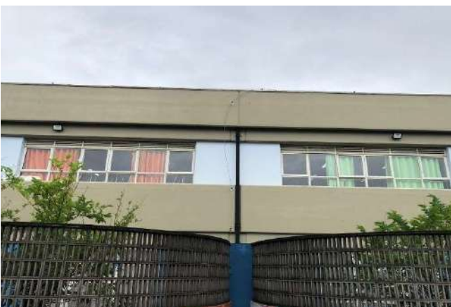
FOTO 264 SPDA DA FACHADA LATERAL DIREITA
