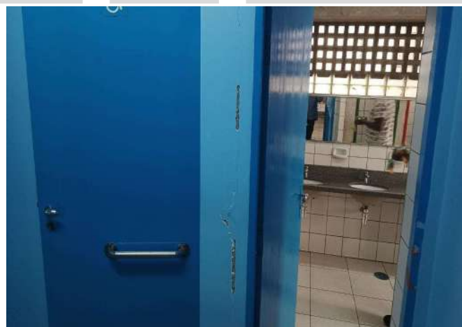
FOTO 212 BANHEIRO FEM ALUNO / PORTA FISSURA NO BATENTE
