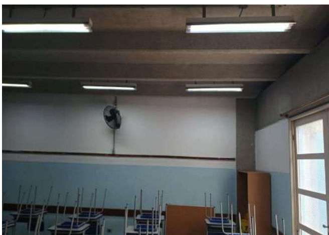
FOTO 27 SALA 4 DE ALUNO COM ADAPTAÇÕES DE TOMADAS E VENTILADORES.
