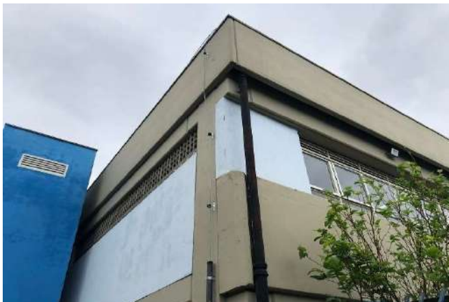
FOTO 265 SPDA DA FACHADA DA FRENTE DA ECOLA
