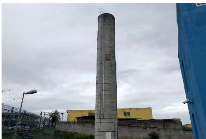
FOTO 268 SPDA DA CAIXA D'ÁGUA E CASA DE MÁQUINA
