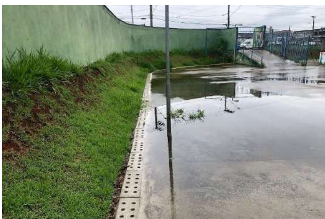
FOTO 261 PÁTIO DESCOBERTO DA ENTRADA / SEM VAZÃO DA ÁGUA DA CHUVA
