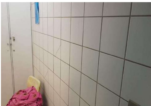
FOTO 251 COPA, LAVANDERIA E VESTIÁRIO DE FUNCIONÁRIO / AZULEJOS TRINCADOS
