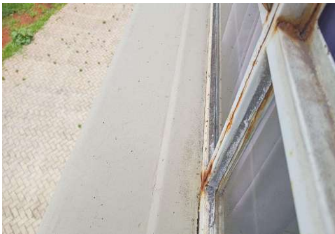
FOTO 121 SALA DE ARTES / JANELA COM FERRUGEM.
