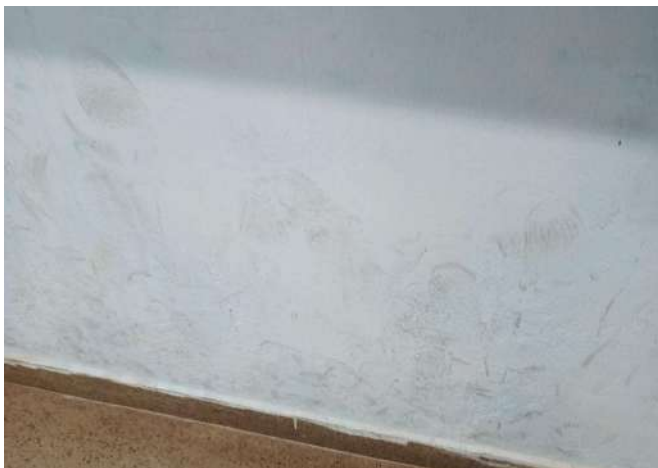
FOTO 49 SALA 6 DE ALUNO, PAREDE COM MANCHAS.
