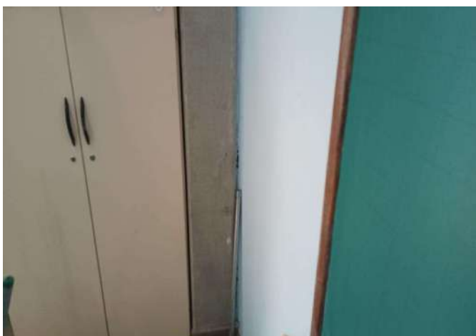
FOTO 39 SALA 5 DE ALUNO COM TRINCA NA PAREDE.
