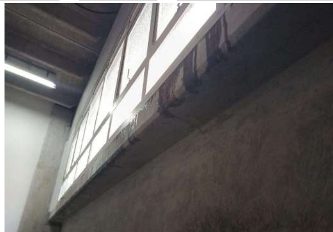
FOTO 230 PÁTIO COBERTO / JANELA DE VIDRO COM INFILTRAÇÃO
