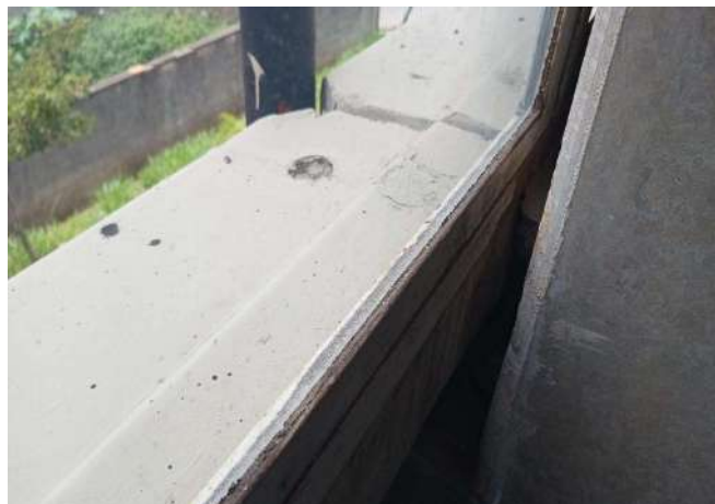
FOTO 126 SALA DE ARTES.
