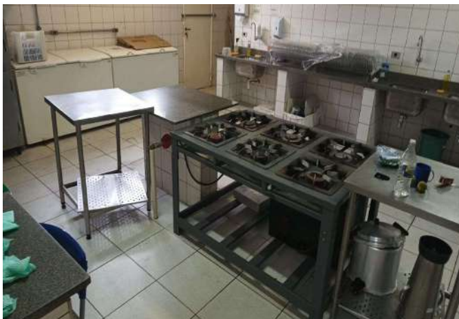
FOTO 85 COZINHA / FOGÃO SEM VALVULA DE PRESSÃO.
