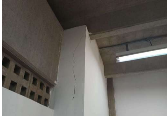
FOTO 44 SALA 5 DE ALUNO COM TRINCA NO PILAR.
