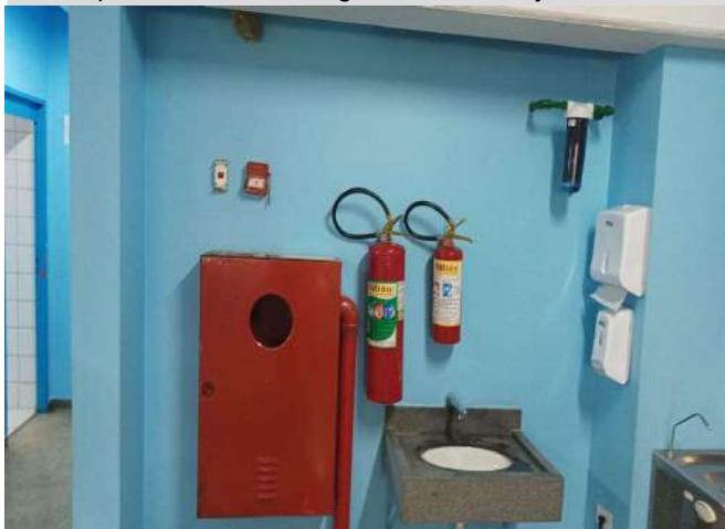
FOTO 205 HIDRANTE E EXTINTORES.
