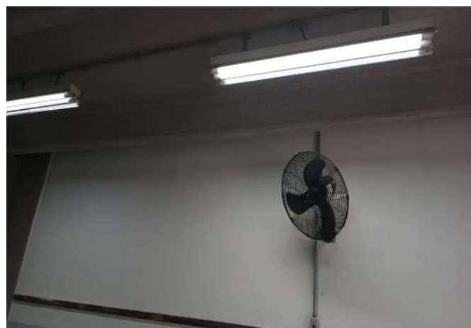
FOTO 30 SALA 4 DE ALUNO COM ADAPTAÇÕES DE TOMADAS E VENTILADORES.
