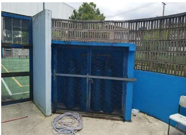
FOTO 91 ABRIGO DE GÁS / PINGADEIRAS DANIFICADAS
