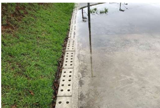
FOTO 262 PÁTIO DESCOBERTO DA ENTRADA /SEM VAZÃO DA ÁGUA DA CHUVA
