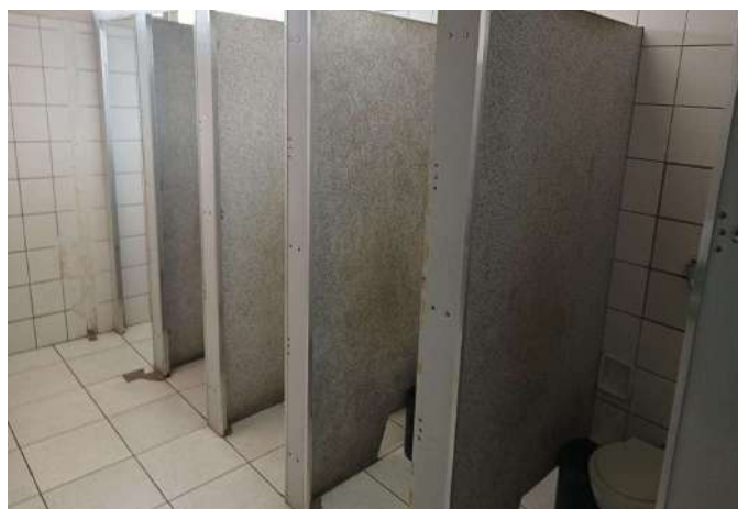
FOTO 72 BANHEIRO MASC ALUNO, DIVISA DOS VASOS SANITÁRIOS.
