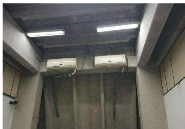
FOTO 134 SALA DE LABORATÓRIO DE INFORMÁTICA / AR CONDICIONADO.
