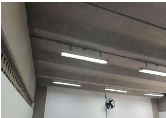
FOTO 35 SALA 4 DE ALUNO COM ADAPTAÇÕES DE TOMADAS E VENTILADORES.
