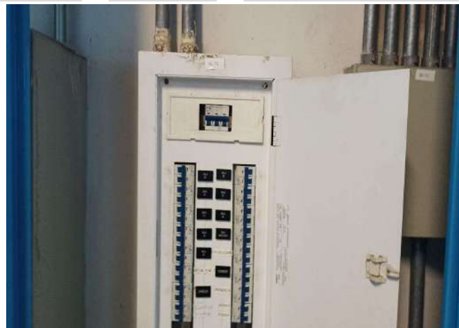
FOTO 254 QUADRO DE ENERGIA.
