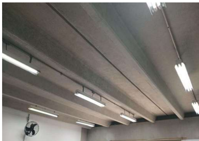
FOTO 36 SALA 4 DE ALUNO COM ADAPTAÇÕES DE TOMADAS E VENTILADORES.
