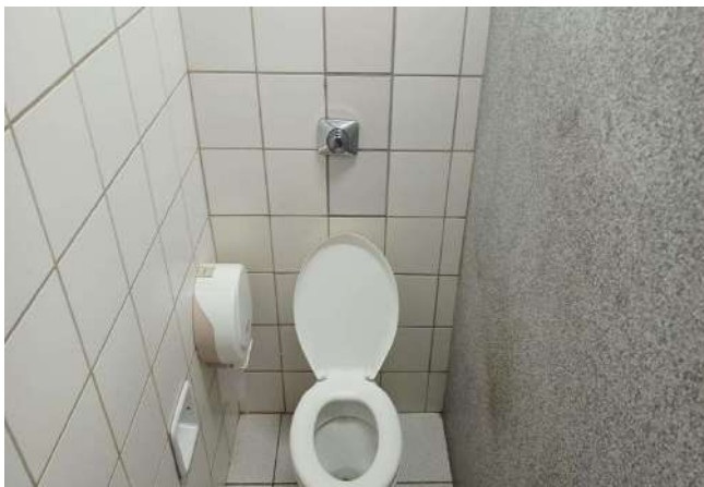
FOTO 247 BANHEIRO FEM FUNCIONÁRIO / VASO SANITÁRIO
