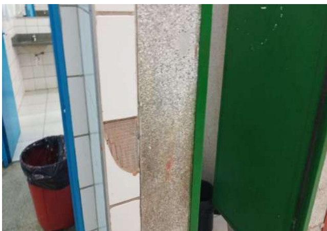
FOTO 227 BANHEIRO MASC ALUNO / PAREDE COM AZULEJO QUEBRADO.
