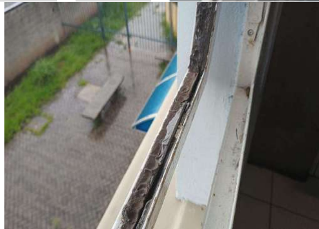
FOTO 224 BANHEIRO MASC ALUNO / JANELA DANIFICADA.
