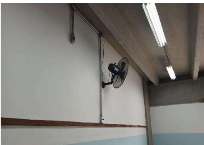
FOTO 45 SALA 5 DE ALUNO COM ADAPTAÇÕES DE TOMADAS E VENTILADORES.
