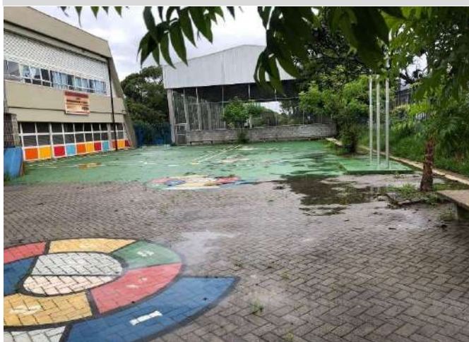
FOTO 256 PÁTIO DESCOBERTO / DANIFICADO.
