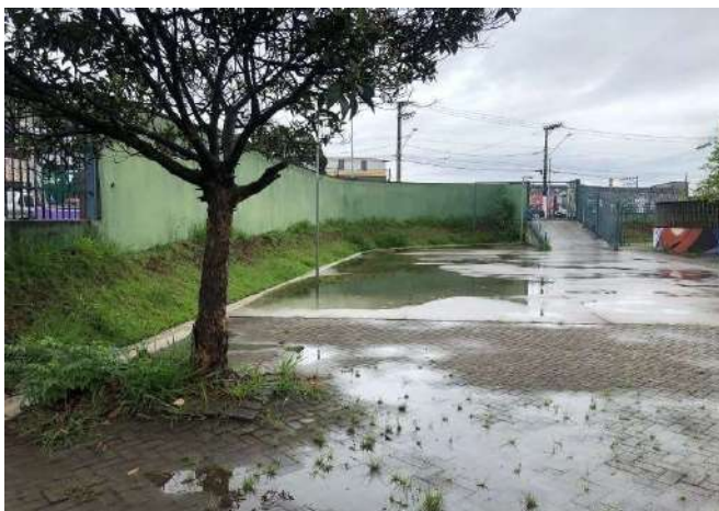
FOTO 259 PÁTIO DESCOBERTO DA ENTRADA / DANIFICADO
