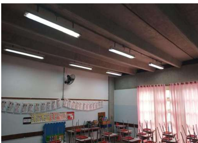
FOTO 21 SALA 2 DE ALUNO COM ADAPTAÇÕES DE TOMADAS E VENTILADORES.
