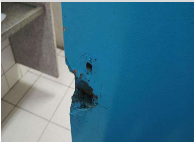
FOTO 244 BANHEIRO MASC FUNCIONÁRIO / PAREDE DANIFICADA DOS VASOS SANITÁRIO
