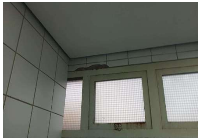
FOTO 248 BANHEIRO FEM FUNCIONÁRIO / JANELA COM FILTRAÇÃO E REVESTIMNTO QUEBRADO
