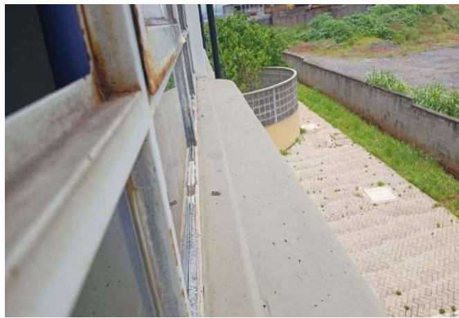
FOTO 122 SALA DE ARTES / JANELA COM FERRUGEM.
