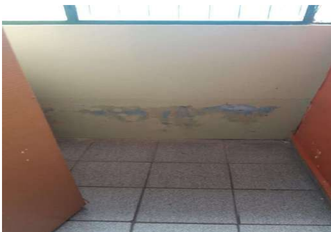
FOTO 17 INFILTRAÇÃO NA PAREDE DA SALA DE AULA 4
