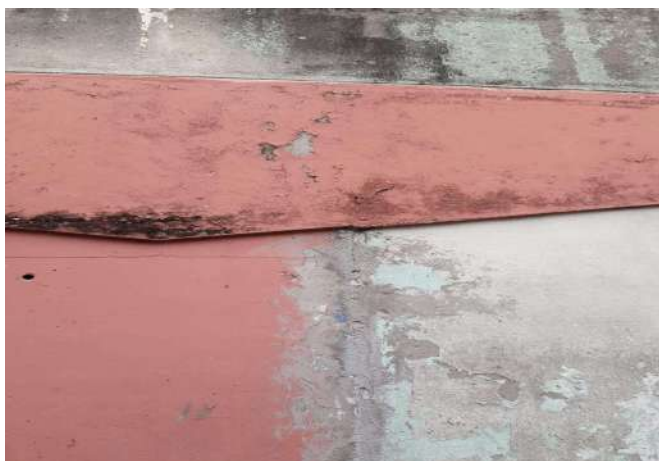
FOTO 29 TRINCA E INFILTRAÇÃO NA PAREDE EXTERNA DA SALA DE AULA 7
