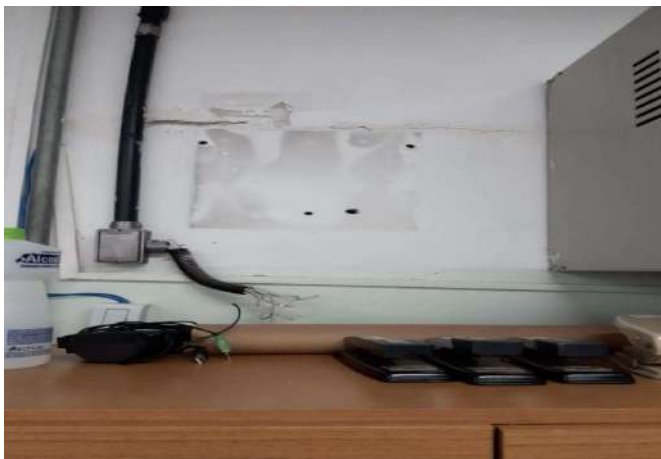
FOTO 31 TRINCA NA SALA DA SECRETARIA
