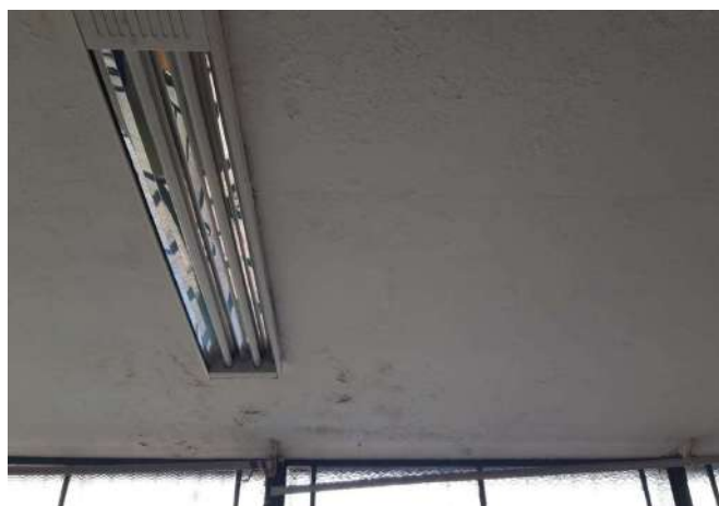
FOTO 28 INFILTRAÇÃO NO TETO DA SALA 4
