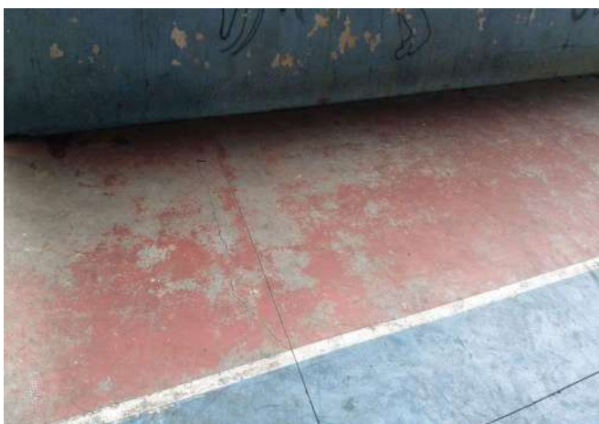
FOTO 39 TRINCA NA PINTURA NA QUADRA COBERTA
