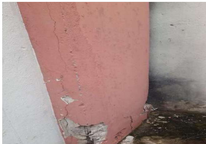
FOTO 26 ARMADURA EXPOSTA NA VIGA NA ENTRADA DA UNIDADE
