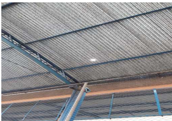
FOTO 27 VAZAMENTO NO TELHADO DA QUADRA COBERTA
