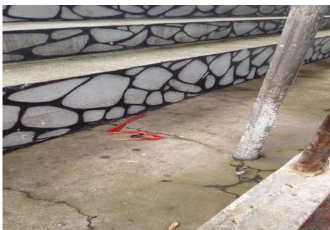
FOTO 35 TRINCA NO PISO E NA ARQUIBANCADA DA QUADRA COBERTA
