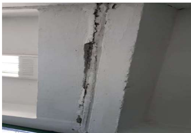
FOTO 45 AFASTAMENTO ENTRE VIGAS NO CORREDOR DE ACESSO A SALA DE AULA 9
