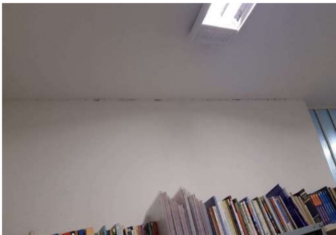
FOTO 25 TRINCAS NA SALA DE LEITURA
