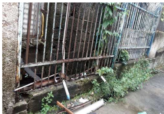
FOTO 18 PINTURA E UMIDADE DEVIDO A FALTA DE SISTEMA DE DRENAGEM DE ÁGUA PLUVIAIS
