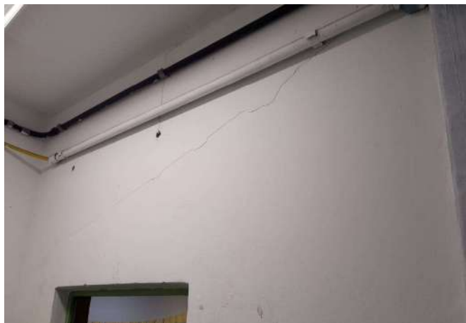
FOTO 43 TRINCA NA ENTRADA DA SALA DE AULA 8
