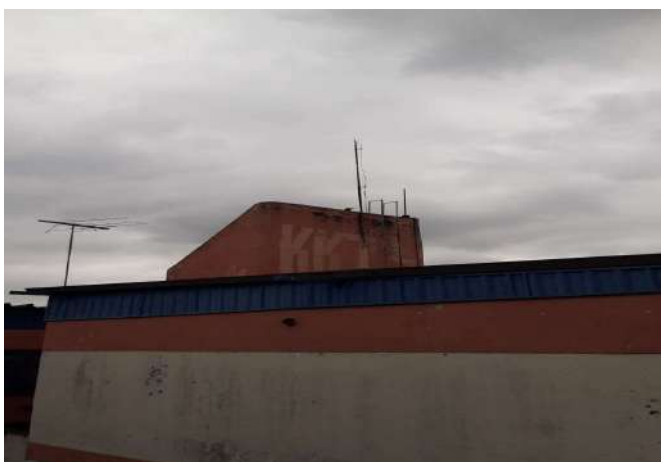
FOTO 33 CAIXA D'ÁGUA 2 SEM GUARDA CORPO E FALTA PINTURA E POUCA PRESSÃO
