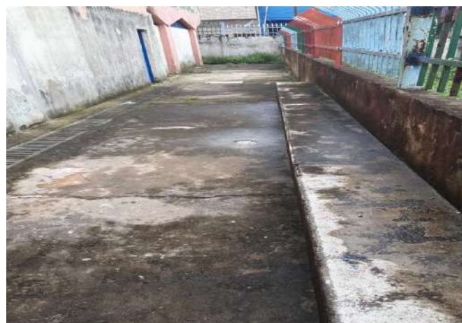
FOTO 34 TRINCA E INFILTRAÇÃO NO CORREDOR EXTERNO PARA QUADRA
