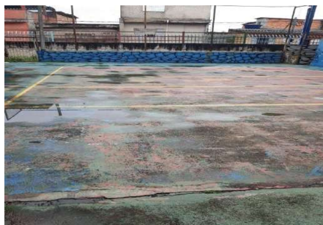
FOTO 16 QUADRA DESCOBERTA NECESSITA DE REFORMA DO PISO
