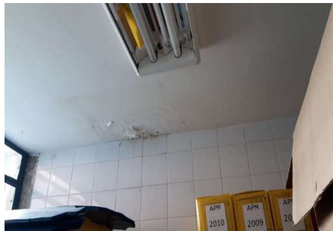
FOTO 32 INFILTRAÇÃO NO ARQUIVO MORTO ORIUNDO DO BANHEIRO FEMININO DOS PROFESSORES
