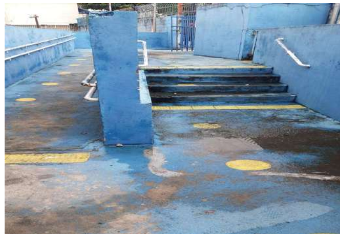
FOTO 44 TRINCA E INFILTRAÇÃO DA RAMPA E ESCADA NA ENTRADA DOS ALUNOS
