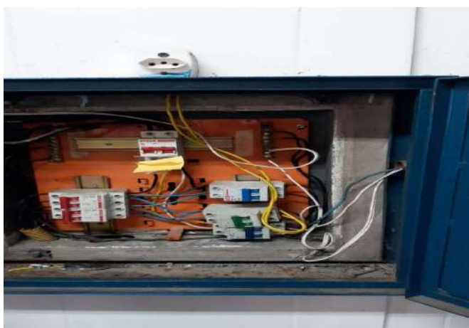
FOTO 29 REVISÃO ELÉTRICA DA ESCOLA
