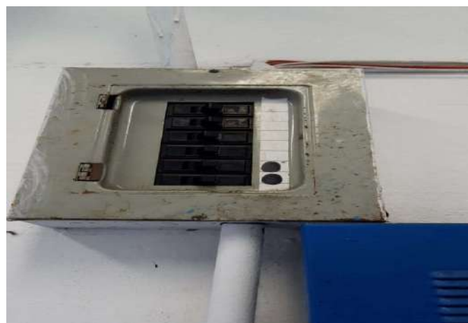
FOTO 28 REVISÃO ELÉTRICA DA ESCOLA
