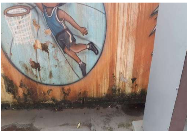
FOTO 27 UMIDADE E INFILTRAÇÕES NA QUADRA COBERTA
