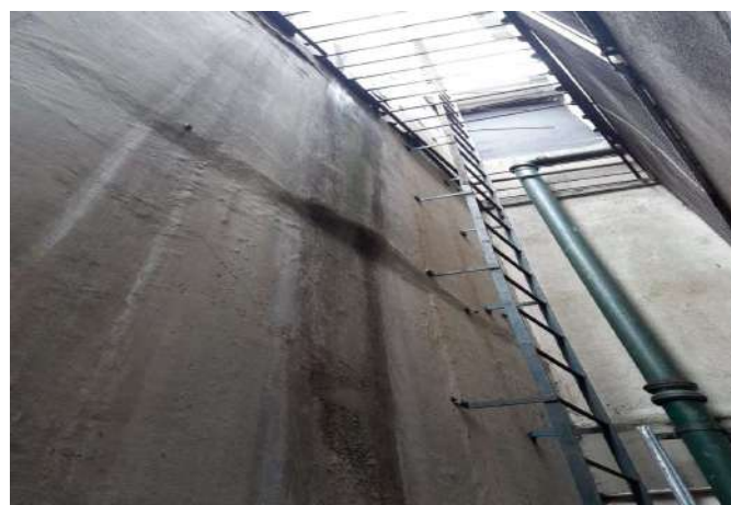
FOTO 6 CAIXA D'ÁGUA FUNCIONAMENTO SEM GUARDA CORPO
