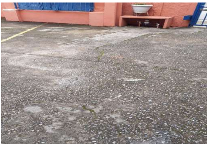
FOTO 23 TRINCA NO PISO DO ESTACIONAMENTO
