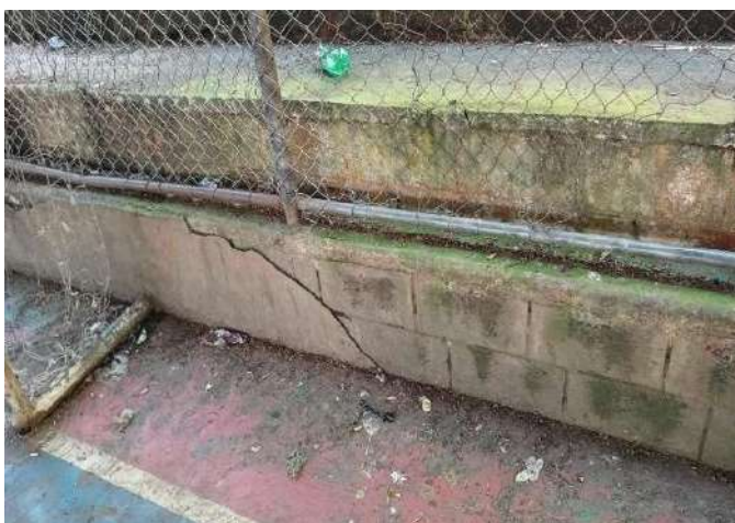
FOTO 111 PAREDE DA QUADRA DANIFICADA.
