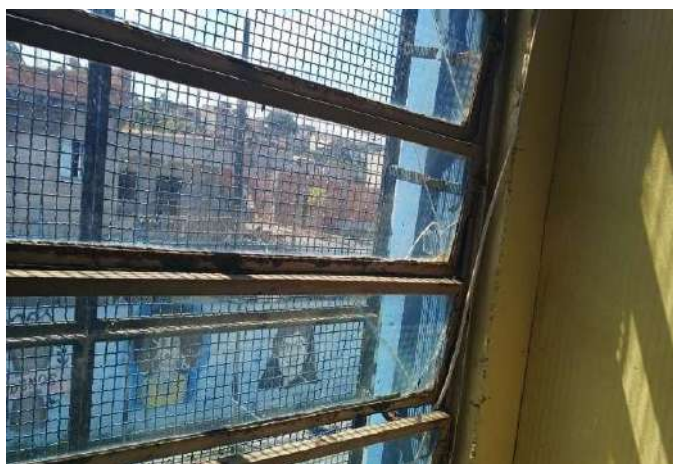
FOTO 261 SALA DE AULA 11 COM VIDRO QUEBRADO.
