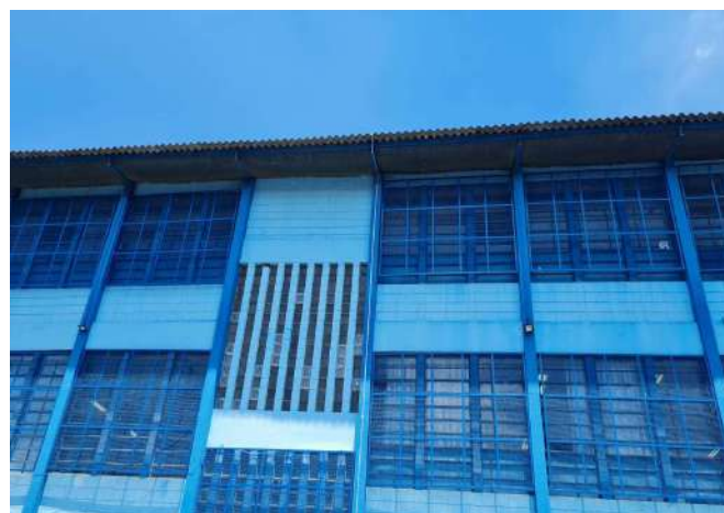
FOTO 88 SPDA FACHADA LATERAL / DIREITA.
