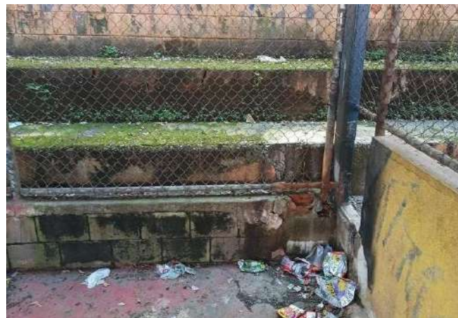
FOTO 110 QUADRA COBERTA, MURO DANIFICADO.
