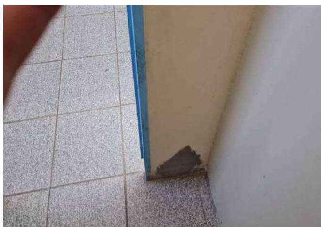
FOTO 76 PAREDE DO BANHEIRO DE FUNCIONÁRIOS UNISSEX.
