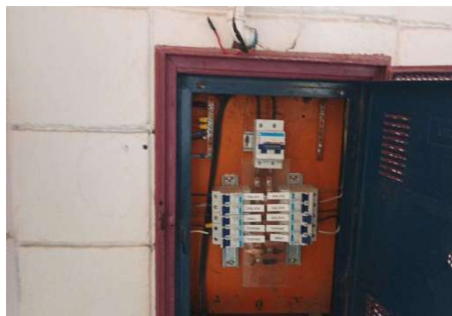
FOTO 242 QUADRO DE ENERGIA.
