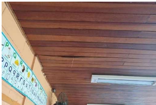
FOTO 249 SALA DE AULA 13 COM FORRO DANIFICADO.
