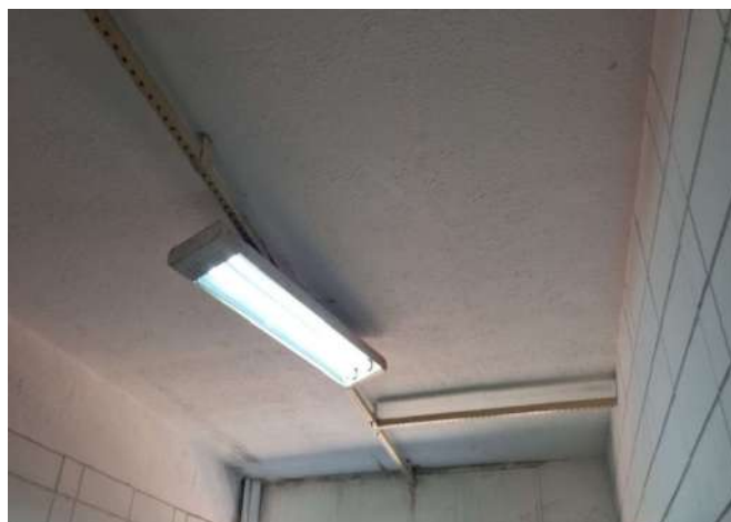
FOTO 66 BANHEIRO FEMININO ALUNO, IMPROVISO NA ELÉTRICA.
