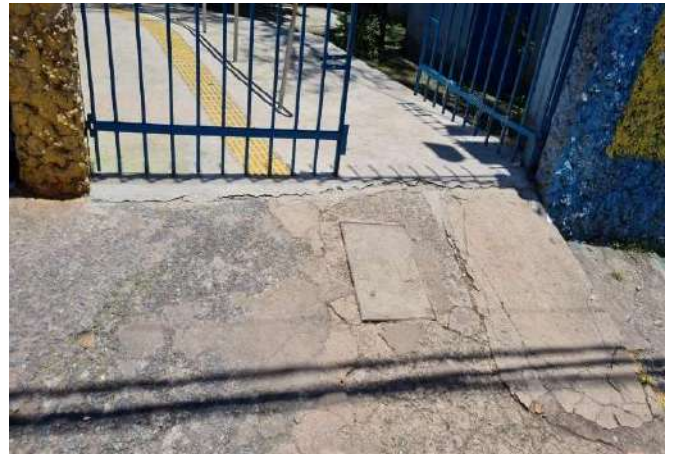
FOTO 2 PISO DA ENTRADA FISSURADO
