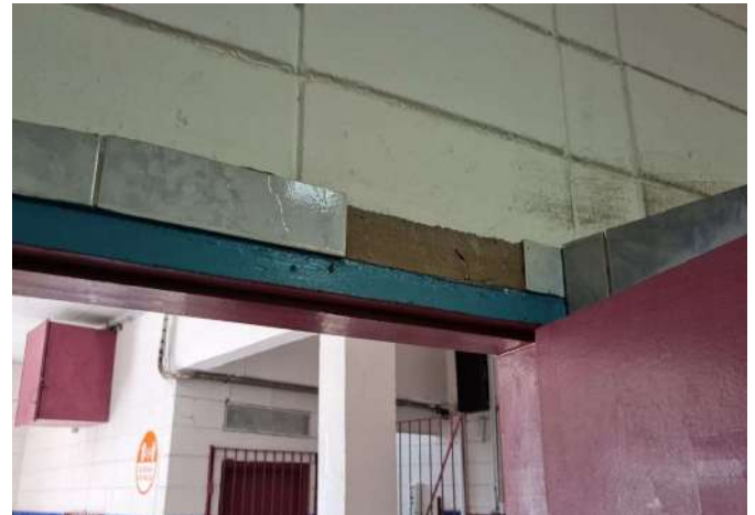
FOTO 80 BANHEIRO FEMININO ALUNOS, AZULEJO DANIFICADO.
