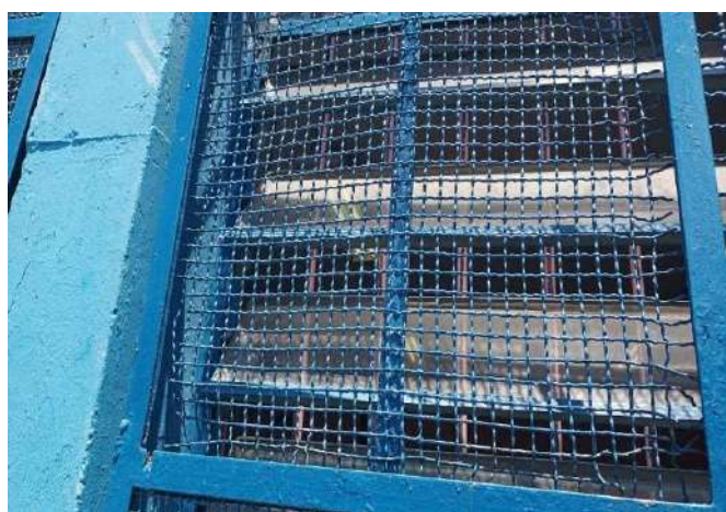
FOTO 118 JANELAS EXTERNAS, GRADE DE PROTEÇÃO DANIFICADA.
