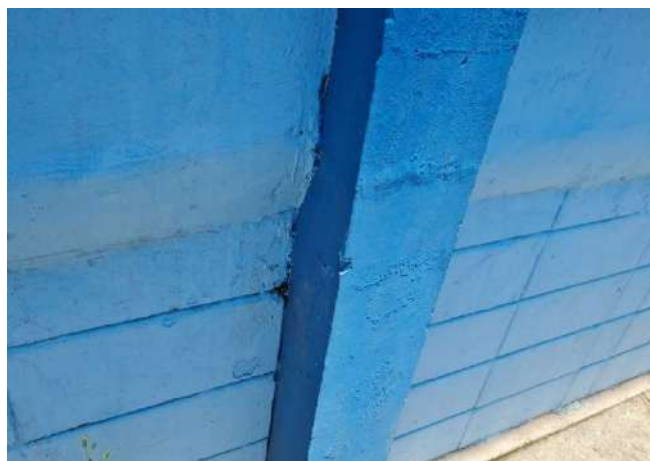
FOTO 18 CORREDOR DE ACESSO AO PÁTIO / PILAR DANIFICADO.
