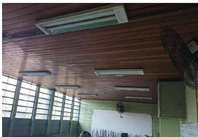
FOTO 245 SALA DE AULA 14, ADAPTAÇÕES PARA TOMADAS E VENTILADORES.
