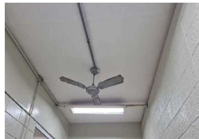
FOTO 33 ADAPTAÇÕES DE TOMADAS E VENTILADORES.
