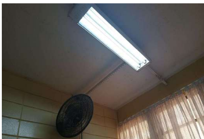
FOTO 139 SECRETARIA, COM ADAPTAÇÕES DE TOMADAS E VENTILADORES.
