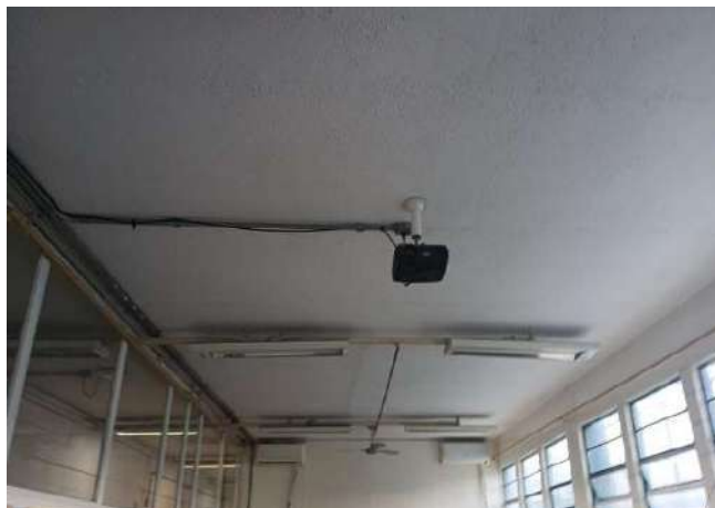
FOTO 195 SALA DE LEITURA, ADAPTAÇÕES DE TOMADAS E LEITURA.
