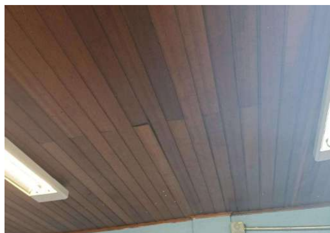
FOTO 254 SALA DE AULA 12 COM FORRO DE MADEIRA DANIFICADO.
