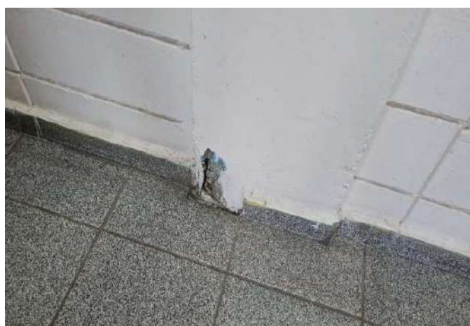
FOTO 46 CORREDOR DA SECRETARIA PILAR COM ARMADURA EXPOSTA.
