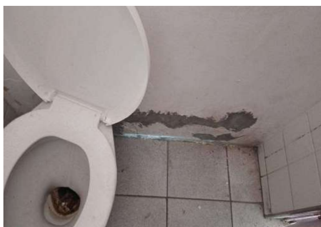
FOTO 154 BANHEIRO FEM ALUNO, VASO DANIFICADO, ENTUPIMENTO E INFILTRAÇÕES.
