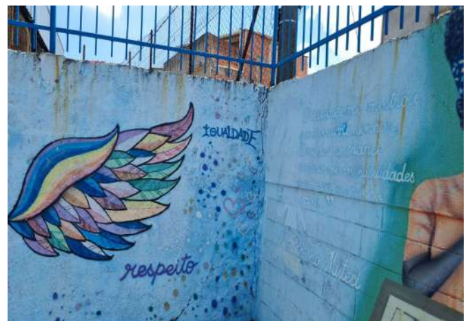
FOTO 84 MURO DE DIVISA DA LATERAL DIREITA COM TRINCA E FISSURA.
