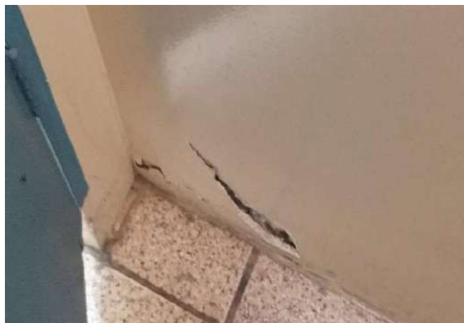
FOTO 231 BANHEIRO MASCULINO FUNCIONÁRIOS, PAREDE COM PARTES SOLTAS.
