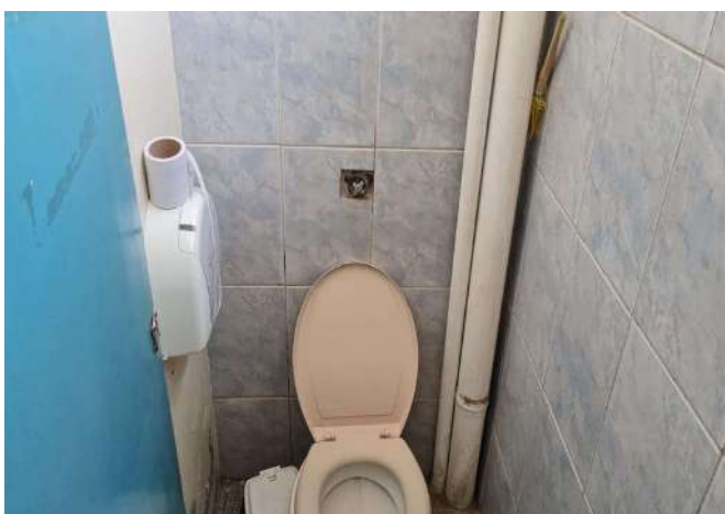
FOTO 71 BANHEIRO DE FUNCIONÁRIO, AUSÊNCIA DE ACABAMENTO DE VÁLVULA DE DESCARGA.
