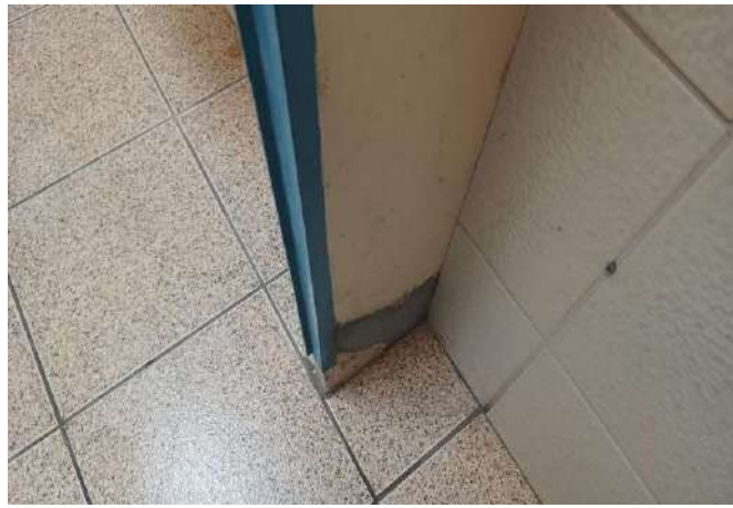
FOTO 232 BANHEIRO MASCULINO FUNCIONÁRIOS, REMENDO NO GRANILITE DA DIVISÓRIA.
