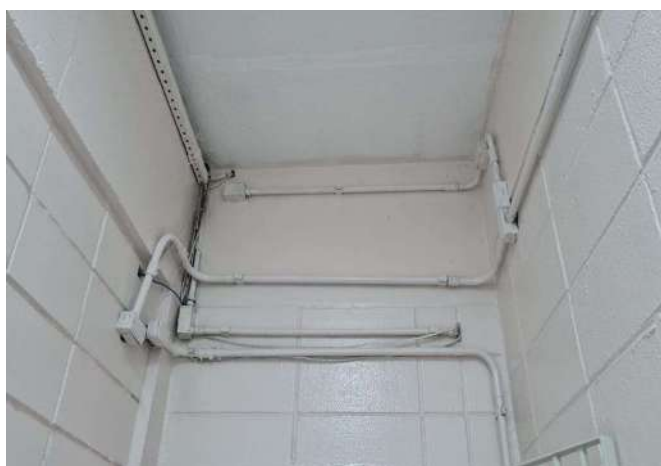
FOTO 47 CORREDOR ADAPTAÇÕES DE TOMADAS.
