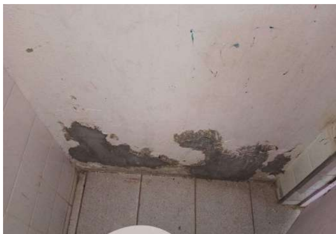
FOTO 157 BANHEIRO FEM ALUNO PAREDE INFILTRADA COM PARTES SOLTAS.
