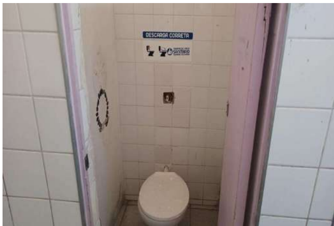
FOTO 156 BANHEIRO FEM ALUNO, VÁLVULA DE DESCARGA SEM ACABAMENTO E AZULEJOS TRINCADOS.
