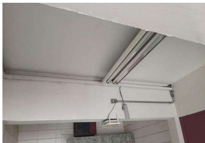
FOTO 241 SALA DE AULA 10 COM IMPROVISO NAS INSTALAÇÕES ELÉTRICAS.
