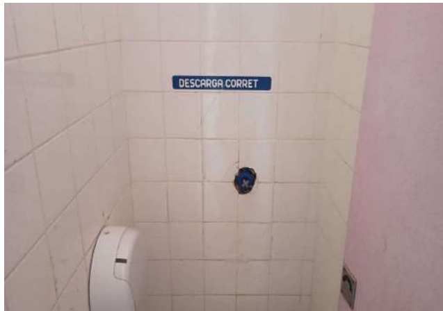
FOTO 155 BANHEIRO FEM ALUNOS, VÁLVULA DE DESCARGA DANIFICADA E SEM ACABAMENTO.
