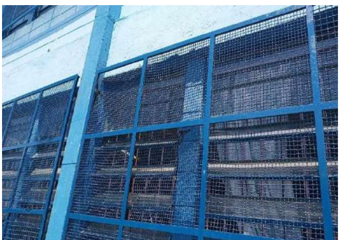
FOTO 119 JANELAS EXTERNAS GRADE DE PROTEÇÃO DANIFICADA.
