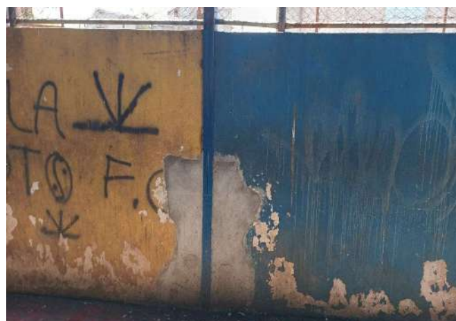
FOTO 90 PAREDE DA QUADRA COBERTA, PARTES SOLTAS.
