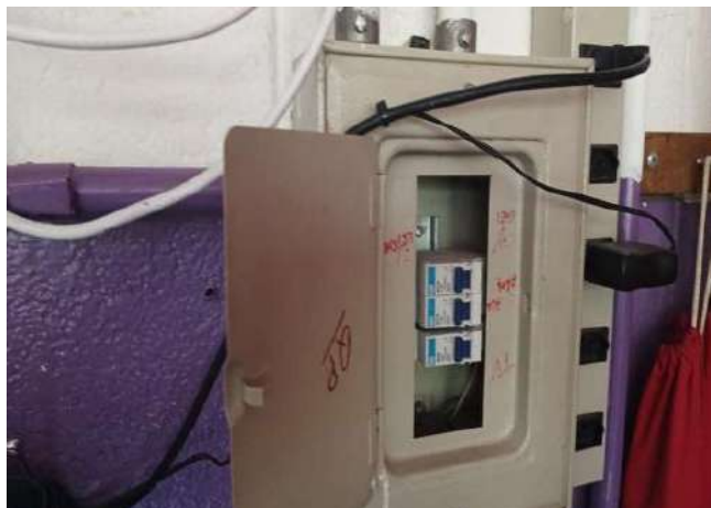
FOTO 189 QUADRO DE ENERGIA.
