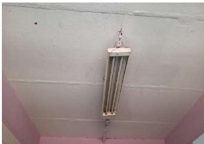
FOTO 159 BANHEIRO FEM ALUNO, IMPROVISO NA PARTE ELÉTRICA E FIOS APARENTES.
