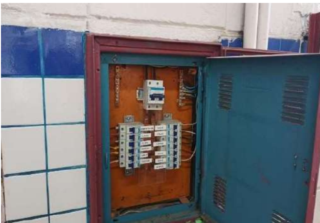
FOTO 169 QUADRO DE ENERGIA (QDE).
