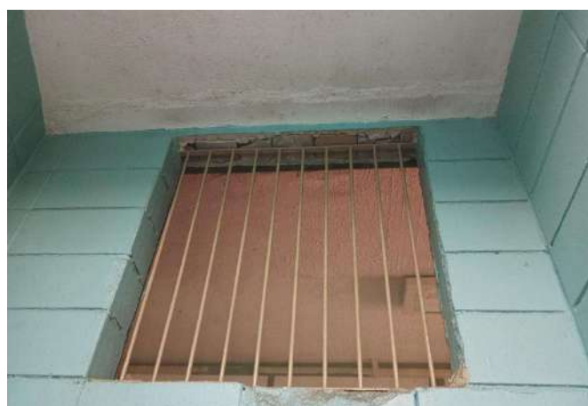
FOTO 142 SALA DE ARQUIVO COM GRADE DANIFICADA.
