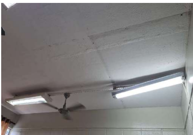
FOTO 29 ADAPTAÇÕES DE TOMADAS E VENTILADORES NA SECRETARIA.
