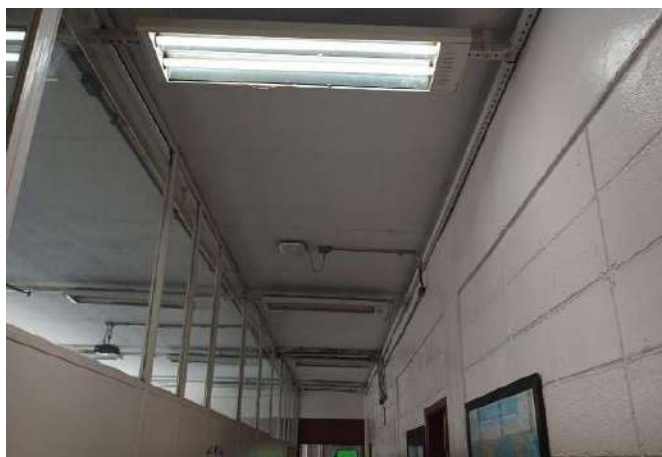
FOTO 181 CORREDOR COM ADAPTAÇÕES DE TOMADAS E VENTILADORES.
