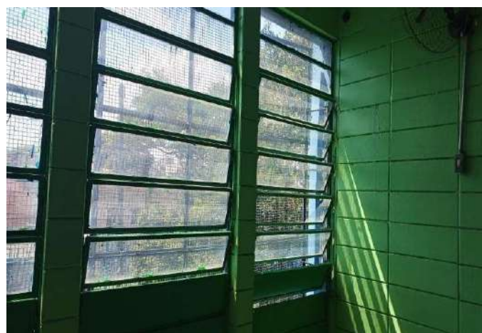
FOTO 239 SALA DE AULA 10 COM VIDRO QUEBRADO.
