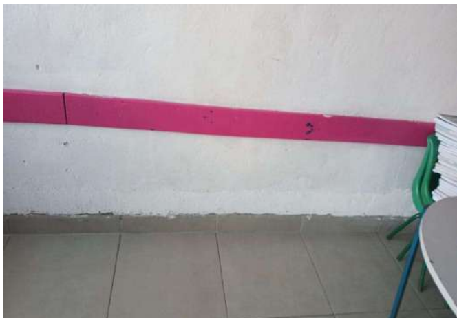
FOTO 213 SALA DE AULA 07 PAREDE DANIFICA
