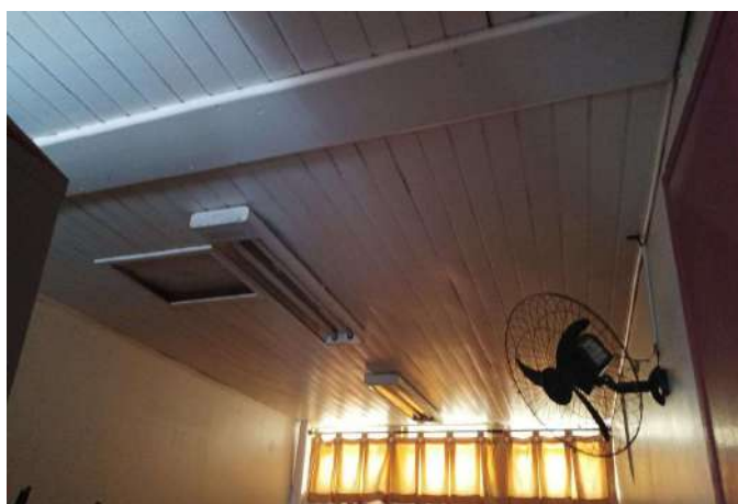
FOTO 203 SALA DE RÁDIO, ADAPTAÇÕES DE TOMADAS E VENTILADORES.
