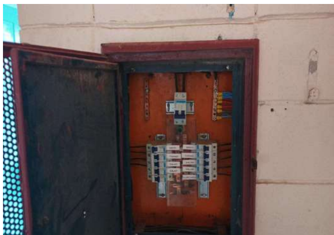
FOTO 197 QUADRO DE ENERGIA (QDE).
