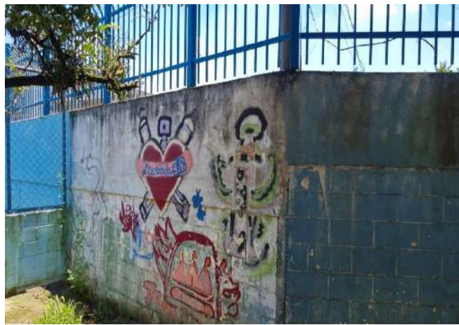
FOTO 8 PAREDE COM TRINCAS NA SECRETARIA
