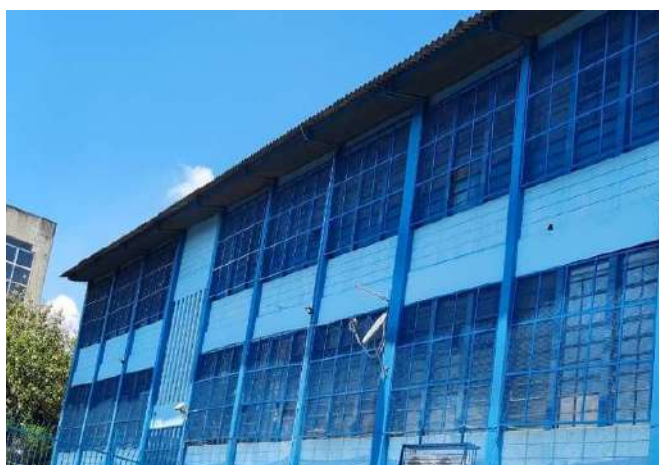
FOTO 89 SPDA FACHADA, LATERAL DIREITA.
