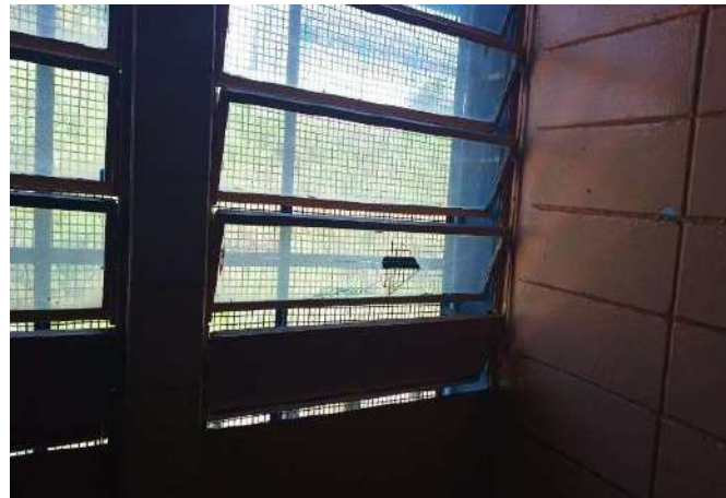
FOTO 250 SALA DE AULA 13, VIDRO DA JANELA QUEBRADO.
