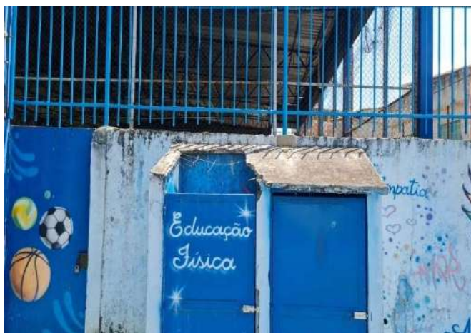
FOTO 87 DEPÓSITO DE EDUCAÇÃO FÍSICA, ESTRUTURA DANIFICADA.
