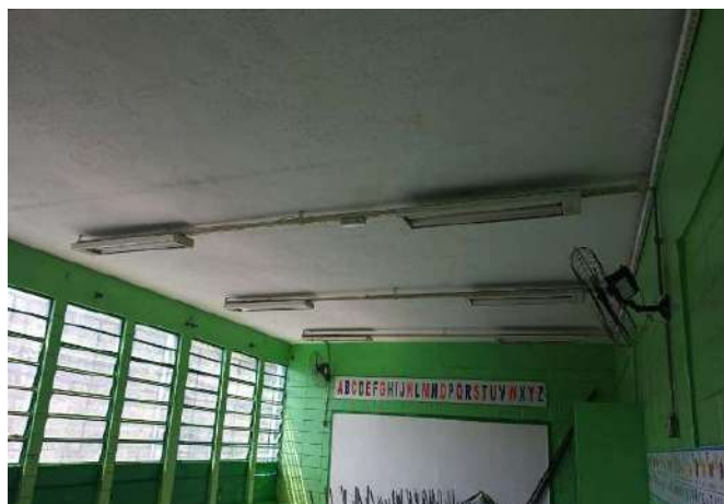
FOTO 238 SALA DE AULA 10 COM ADAPTAÇÕES DE TOMADAS E VENTILADORES.
