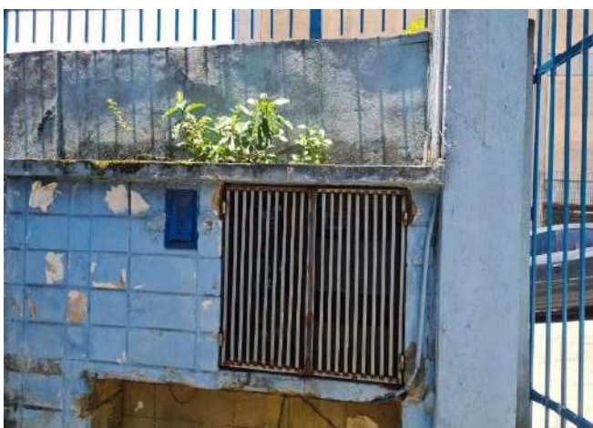
FOTO 5 ENTRADA DE ENERGIA
