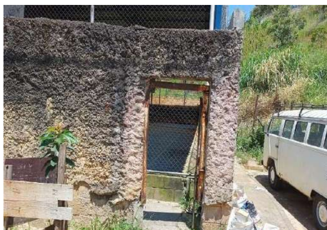
FOTO 102 MURO DE DIVISA, REBOCO APRESENTA PARTES SOLTAS E SOM CAVO.
