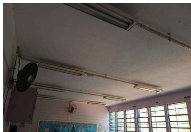
FOTO 235 SALA DE AULA 09, COM ADAPTAÇÕES DE TOMADAS E VENTILADORES.
