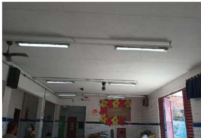
FOTO 122 PÁTIO INTERNO, ADAPTAÇÕES DE TOMADAS E VENTILADORES.
