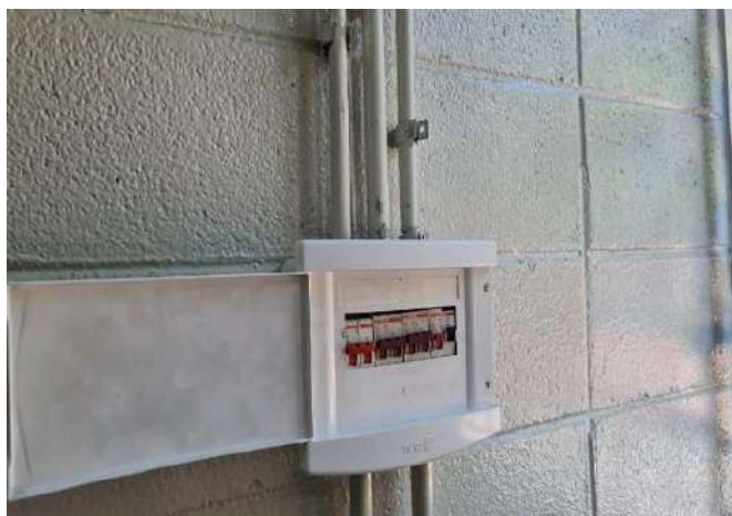
FOTO 43 QUADRO DE ENERGIA.
