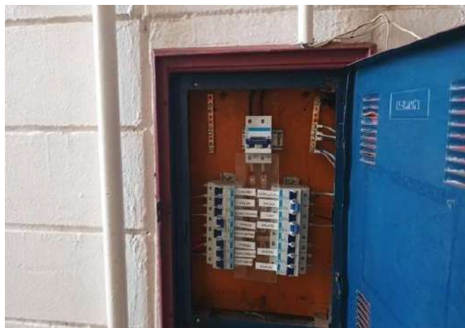
FOTO 240 QUADRO DE ENERGIA (QDE).
