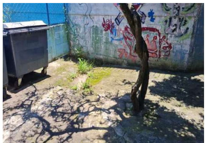
FOTO 6 PÁTIO EXTERNO PISO COM TRINCAS
