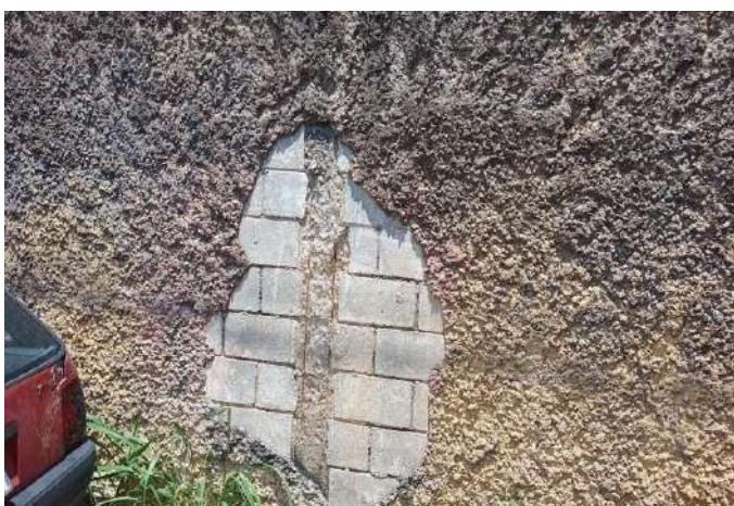
FOTO 101 MURO DE DIVISA, REBOCO APRESENTA PARTES SOLTAS E SOM CAVO.
