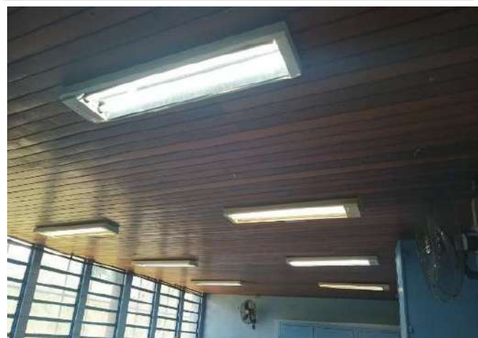
FOTO 253 SALA DE AULA 12 COM FORRO DE MADEIRA DANIFICADO.
