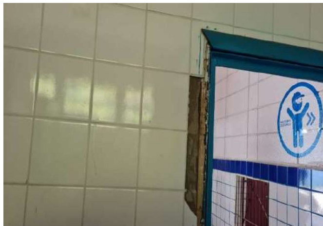
FOTO 56 BANHEIRO MASCULINO ALUNOS, AZULEJO DO BANHEIRO DANIFICADO.
