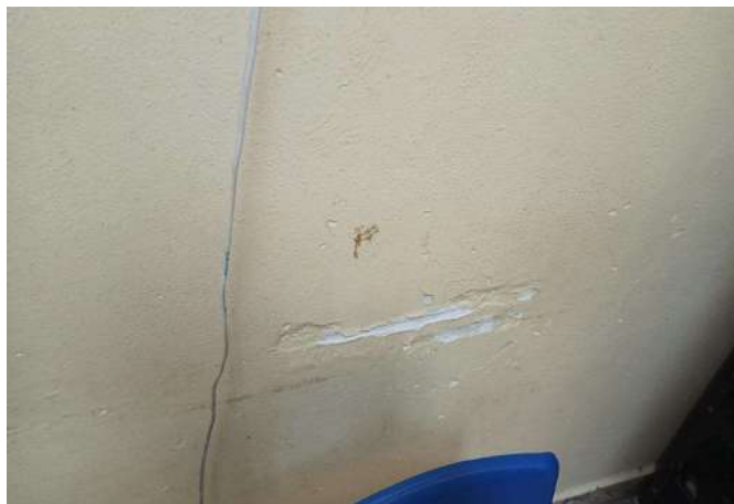
FOTO 137 ALMOJARIFADO, COM FISSURA NA PAREDE.
