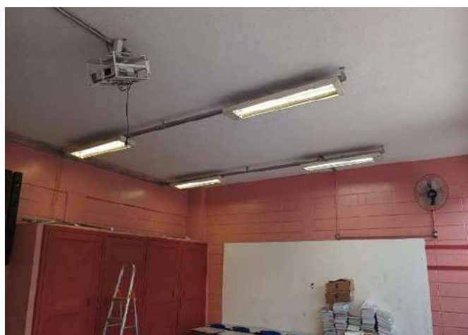
FOTO 164 SALA DE AULA 1 COM ADAPTAÇÕES DE TOMADAS E VENTILADORES.
