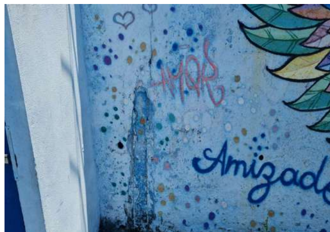
FOTO 86 MURO DE DIVISA EXTERNA, ARMADURA EXPOSTA.
