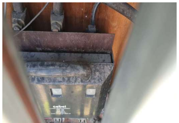
FOTO 4 ENTRADA DE ENERGIA
