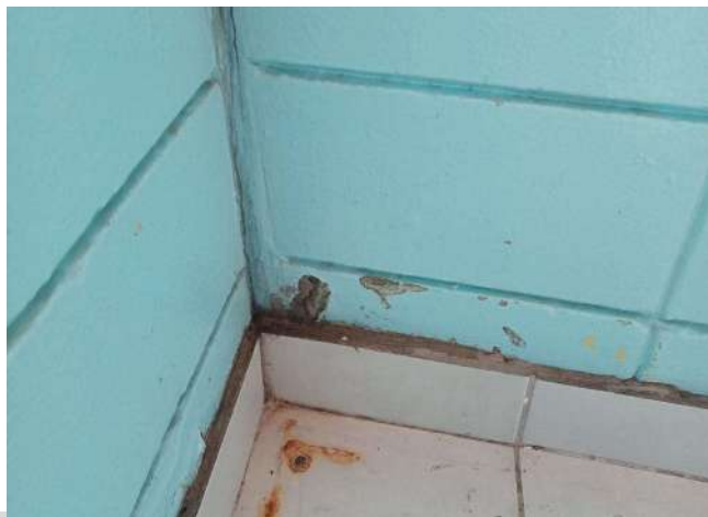
FOTO 207 SALA DE AULA 8, PAREDE INFILTRADA.
