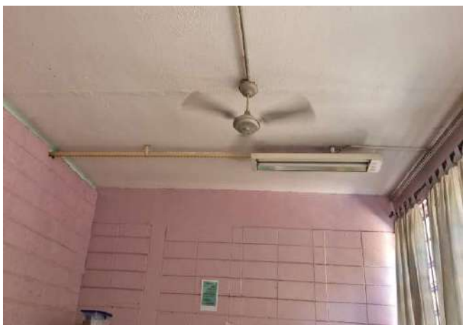
FOTO 41 SALA DE ARQUIVOS COM ADAPTAÇÕES DE TOMADAS E VENTILADORES.
