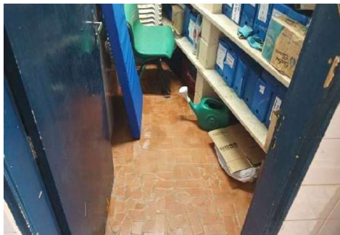
FOTO 140 ALMOJARIFADO, COM PISO DANIFICADO.
