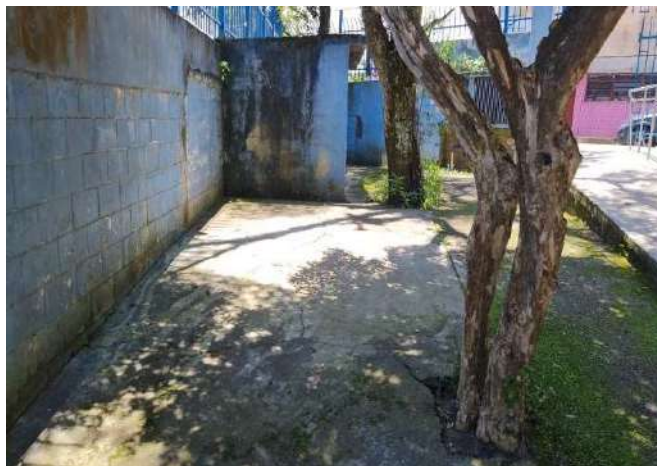
FOTO 7 PISO EXTERNO FISSURA
