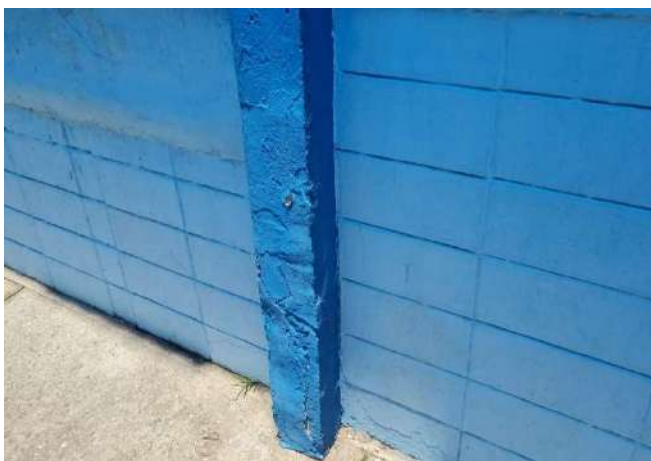
FOTO 17 CORREDOR DE ACESSO AO PÁTIO / PILAR DANIFICADO.
