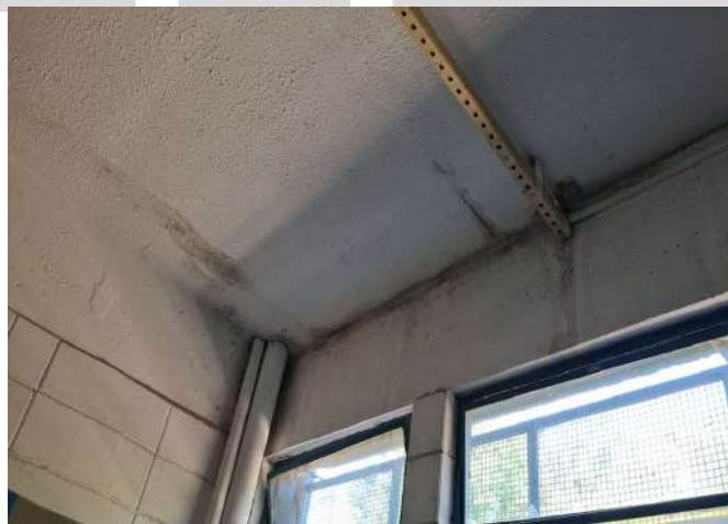
FOTO 68 BANHEIRO DE FUNCIONÁRIOS, TETO COM INFILTRAÇÃO.
