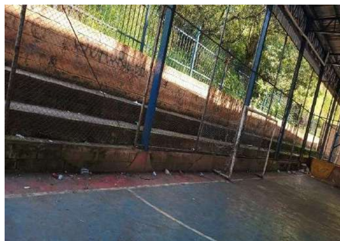
FOTO 112 QUADRA COBERTA, ALAMBRADO DANIFICADO.
