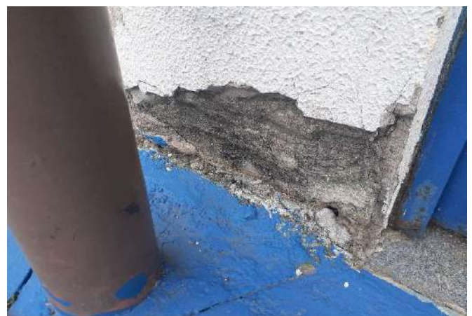
FOTO 36 Pátio Descoberto - Partes quebradas (Destacamento)
