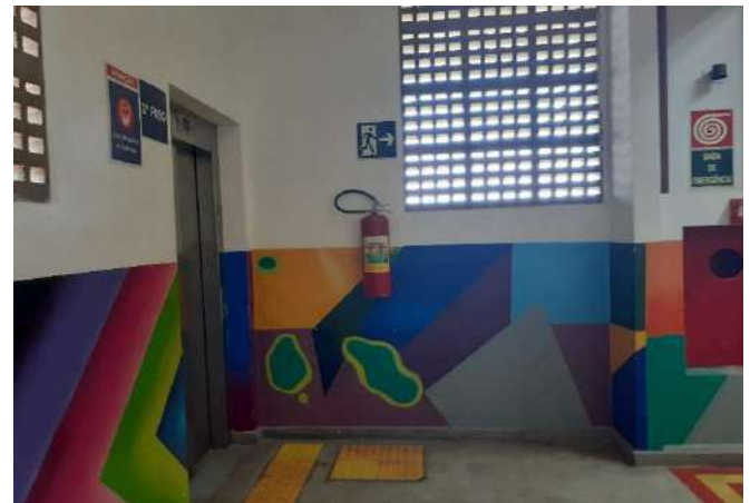
FOTO 104 Extintor - Sem placa de identificação
