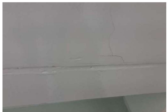
FOTO 102 Sala 23 - Fissura na parede
