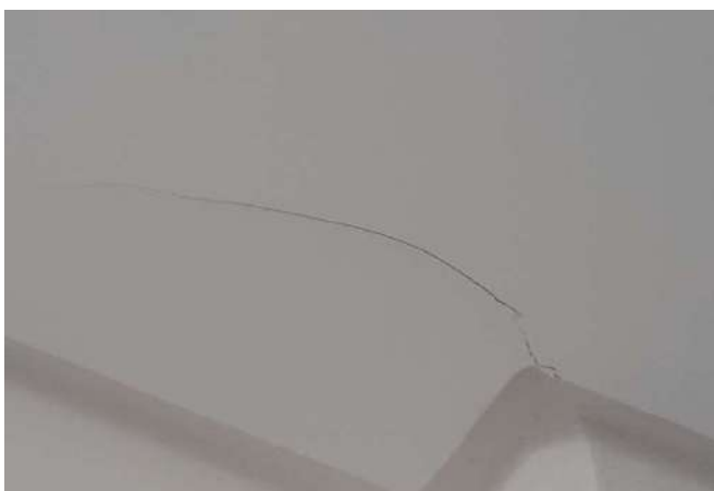
FOTO 23 Laboratório de Ciências - Trinca no teto
