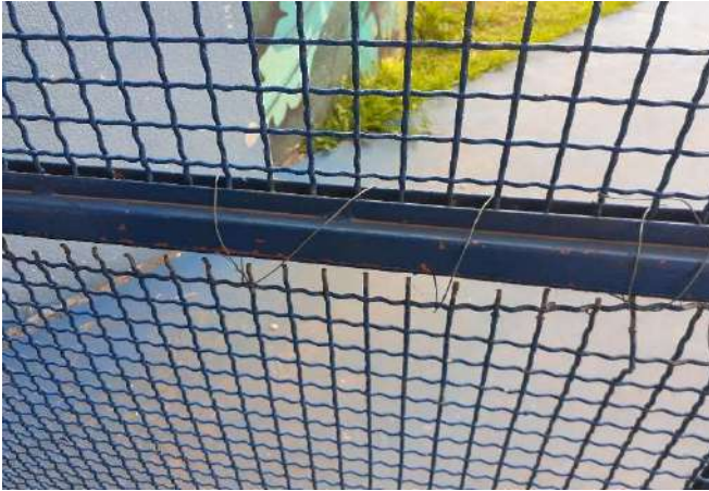
FOTO 43 Pátio Descoberto - Grade danificada
