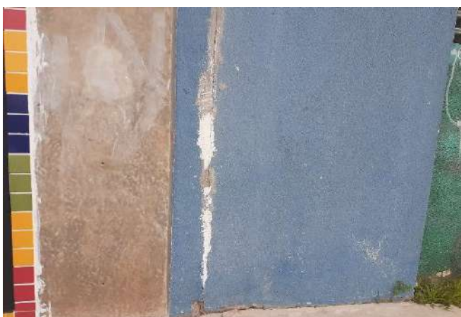
FOTO 15 Estacionamento - Parede externa trincada
