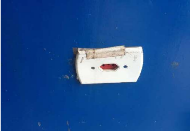
FOTO 55 Refeitório - Tomada com proteção adaptada
