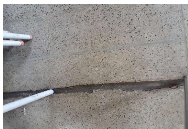
FOTO 108 Sala 27 - Juntas deficientes
