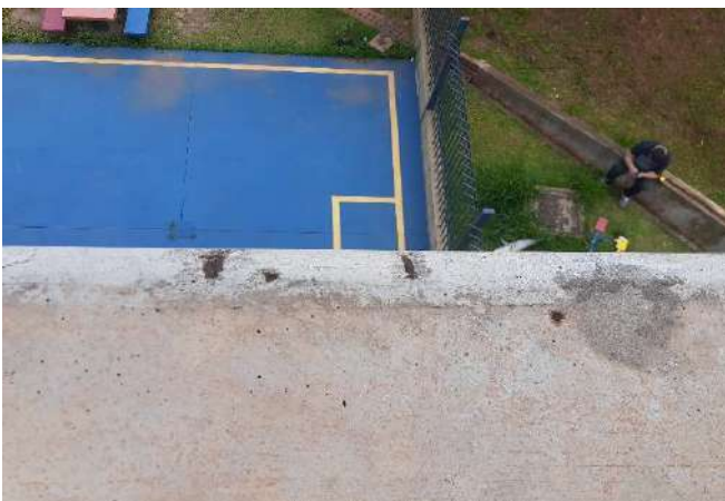
FOTO 105 Sala 28 - Beiral com partes quebradas
