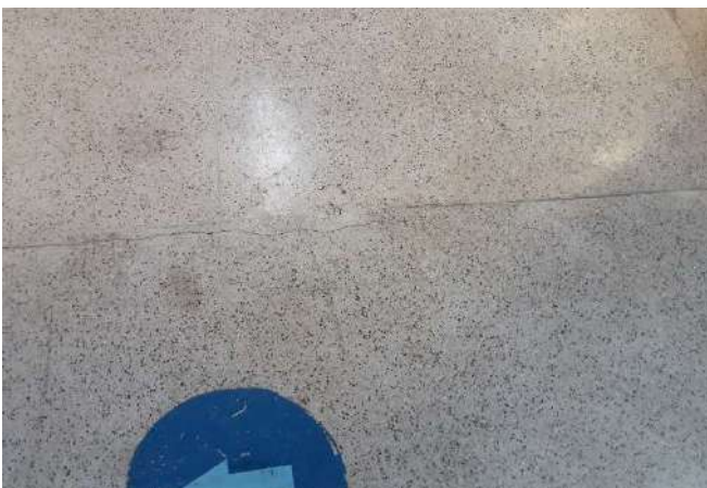
FOTO 105 Escada e circulação - Piso com fissura e infiltração
