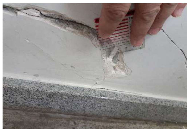
FOTO 30 Laboratório de Informática - Abertura na parede de 20mm
