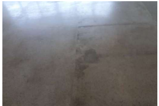
FOTO 100 Sala 22 - Juntas de dilatação e fissura
