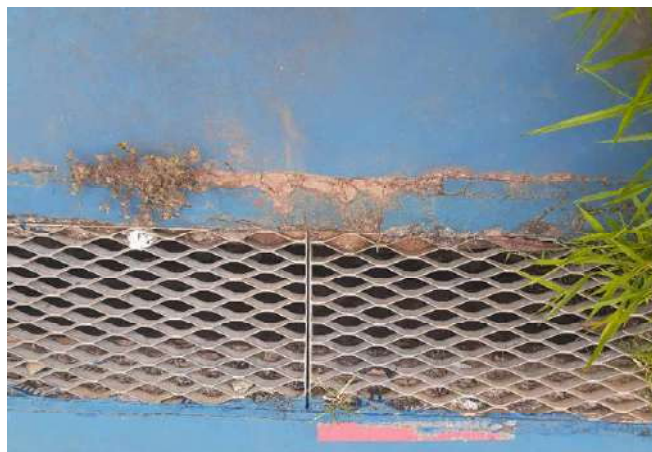
FOTO 45 Playground - Juntas deficiente
