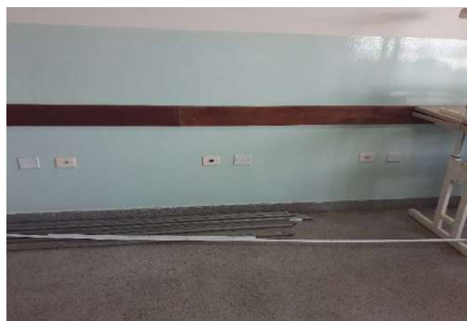
FOTO 76 Sala de Projeto - Tomadas afundadas
