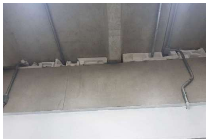
FOTO 66 Sala dos Professores - Fechamento Inadequado (Conforto térmico)
