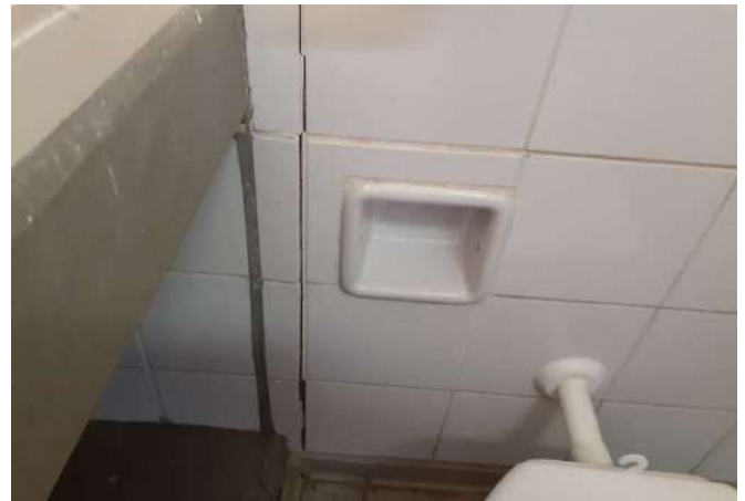
FOTO 104 Sanit Aluno Fem - Trinca rejunte azulejo
