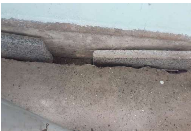
FOTO 69 Sala de Video - Rodapé deficiência na junta, abertura entre rodapé e a parede
