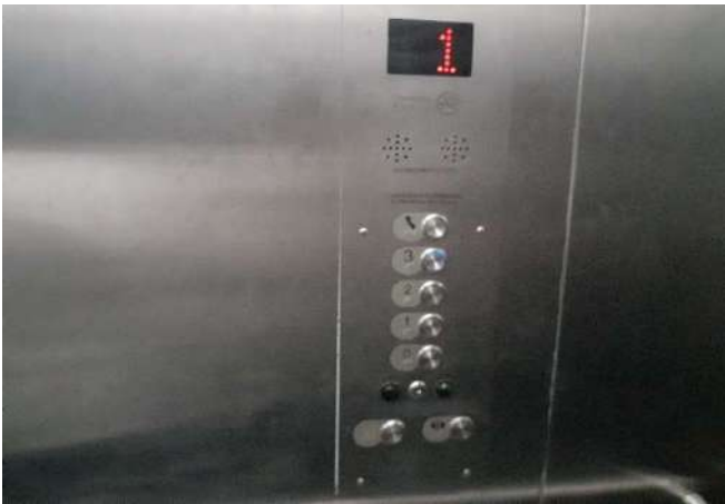
FOTO 103 Elevador - Botões emergencia/ Interfone não funciona
