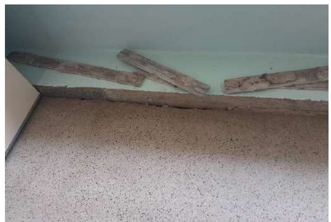
FOTO 108 Sala 26 - Rodapé inadequado com partes quebradas
