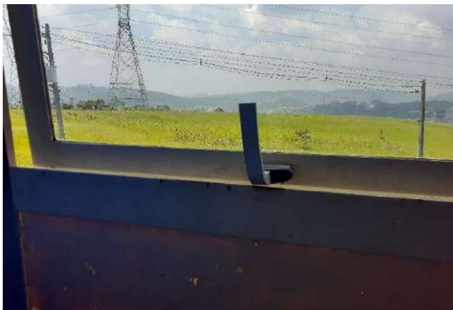
FOTO 103 Sanit Aluno Masc - Esquadria quebrada
