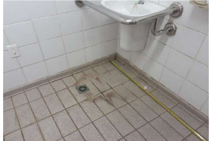
FOTO 104 Sanit. para Deficiente Fem - Mancha umidade
