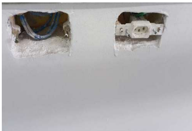
FOTO 79 Sala de multi uso - Falha na tomada
