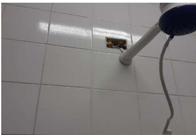
FOTO 107 Sanit Func Masc - Improviso elétrico
