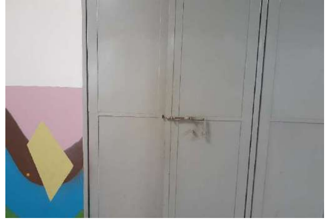
FOTO 104 Quadro de luz - Armário fechado
