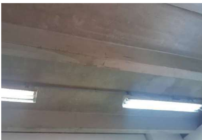
FOTO 77 Sala de Projeto - Destacamento
