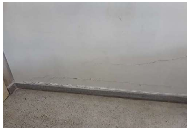
FOTO 26 Laboratório de Informática - Trincas horizontais
