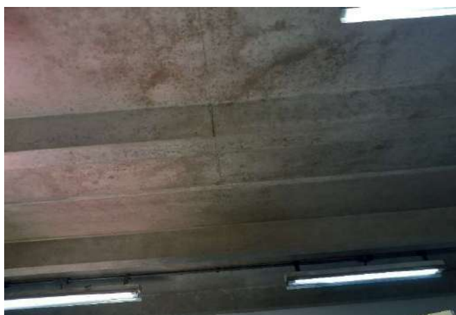
FOTO 81 Sala de Leitura - Infiltração, mancha de mofo/bolor Junta da peças pré moldadas e fissuras
