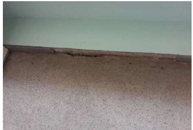
FOTO 104 Sala 24 - Rodapé ineficiente (Partes quebradas)
