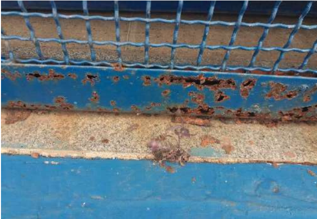
FOTO 37 Pátio Descoberto - Grade oxidata
