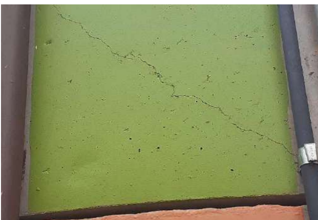
FOTO 107 Caixa d' Água - Fissura
