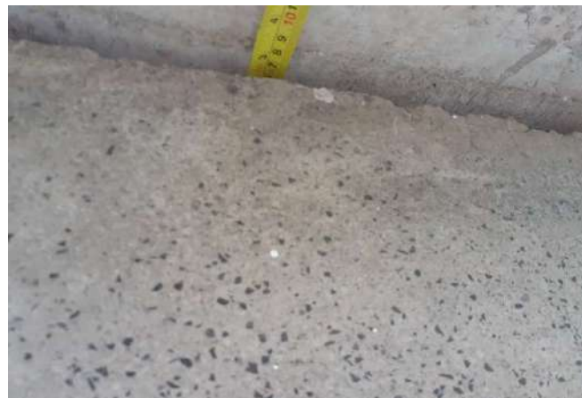
FOTO 104 Sala 27 - Rodapé com abertura entre a parede e o piso com profundidade de 70 mm
