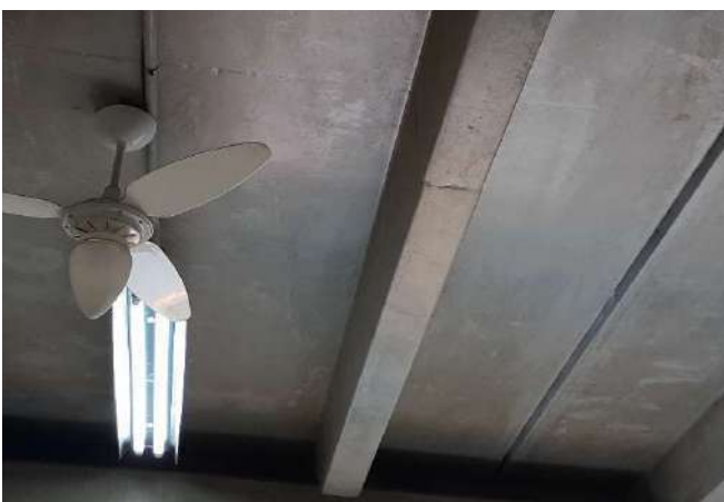
FOTO 101 Sala 16 - Juntas fissuradas
