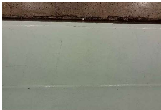
FOTO 21 Laboratório Ciências - Rodapé deficiência nas juntas
