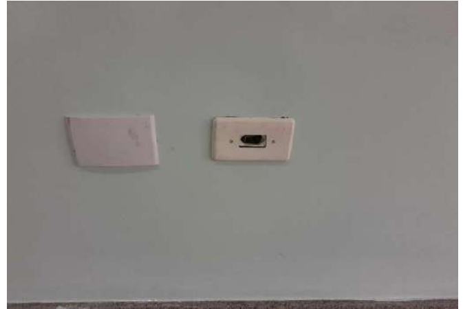
FOTO 104 Sala 28 - Tomada ineficiente
