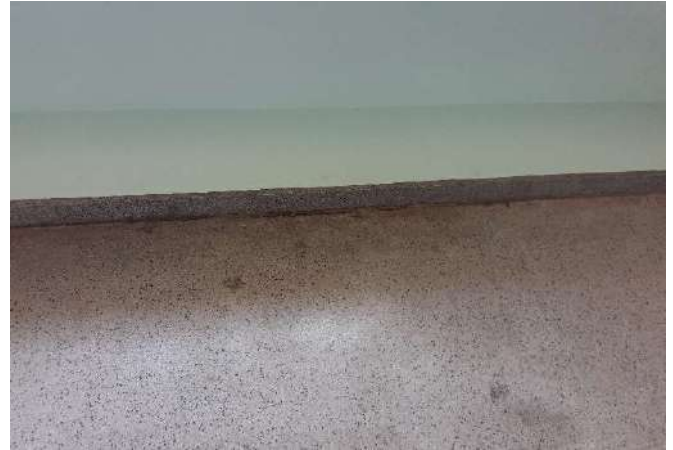
FOTO 98 Sala 22 - Rodapé inefficiente
