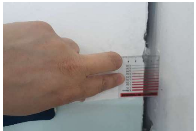
FOTO 100 Sala 17 - Abertura parede (20mm)
