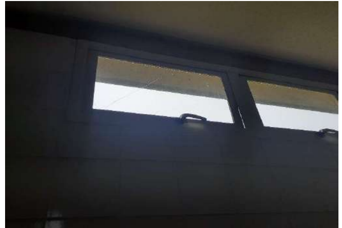
FOTO 106 Sanit. para Deficiente Fem - Vidro quebrado
