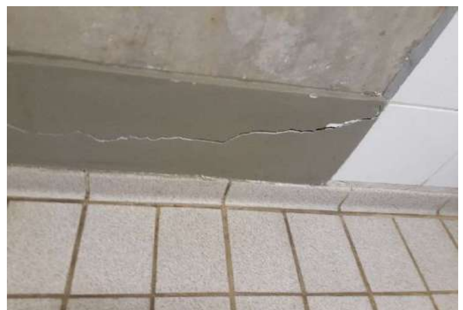
FOTO 108 Sanit. para Deficiente Masc. - Trinca
