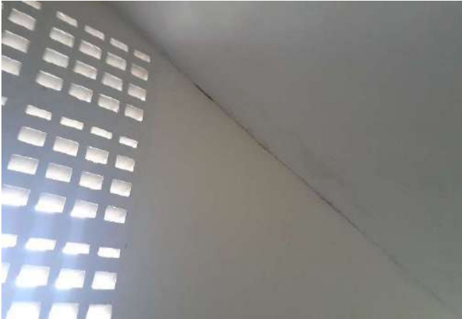
FOTO 103 Escada e circulação - Trinca
