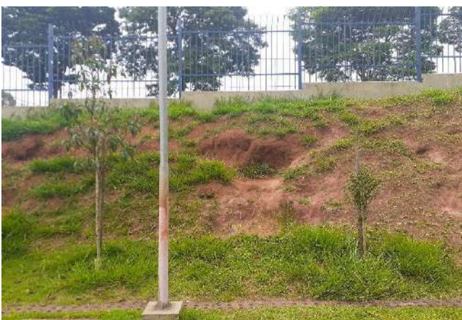
FOTO 41 Pátio Descoberto - Talude com erosão
