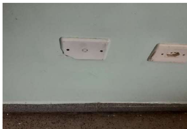
FOTO 82 Sala 10 - Espelho tomada quebrada
