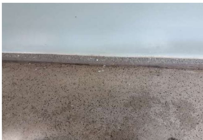
FOTO 83 Sala 10 - Rodapé com abertura (ineficiente)
