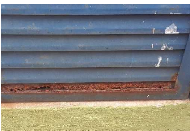
FOTO 6 Porta oxidada - Casa de Máquina Reservatório
