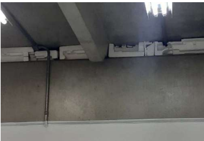
FOTO 63 Sala do coordenador - Fechamento ineficiente (Conforto térmico)
