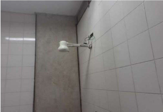
FOTO 103 Sanit. para Deficiente Masc. - Improviso elétrico
