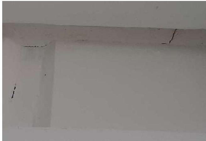
FOTO 22 Laboratório Ciências -Trincas na parede
