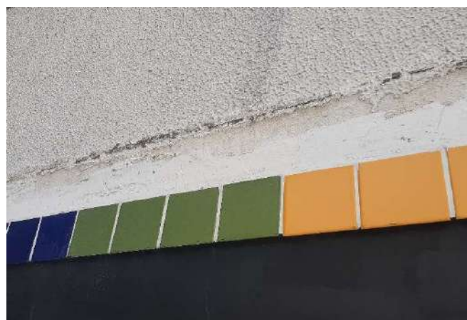
FOTO 16 Estacionamento - Parede externa trincada
