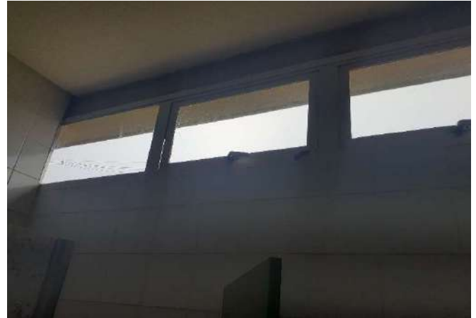
FOTO 104 Sanit. para Deficiente Masc.- Vidro quebrado
