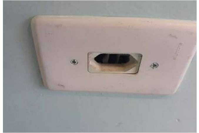
FOTO 92 Sala 14 - Falta tomada
