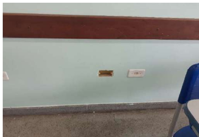
FOTO 84 Sala 10 - Falta tomada
