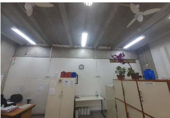
FOTO 107 Secretaria - Fechamento ineficiente (conforto)
