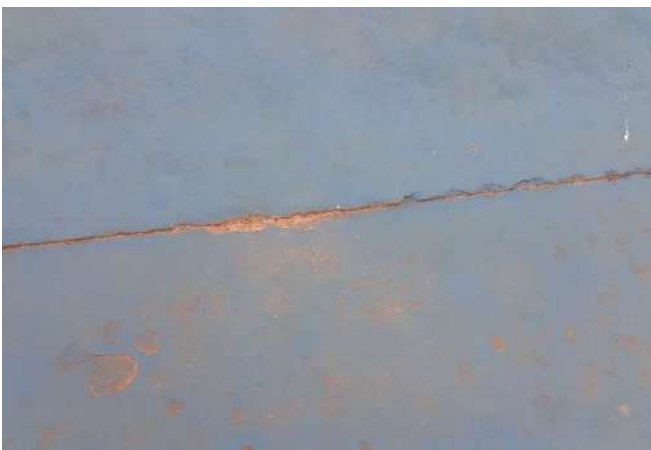
FOTO 39 Pátio Descoberto - Juntas de dilatação e deficiência no rejunte
