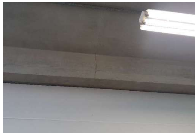
FOTO 68 Sala dos Professores - Trinca na viga
