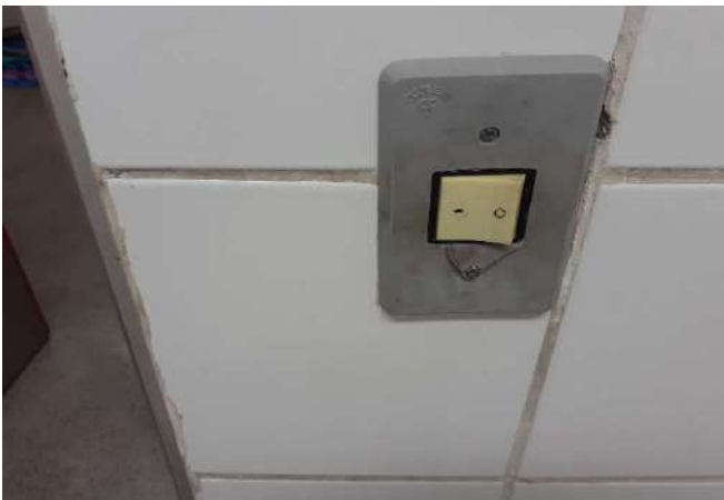
FOTO 105 Sanit. para Deficiente Fem - Interruptor quebrado
