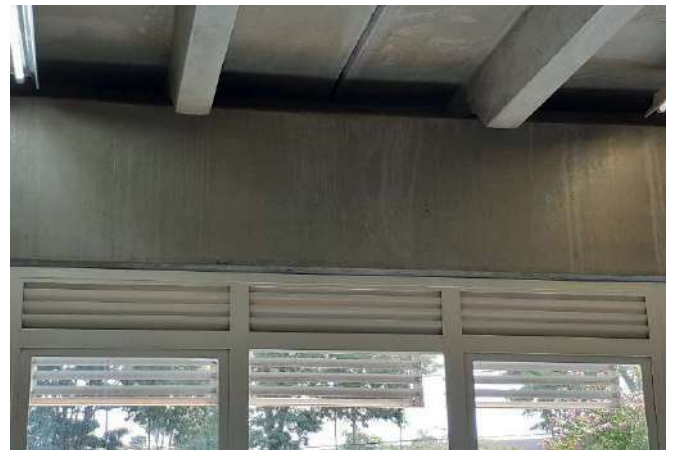
FOTO 100 Sala 16 - Mancha de infiltração
