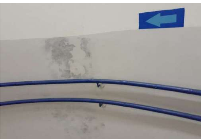
FOTO 107 Escadas e circulação - Mancha de umidade
