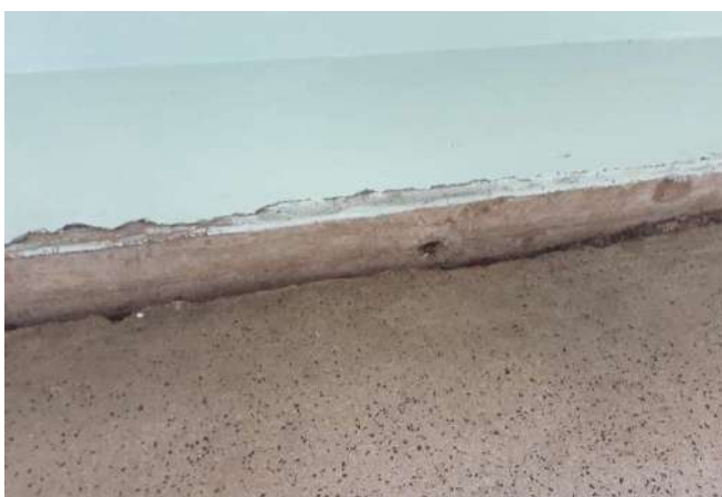
FOTO 105 Sala 27 - Partes quebrada
