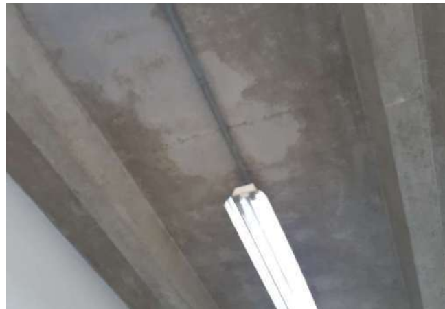
FOTO 106 Sala 27 - Juntas deficientes
