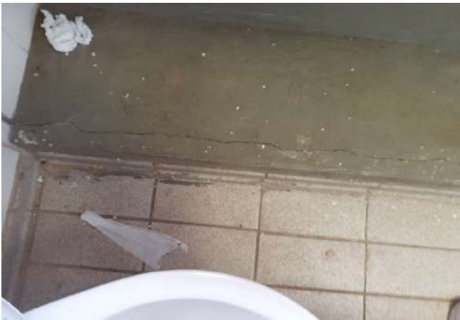
FOTO 103 Sanit Aluno Fem - Partes quebradas
