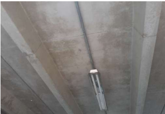
FOTO 87 Sala 12 - Fissuras na juntas das peças
