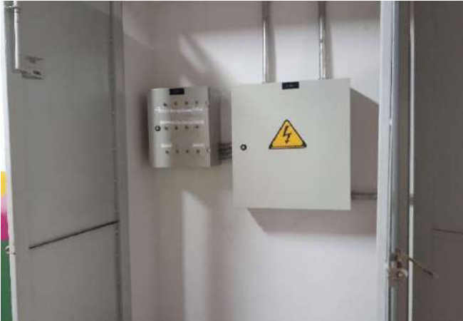
FOTO 103 Quadro de luz - Visão geral
