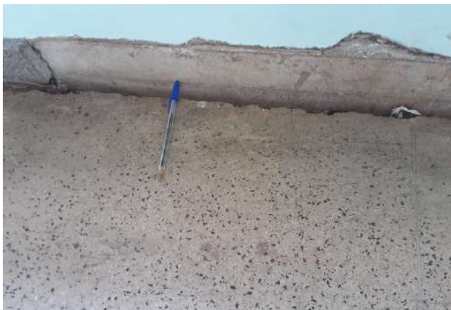
FOTO 103 Sala 27 - Rodapé com abertura entre a parede e o piso
