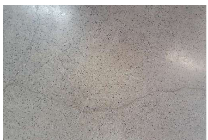
FOTO 54 Refeitório - Piso Trinca
