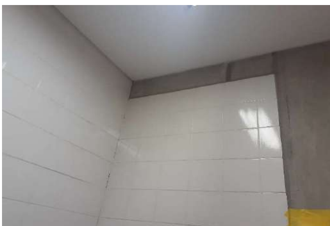
FOTO 105 Vestiário - Falta de rejunte
