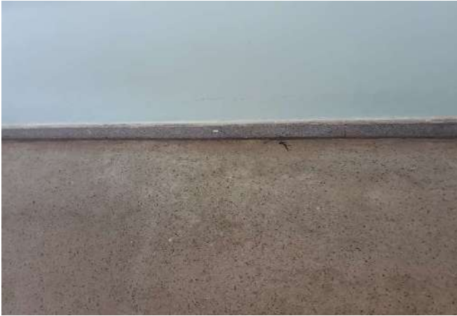
FOTO 91 Sala 14 - Rodapé com deficiência nas juntas
