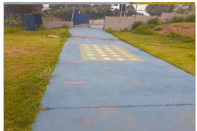
FOTO 40 Pátio Descoberto - Juntas de dilatação e deficiência no rejunte
