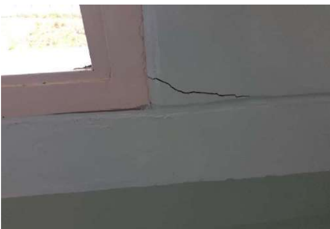
FOTO 107 Sala 26 - Parede com fissura
