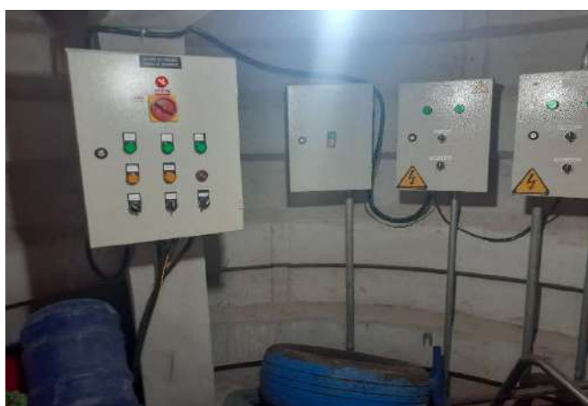
FOTO 5 Casa de Máquina - Elevador - Visão interna
