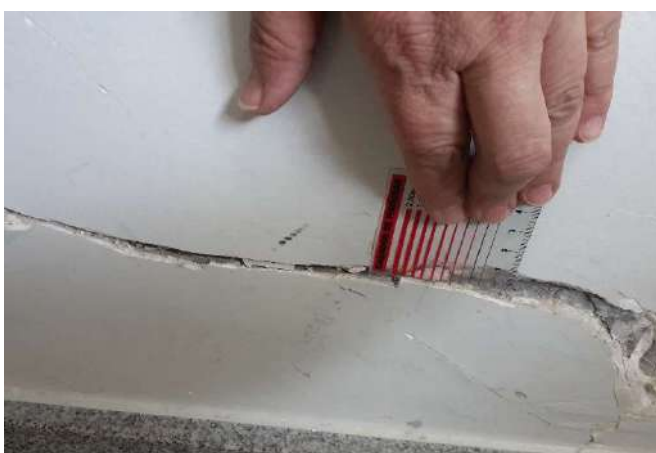
FOTO 29 Laboratório de Informática - Trinca com 10mm
