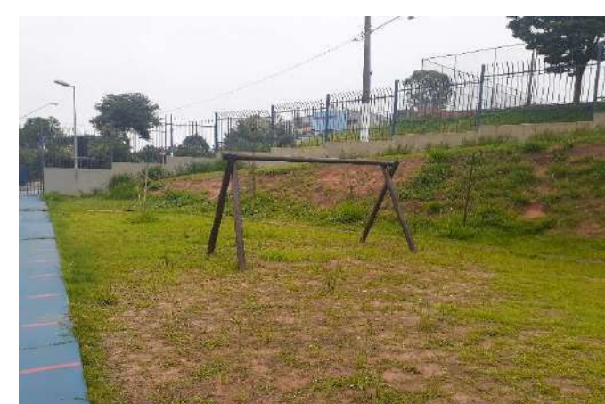
FOTO 48 Playground - Balança quebrada
