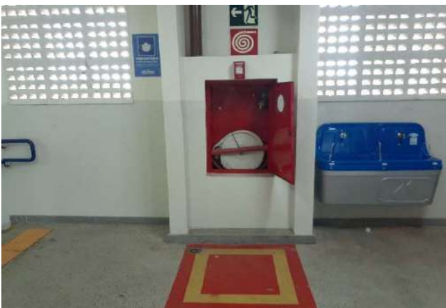
FOTO 105 Hidrante - Visão geral
