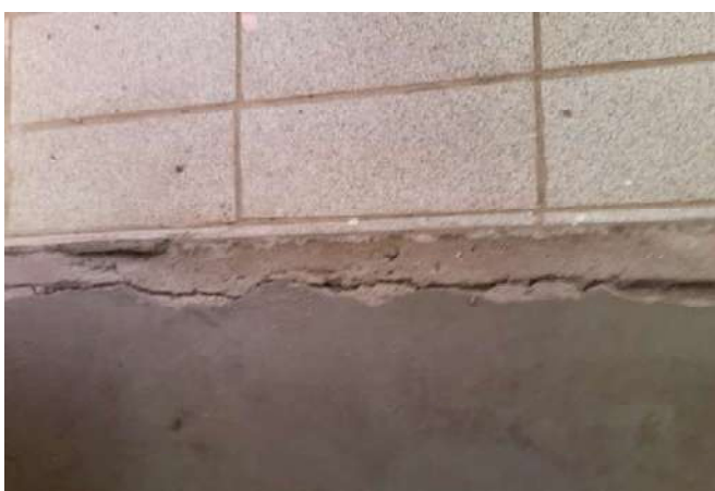
FOTO 107 Sanit. Aluno Fem - Fissura
