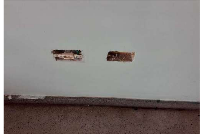
FOTO 86 Sala 12 - Espelhos faltantes
