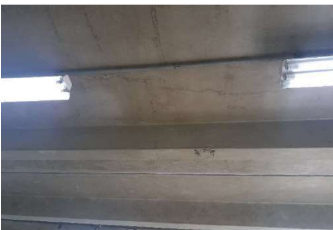
FOTO 101 Sala 17 - Fissura na viga
