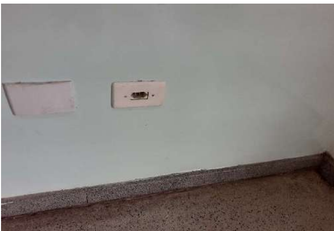
FOTO 105 Sala 24 - Tomadas Ineficiente
