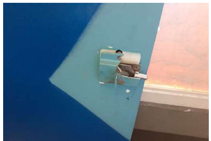
FOTO 108 Sanit Aluno Masc - Trinco da porta quebrada
