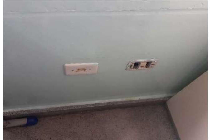
FOTO 98 Sala 17 - Tomadas (Falta de espelho)
