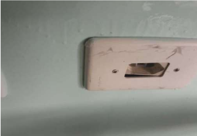
FOTO 97 Sala 15 - Tomada inadequada
