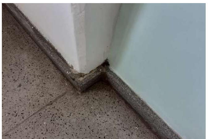
FOTO 88 Sala 12 - Rodapé com deficiência nas juntas
