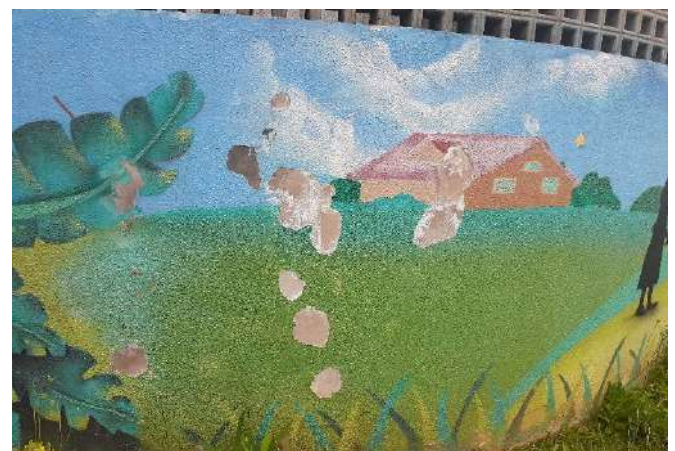
FOTO 42 Pátio Descoberto - Descascamento
