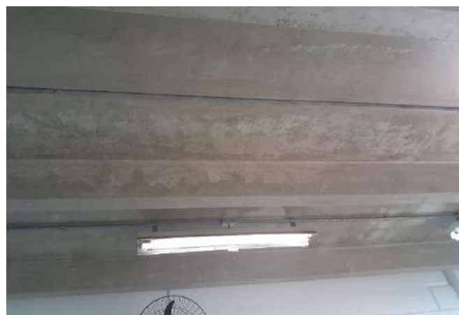
FOTO 72 Sala de Video - Eflorescência
