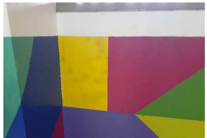
FOTO 106 Escada e circulação -Manchas de umidade
