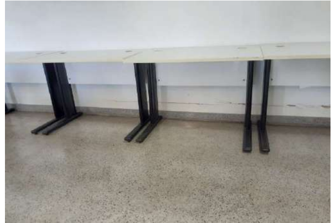
FOTO 32 Laboratório de Informática - Trinca horizontal
