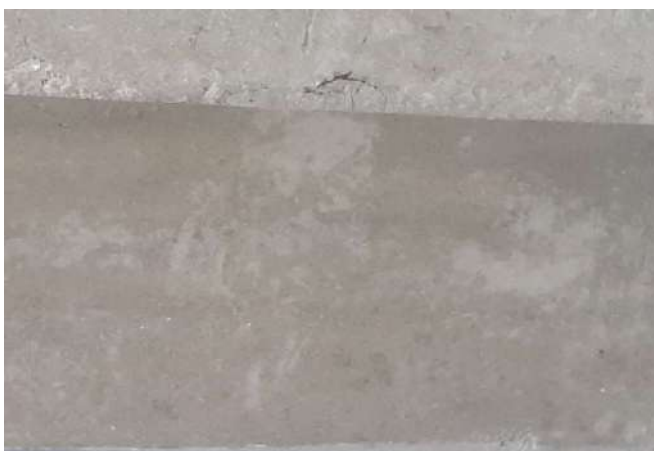
FOTO 107 Sala 27 - Juntas deficientes
