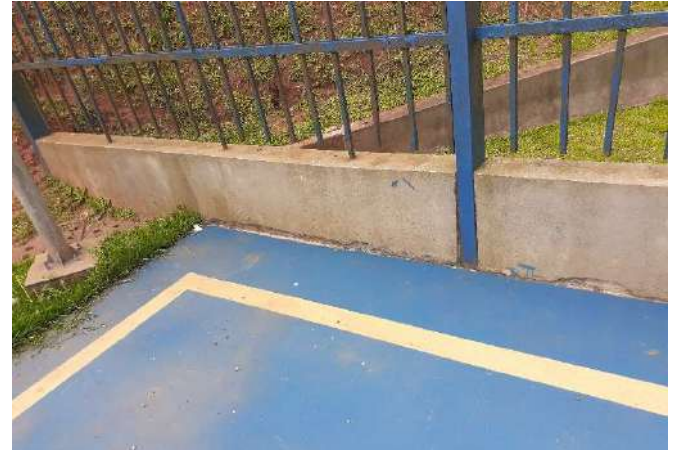
FOTO 38 Pátio Descoberto - Partes quebradas
