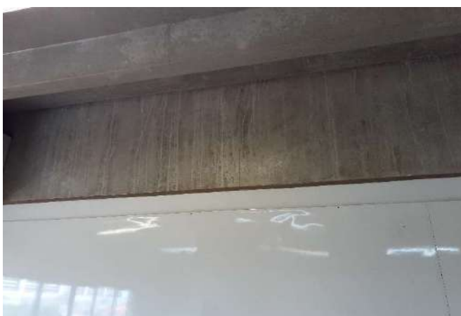
FOTO 27 Laboratório de Informática - Eflorescência
