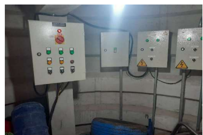
FOTO 106 Caixa da Água - Controle de bomba
