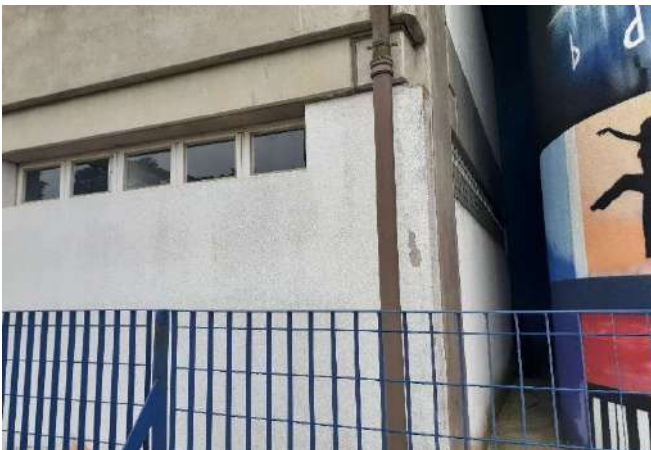
FOTO 57 Refeitório Func. - Descascamento (Parede externa Solario)
