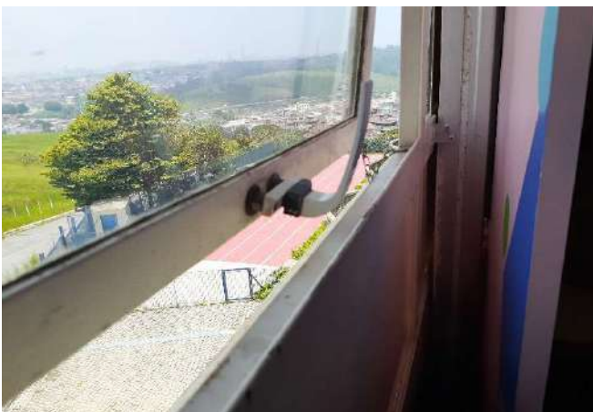
FOTO 105 Sanit aluno Fem - Esquadria quebrada
