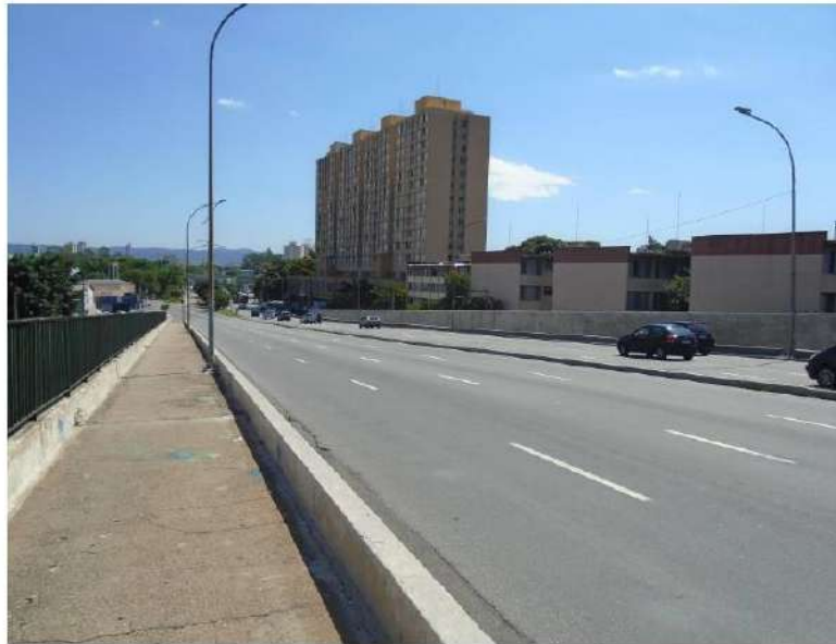
FOTO 1 – Vista do tabuleiro do Viaduto – Sinais de deslocamento do revestimento.
