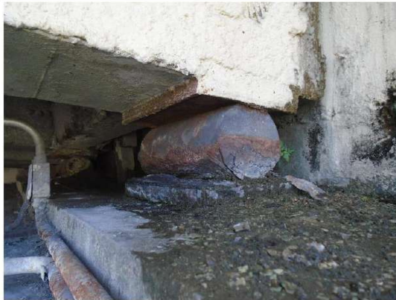
FOTO 13 – Vista do aparelho de apoio metálico com chapa superior e inferior em aço e rolete metálico com corrosões.
