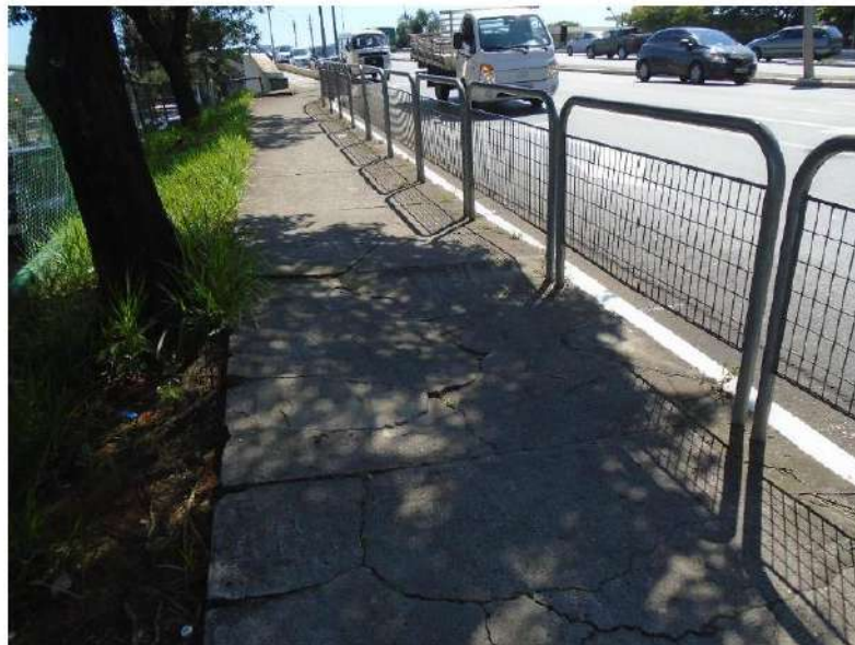
FOTO 10 – Vista da entrada/saída do passeio com pavimento danificado.
