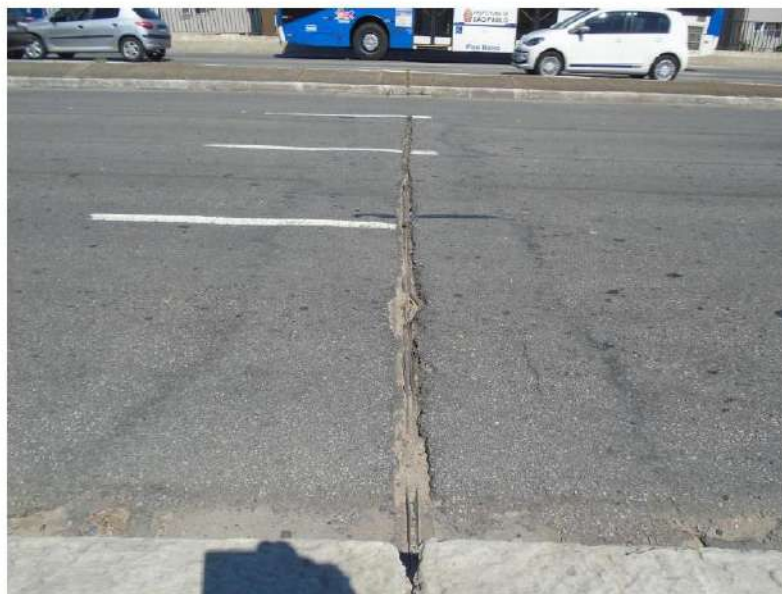
FOTO 2 – Vista da junta de dilatação: Encoberta por pavimentação, asfalto disgregado formando degrau; junta de dilatação com elastômero danificado.
