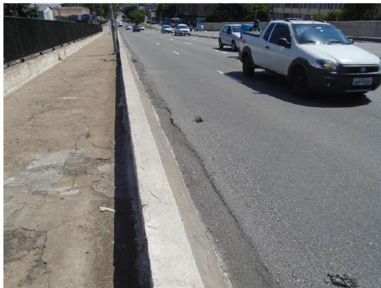
FOTO 4 – Vista do pavimento com buracos e afundamento de consolidação.
