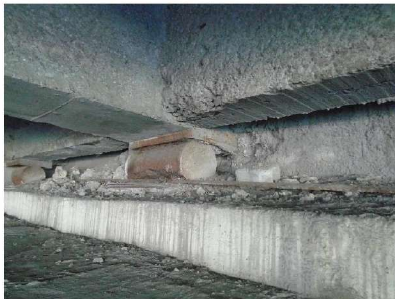
FOTO 14 – Vista do aparelho de apoio metálico com rolete não centralizado em relação as bases de placas em aço.
