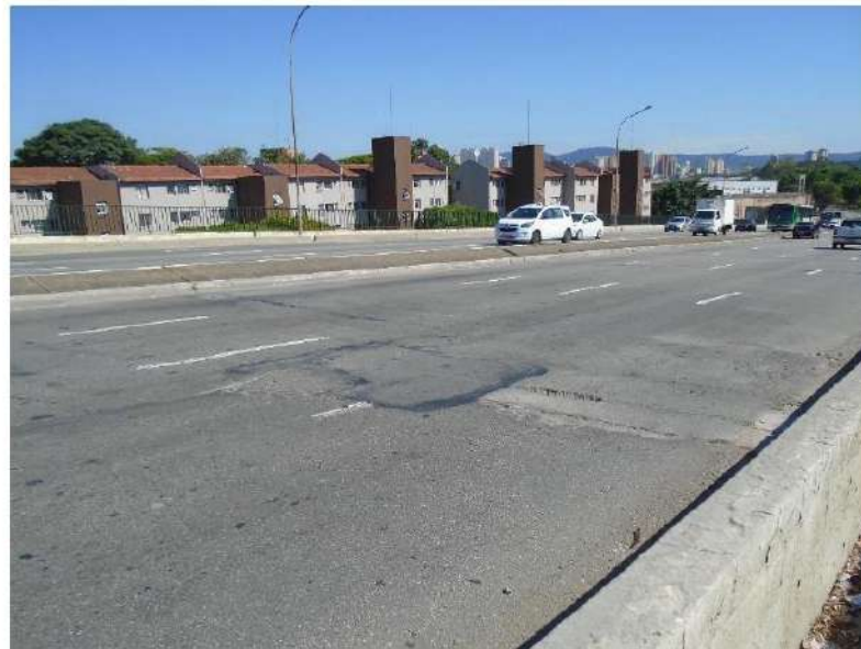
FOTO 4 – Vista de remendo asfáltico.
