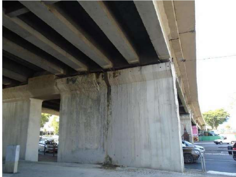
FOTO 15 – Vista frontal do pilar do viaduto focalizando infiltrações devido a problemas com as juntas.
