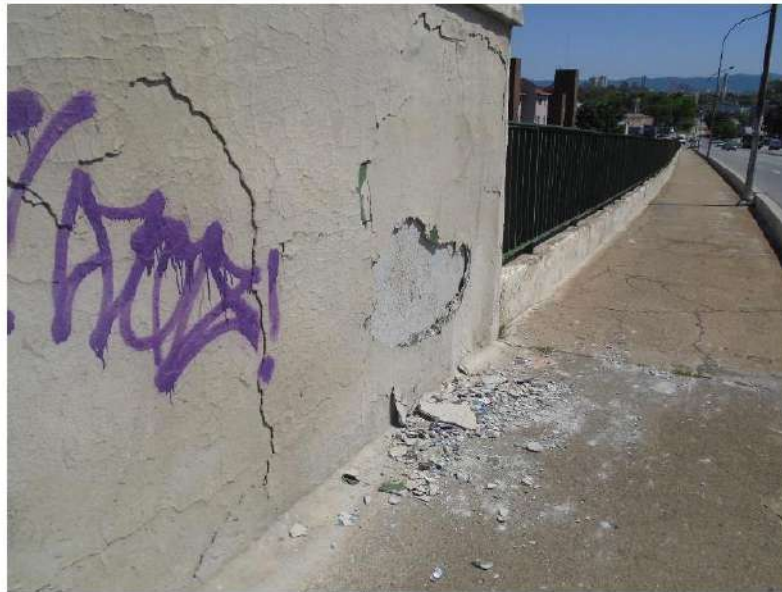
FOTO 9 – Vista do guarda corpo em concreto do passeio superior com deslocamento do revestimento.
