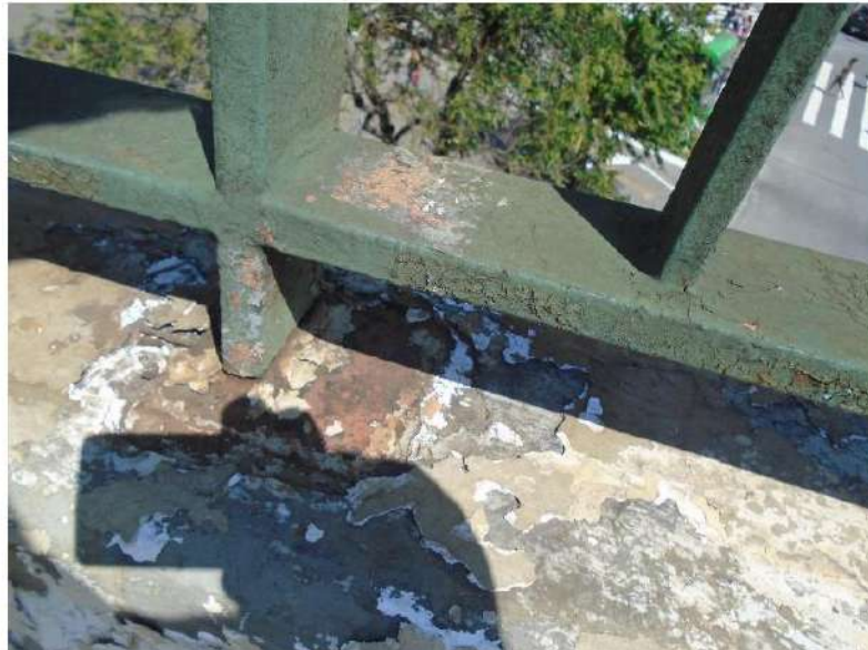
FOTO 8 – Vista do guarda corpo metálico do passeio superior com oxidação na base.
