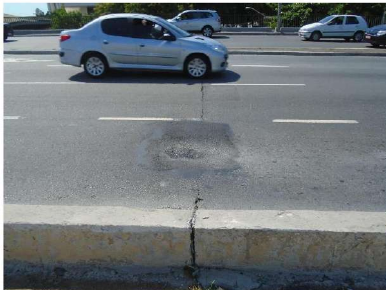
FOTO 2 – Detalhe do pavimento asfáltico com remendo deteriorado.
