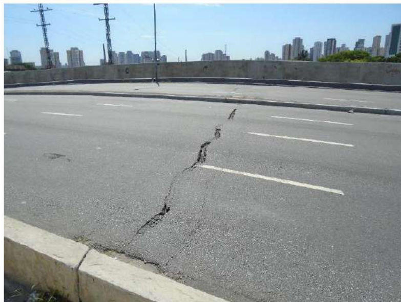
FOTO 6 – Vista do pavimento com disgregação do pavimento sobre junta de dilatação.
