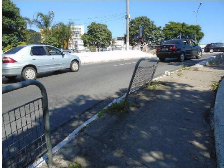
FOTO 9 – Vista da entrada/saída do passeio com ausência de guarda corpo metálico e guarda corpo avariado.
