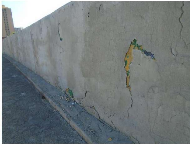
FOTO 7 – Vista do guarda corpo em concreto com deslocamento do revestimento.
