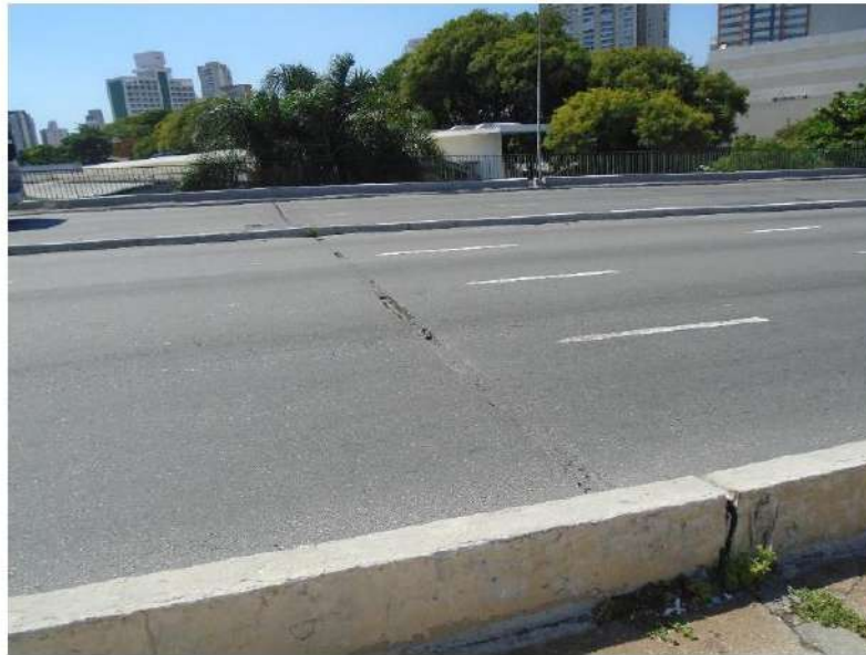
FOTO 3 – Vista parcial do tabuleiro com detalhe para junta de dilatação encoberta por pavimentação e com disgregação do pavimento sobre a junta.
