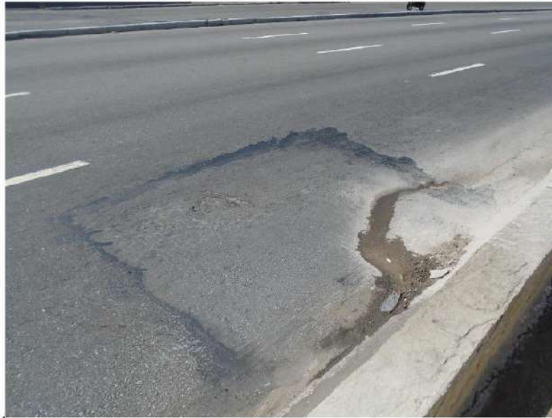
FOTO 5 – Detalhe do pavimento com remendo e com fluido percolante na superfície.
