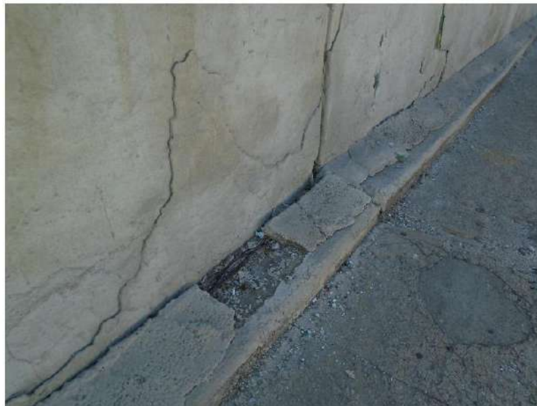
FOTO 8 – Vista do passeio com exposição de cabos junto ao guarda corpo.
