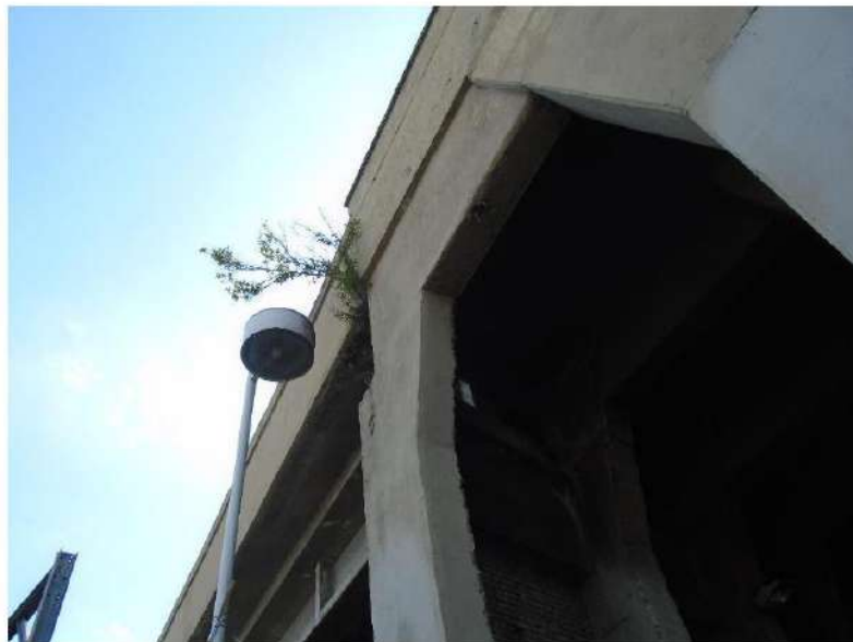
FOTO 12 – Vista lateral da junta de dilatação obstruída por vegetação.
