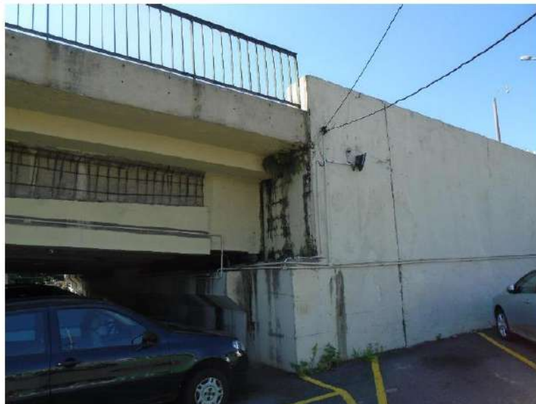
FOTO 10 – Vista lateral do viaduto com infiltrações e vegetais na junta de dilatação da junção tabuleiro/encontro. Armadura de reforço exposta em viga longitudinal com ausência de concreto.
