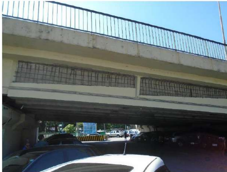
FOTO 11 – Vista da viga longarina com exposição de amadura de reforço sem concretagem.
