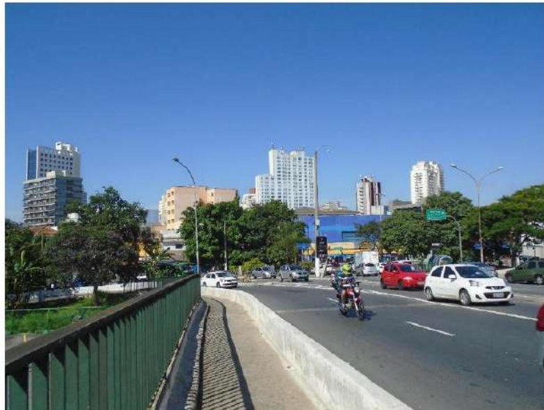
FOTO 6 – Vista da iluminação do tabuleiro com haste de iluminação invertida.
