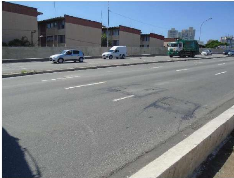
FOTO 7 – Vista do pavimento com remendos e panelas.
