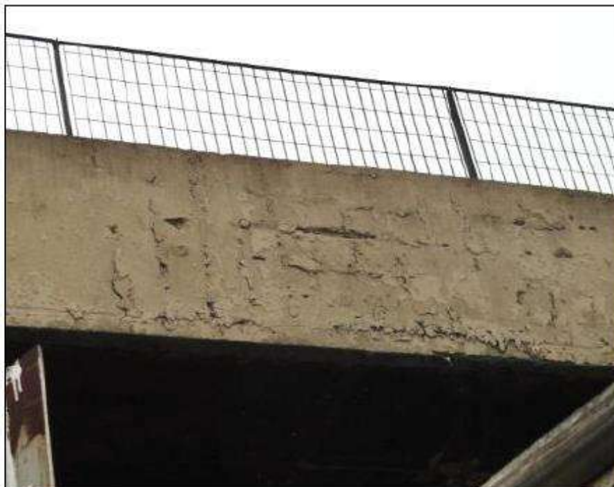
FOTO 6 – Detalhe de concreto segregado na lateral da laje.
