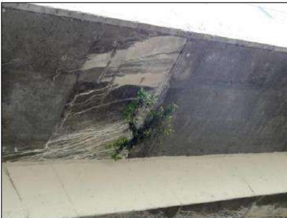
FOTO 4 – Detalhe de fissura com infiltração na laje superior.
