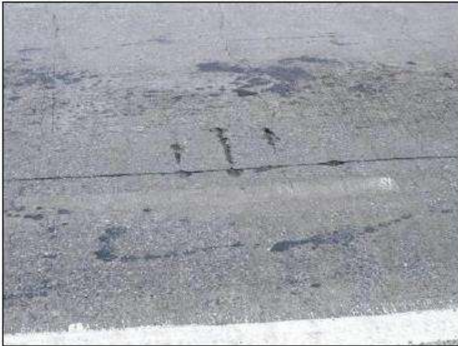
FOTO 9 – Detalhe do pavimento rígido desgastado.
