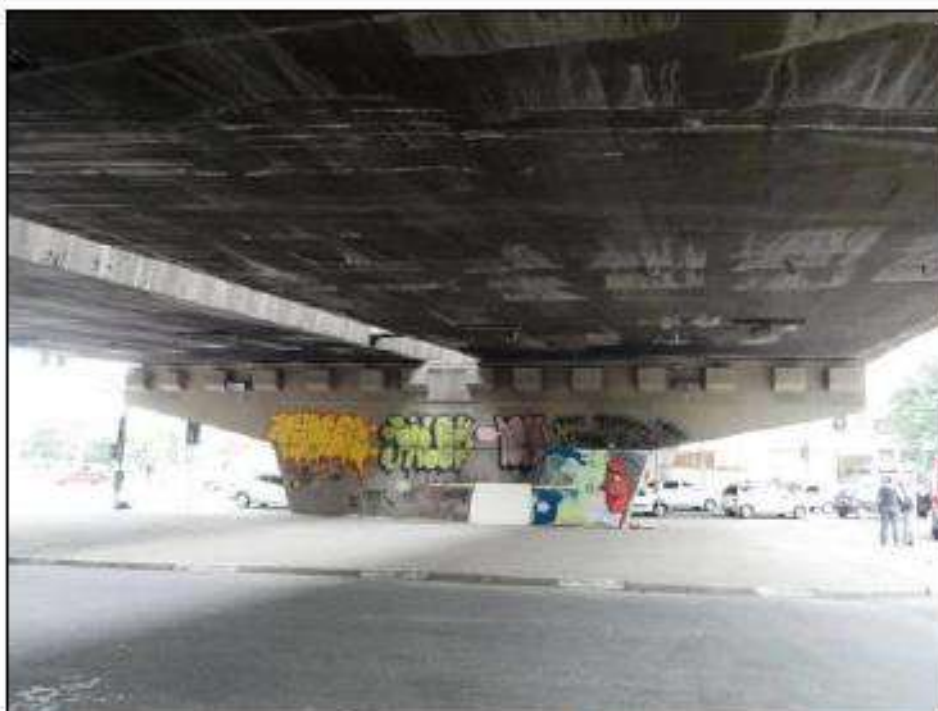
FOTO 3 – Vista frontal do pilar e inferior da laje do tabuleiro com sinais de colisão de veículos.
