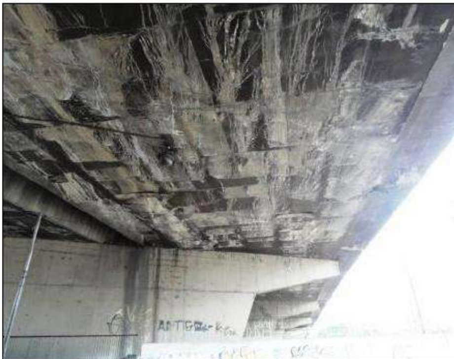
FOTO 5 – Detalhe de concreto disgregado na laje inferior do caixão devido impacto de veículo.
