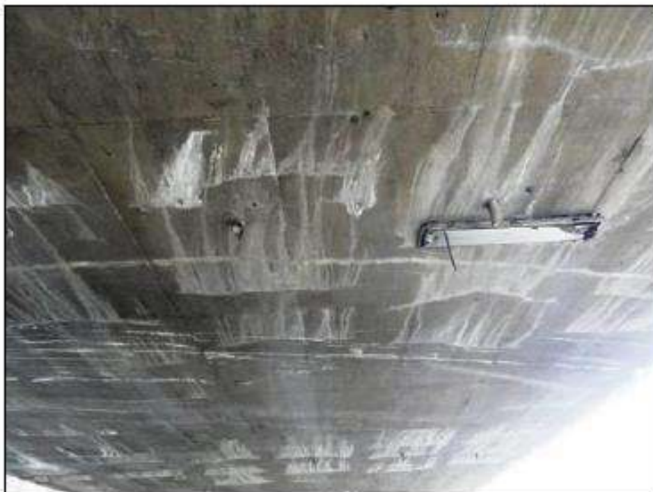
FOTO 4 – Detalhe da laje inferior do caixão com fissuras e infiltração.
