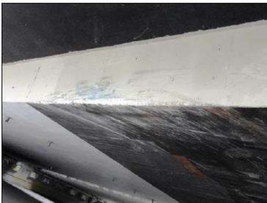
FOTO 5 – Detalhe da face lateral do caixão, focalizando concreto disgregado devido impacto de veículo.
