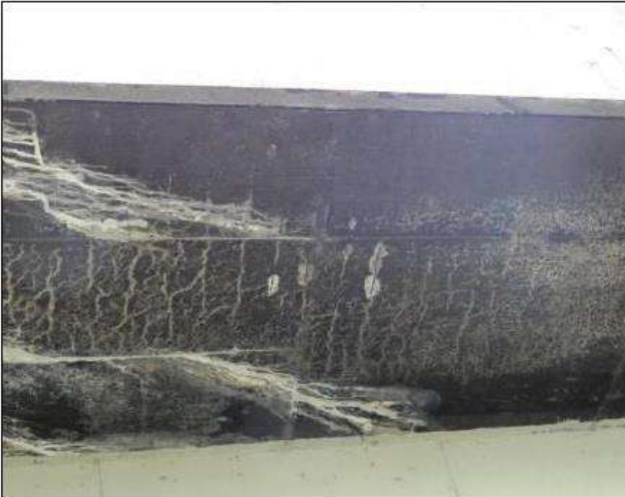
FOTO 10 – Detalhe de fissuras na laje do balanço.
