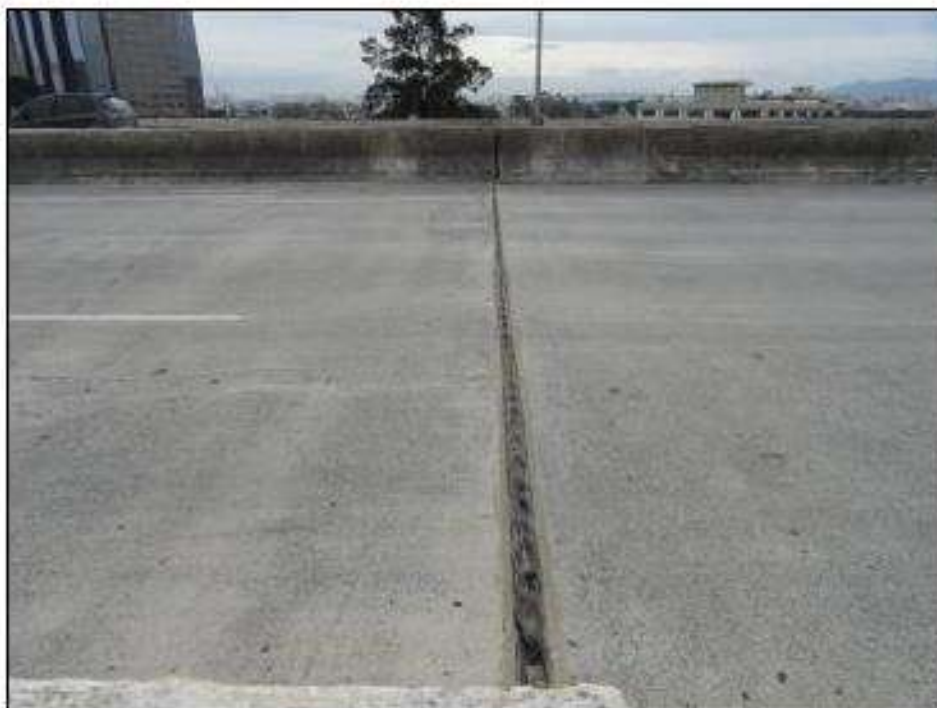
FOTO 8 – Vista superior da junta de dilatação danificada.
