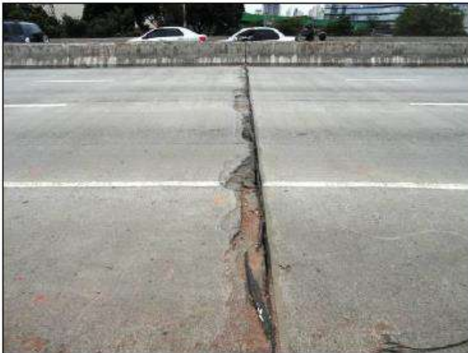
FOTO 10 – Detalhe de junta de dilatação danificada.
