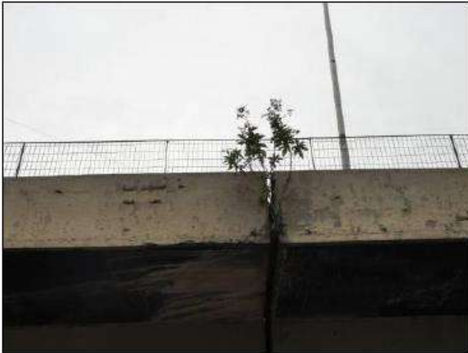
FOTO 7 – Detalhe da junta de dilatação bloqueada por vegetação.
