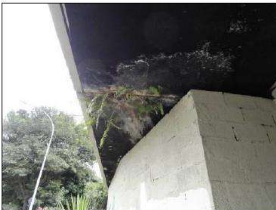
FOTO 6 – Detalhe da junta de dilatação bloqueada por vegetação.
