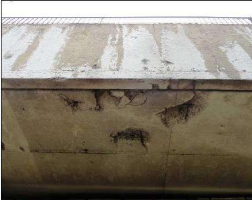
FOTO 9 – Detalhe da laje do balanço com concreto disgregado.
