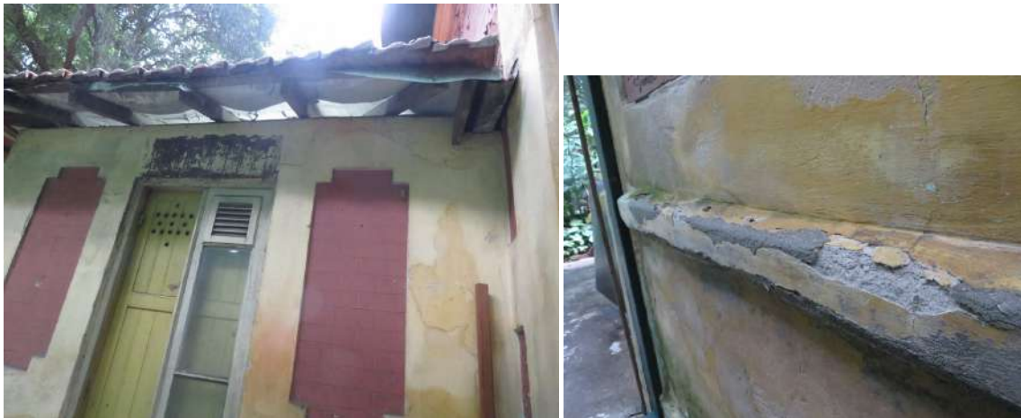
21. Fachada leste. 22. Patologia recorrente: obturação com reboco de argamassa cimentícia.
