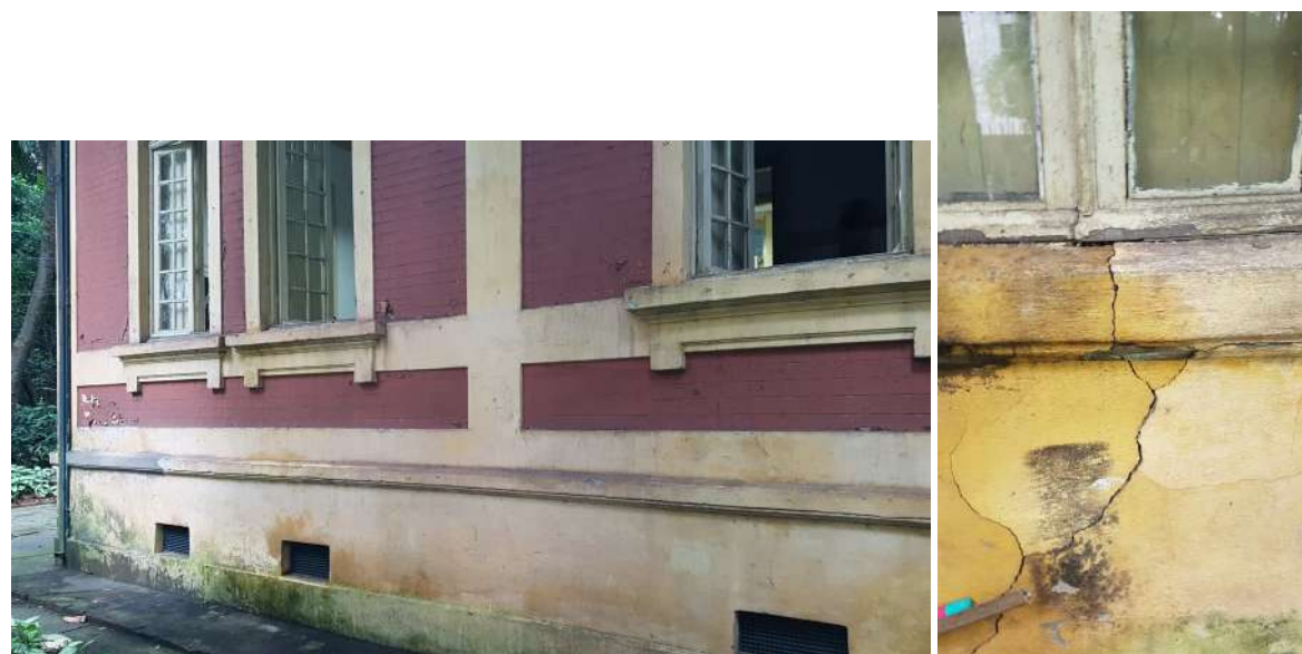
25. Fachada oeste. 26. Patologia recorrente: desprendimento do reboco.
