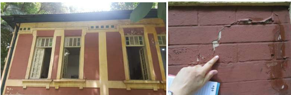
9. Fachada oeste. 10. Patologia recorrente: desprendimento da pintura plástica.
