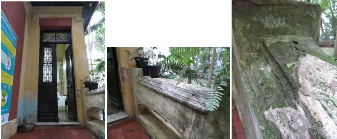
36. Porta de entrada. 37 e 38. Topo do guarda-corpo tem argamassa parcialmente desagregada, sob película de biofilme que forma uma pátina.
