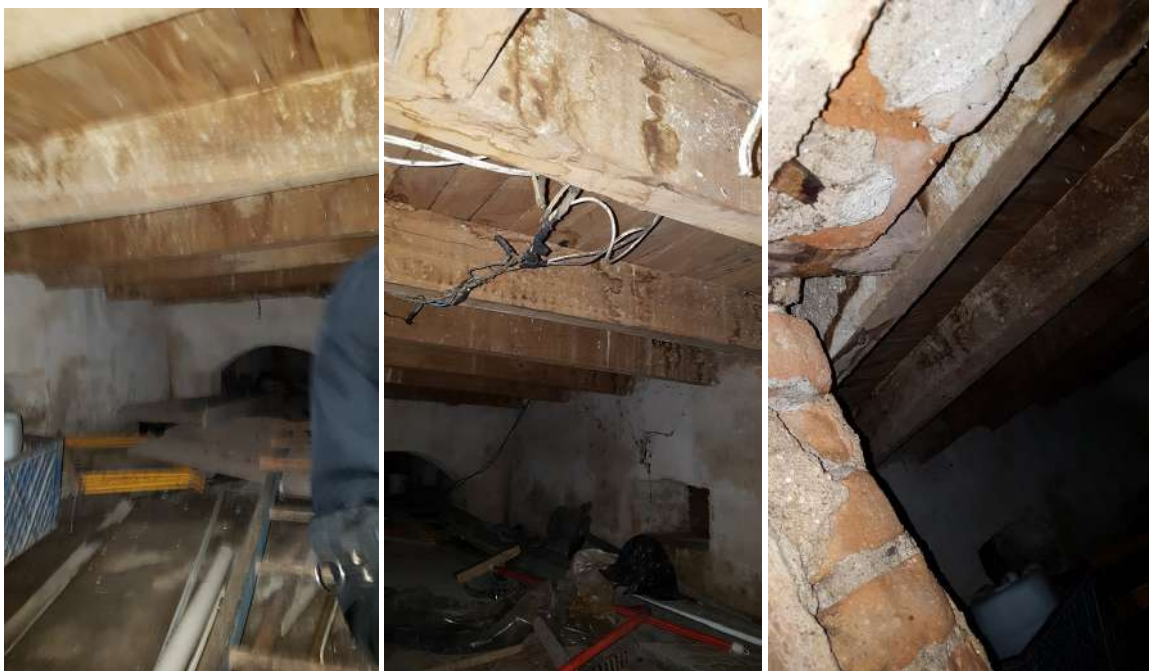
33, 34 e 35. Barrotes sob o assoalho, no nível do porão. Pode-se observar manchas provocadas pela água que desce do telhado. Recomenda-se investigar, na obra, o estado de conservação das cabeças dos barrotes.
