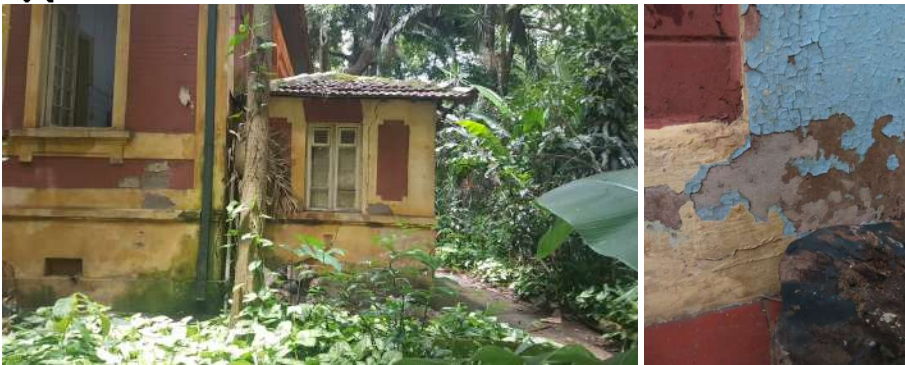
7. Fachada oeste, e o “puxadinho” à direita. 8. Patologia recorrente: desprendimento da pintura.
