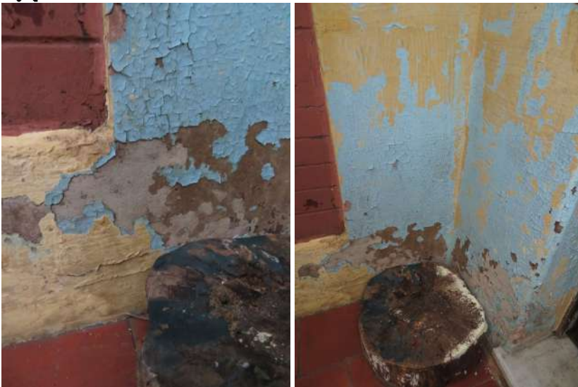
39 e 40. Rebocos pintados com tinta à base de cal (amarelo), e com camada mais recente de tinta plástica (cinza) que está desprendendo.
