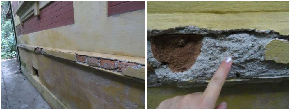
23. Patologia recorrente: desprendimento de reboco. 24. Argamassa do reboco original.
