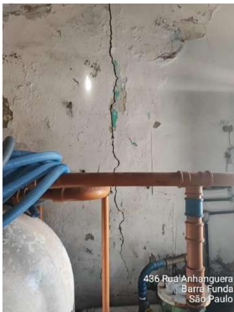
FOTO 39 – PAREDE COM REPAROS A EXECUTAR
