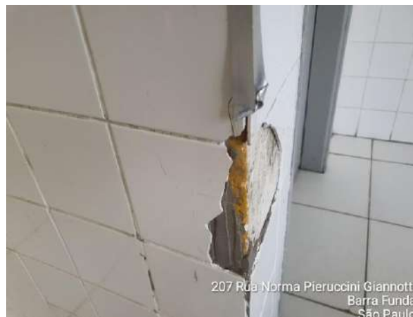
FOTO 46 – PAREDE COM REPAROS A EXECUTAR
