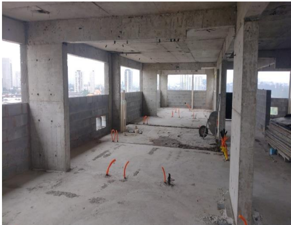
Torre B – 10º Pavimento – Execução de alvenaria de vedação na periferia da laje
