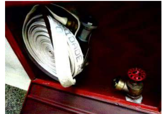
Instalação de mangueira, esguicho e chave de engate
