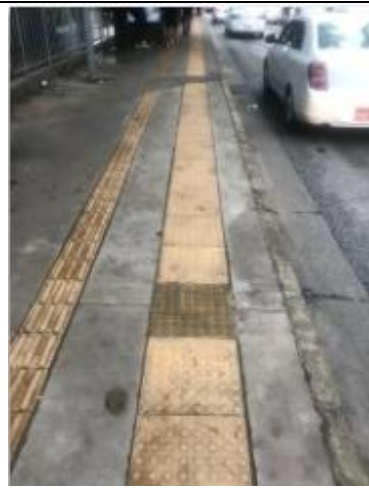
Foto 2: Piso podotátil e rejunte em boas condições no local onde houve deslocamento apontado pela Equipe de Auditoria da Controladoria Geral do Município (CGM).
