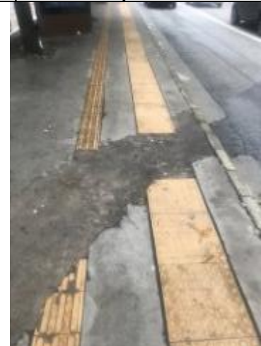
Foto 6: Local onde houve intervenção sem a devida recomposição do piso.
