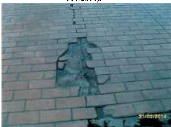
Figura 12– Fragmento do relatório fotográfico utilizado como base para elaboração do Memorial Descritivo (antes das intervenções – Fev/2014).
