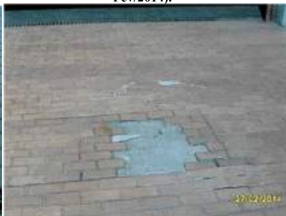
Figura 13– Fragmento do relatório fotográfico utilizado como base para elaboração do Memorial Descritivo (antes das intervenções – Fev/2014).
