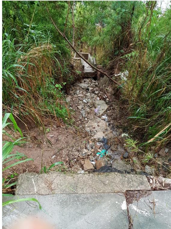
Foto 4.1.1 – Foto do colapso da escada hidráulica
