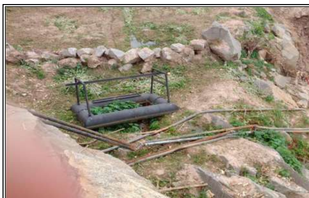
Figura 3 - Flutuante reserva sem motobombas
