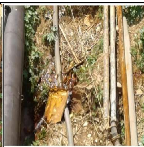
Figura 9 - Vazamentos na tubulação abaixo da peça de madeira.
