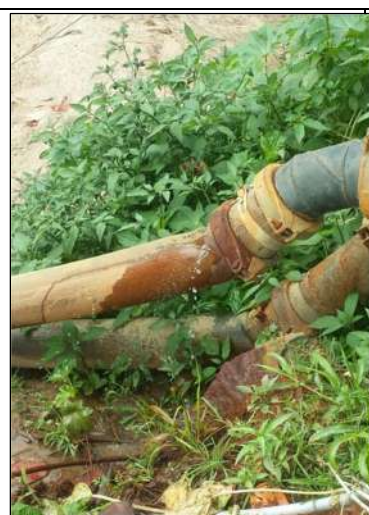
Figura 7 - Vazamentos na junção entre a tubulação flexível e de aço.
