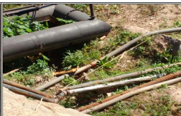
Figura 4 - Flutuante reserva sem motobombas
