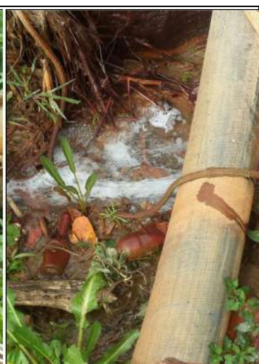
Figura 8 - Vazamentos na tubulação flexível.
