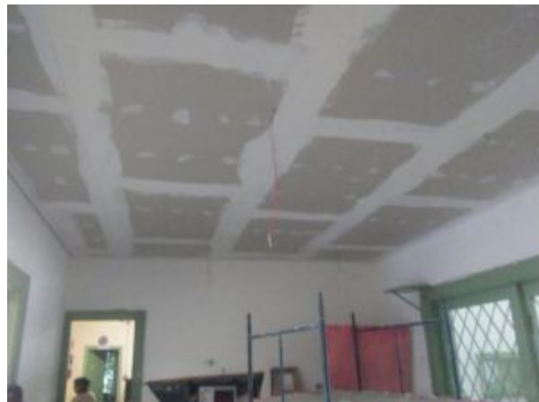
Instalação em andamento do forro de gesso acartonado, no Hall de Entrada
