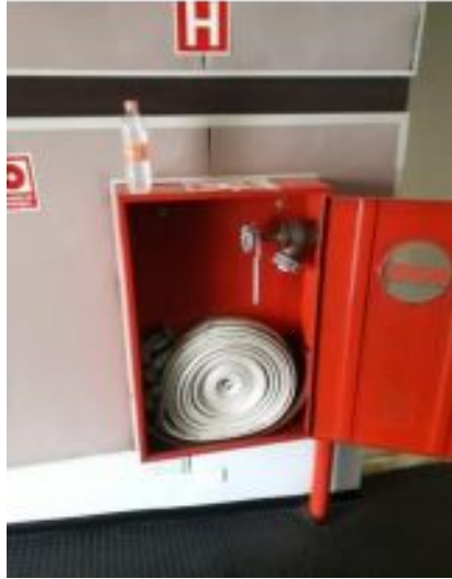
Instalação de esguicho com engate rápido na plateia do Teatro Décio de Almeida Prado
