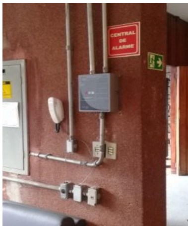
Central de alarme
