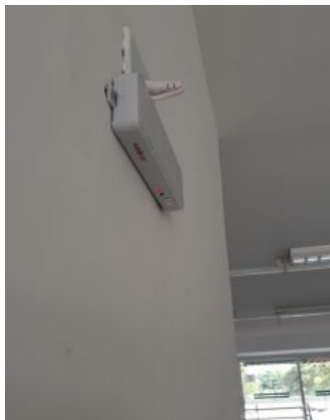
Iluminação de emergência
