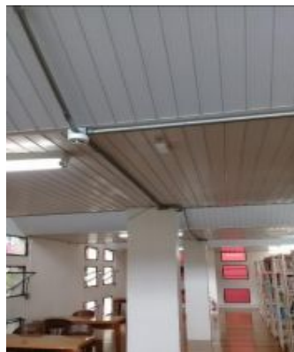
Detectores de incêndio
