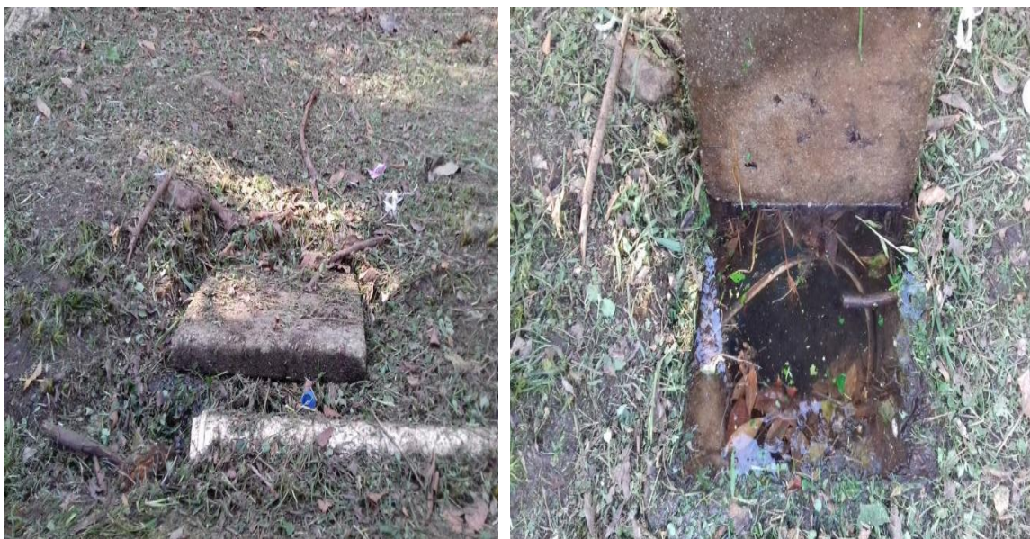
Figuras 9 e 10. Caixa de captação da nascente. Fonte: PMSP
