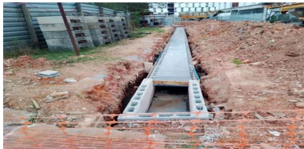
Condomínio 1: Drenagem Externa – Foto: ago./23.
