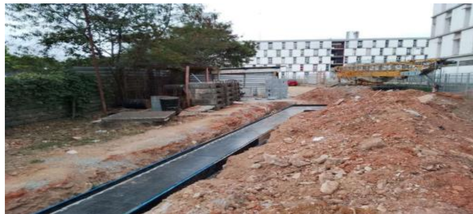
Condomínio 1: Drenagem Externa – Foto: ago./23.
