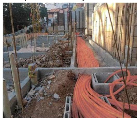
Eletroduto - Foto: ago./23
