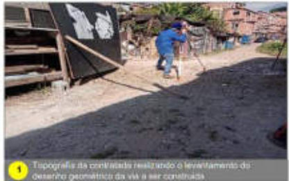
1 Topografia da contravista realizando o levantamento do desenho geométrico da via a ser construída.
