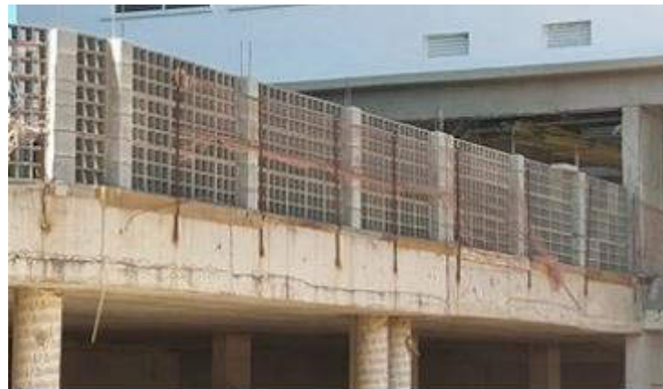
Elemento vazado na área comum entre as Torres A e B
