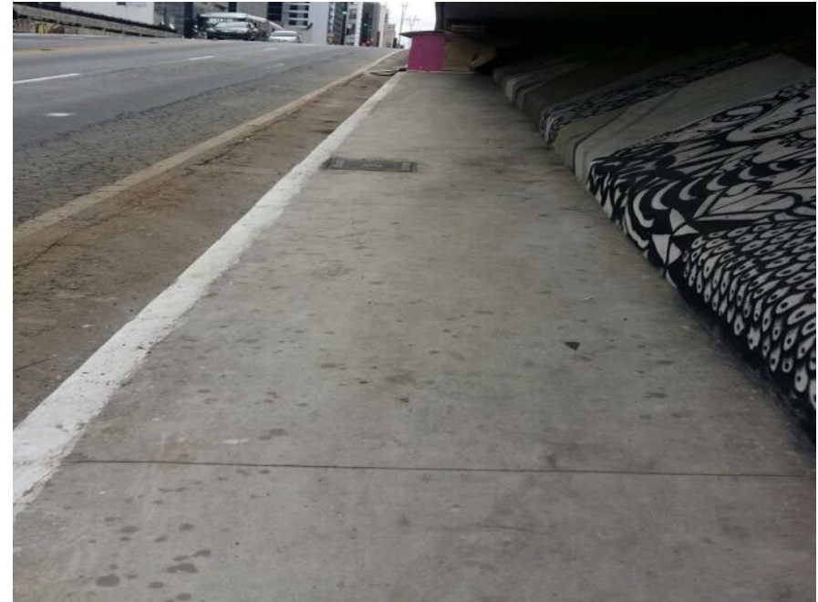
Túnel José Roberto Fanganiello Melhem / Viaduto Paulista. Valor empenhado: R$ 48.813,13 Valor liquidado: R$ 48.813,13
