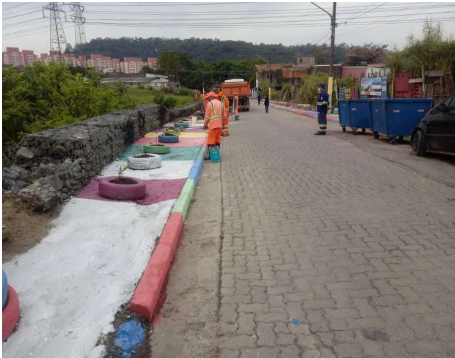
Ecoponto Móvel do Jardim 5 de Julho, montado em outubro
