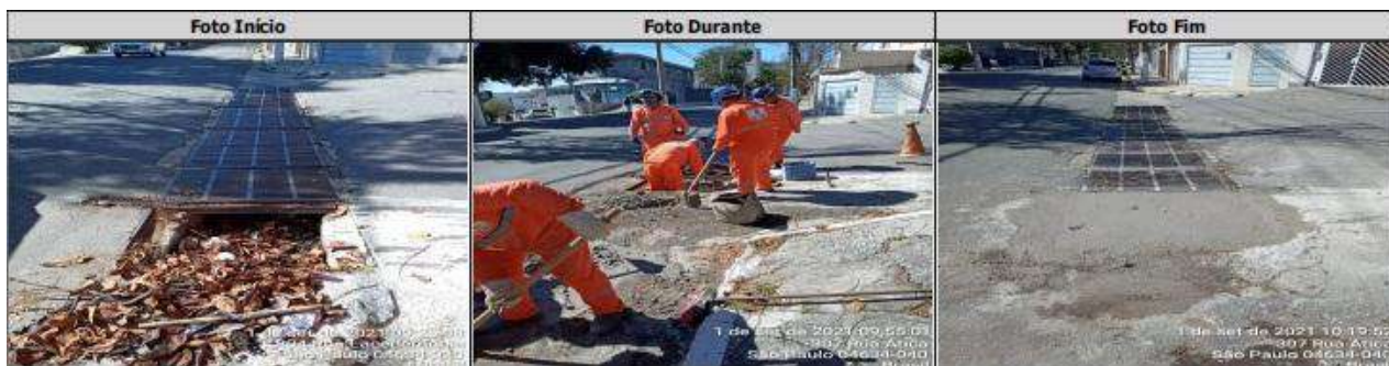
Manutenção sarjetão com grelhas
