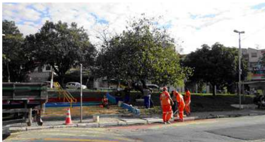
Conserto e manutenção de boca de lobo na Rua Leopoldo de Passos Lima
