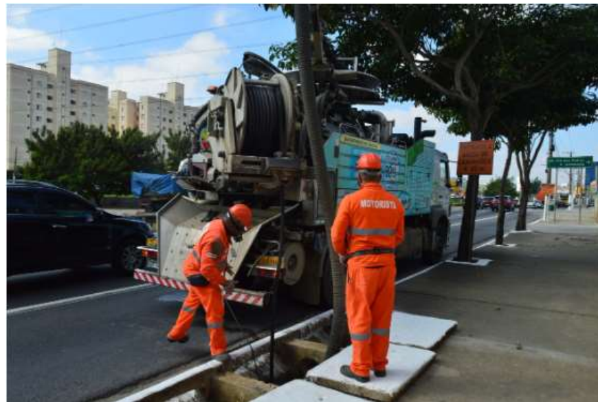
Legenda: Exemplo de Serviço de Microdrenagem.
