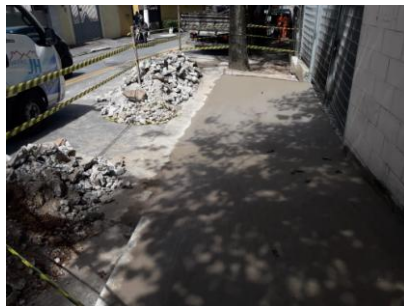
Calçada no Hospital Dia – Rede Hora Certa
