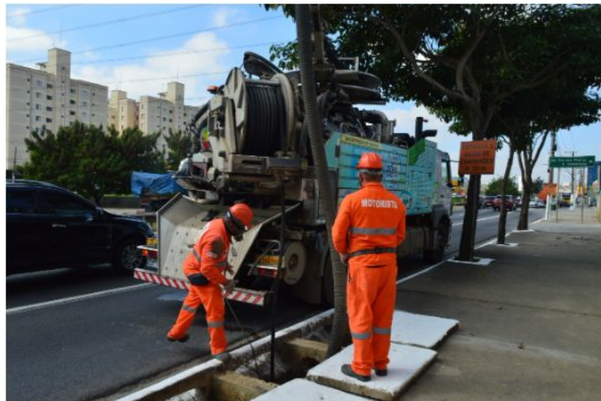
Legenda: Exemplo de Serviço de Microdrenagem.
