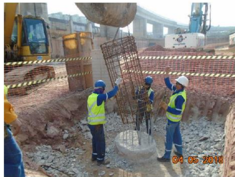
Foto n.º. 04 – Montagem da armação para realização de teste de carga na estaca.
