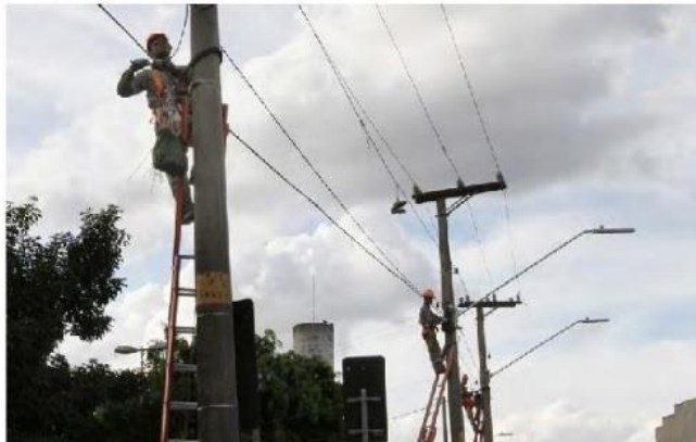
Os trabalhos já tiveram início nas avenidas Inácio Monteiro e Doutor Guilherme de Abreu Sodré
