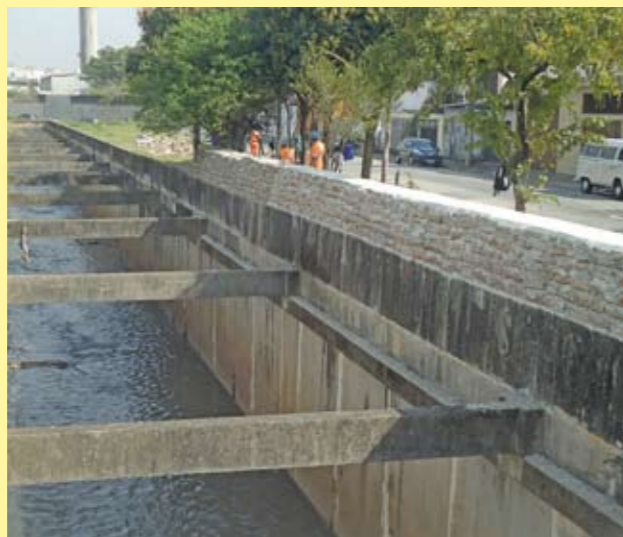
Contenção: proteção contra alagamentos e quedas
