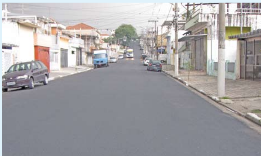
Rua Santa Eudóxia, na Casa Verde, recapeada - agora vem a sinalização de solo
