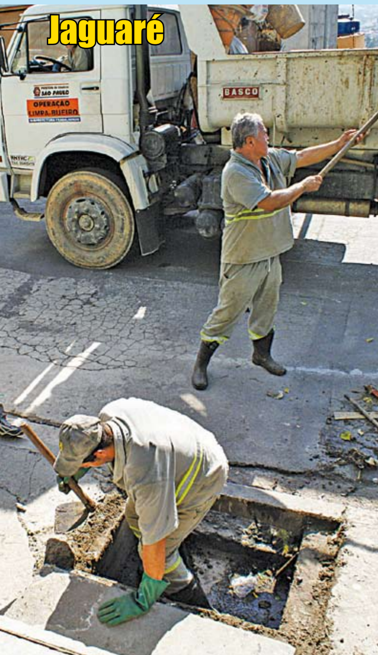
Rua Águas da Prata: sujeira entupiu a boca-de-leão
