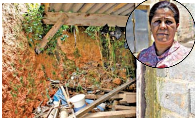
Desmoronamento: casa em encosta é interditada por oferecer risco
