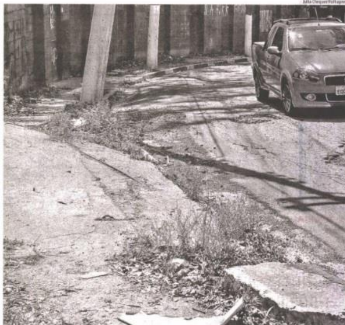
Veículo passa pela rua Agrimensor Sugaya, em Itaquera (zona leste), em trecho com calçada e asfalto irregulares; pedestres reclamam, ainda, de lixo no passeio
